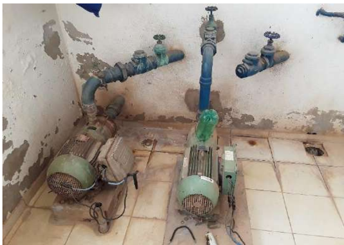
Figura 28 – Bombas – São José do Triunfo
