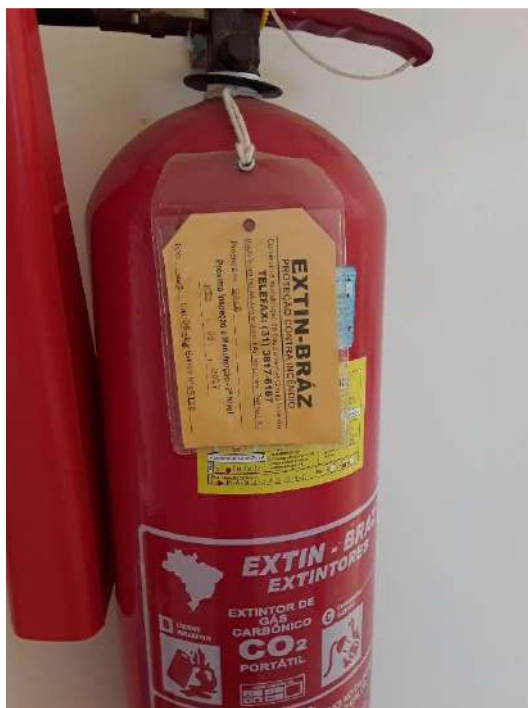
Figura 54 – Extintor de incêndio
