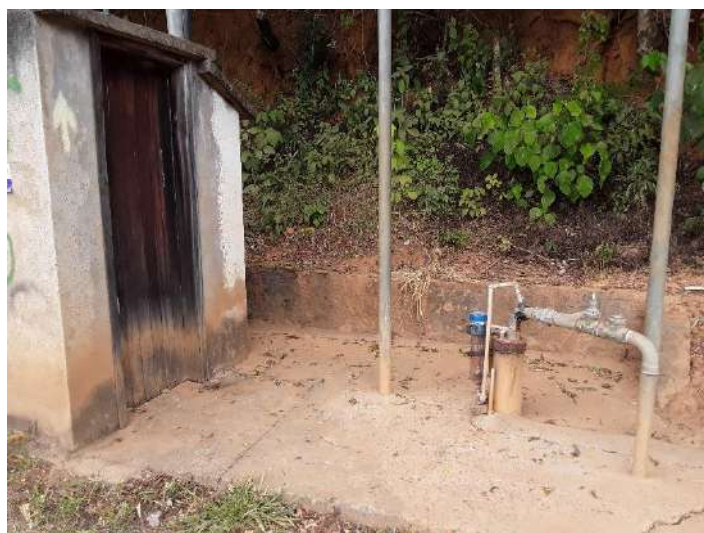
Figura 35 – Área da captação subterrânea – Romão dos Reis
