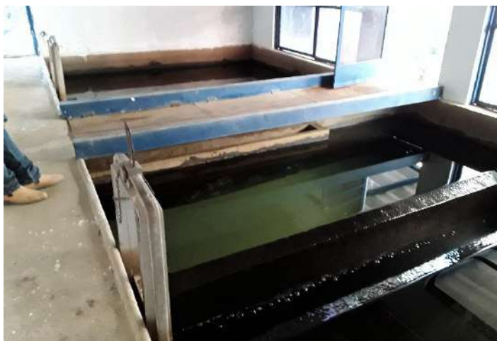
Figura 59 – Filtros – ETA I
