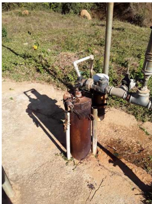
Figura 11 – Captação subterrânea – Córrego São João
