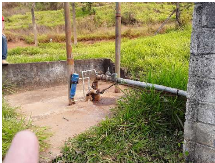
Figura 37 – Área da captação subterrânea – Nova Viçosa
