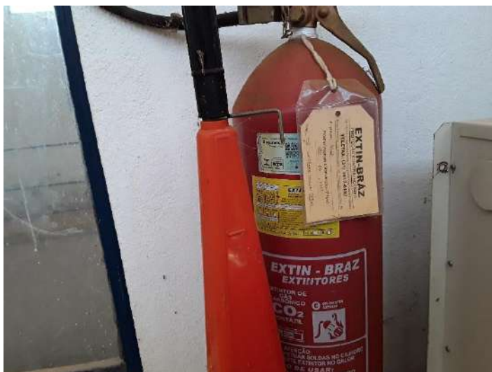
Figura 8 – Extintor de Incêndio – Rio Turvo Sujo
