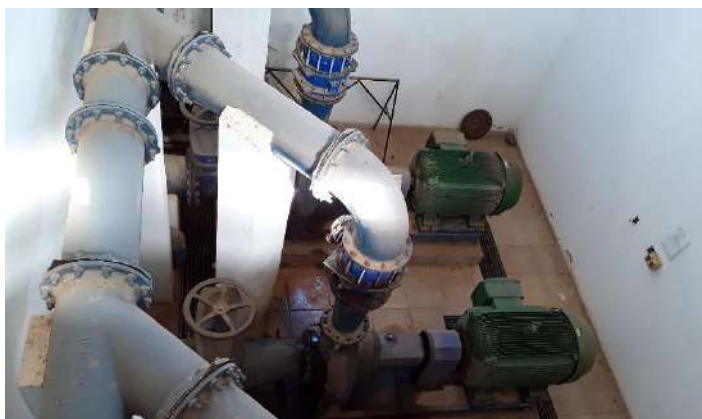
Figura 69 – Casa de Bombas – ETA II
