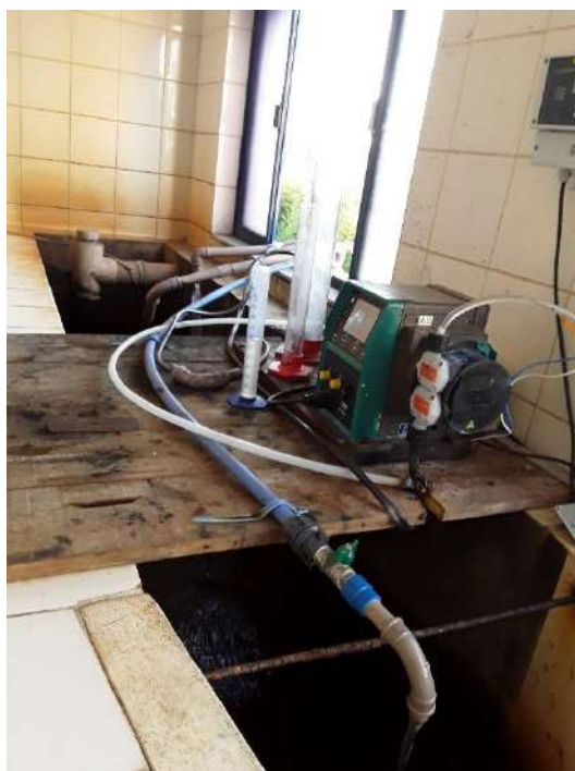
Figura 51 – Bomba dosadora – ETA I
