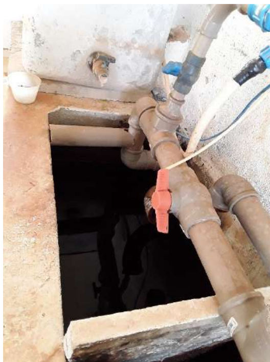
Figura 20 – Tanque de Contato – Cachoeira de Santa Cruz
