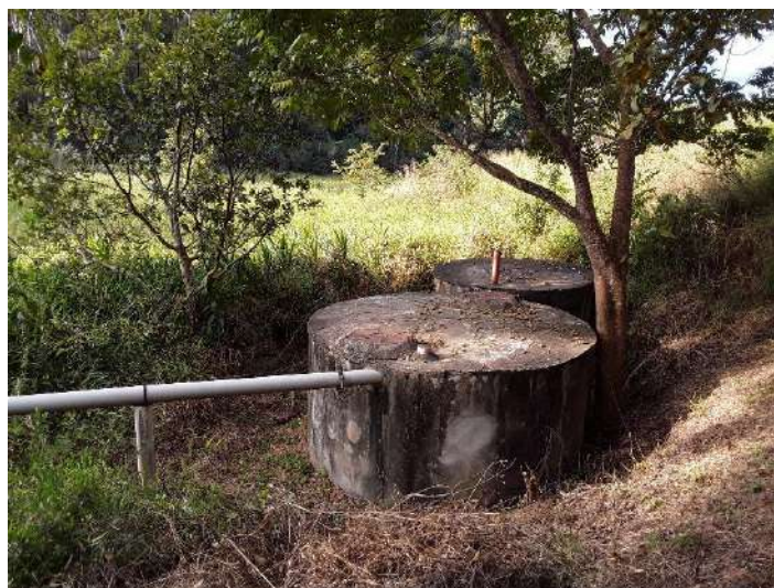
Figura 81 – ETE Zona Rural dos Nobres
