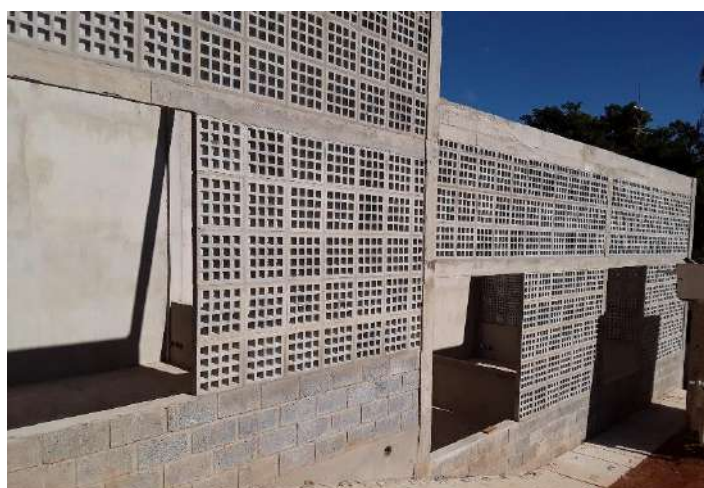
Figura 66 – Estrutura para armazenar produtos químicos – ETA II
