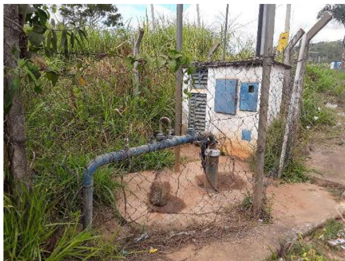
Figura 14 – Área da captação subterrânea – Novo Silvestre
