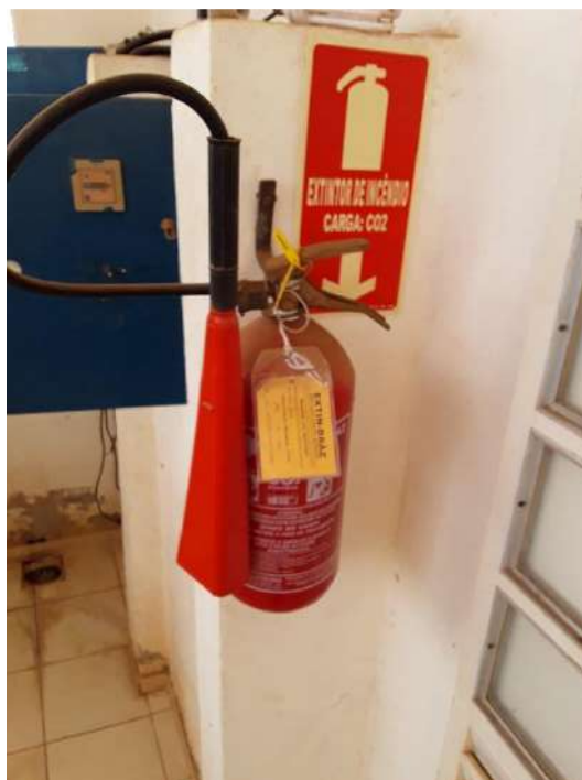
Figura 29 – Extintor de incêndio – São José do Triunfo
