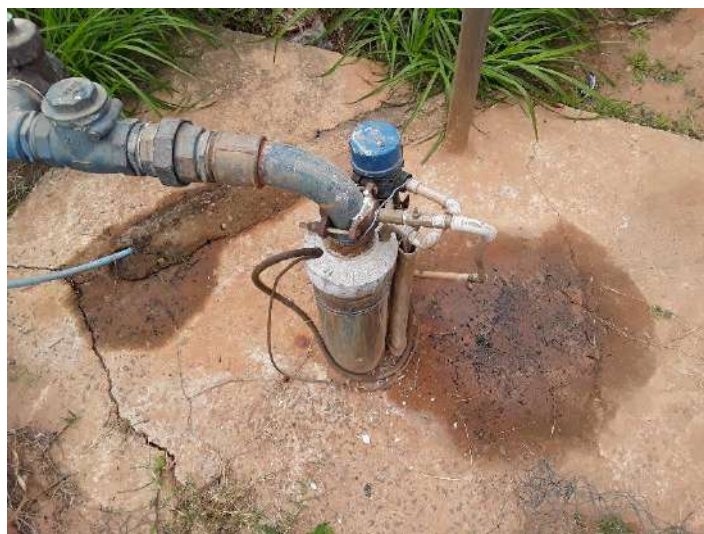
Figura 15 – Captação subterrânea – Novo Silvestre
