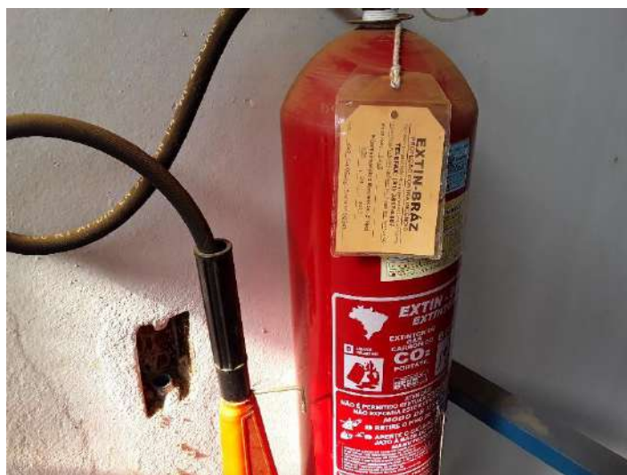
Figura 71 – Extintor de incêndio – ETA II
