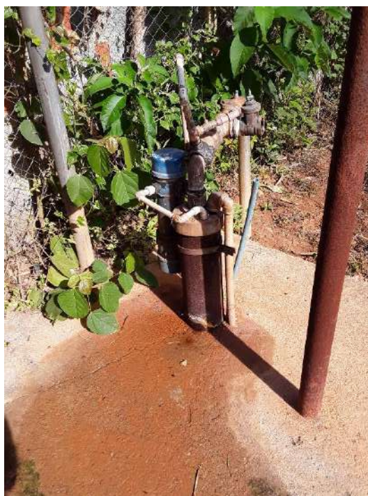
Figura 44 - Captação subterrânea – Sol Nascente
