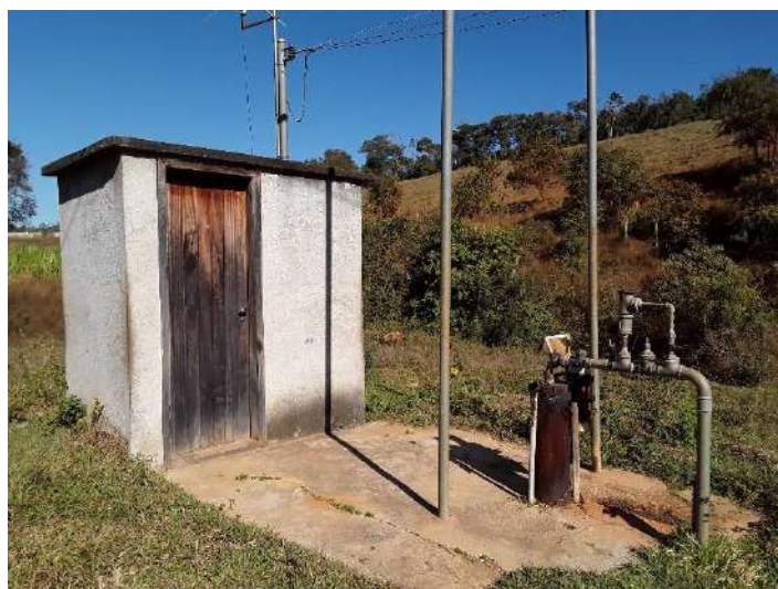
Figura 10 – Área da captação subterrânea – Córrego São João
