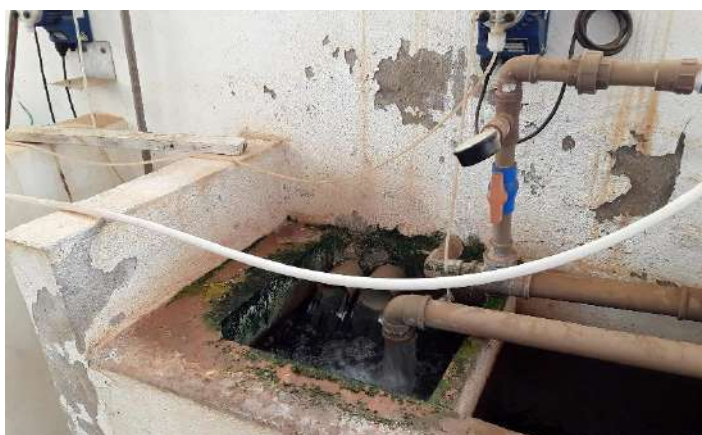
Figura 27 – Tanque de Contato – São José do Triunfo
