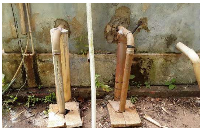
Figura 22 – Tubulações – Cachoeira de Santa Cruz
