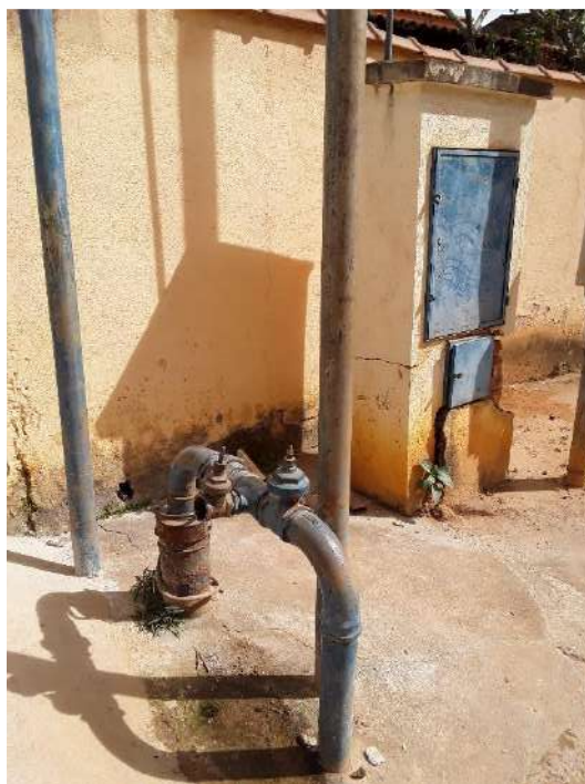
Figura 24 – Captação Subterrânea 1 – São José do Triunfo
