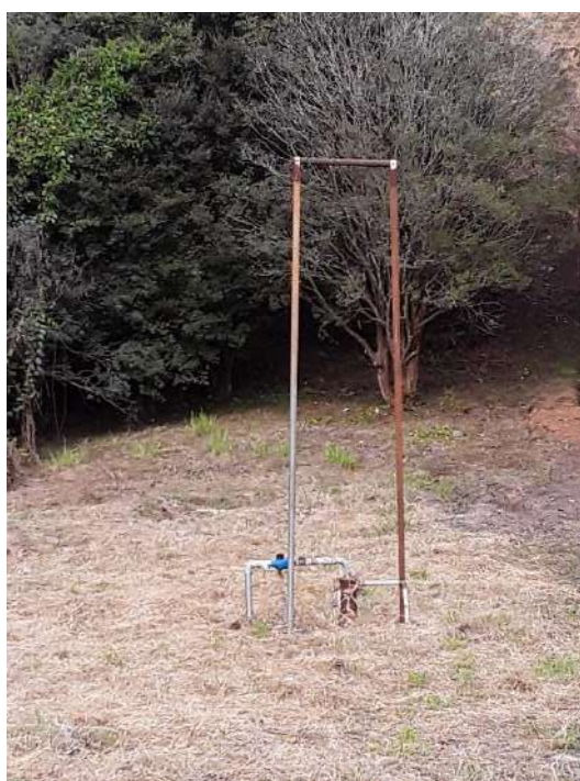
Figura 48 – Captação subterrânea – Rua Nova
