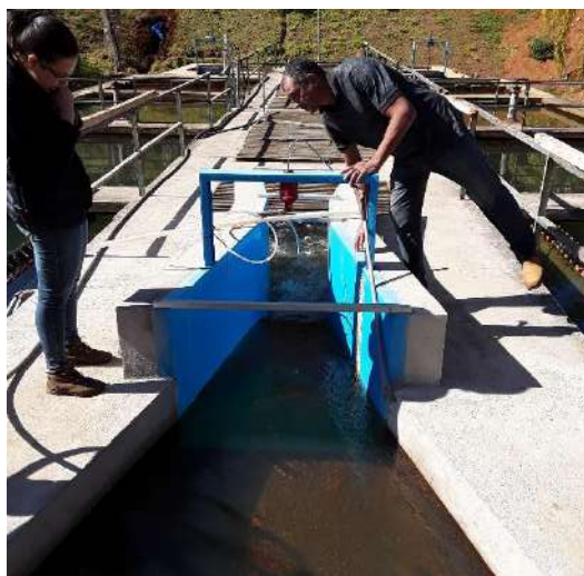
Figura 63 – Nova Calha Parshall – ETA II
