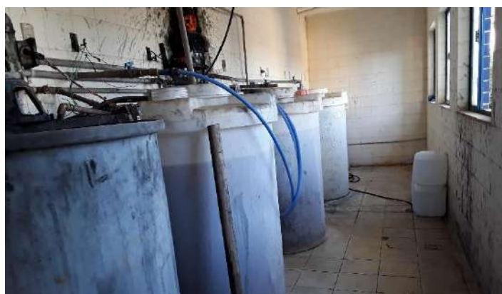
Figura 57 – Armazenamento de produtos químicos – ETA I
