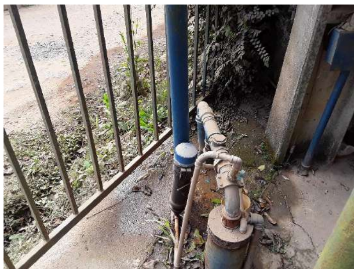
Figura 46 - Captação subterrânea – Cristais
