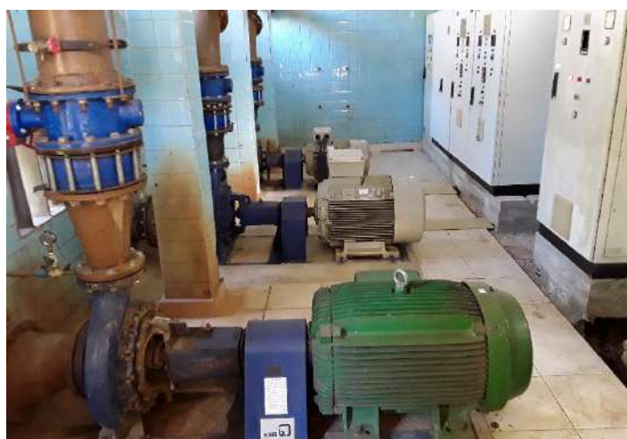
Figura 4 – Casa de bombas - Ribeirão São Bartolomeu
