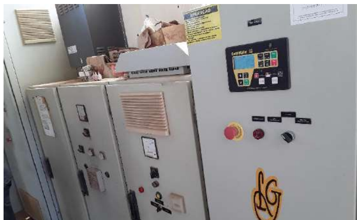
Figura 70 – Painel de Controle – ETA II
