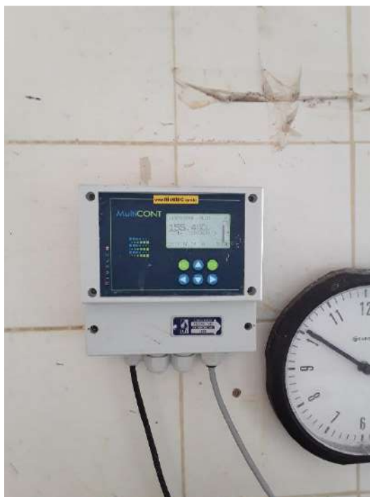
Figura 52 – Macromedidor – ETA I
