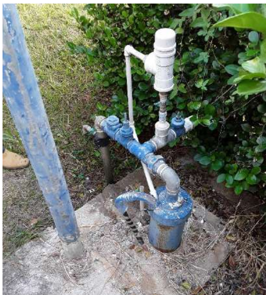
Figura 32 – Captação subterrânea – Octávio Pacheco
