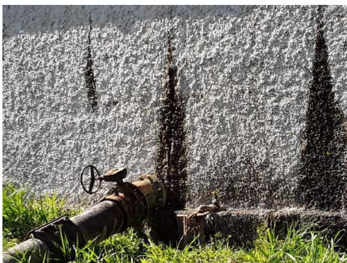
Figura 68 – Vazamento no reservatório – ETA II
