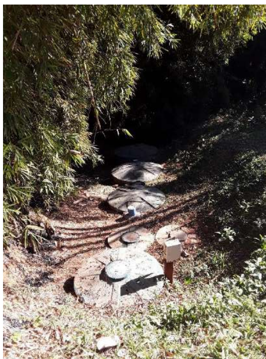
Figura 80 – ETE Sol Nascente
