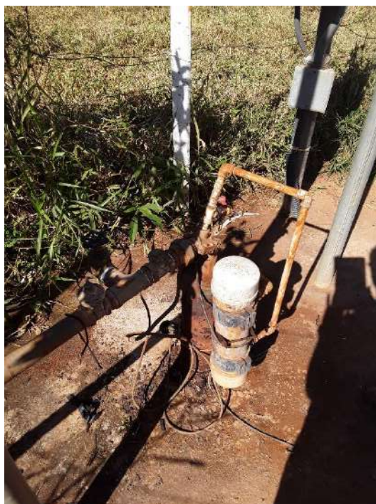
Figura 13 – Captação subterrânea – Pau de Cedro
