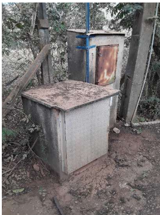
Figura 40 – Quadro de Comando – Novo Paraíso
