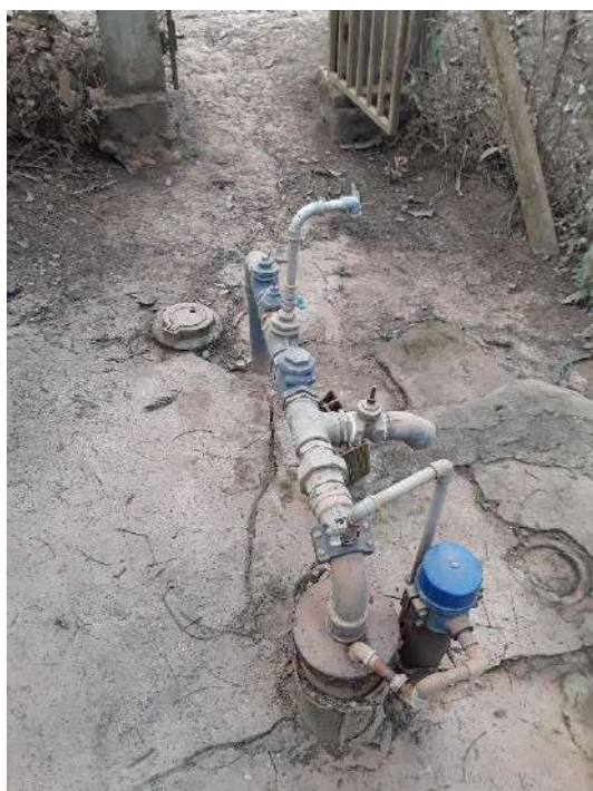
Figura 39 – Captação subterrânea – Novo Paraíso
