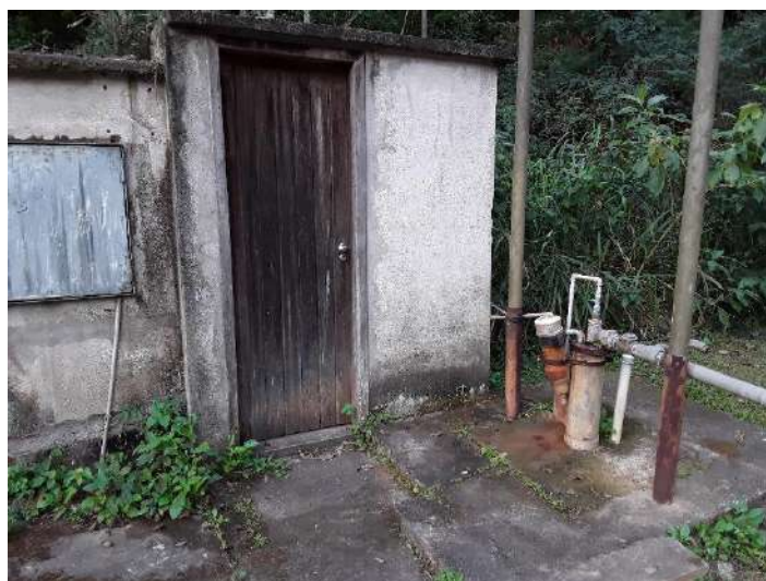
Figura 30 – Área da captação subterrânea – Vila Alves
