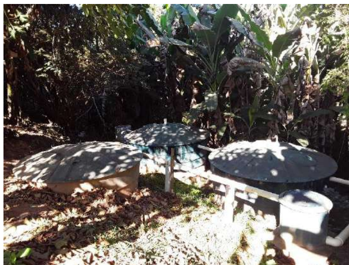
Figura 78 – Área da ETE São Francisco de Assis
