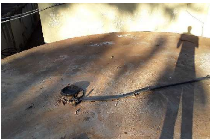
Figura 60 – Tanque de contato – ETA I
