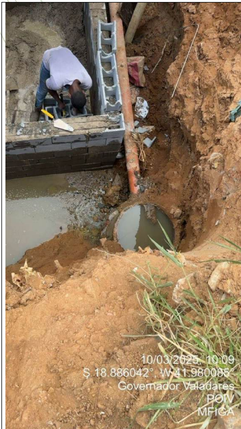
Foto 2 – Esgoto e Vala Aberta, detalhe para o PV
