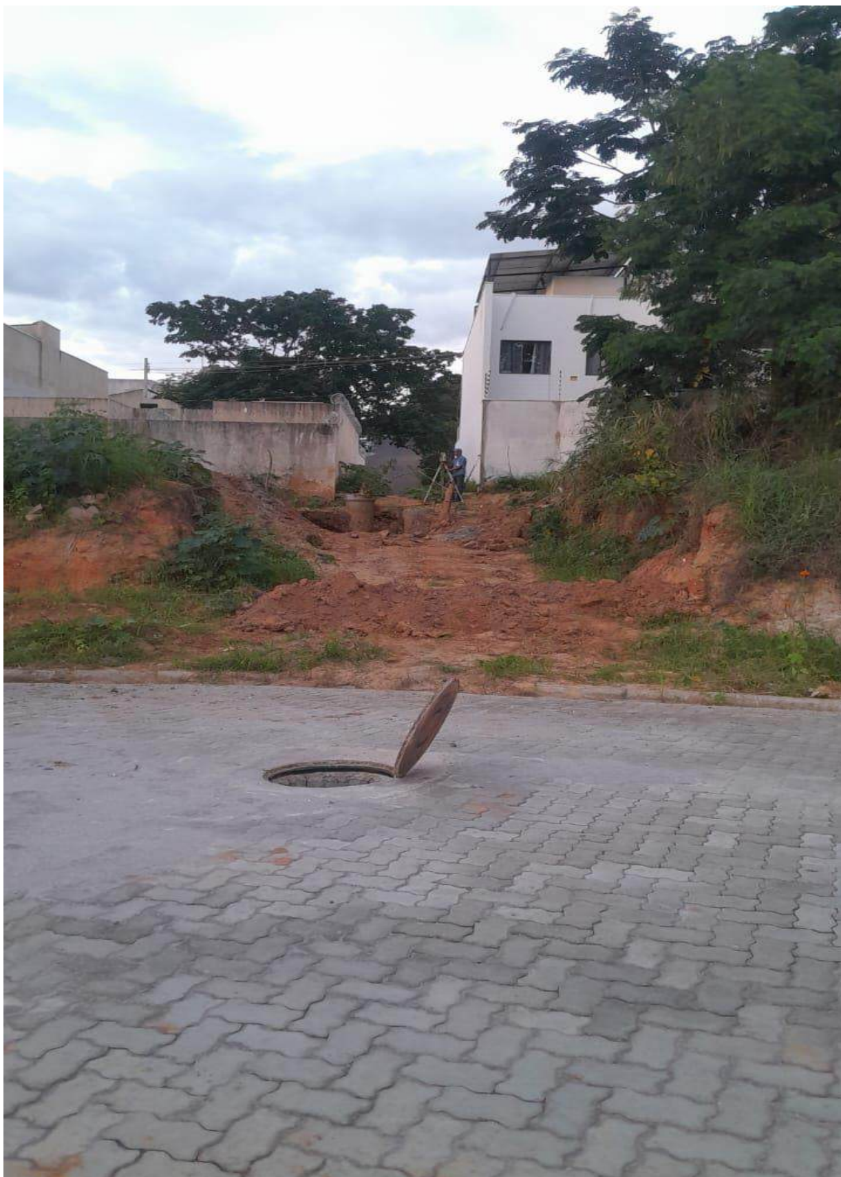
PV DE DRENAGEM – RUA B – PARQUE OLIMPICO IV
