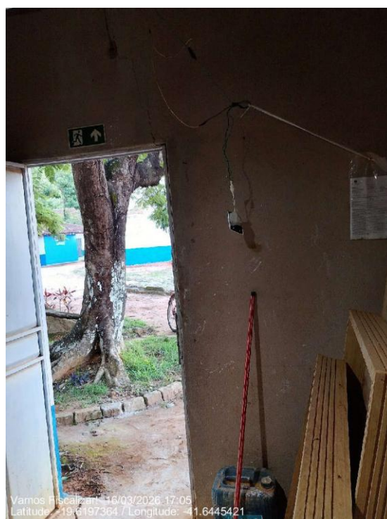
Placa de saída e manual de emergência
