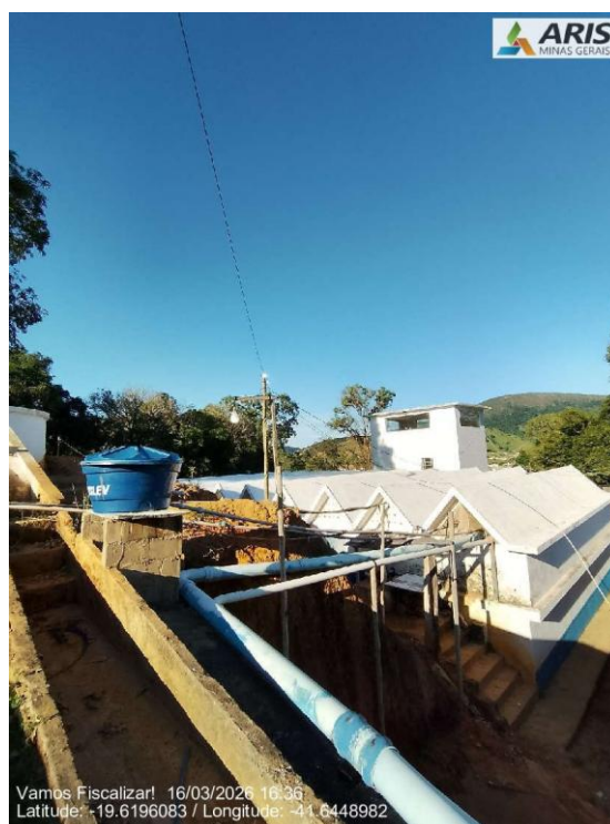
Vista do tanque de contato e tanque de cloro.
