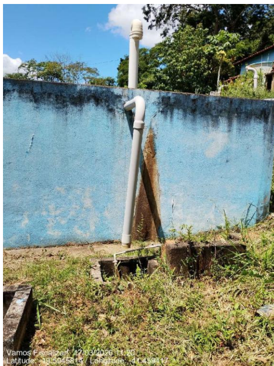
Tubo extravasor com saída para a caixa do registro da tubulação de saída
