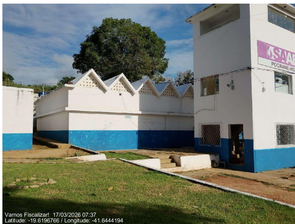
Ausência de dispositivo de indicador de nível de água.
