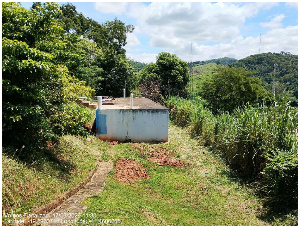
Ausência de guarda-corpo
