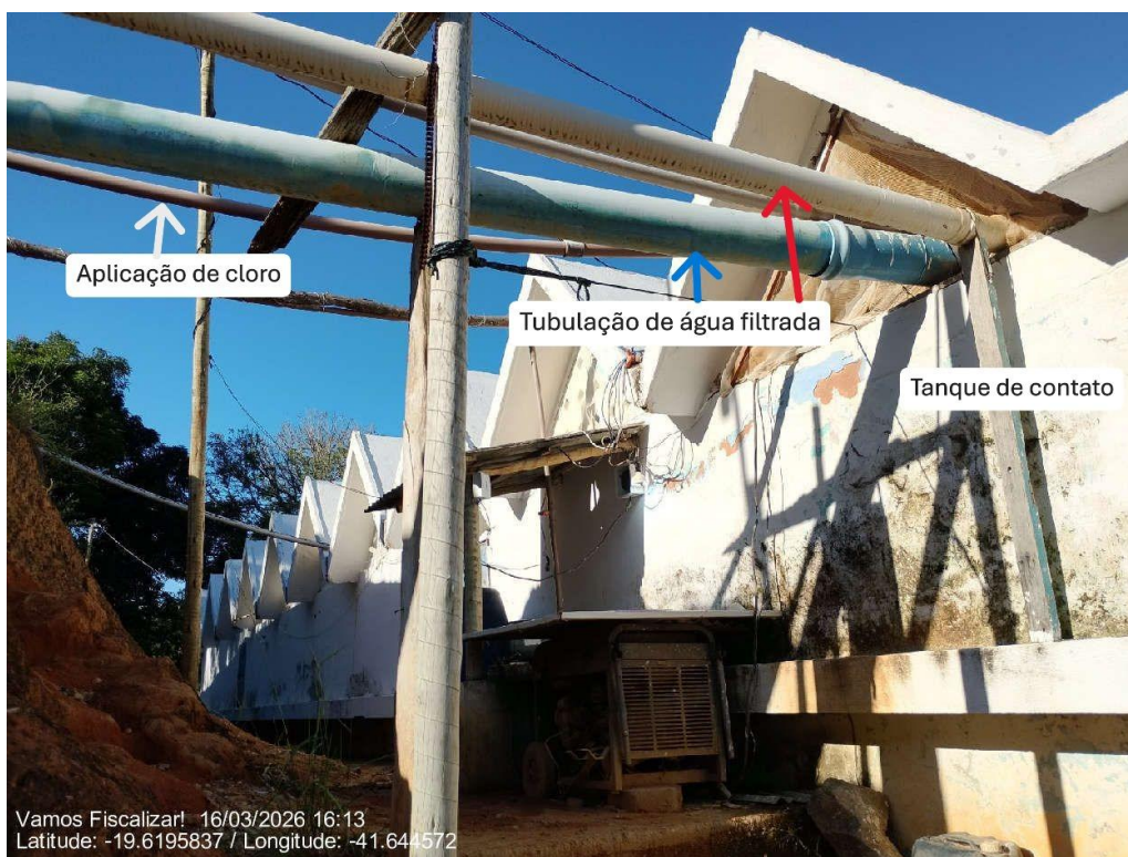
Tubulações de entrada de águas filtradas e do cloro no tanque de contato
