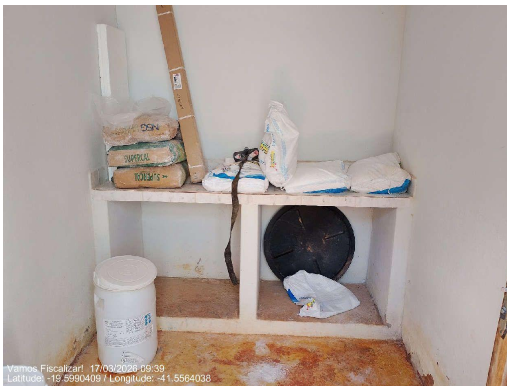
Armazenamento dos produtos químicos
