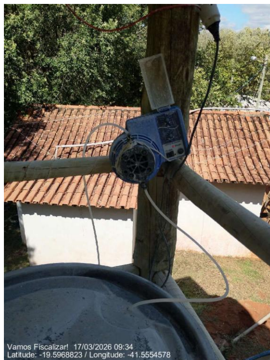
Bomba dosadora de cloro
