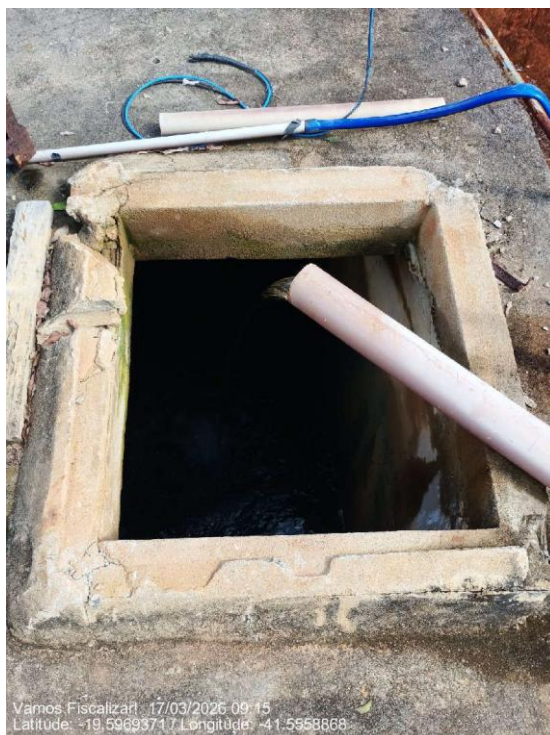
Tubulação de água clorado chegando no tanque de contato
