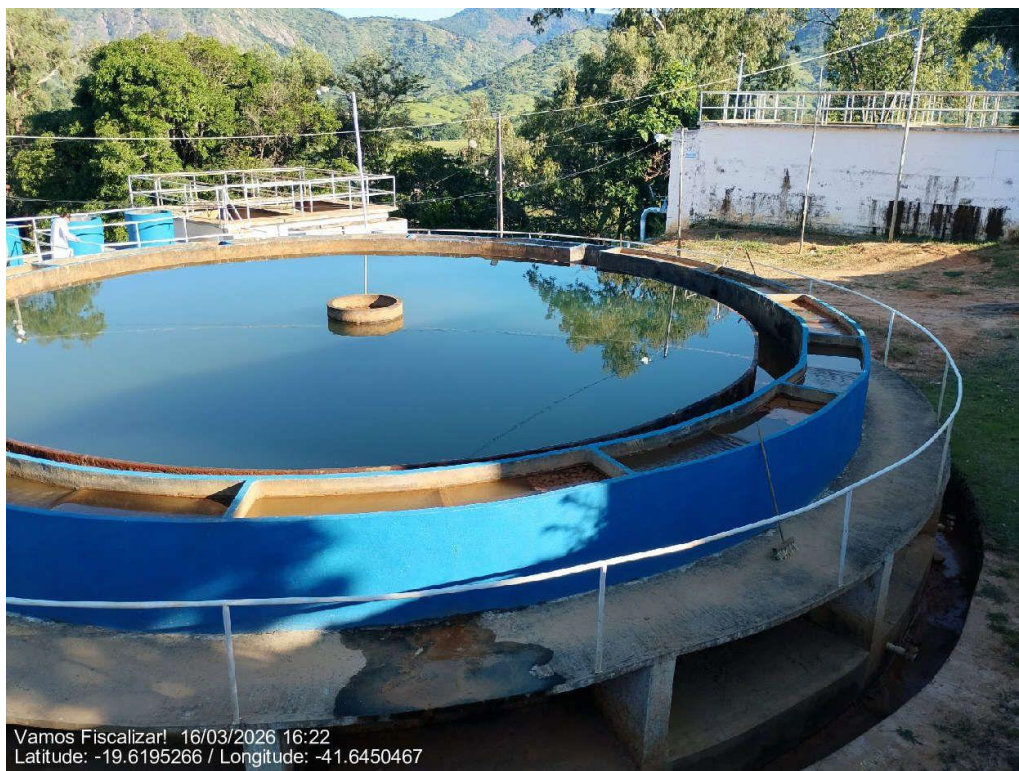
Floculadores no entorno do decantador
