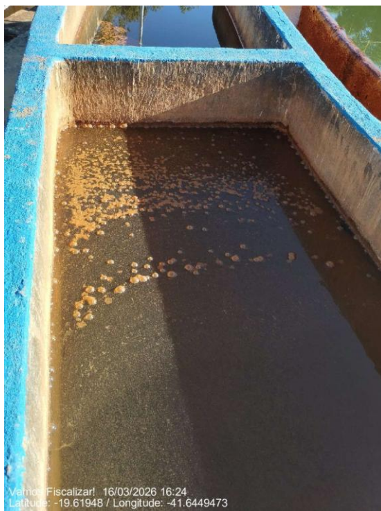
Formação de flocos nos floculadores (Circular)
