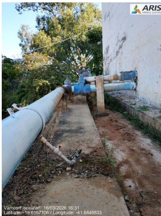
Vista lateral da tubulação de saída das câmaras 1 e 2 do filtro (retangular)
