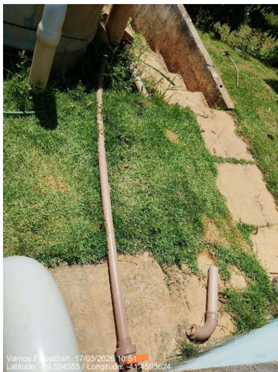
Tubulação de descarte da água bruta
