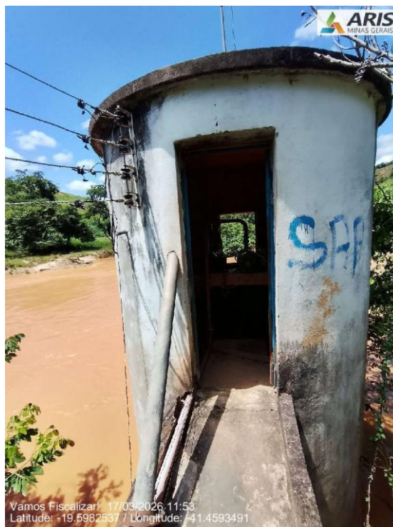
Captação Superficial Rio São José - Casa de bomba.
