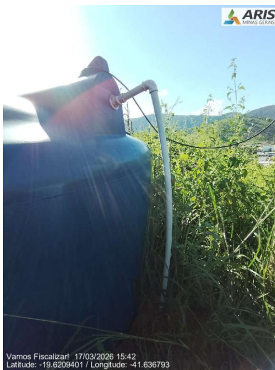
Ausência de válvula na tubulação de entrada.
