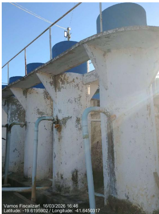
Filtros em operação (Circular)
