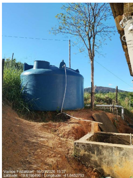
Reservatório complementar para retrolavagem do filtro retangular
