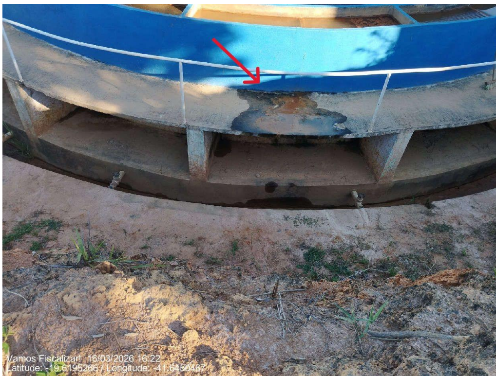
Vazamentos no floculadores/decantador (Circular)
