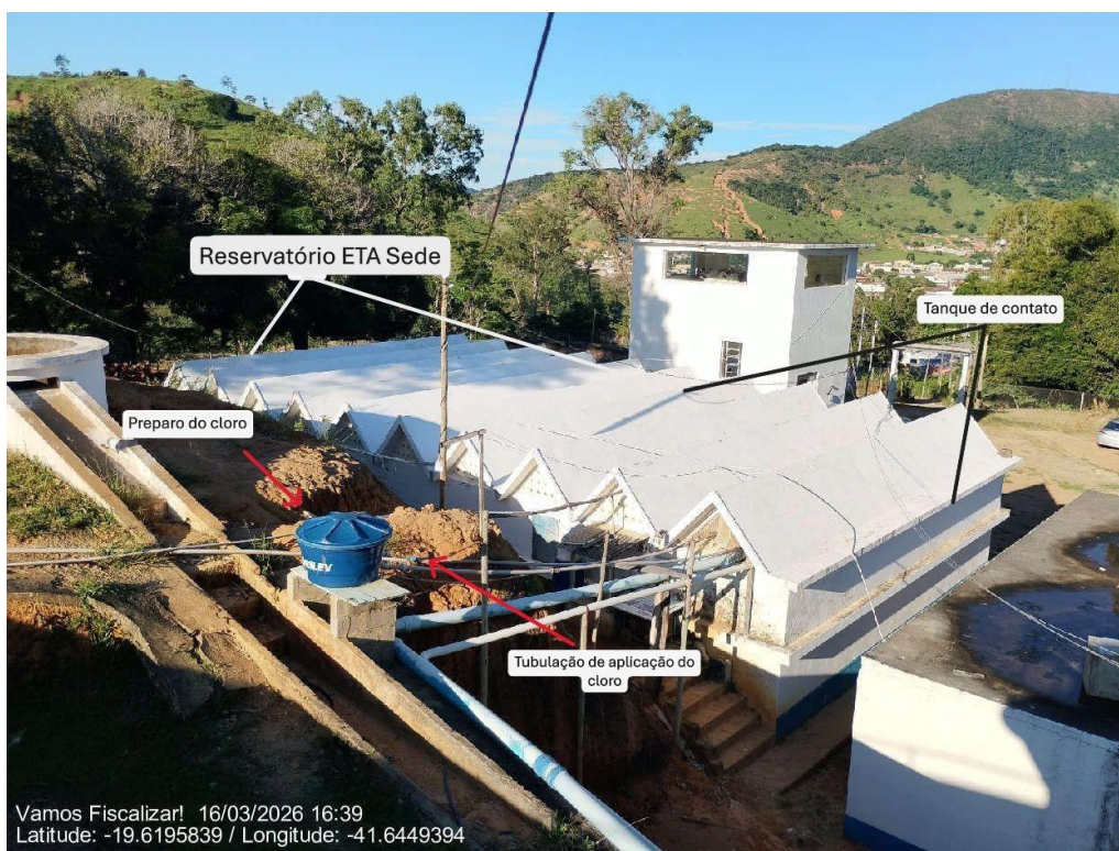
Caixa d'água azul utilizada para o preparo do cloro
