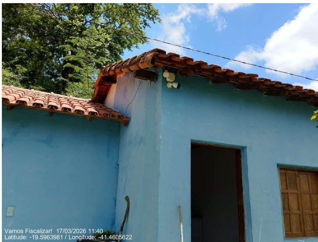
Lâmpada externa não estava funcionando durante a fiscalização
