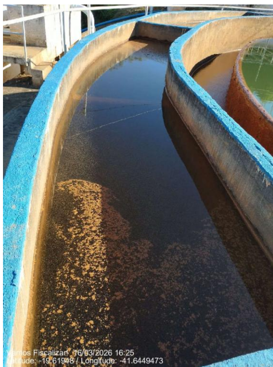
Formação de flocos nos floculadores (Circular)
