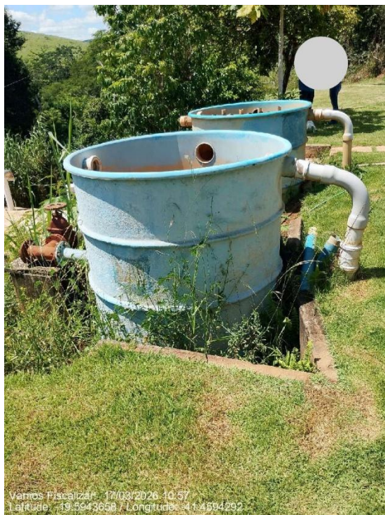
Sem proteção no entorno dos filtros
