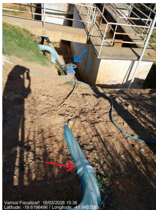
Tubulação de entrada da água bruta (seta vermelha) e registro da tubulação de sobra da água bruta
