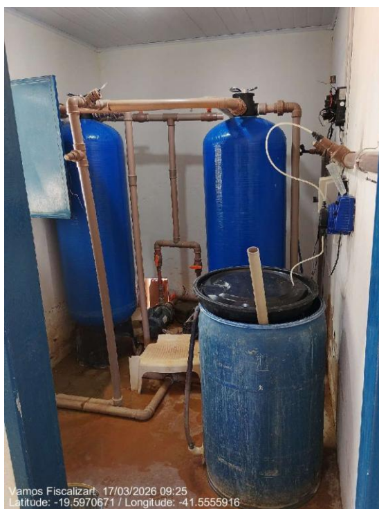
Filtros pressurizados na mesma área de preparo e dosagem do sulfato de alumínio
