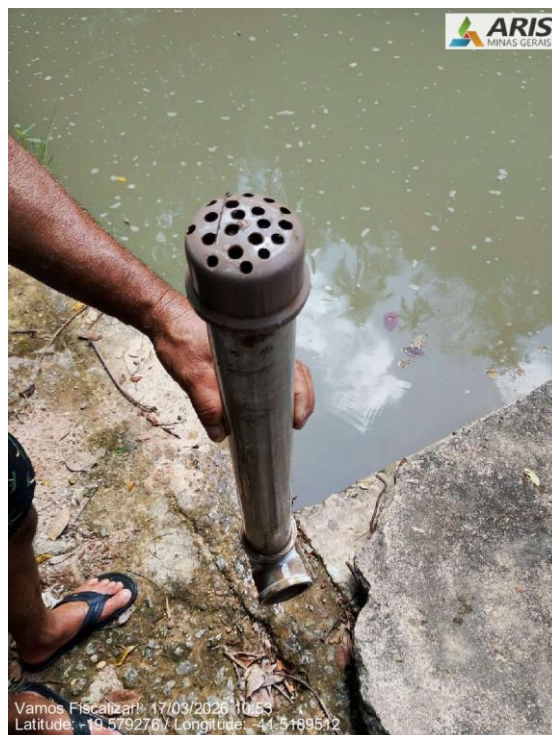
Detalhe da tubulação.
