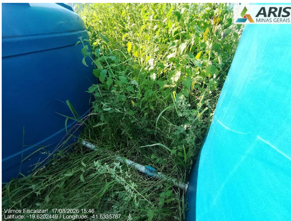
Válvula que conecta as caixas d'água.
