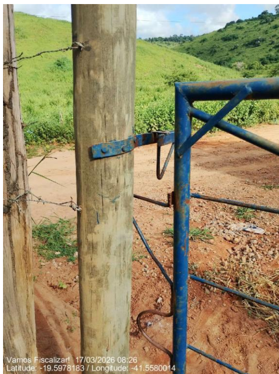
Portão sem tranca ou outro dispositivo que impeça o acesso de pessoas não autorizadas
