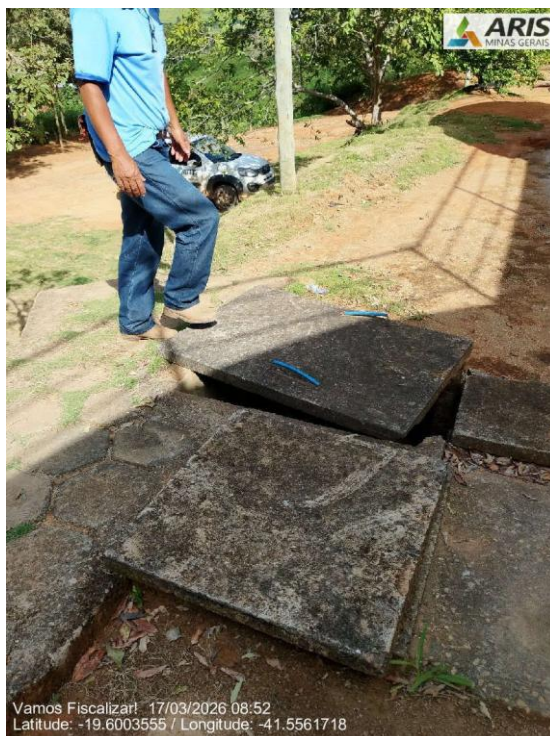
Caixa de registro de entrada do reservatório
