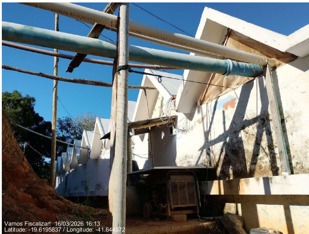
Tubulação de entrada na câmara 1 da estrutura de reservação I (tanque de contato).
