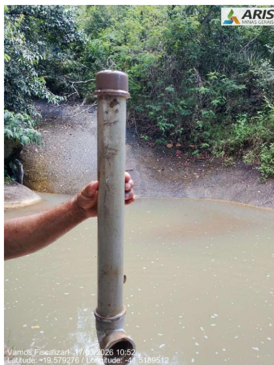
Tubulação de PVC utilizada para captação de água durante o período de cheia.
