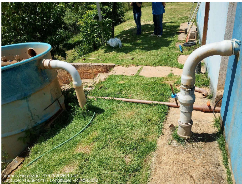
Tubulação de saída do decantador em direção ao filtro
