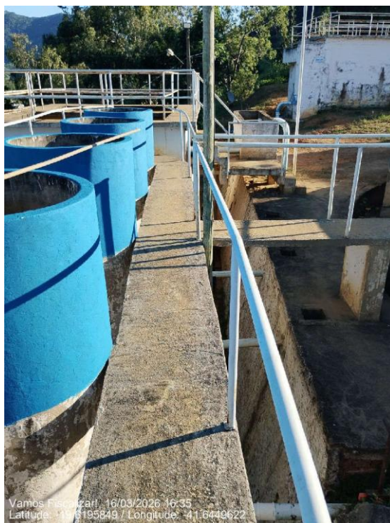
Guarda-corpos inadequados, com altura insuficiente, vãos excessivos e falta de proteção interna no acesso aos filtros (Circular)
