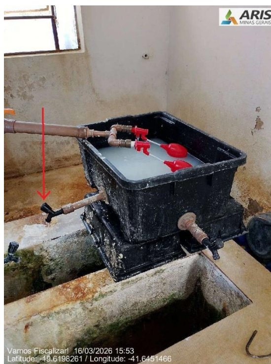
Torneiras em bom estado de conservação para dosagem do sulfato (seta vermelha indica canal que vai para tratamento retangular)
