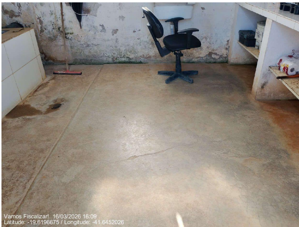
Área de preparo e dosagem dos produtos químicos
