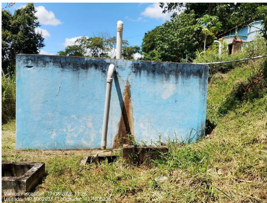
Rachaduras na parede do reservatório e marcas de vazamento
