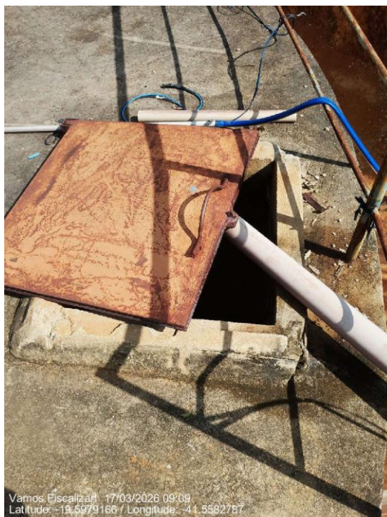
Tampa de inspeção na câmara 1 do tanque de contato, demonstrando a tubulação de chegada da água clorada
