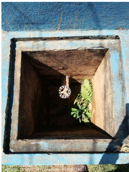
Caixa de registro de descarga de fundo dos decantadores
