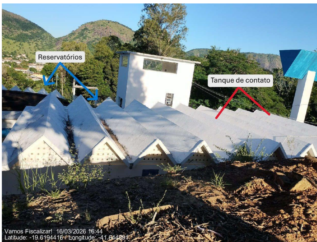
Tanque de contato ao lado do reservatório
