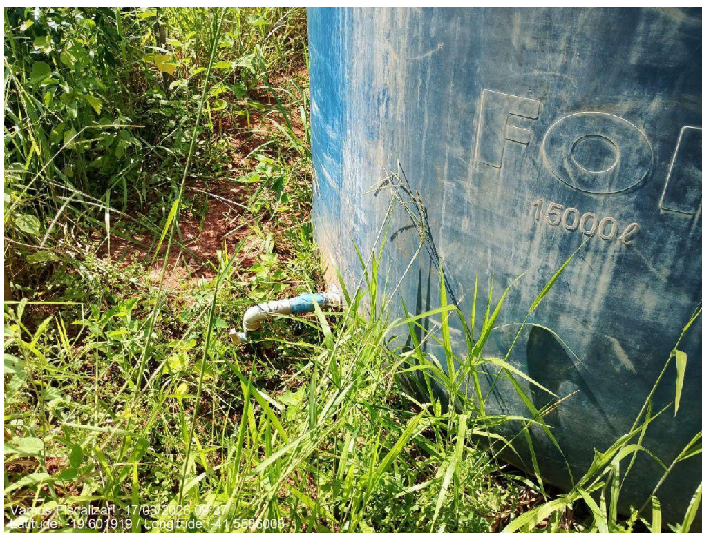
Ausência de controle e medição de vazão na saída.
