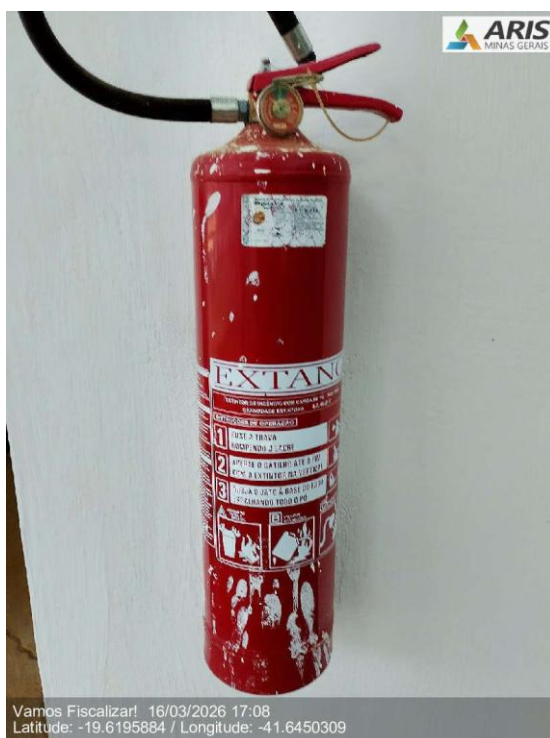
Extintor de incêndio localizado na parte externa
