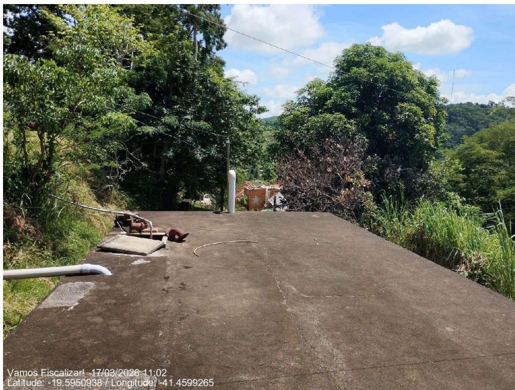
Ausência de guarda-corpo
