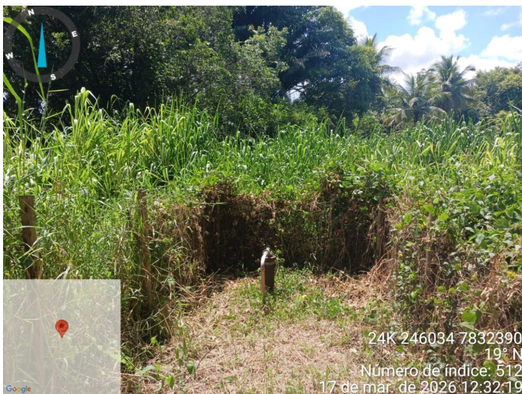
Vista geral da captação subterrânea (interior)
