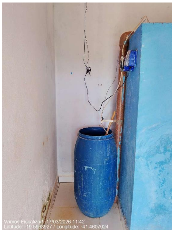
Preparo e dosagem do sulfato de alumínio
