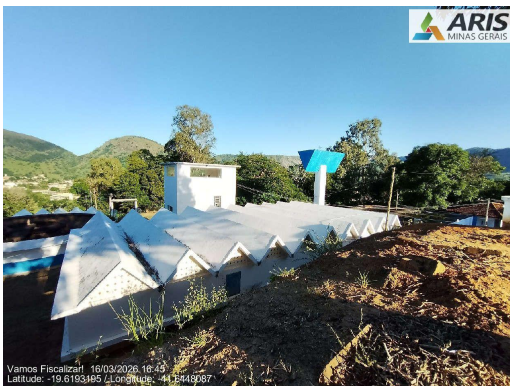
Vista superior do tanque de contato e reservatório.
