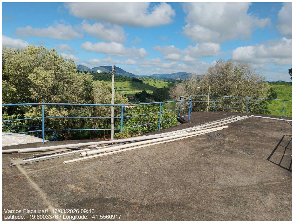
Guarda corpo no tanque de contato
