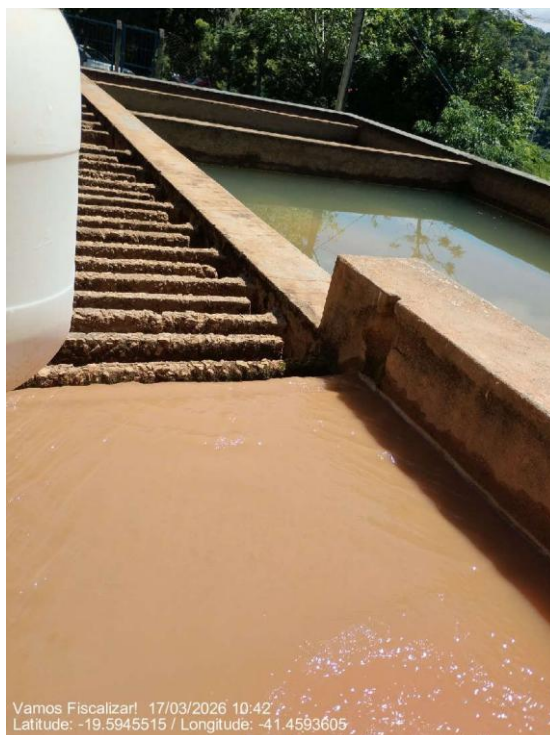
Entrada dos floculadores
