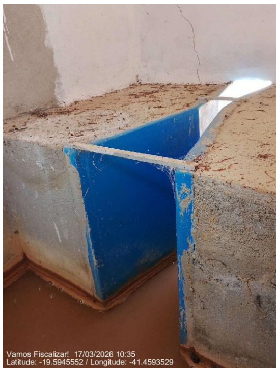
Calha Parshall na entrada do tratamento
