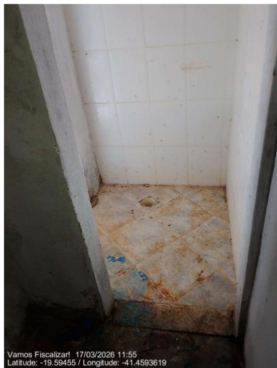
Manchas no piso
