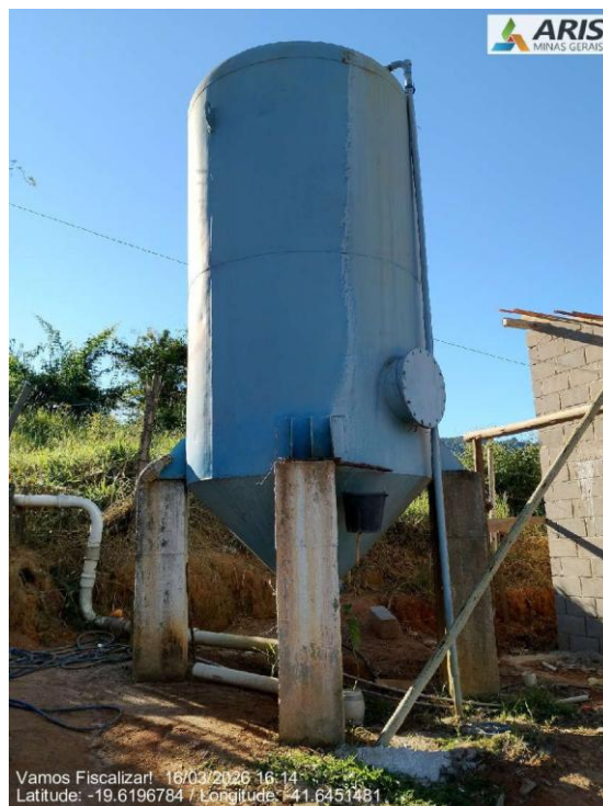
Reservatório para retrolavagem do filtro retangular
