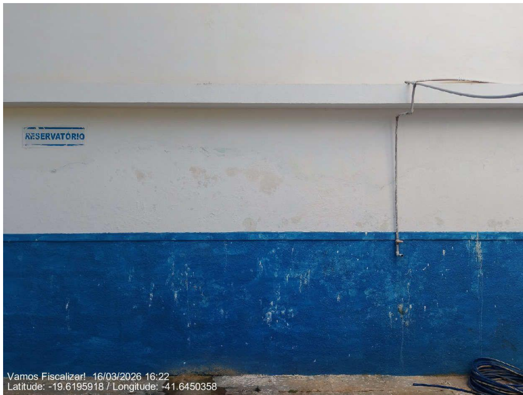
Sinais de eflorescências.
