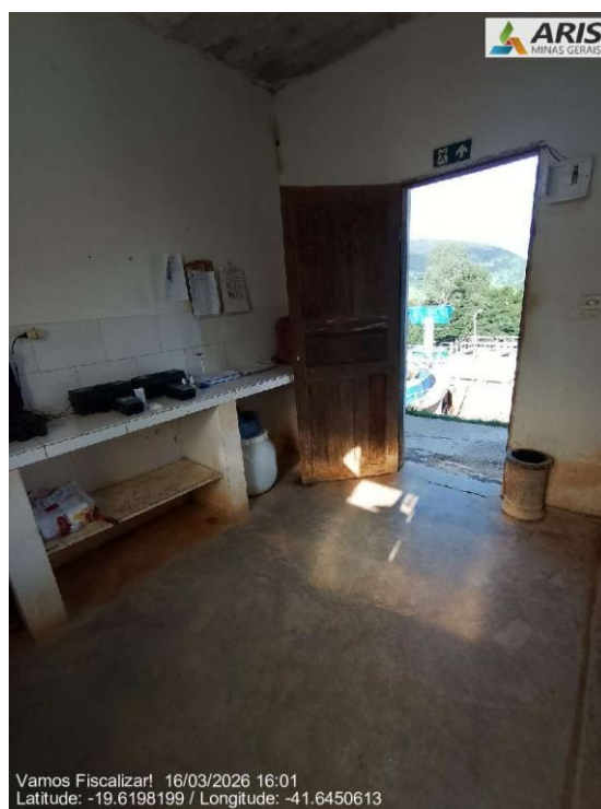
Área de preparo e dosagem dos produtos químicos
