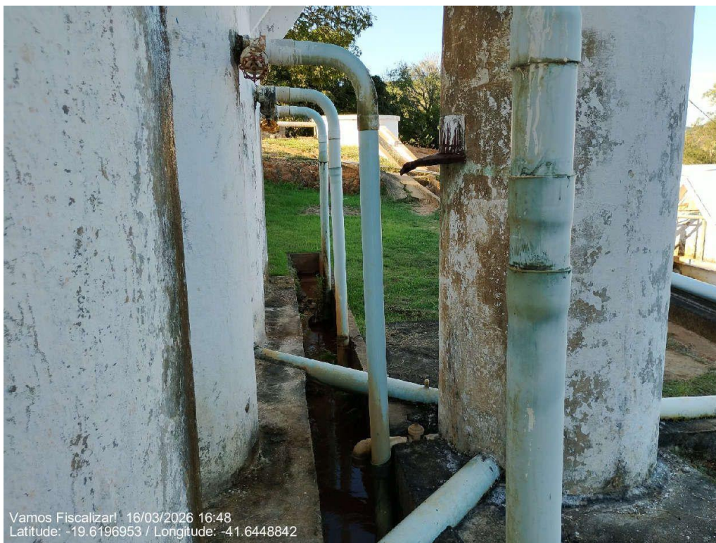
Tubulações de descarte da retrolavagem e de saída da água filtrada (Circular)
