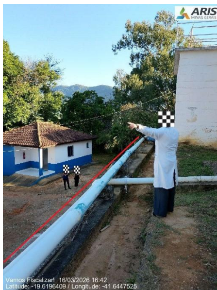
Área próxima aos filtros. Linha vermelha indica a ausência de guarda corpo
