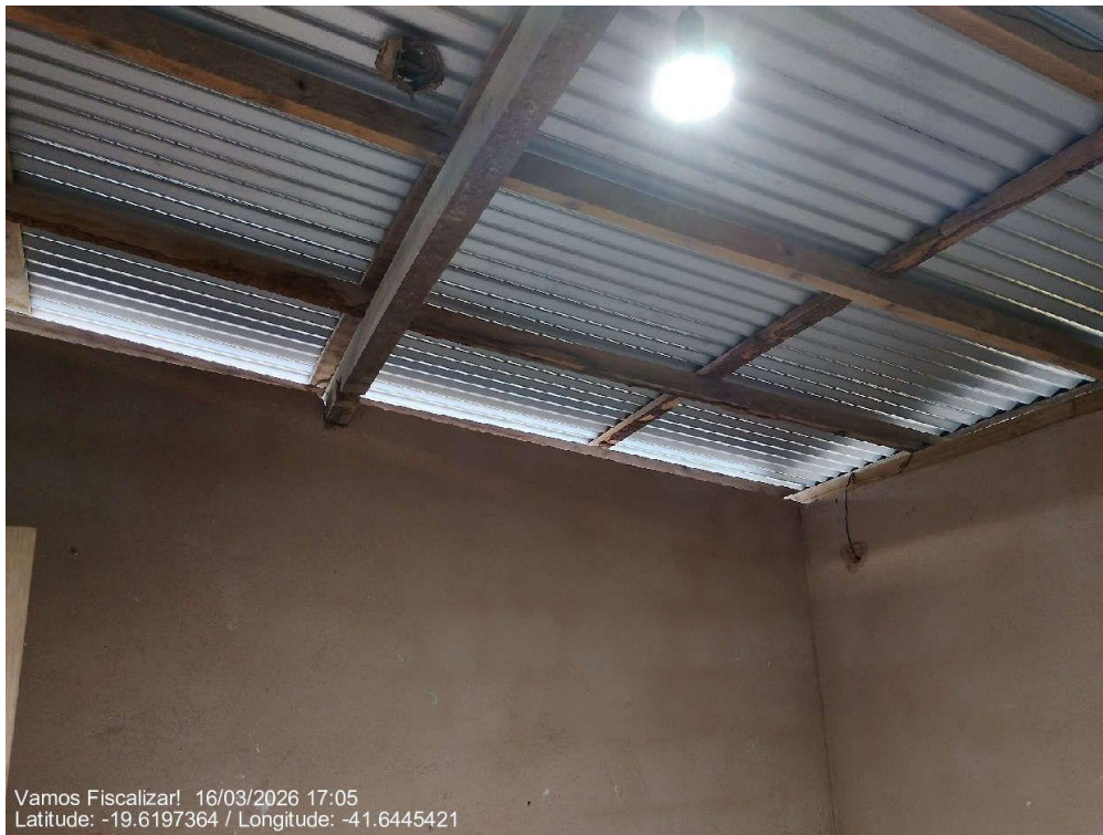
Iluminação noturna no depósito de produtos químicos
