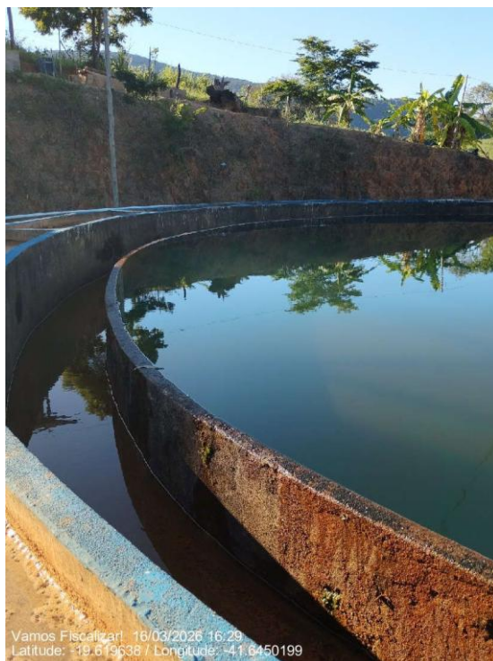
Água clarificada escoando do decantador (Circular)
