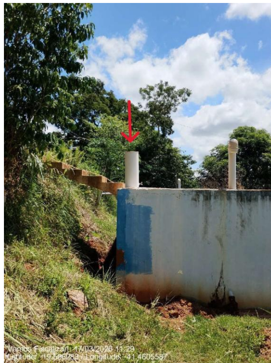
Clorador no reservatório
