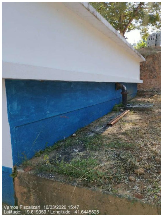
Extravaso da Câmara 2 da estrutura de reservação I.
