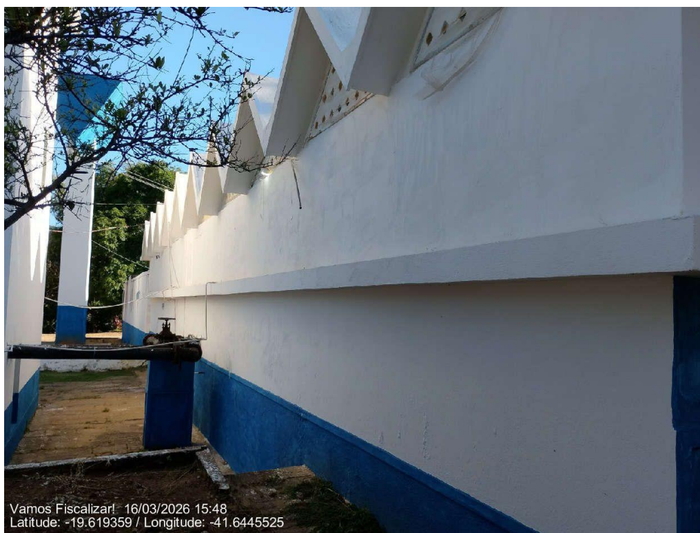
Saída da estrutura de reservação I.
