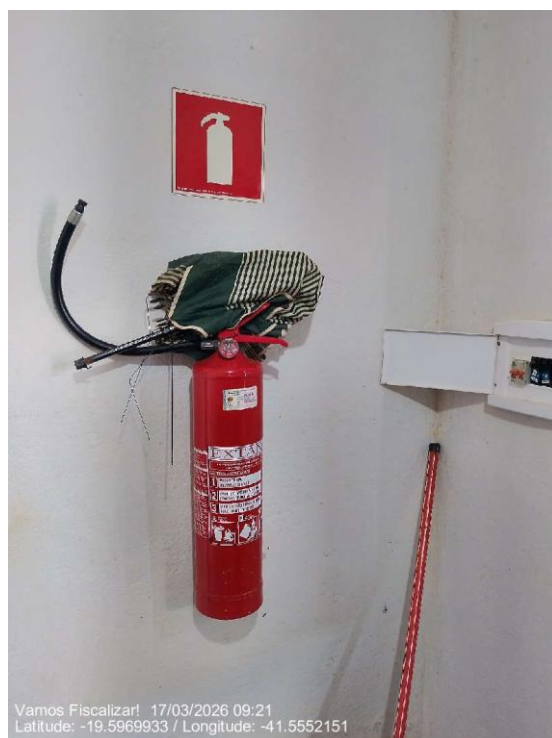
Extintor na área dos filtros e preparo do sulfato de alumínio
