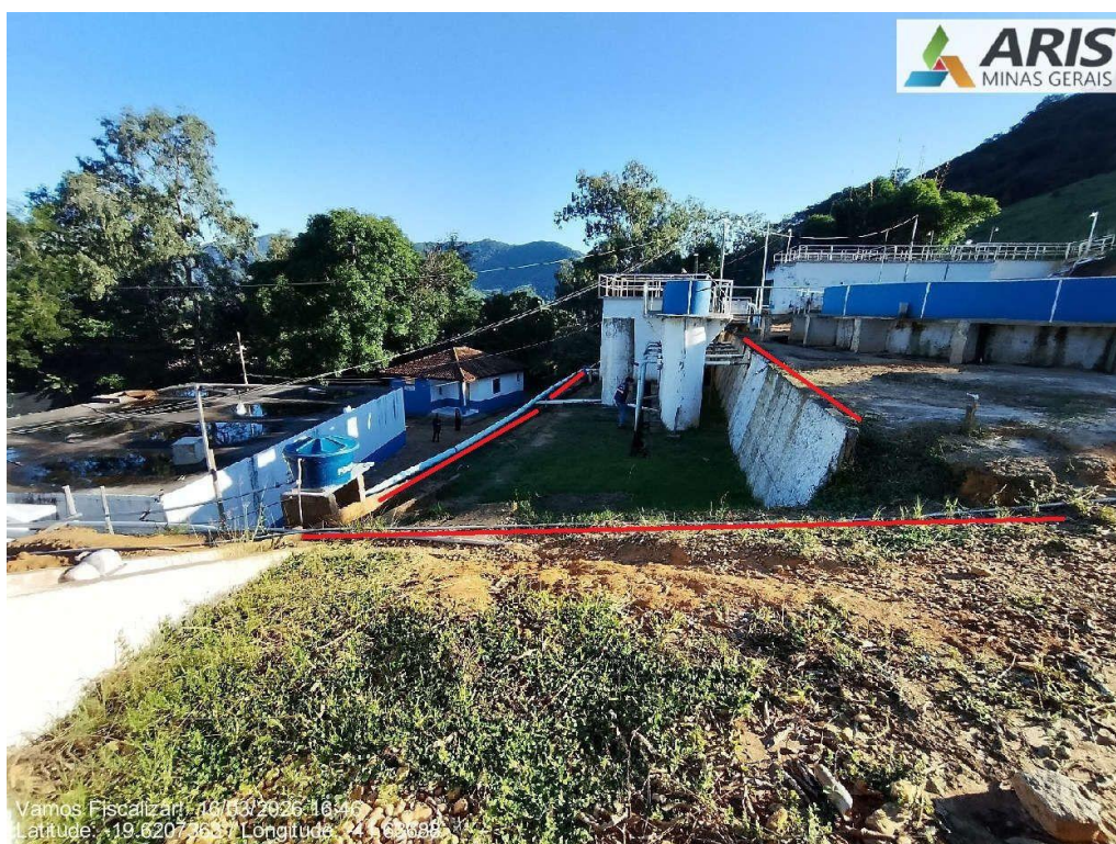
Linha vermelha indica a ausência de guarda corpo
