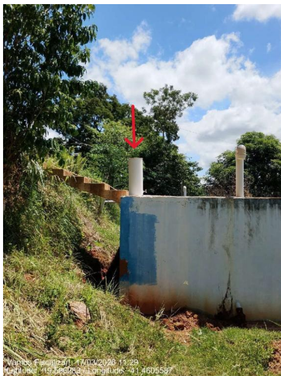
Clorador na cobertura do reservatório
