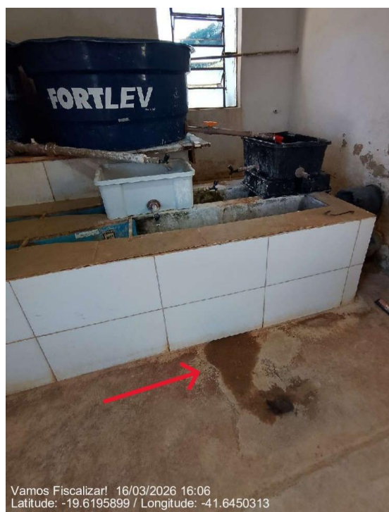
Vazamentos na estrutura de entrada da água bruta
