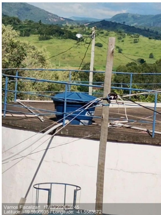
Caixa d'água para abastecimento das unidades da ETA (banheiro, cozinha), localizado em cima do tanque de contato
