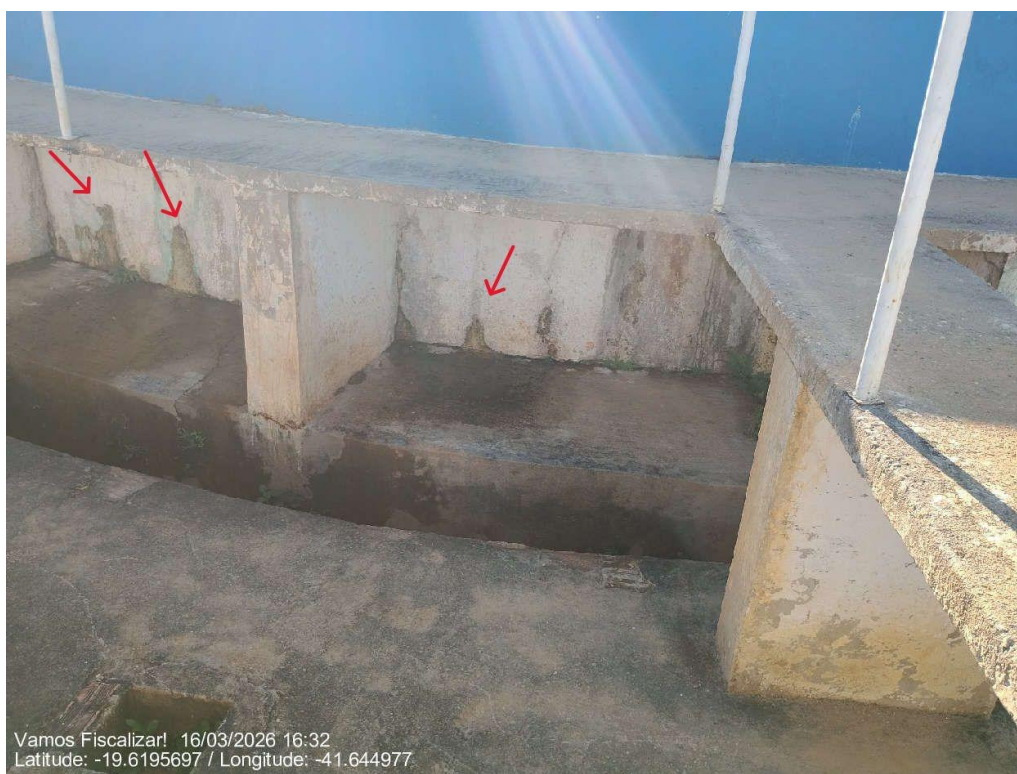
Vazamentos no floculadores/decantador (Circular)
