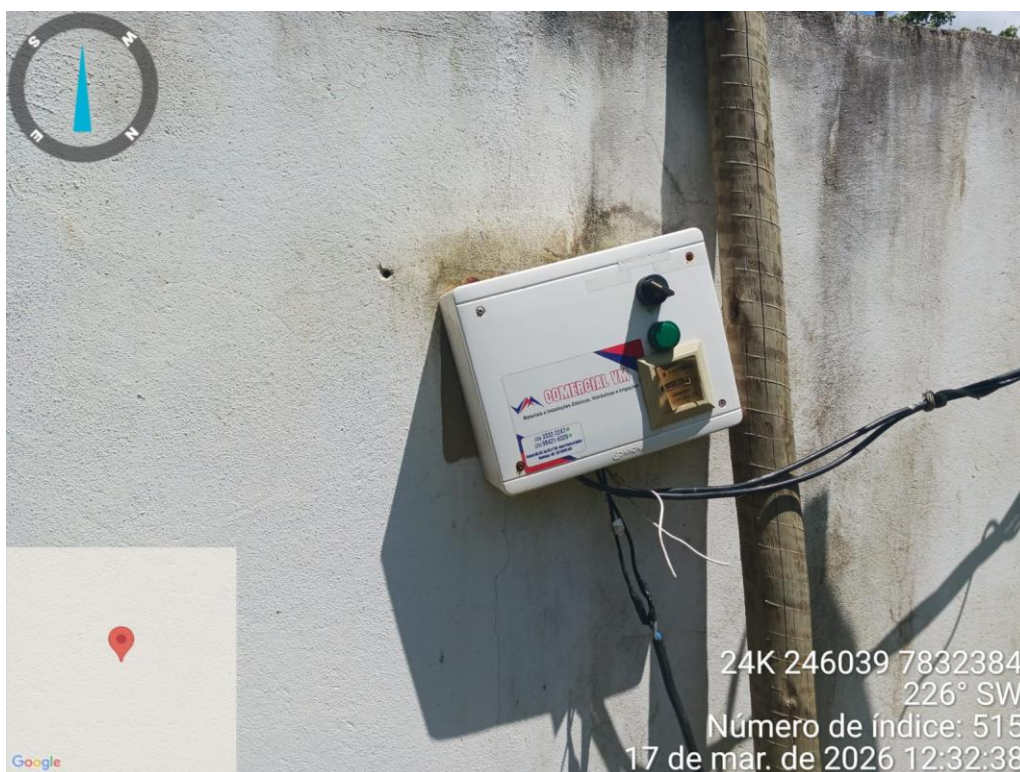
Quadro de acionamento da bomba
