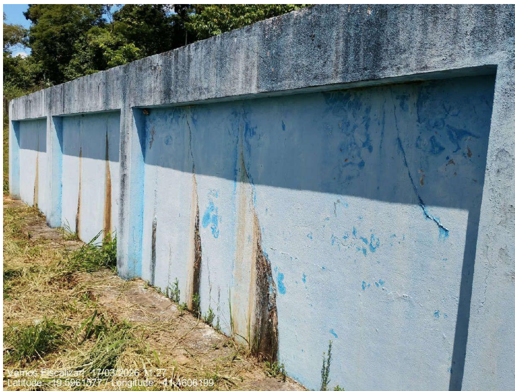
Rachaduras na parede do reservatório e marcas de vazamento
