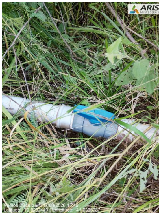
Válvula que conecta as caixas d'água.
