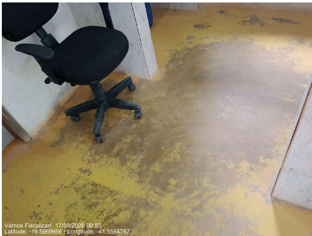
Interior da ETA
