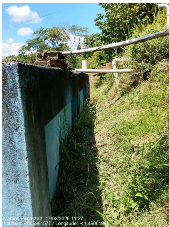
Umidade na parede do reservatório
