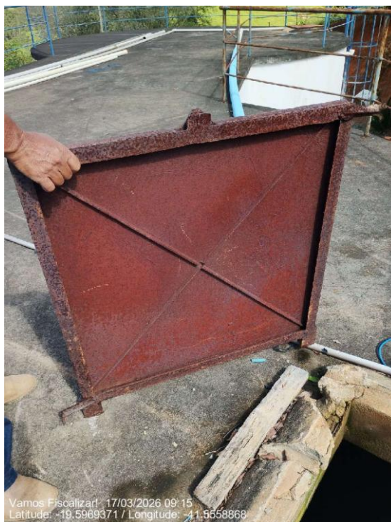
Interior da tampa de inspeção oxidada
