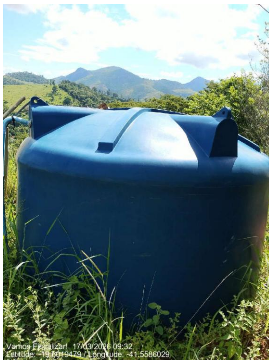
Ausência de tubulação de ventilação.
