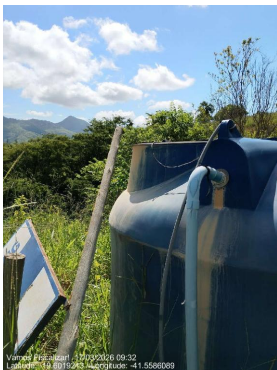
Tampa de inspeção.
