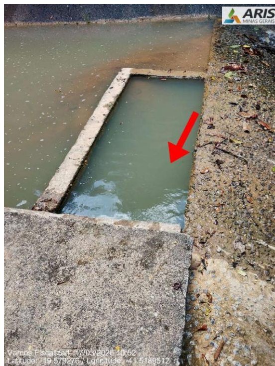
A tubulação perfurada fica localizada na estrutura retangular.
