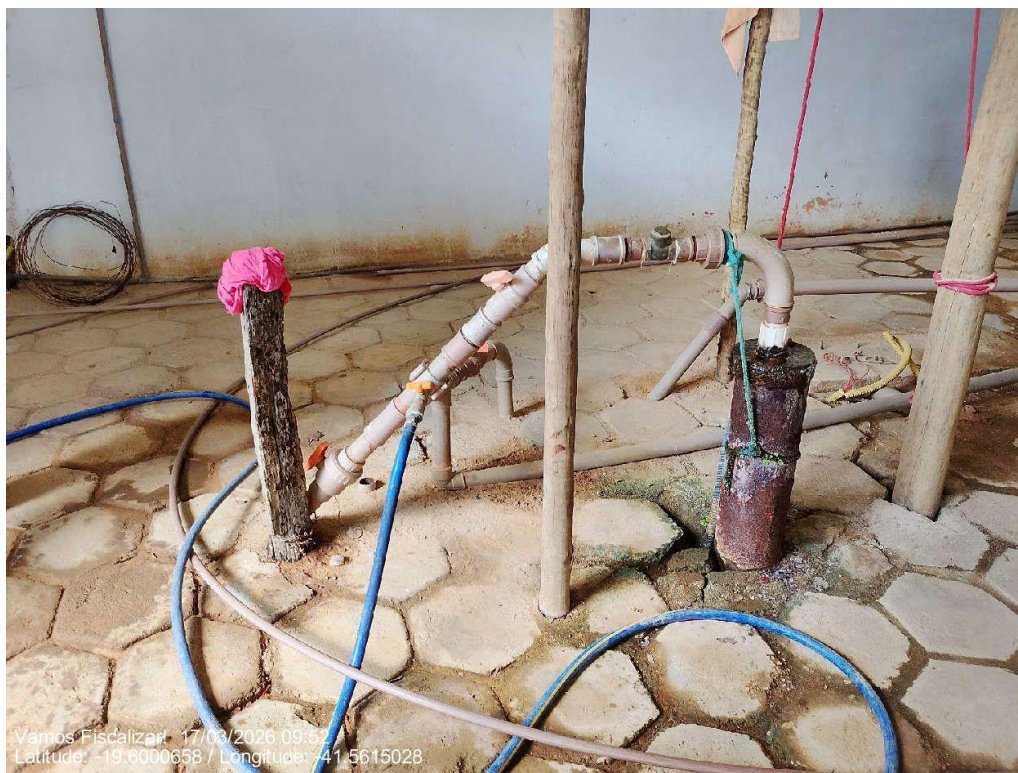
Captação Subterrânea Poço do Campo.
