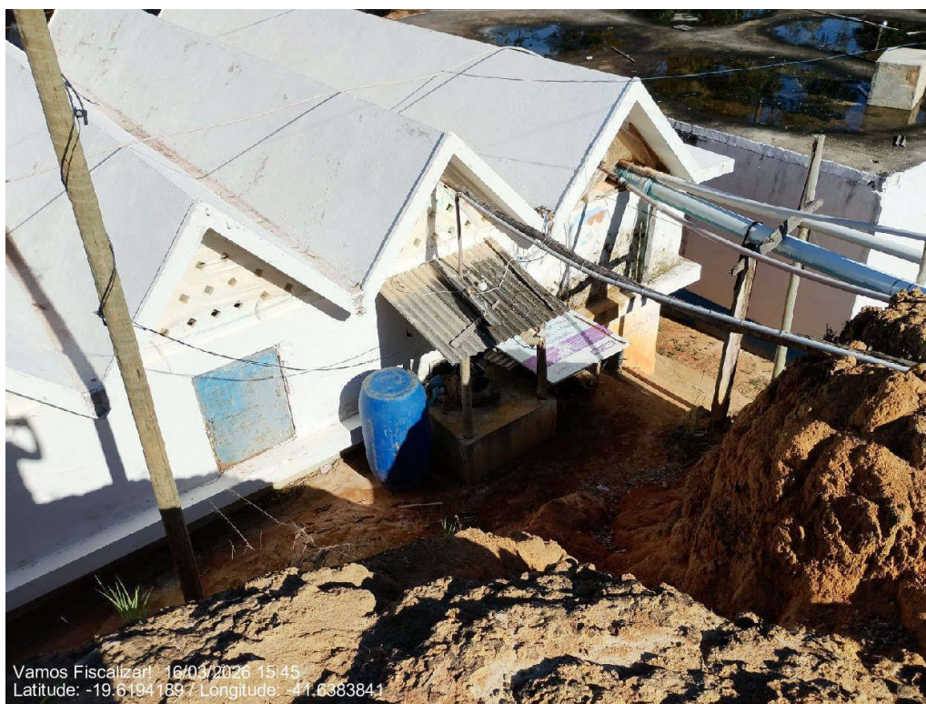
Entrada da água na câmara 1 da estrutura de reservação I.
