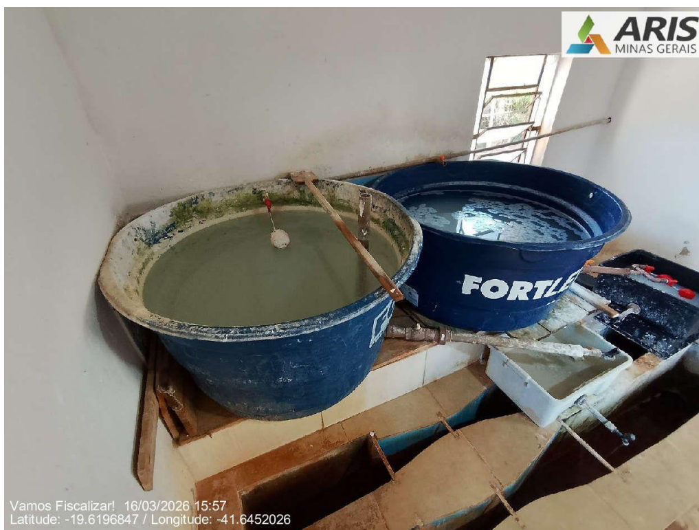
Caixas d'água onde são preparados a solução de CaO e sulfato de alumínio.
