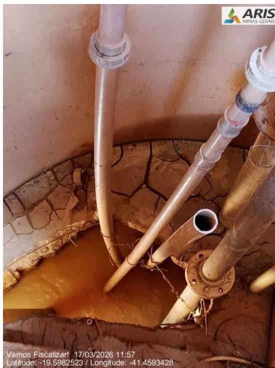
Tubulação de PVC direcionada para o rio
