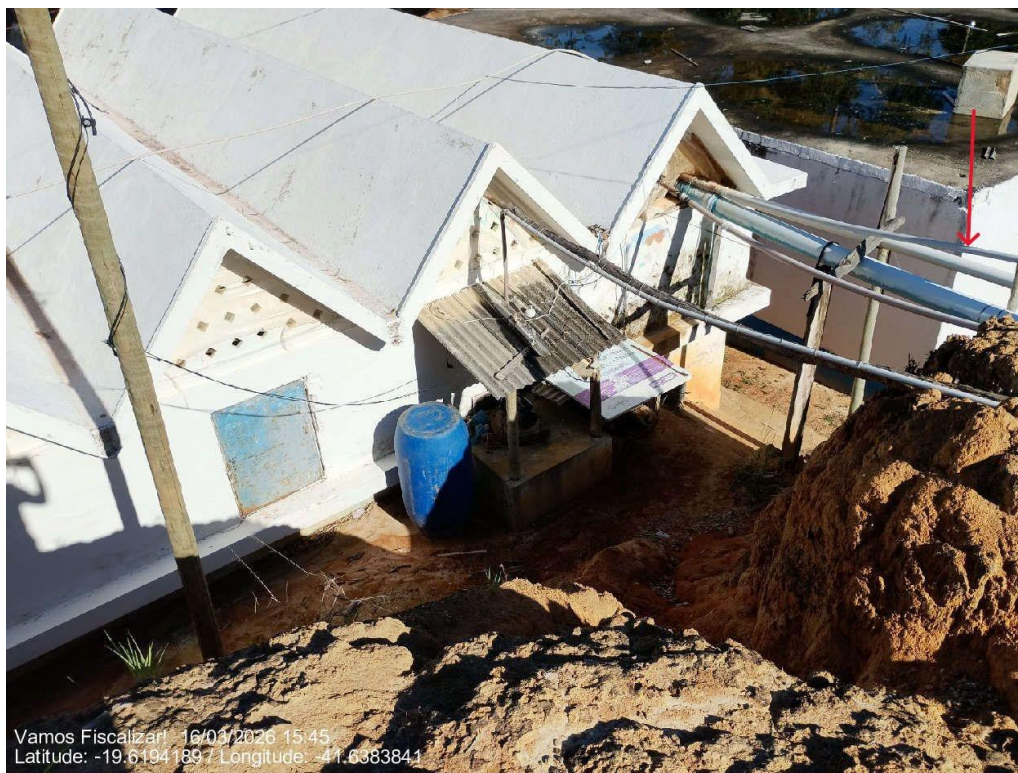
Tubulação de entrada do cloro.
