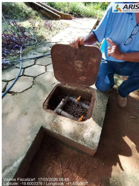
Caixa de registros que direcionam água da captação subterrânea para o filtro 3
