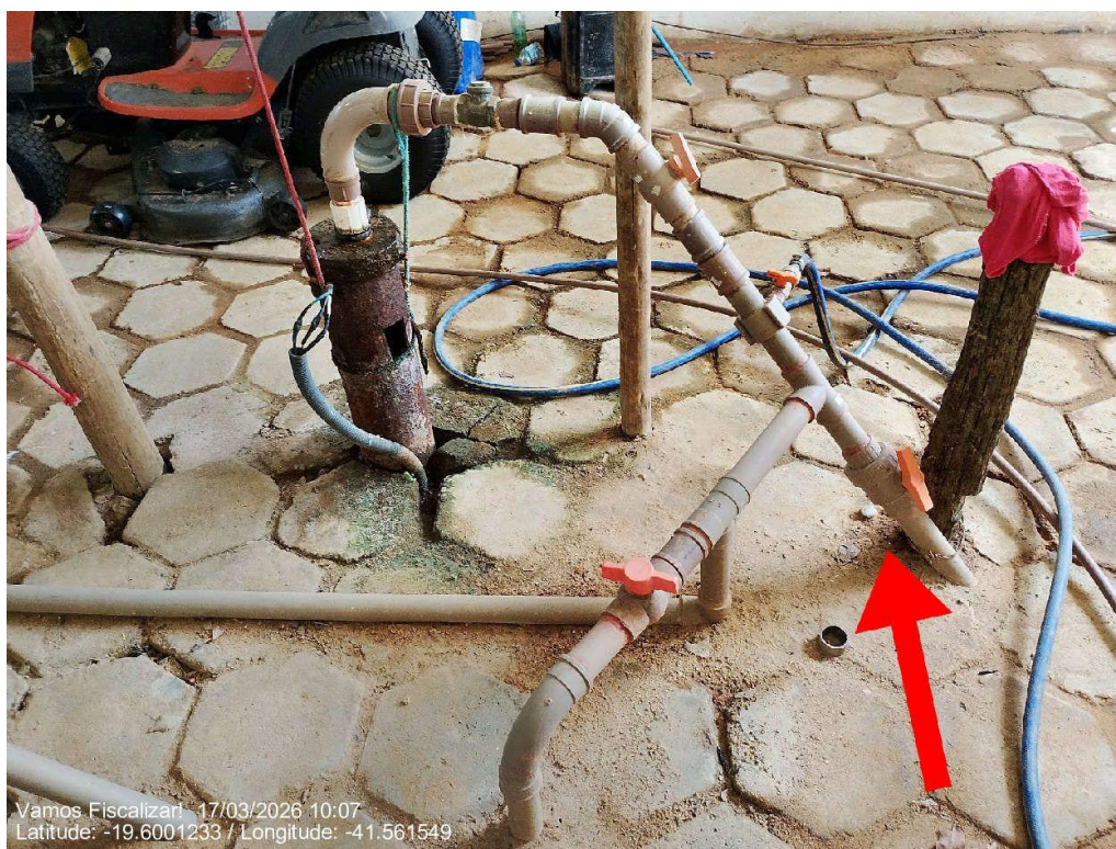
Tubulação que distribui para a ETA.
