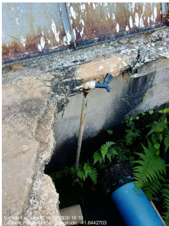
Torneira de coleta de água para análise da água após o Reservatório II.
