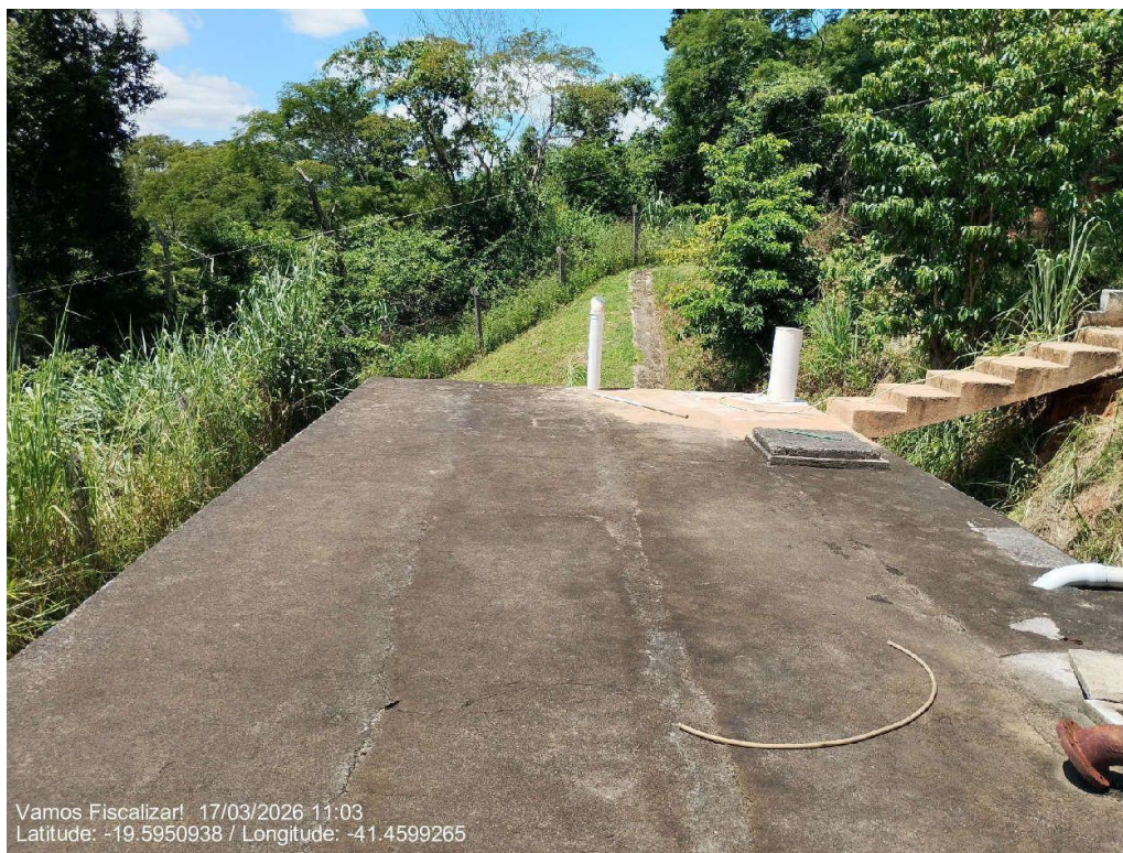
Ausência de guarda-corpo
