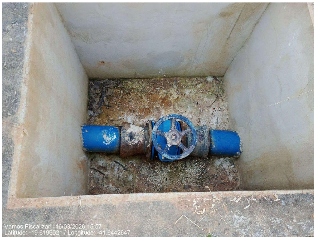
Registro de saída do Reservatório II (para abastecimento da cidade).
