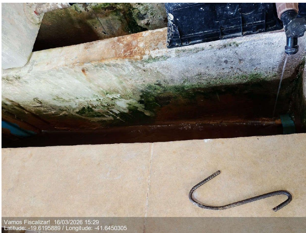
Mofo nas paredes laterais dos canais de entrada da água bruta
