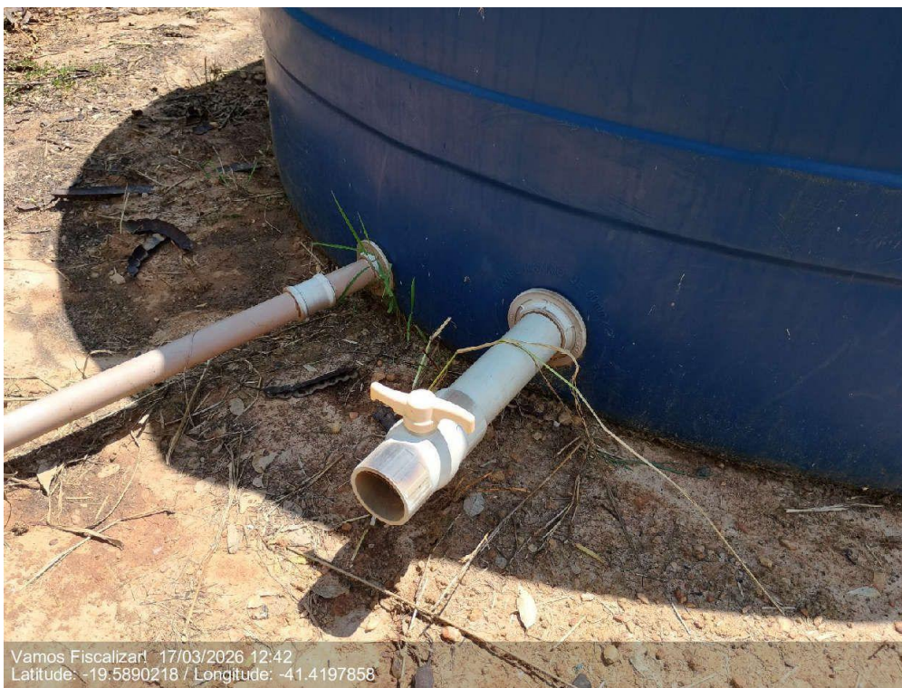
Descarga de fundo.
