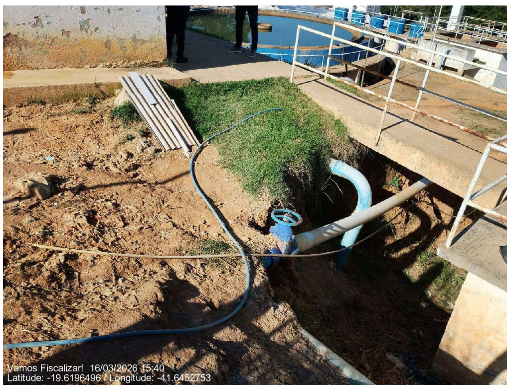
Registro da tubulação de água bruta sobra
