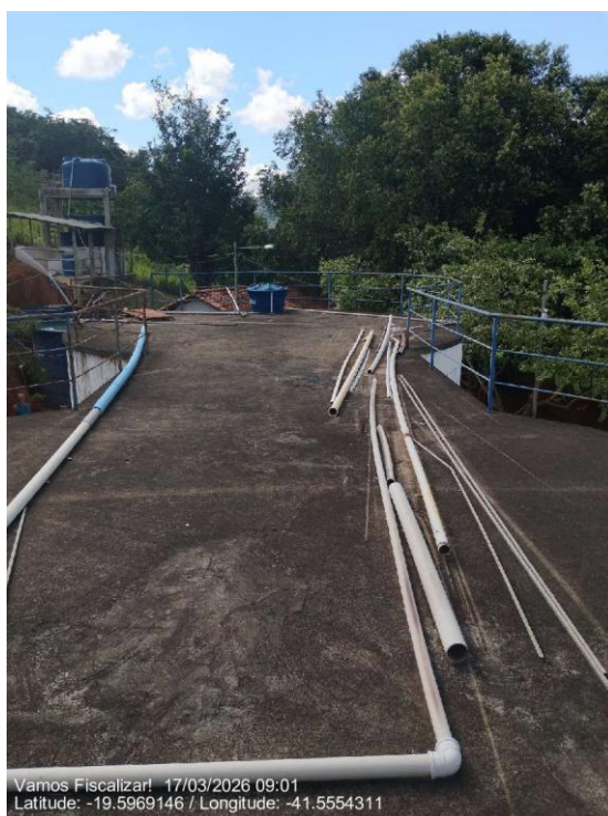
Cobertura da segunda câmara do tanque de contato com presença de várias tubulações
