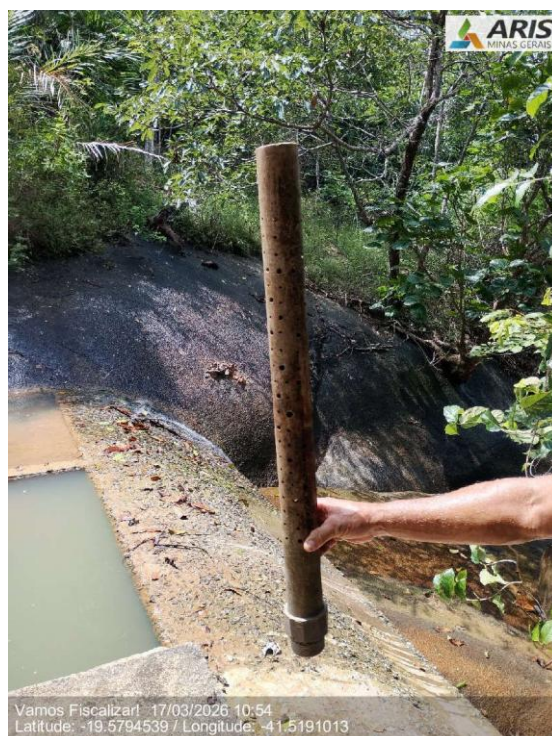
Tubulação perfurada idêntica à que está atualmente instalada.
