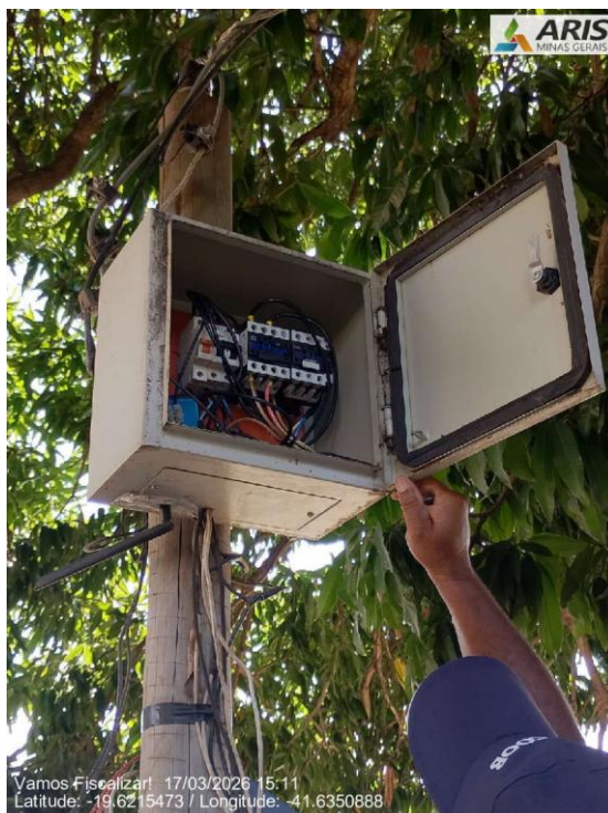
Quadro de comando aberto
