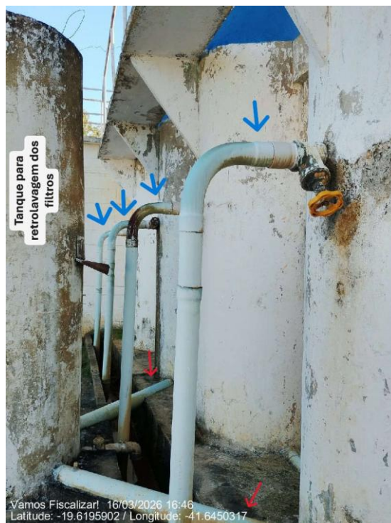
Tubulações de descarte da retrolavagem (setas azuis) e tubulações de saída da água filtrada (setas vermelhas) (Circular)
