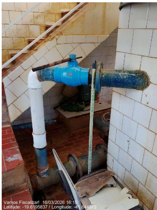
Válvula de fechamento entre as câmaras 1 e 2 da estrutura de reservação I.
