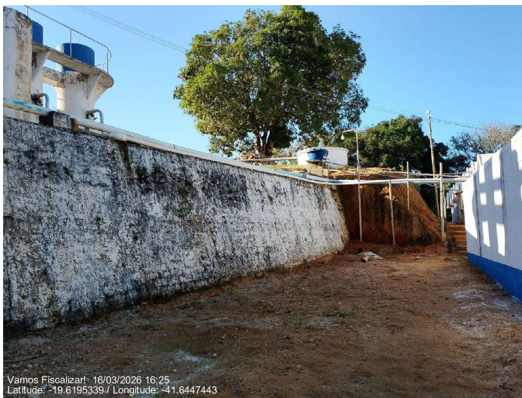
Tubulação de entrada na estrutura de reservação I.
