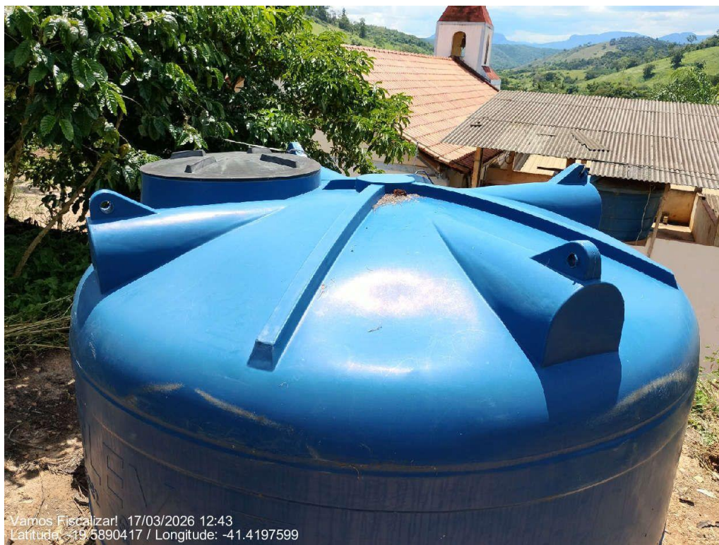
Ausência de tubulação de ventilação.
