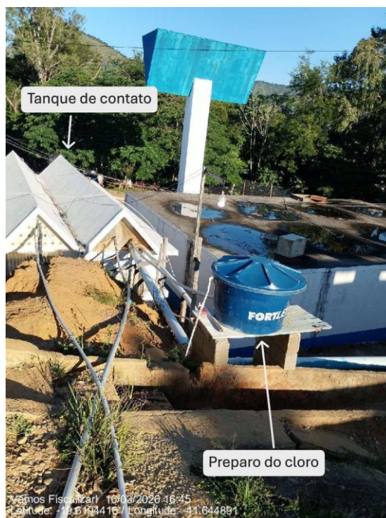
Tanque de contato e preparo do cloro
