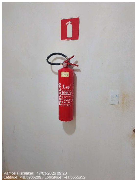
Extintor no laboratório físico-químico
