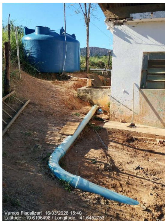
Tubulação de chegada da água bruta
