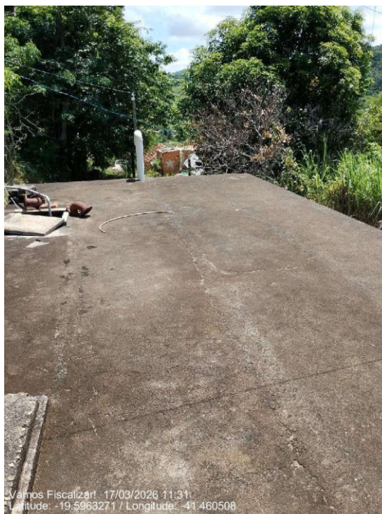
Cobertura do reservatório
