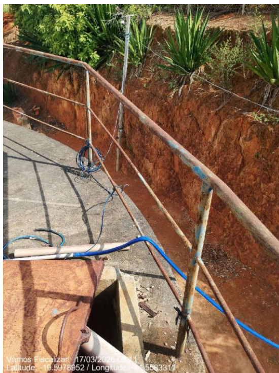
Guarda-corpo do tanque de contato com parte oxidadas
