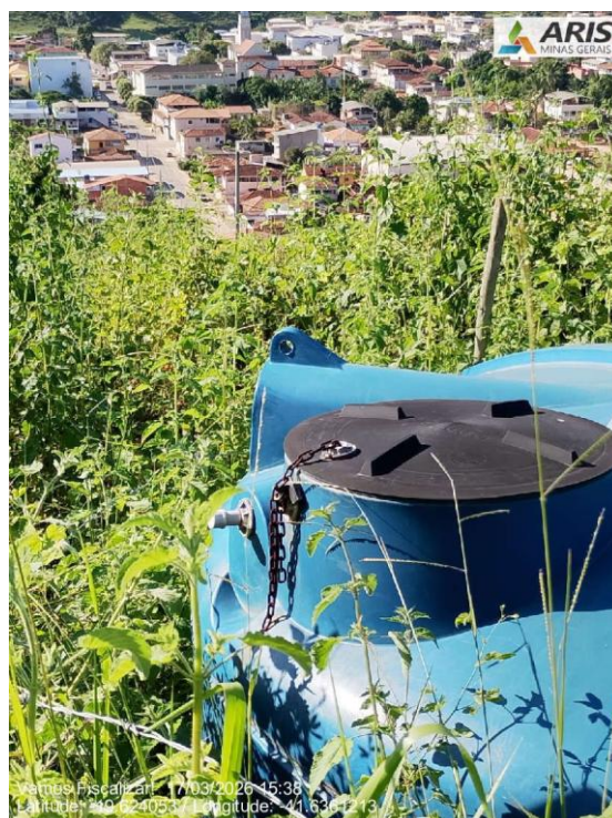
Tampa trancada com reservatório 02 (10 m 3 )
