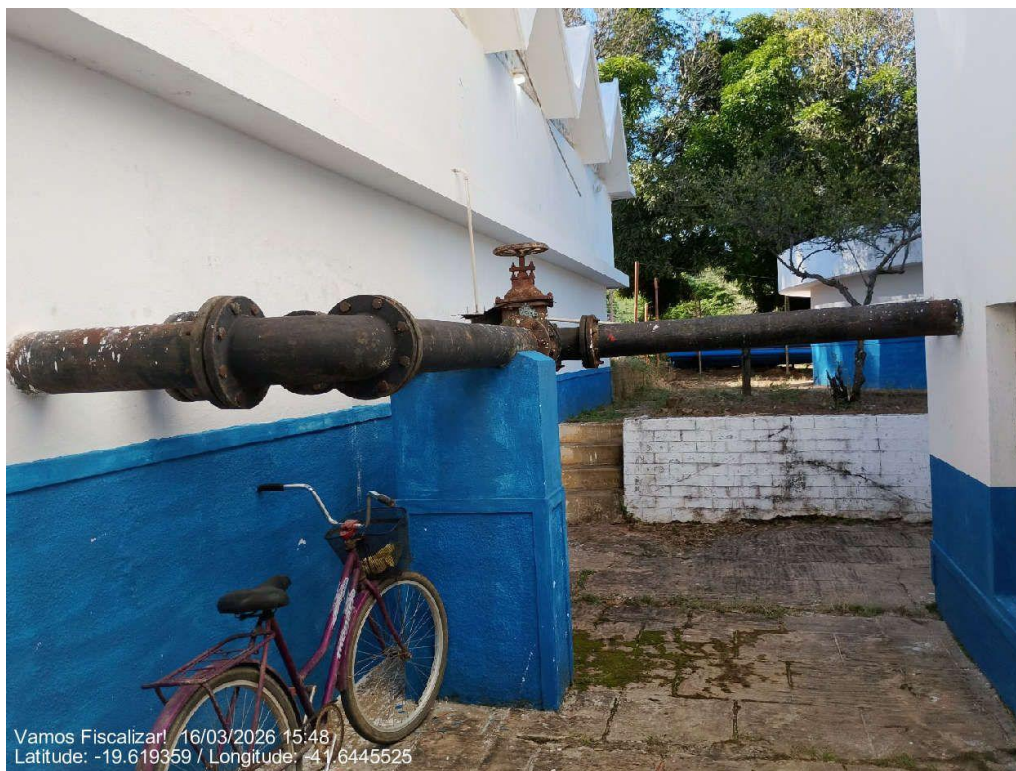
Saída da estrutura de reservação I.
