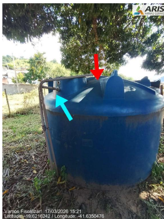
Chegada da água (seta azul) e recalque (seta vermelha) para o reservatório São Matheus
