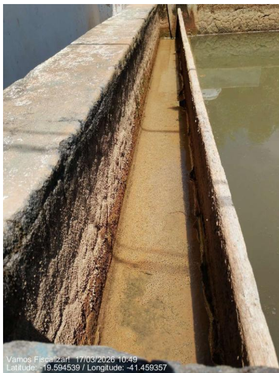
Saída do decantador com flocos visíveis
