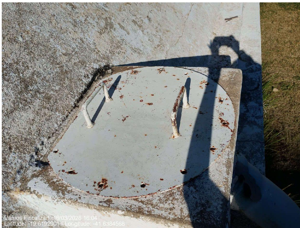
Tampa de inspeção do Reservatório II com início de oxidação..
