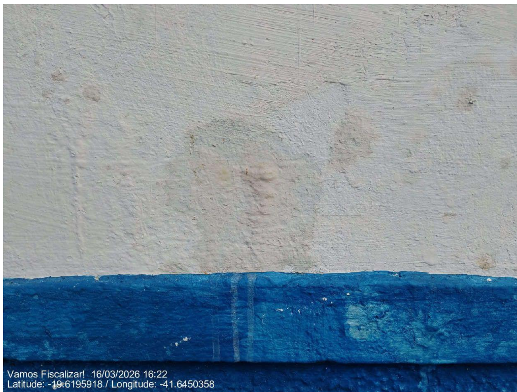
Infiltração por pressão positiva.
