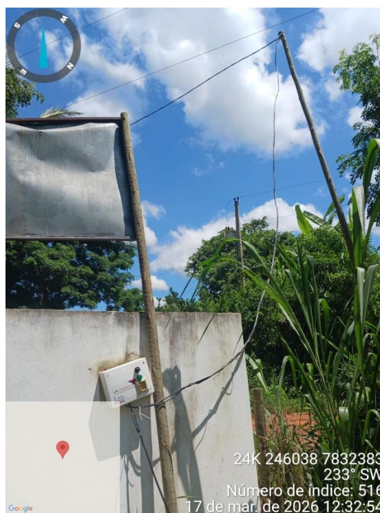
Quadro de acionamento da bomba e alimentação na rede de energia elétrica
