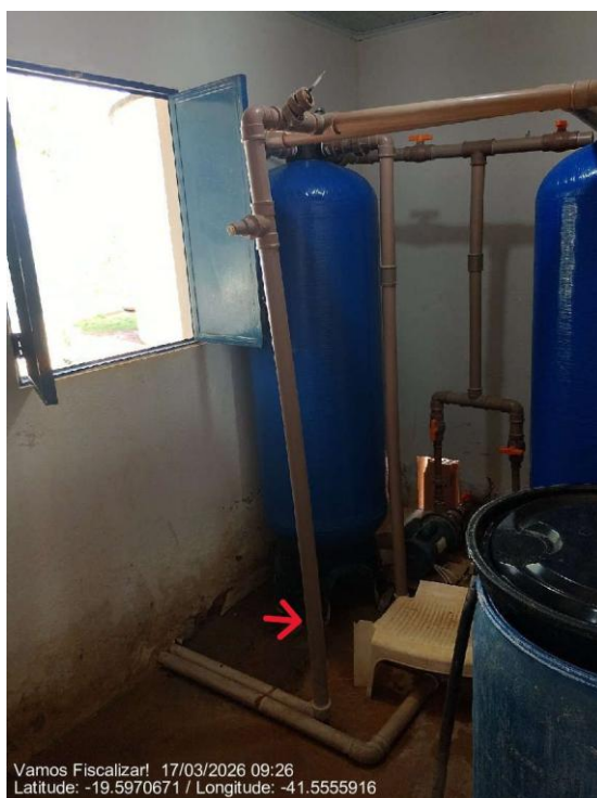
Tubulação de saída dos filtros sem torneira para coleta de água
