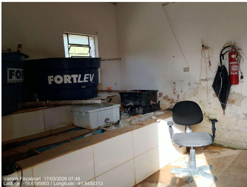
Área de dosagem do sulfato de alumínio e cal da ETA
