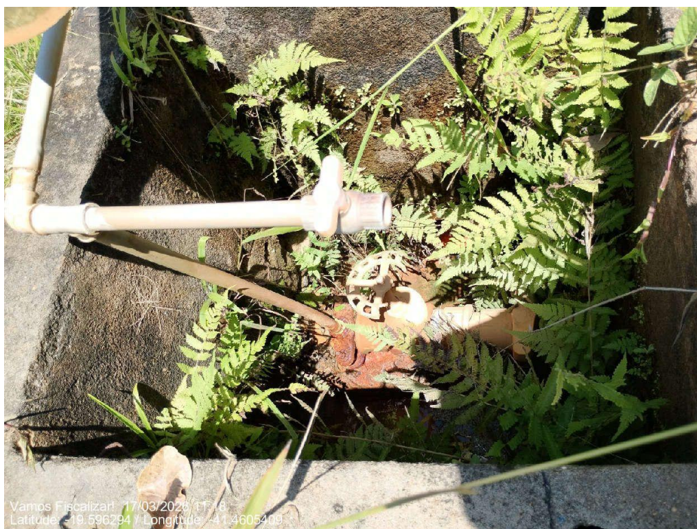
Caixa de registro da tubulação de saída do reservatório
