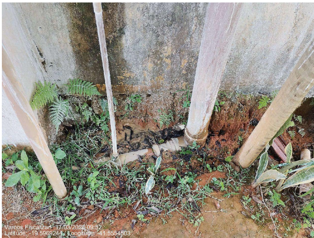
Vazamento na tubulação de saída do filtro 3
