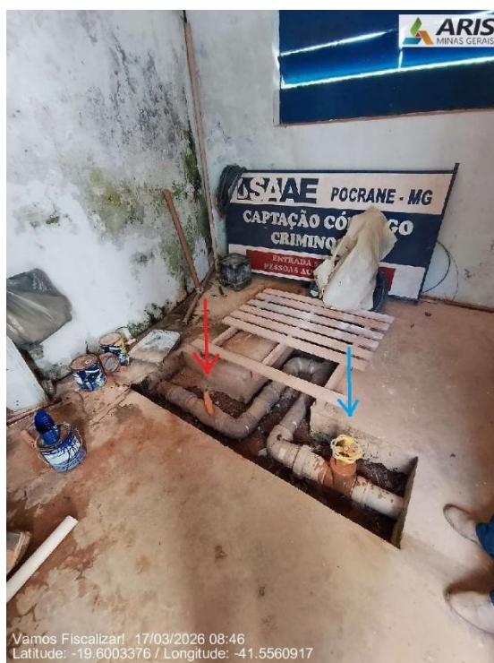
Registros de saída do tanque de contato: seta vermelha indica registro da câmara 1 e seta azul indica registro da câmara 2
