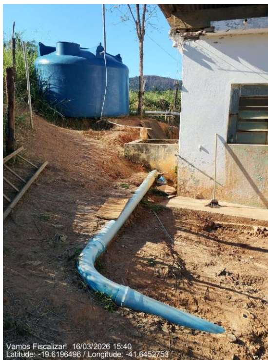
Tubulação por onde chega água bruta.
