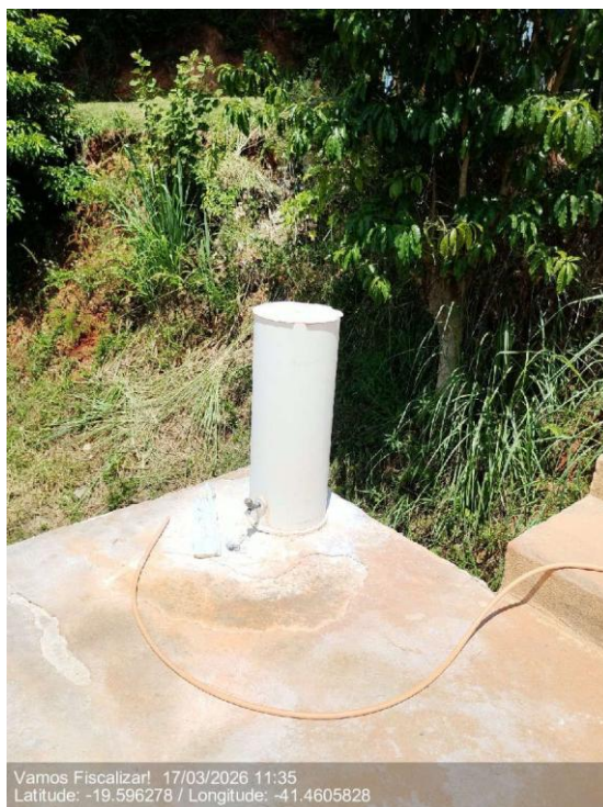
Preparo e dosagem de cloro no Reservatório Assaraí
