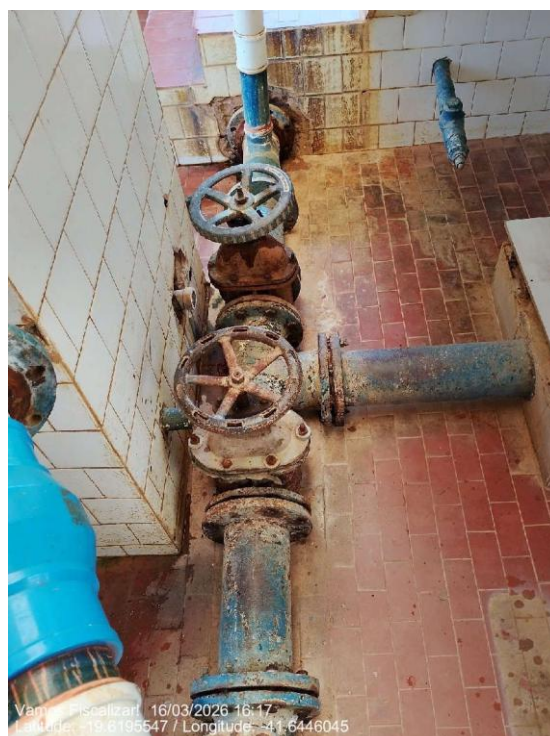
Registro da descarga de fundo.
