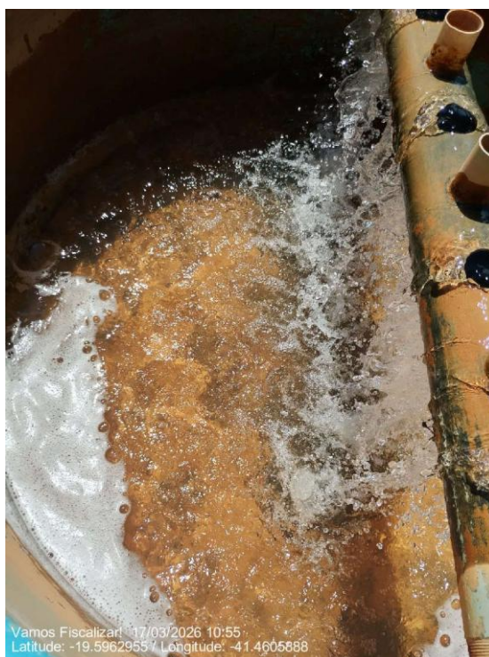
Ausência de flocos no filtro, mas presença de espuma.
