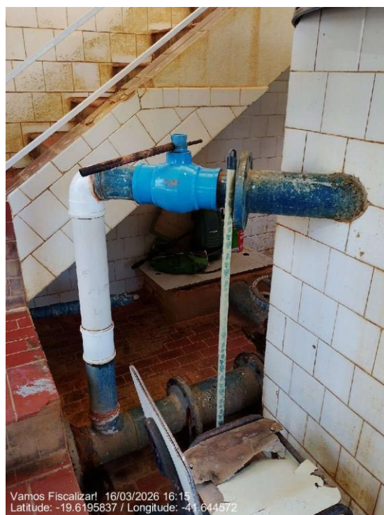
Válvula de fechamento entre o tanque de contato da ETA e o reservatório
