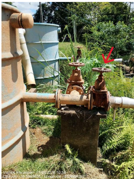
Destaque para o registro de saída do filtro em operação
