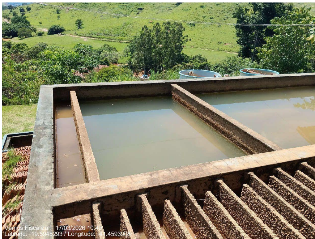
Entrada da água nos decantadores
