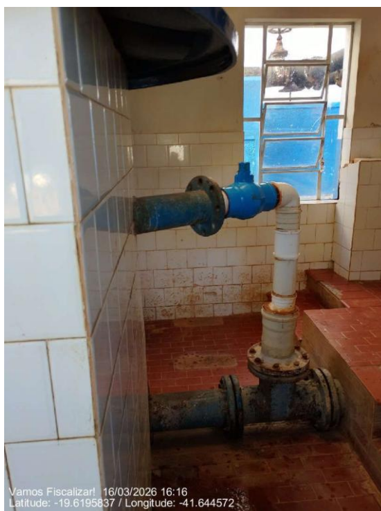
Registro de saída da estrutura de reservação I e de entrada do Reservatório II (interliga os reservatórios).
