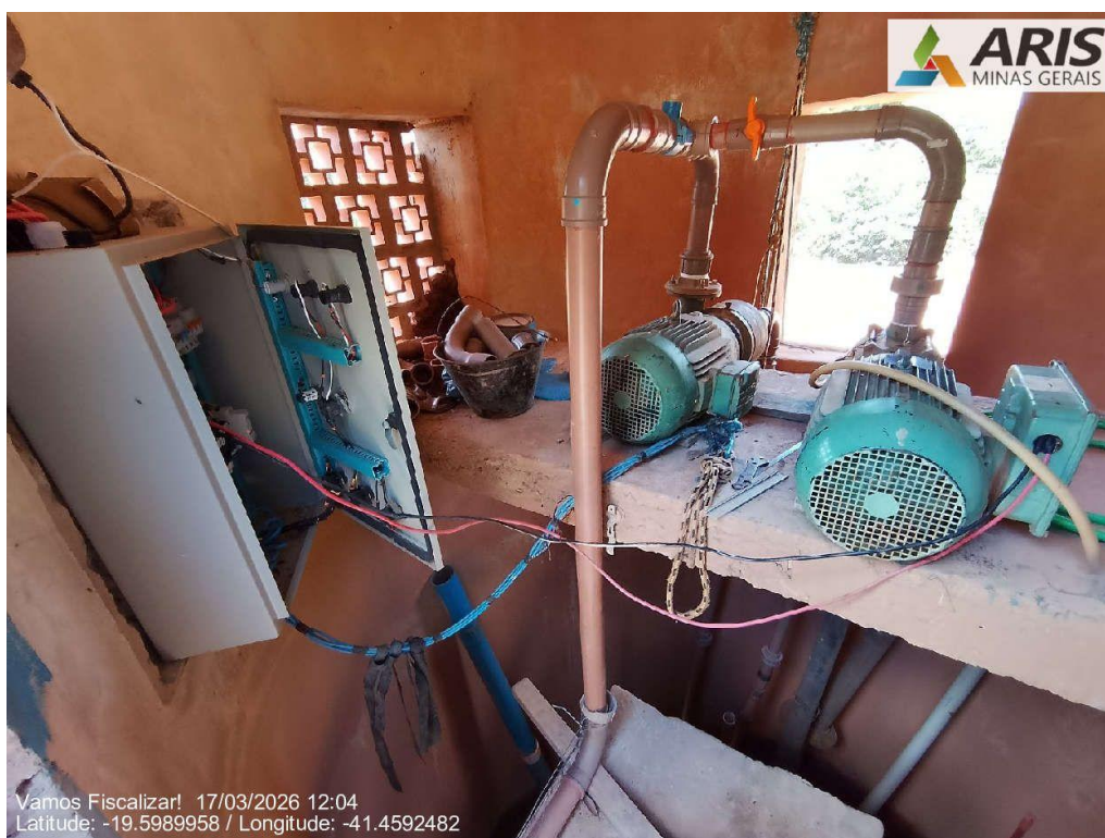
Ligação elétrica das bombas é feita de forma direta.
