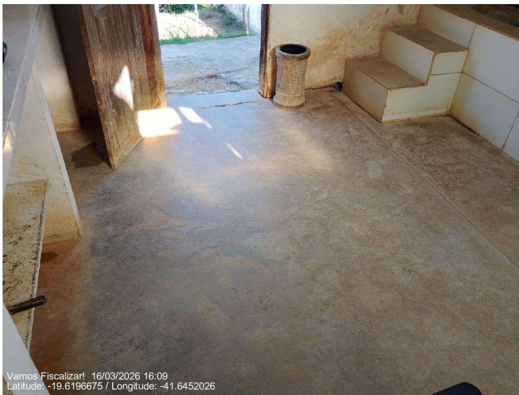
Área de preparo e dosagem dos produtos químicos
