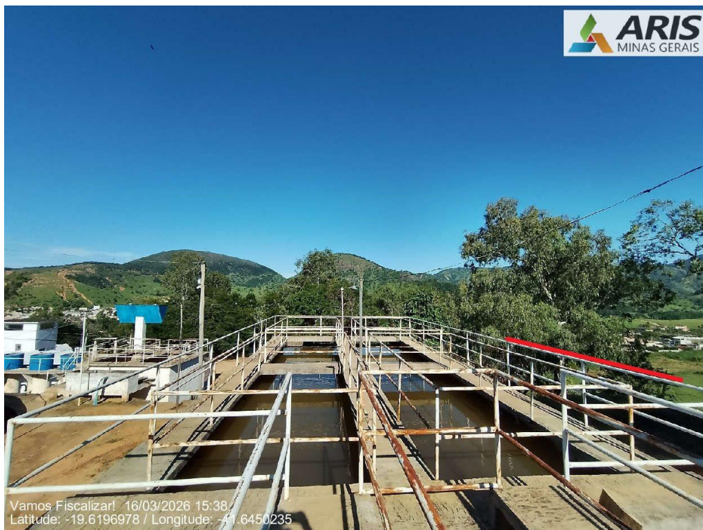
Linha vermelha indica guarda-corpo necessitando manutenção (frouxo)
