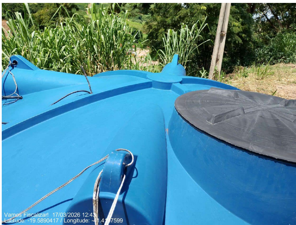
Ausência de tubulação de ventilação.
