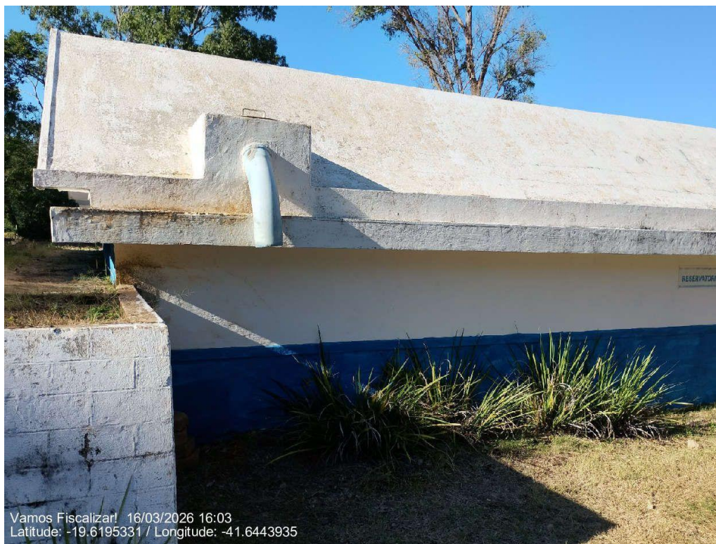
Extravasar do Reservatório II.
