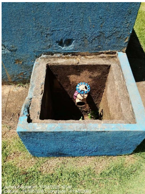
Caixa de registro de descarga de fundo dos floculadores
