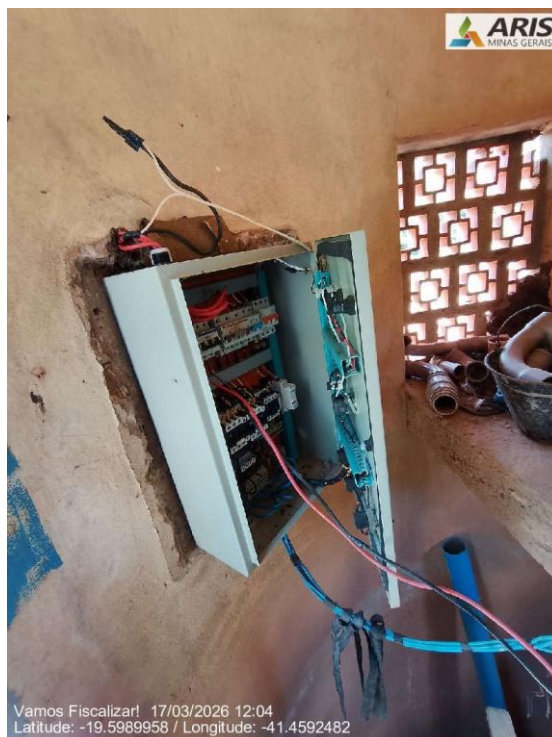
O painel de controle aberto.
