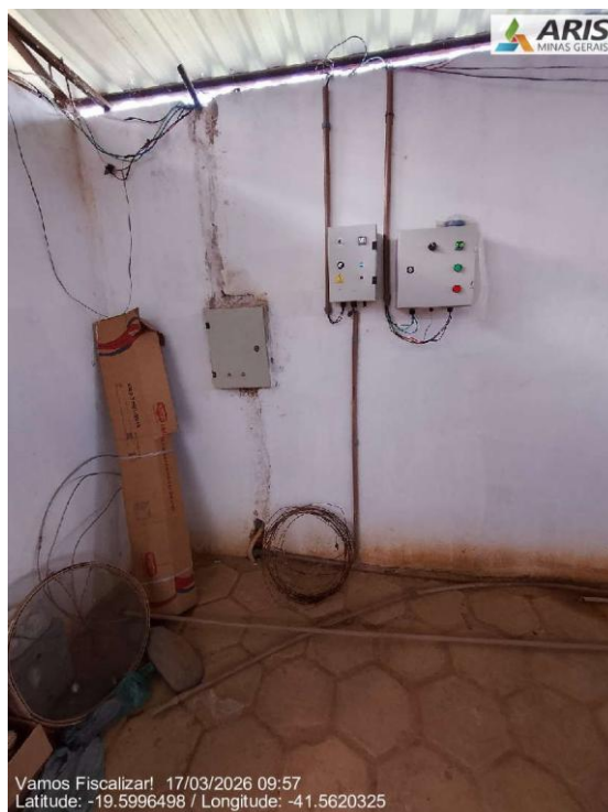
Caixa estão à cima da cota de inundação.
