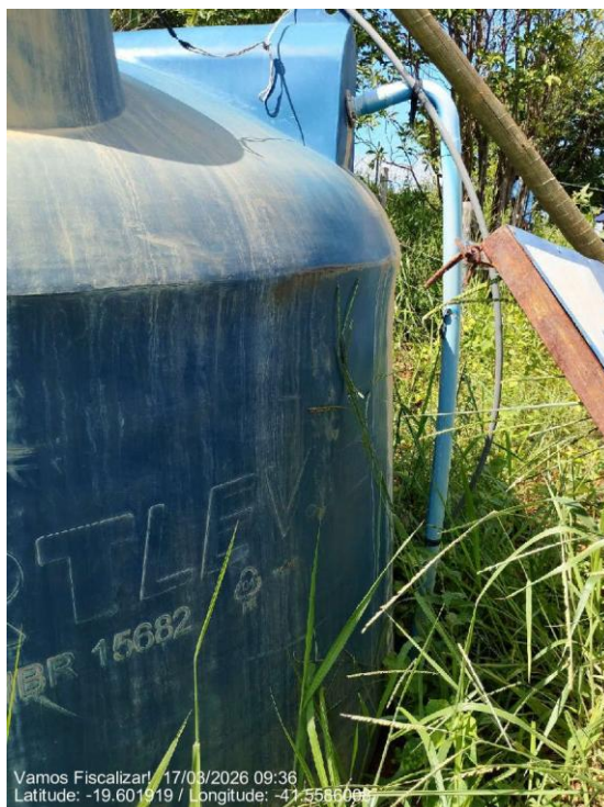
Ausência de controle e medição de vazão na entrada.
