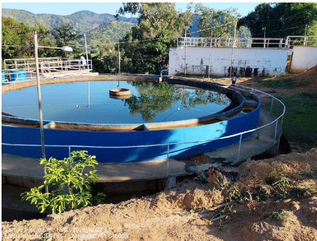
Guarda-corpo no decantador circular (vãos muito espaçados entre si)
