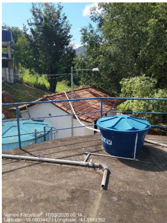
Caixa d'água para abastecimento das unidades da ETA (banheiro, cozinha)
