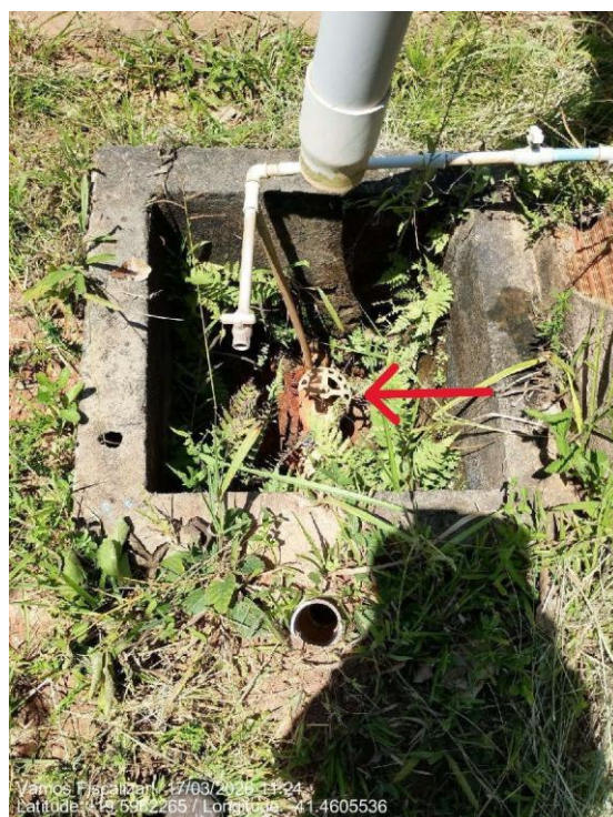
Registro na tubulação de saída
