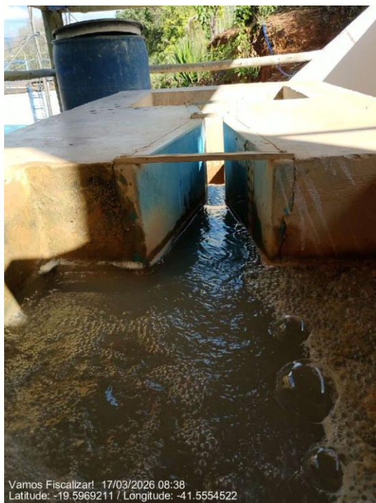
Medidor de vazão na entrada do tratamento
