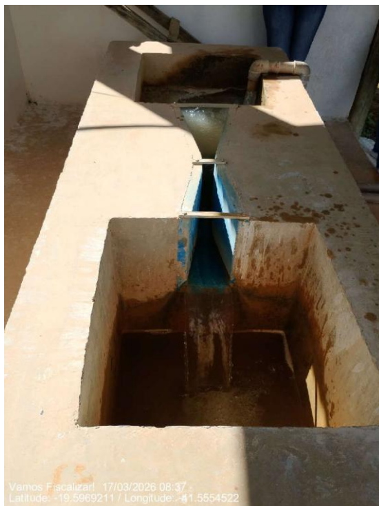
Medidor de vazão na entrada do tratamento
