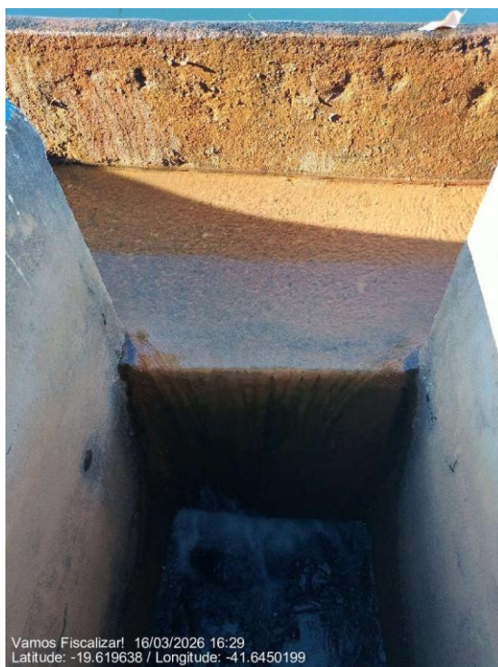
Saída do decantador para os filtros (Circular)
