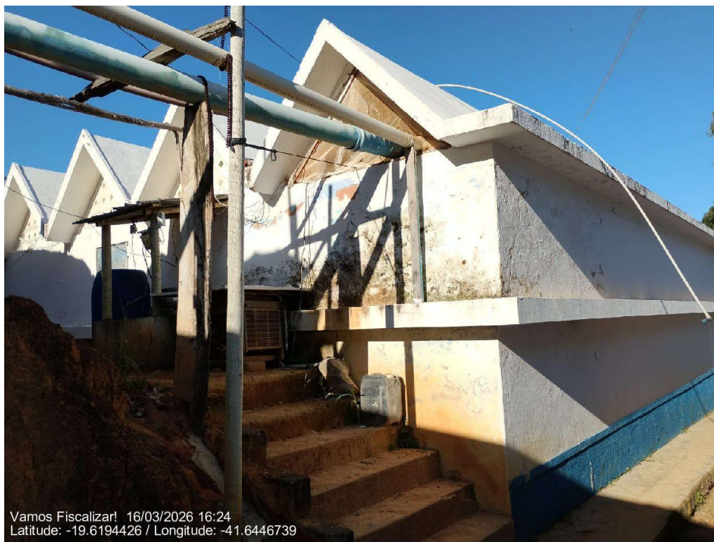
Infiltração na entrada da câmara 1 da estrutura de reservação I.
