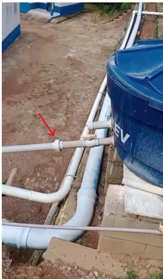
Tubulação de aplicação do cloro no tanque de contato
