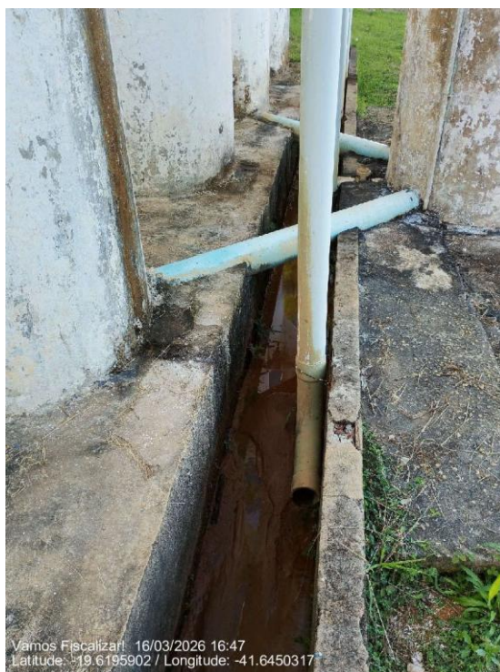
Sedimentos no canal de drenagem das águas da retrolavagem dos filtros (Circular)
