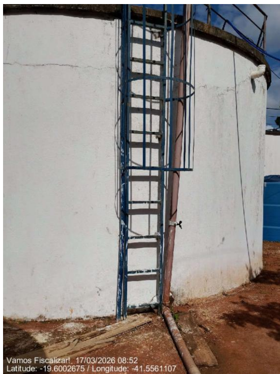
Tubulação de saída do filtro e abastecimento do tanque de contato
