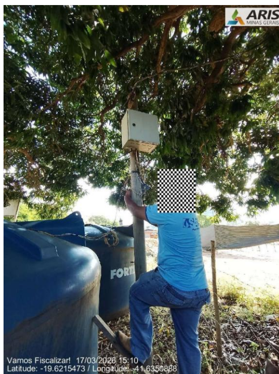
Ausência de escadas no local para acesso seguro do operador ao quadro.
