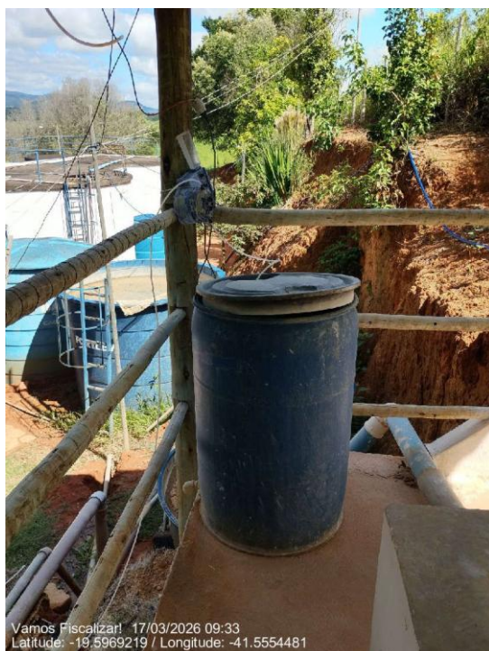
Preparo e dosagem do cloro
