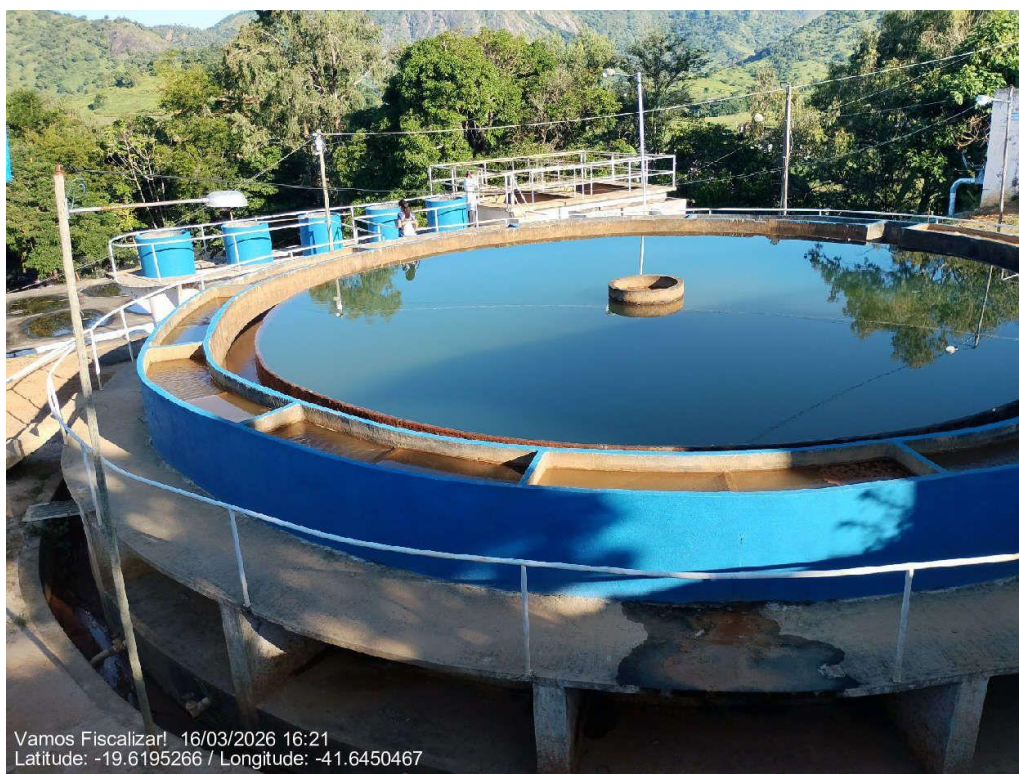
Floculadores no entorno do decantador
