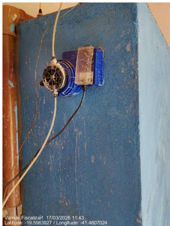
Bomba dosadora do sulfato de alumínio
