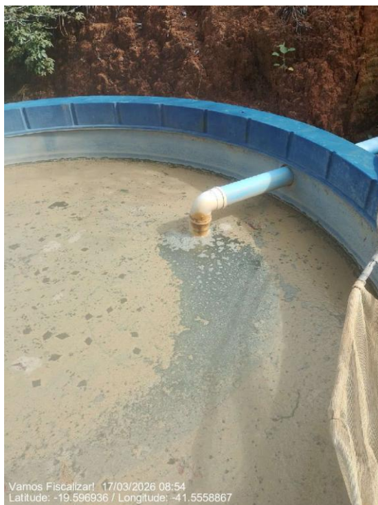
Tubulação de entrada no decantador
