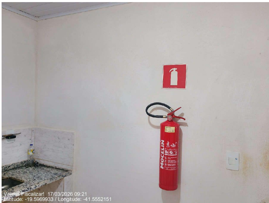
Extintor no laboratório físico-químico
