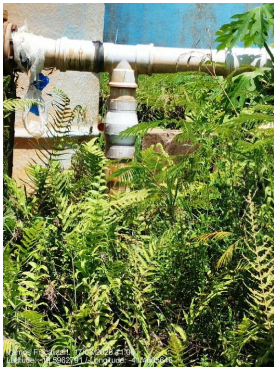
Pequenos vazamentos na tubulação de saída do filtro
