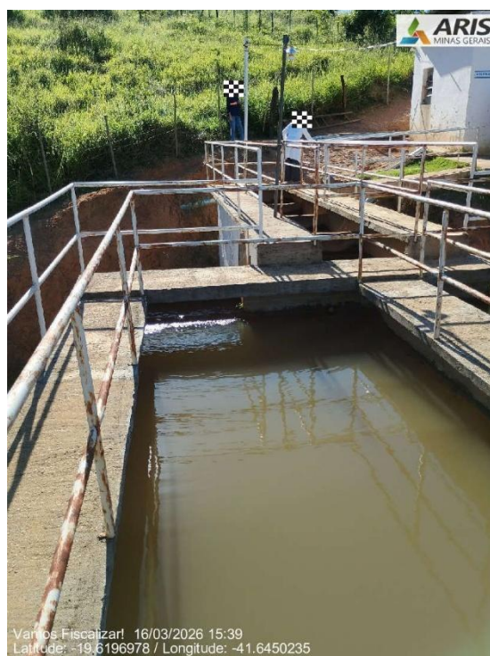
Câmara 01 do decantador, e ao fundo o floculador (Retangular)
