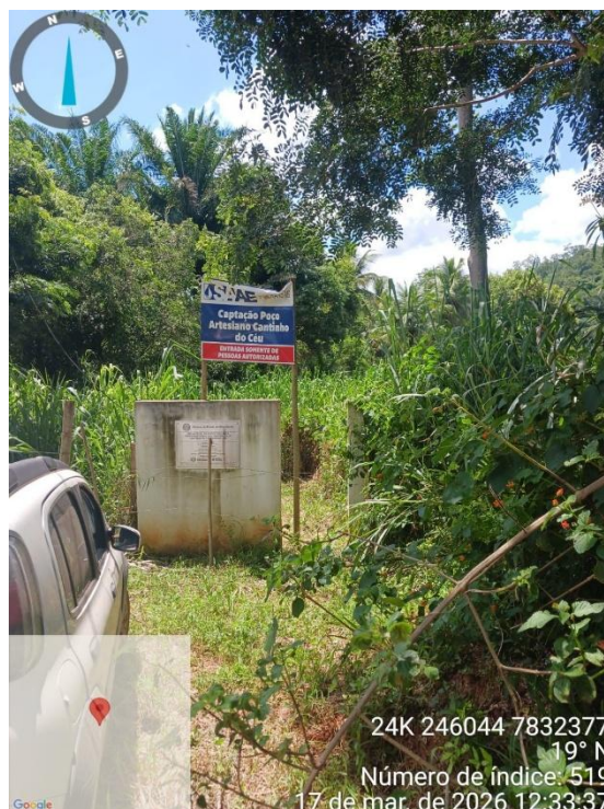
Captação Subterrânea Cantinho do Céu - Vista geral da captação subterrânea (frente/entrada)
