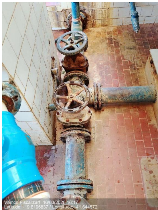
Registro da caixa de descarga.
