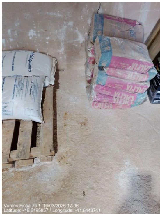
Produtos estocados em paletes sem indícios de vazamentos no chão
