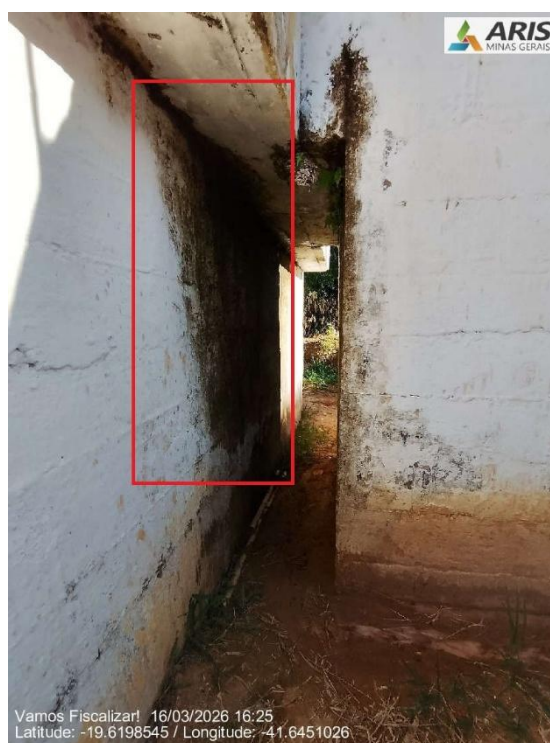
Trecho entre o decantador (esquerda) e floculador (direita) (retangular)
