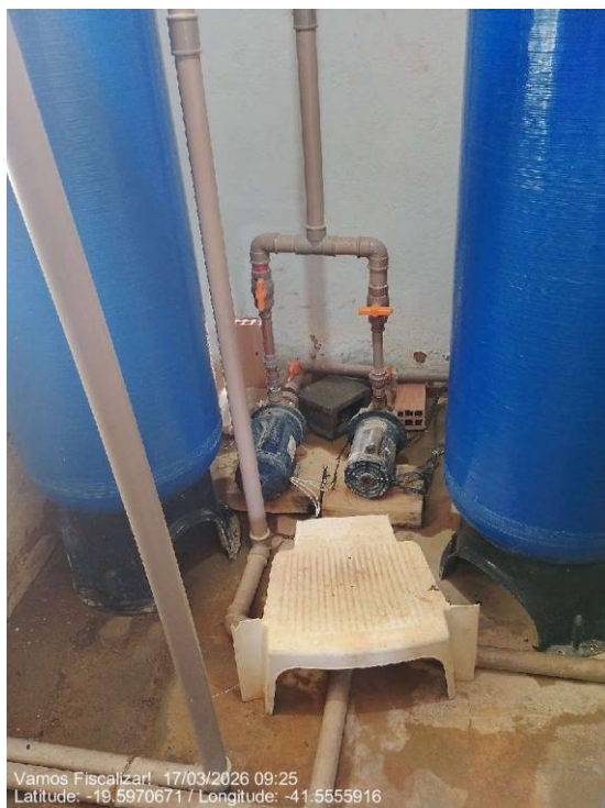
Conjuntos motobombas dos filtros pressurizados
