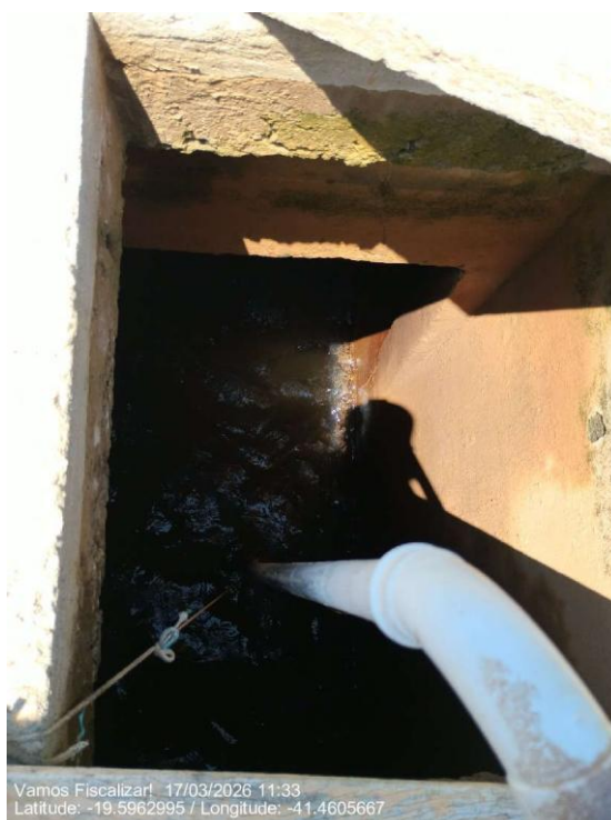
Ausência de indicador de nível
