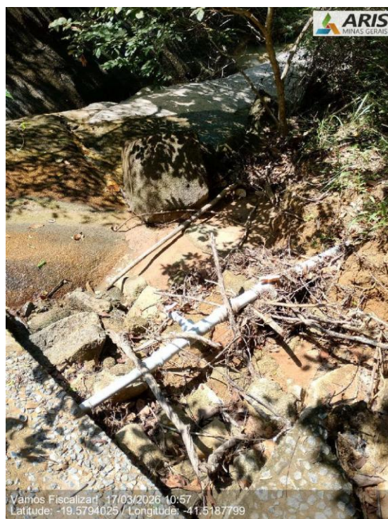
Tubulação que transporta a água para a ETA Barra da Figueira
