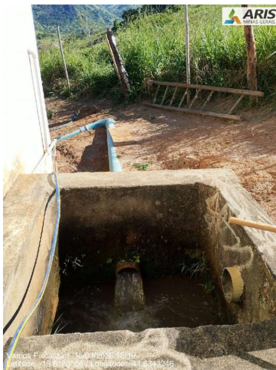
Entrada de água bruta no sistema de tratamento.
