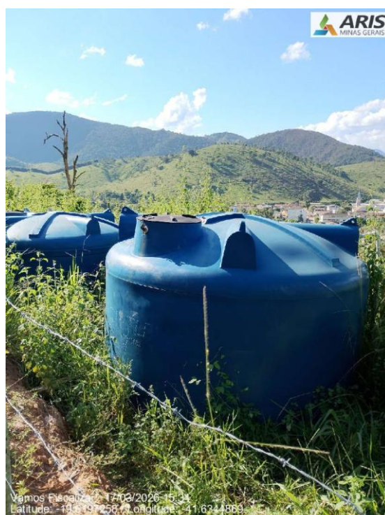
Reservatório composto por duas caixas d'água interligadas.
