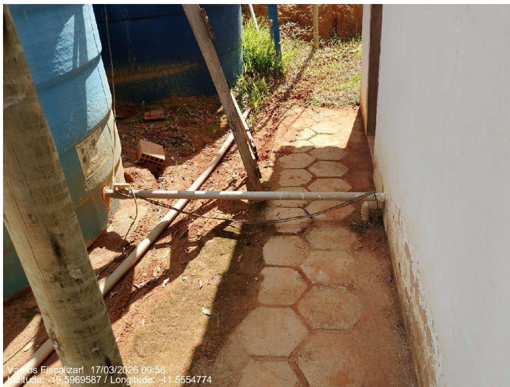
Tubulação de entrada nos filtros pressurizados
