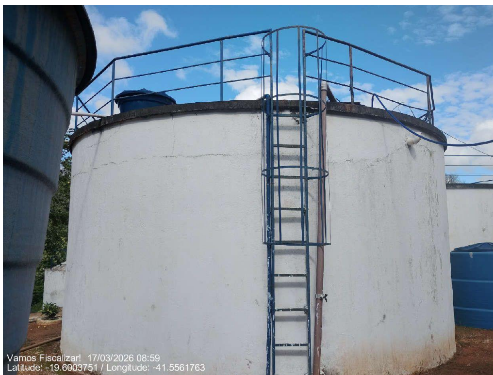
Tanque de contato e tubulação de abastecimento com água clorada
