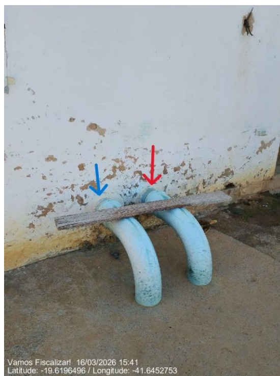
Tubulações de saída para o tratamento físico circular (seta vermelha) e retangular (seta azul)
