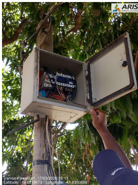
Painel controlador aberto e em bom estado de uso e operação.
