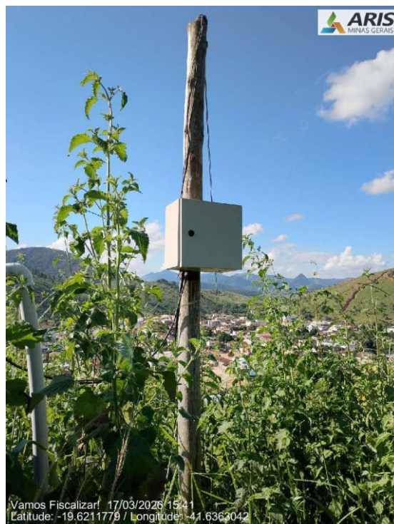
Painel de controle e acionamento da água da EEAT.
