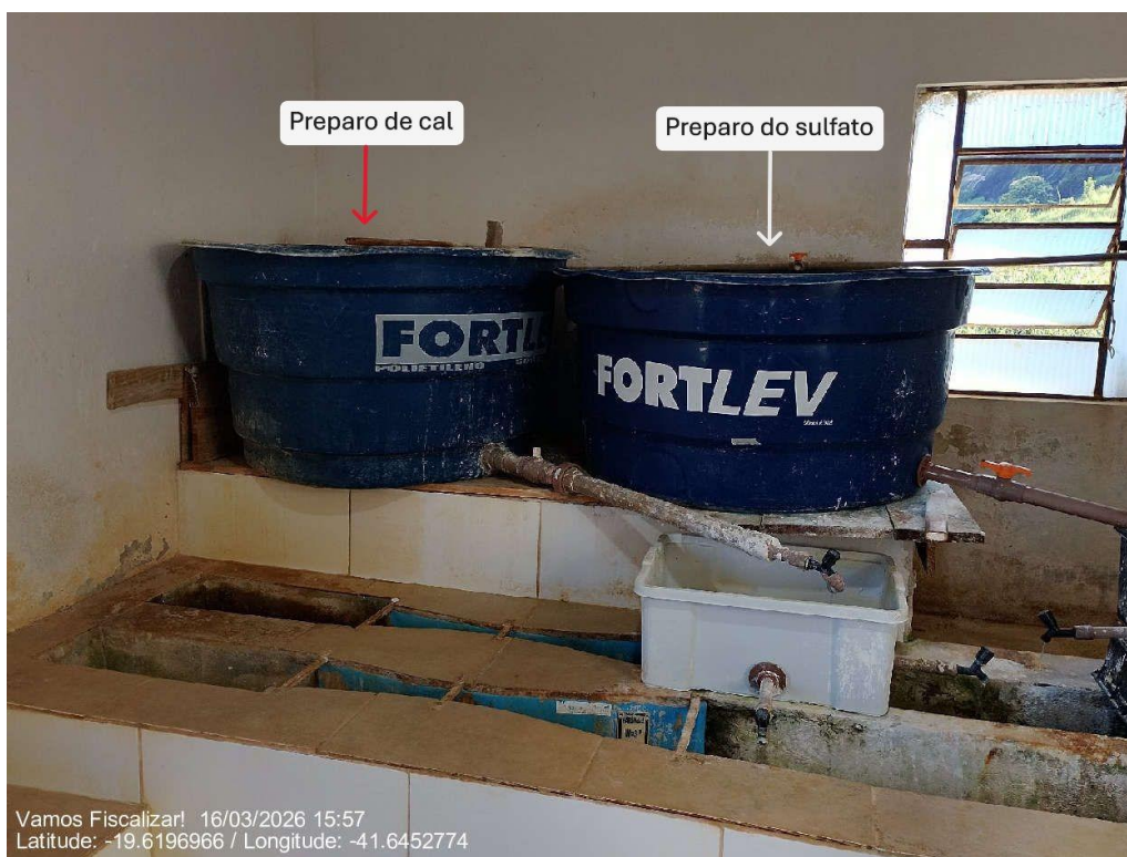
Área de preparo dos produtos químicos
