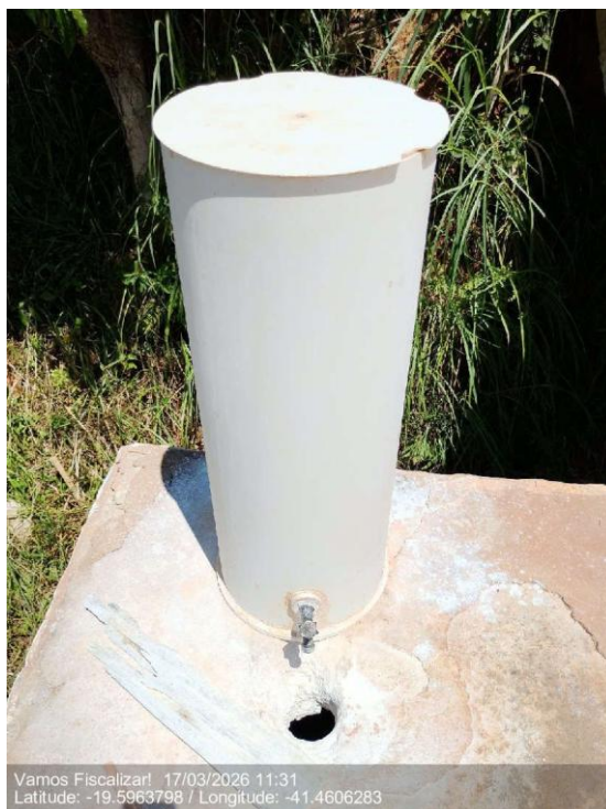
Ponto de preparo e dosagem de cloro no reservatório
