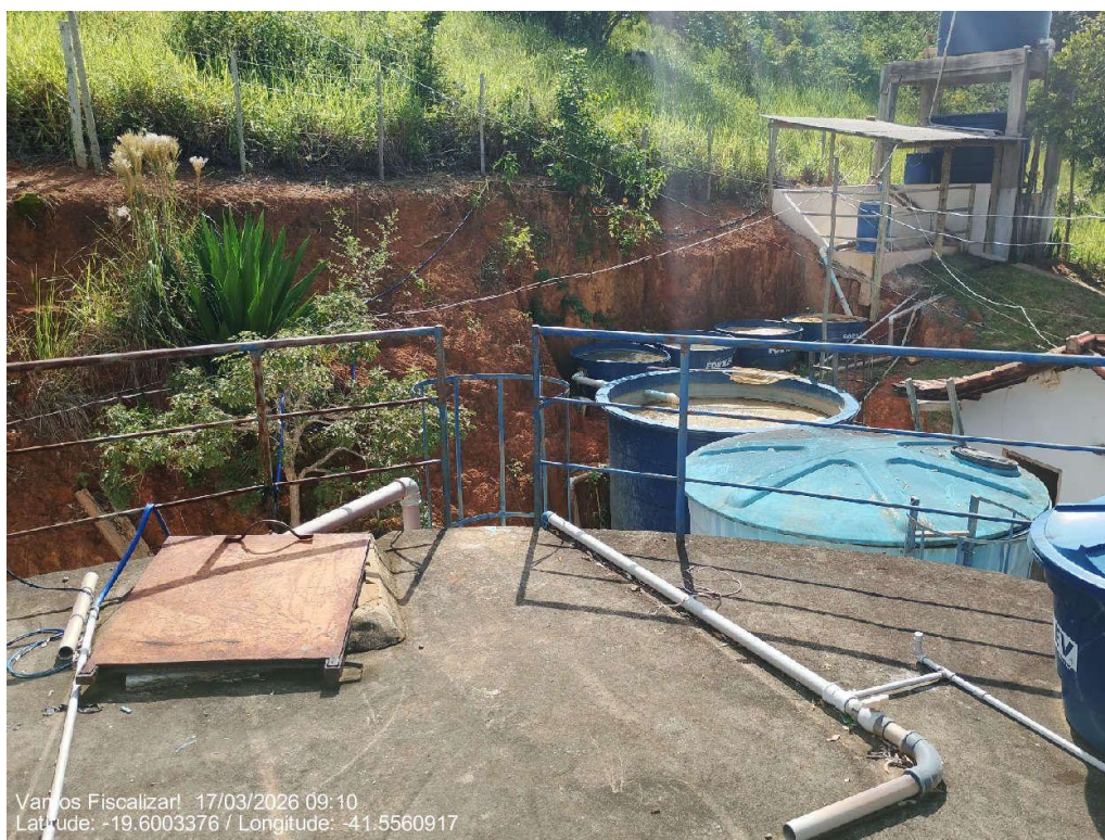
Guarda corpo no tanque de contato
