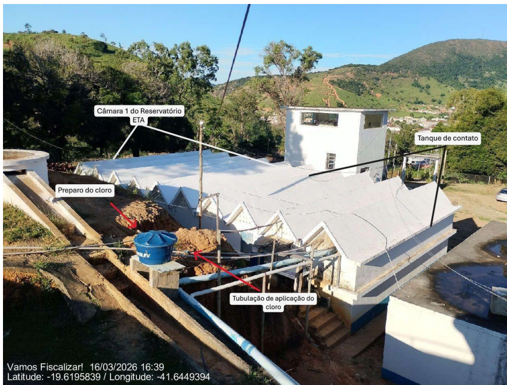
Cloração e tanque de contato
