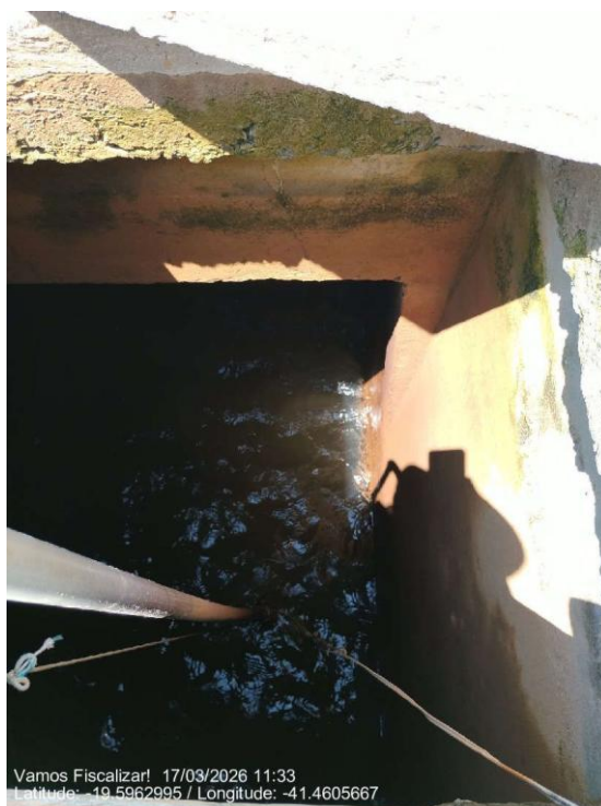
Ausência de indicador de nível
