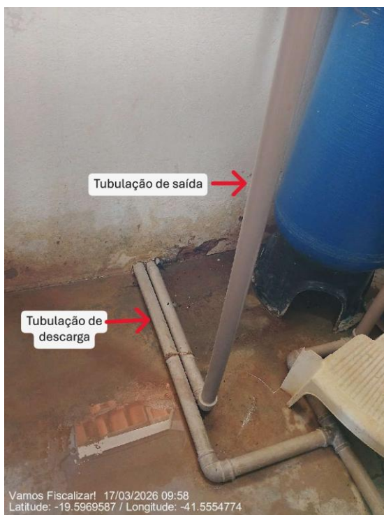
Tubulação de descarga e tubulação de saída
