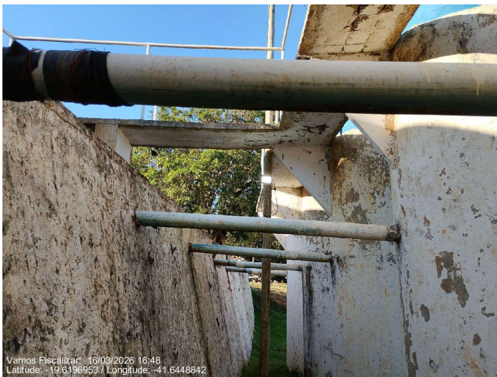
Tubulações de entrada em cada filtro (Circular)
