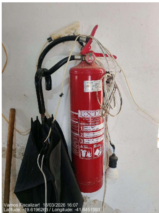
Extintor na casa de química obstruído por fiações
