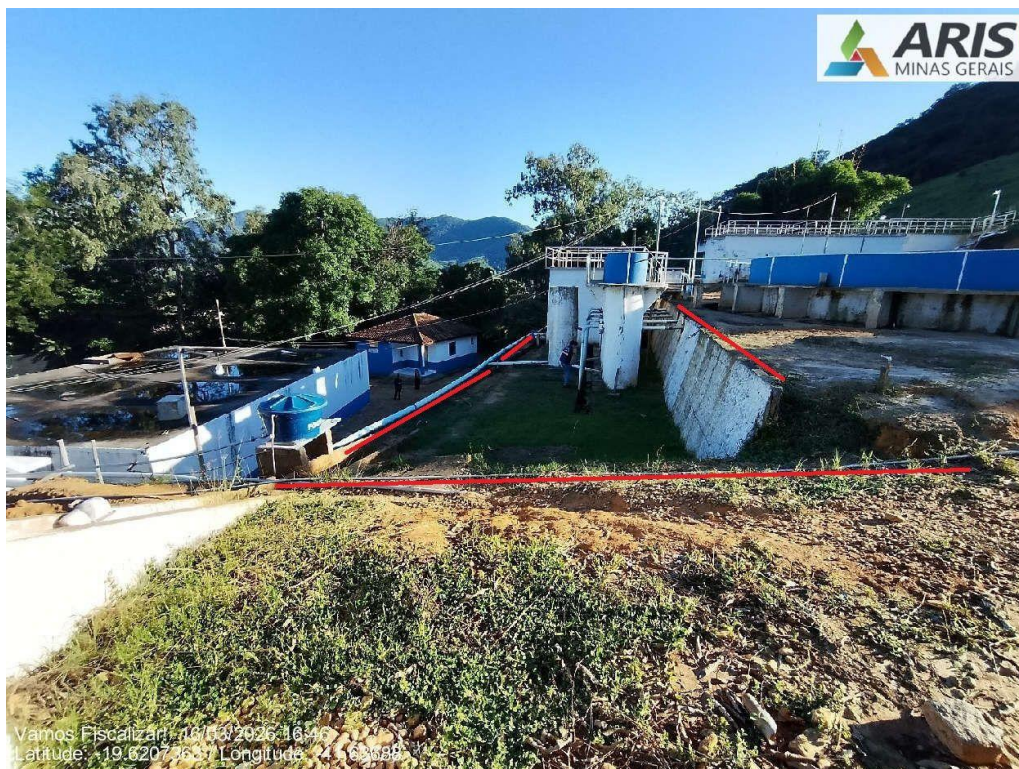
Ausência de guarda corpo indicado na linha vermelha.
