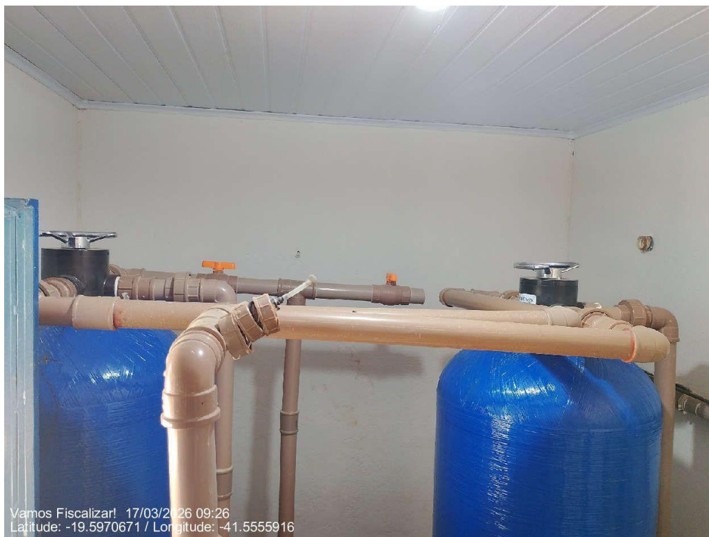
Registros de manobra que acionam a limpeza dos filtros
