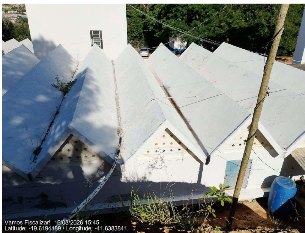
Estrutura de reservação I - câmara 1 (tanque de contato).
