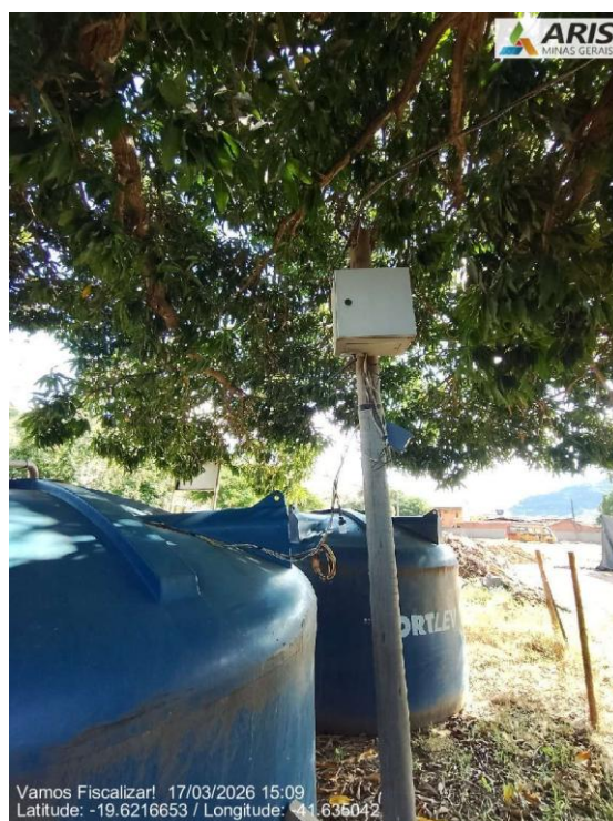
Quadro de comando está elevado
