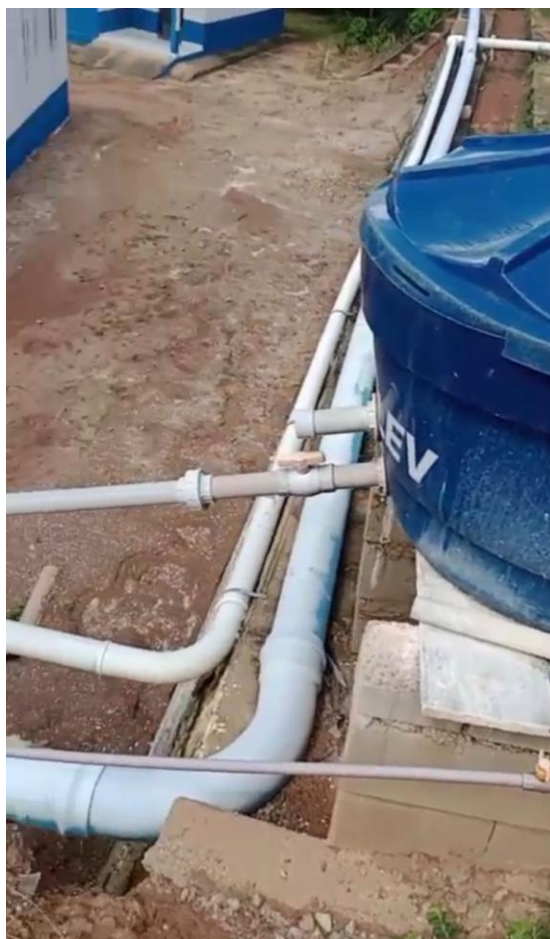
Tubulação de saída da área de preparo do cloro
