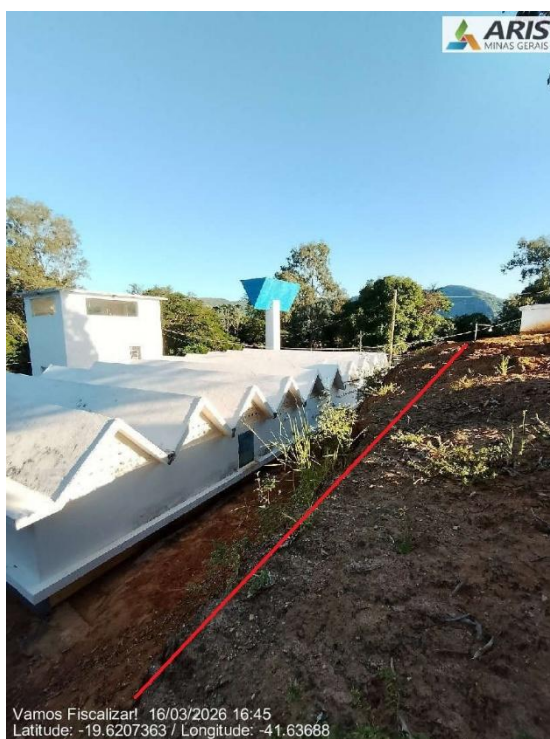
A linha vermelha apresenta trecho com grande desnível e não há guarda corpo
