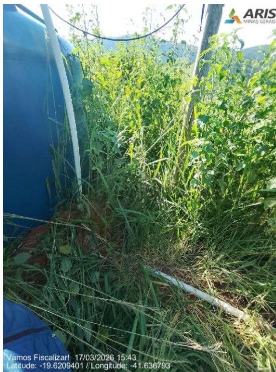
Tubulação de entrada de água no sistema de reservação.
