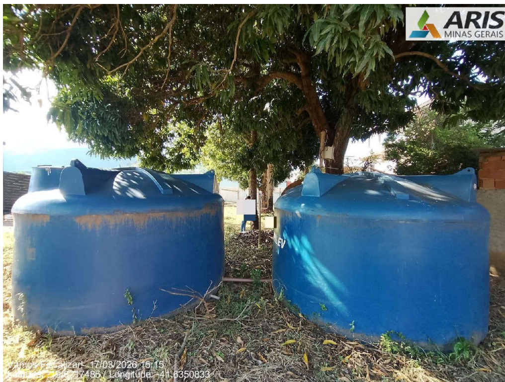
Reservatórios de sucção da EEAT Pátio da Prefeitura
