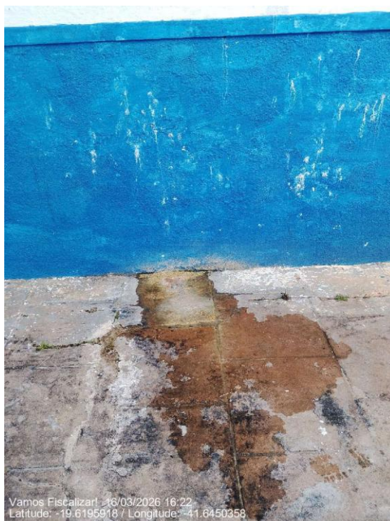
Infiltração por pressão positiva.
