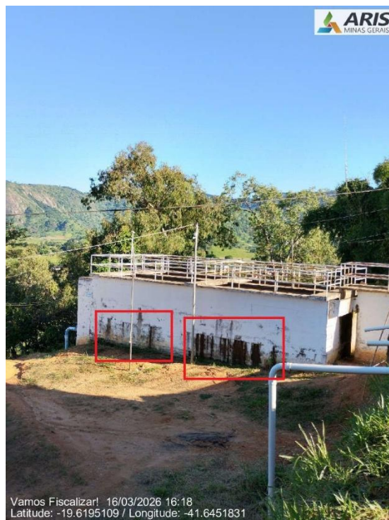
Indícios de vazamento de água na lateral do decantador (Retangular)
