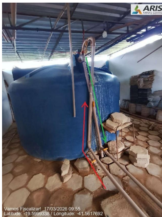
Tubulações de entrada (seta vermelha) e de saída (seta verde)
