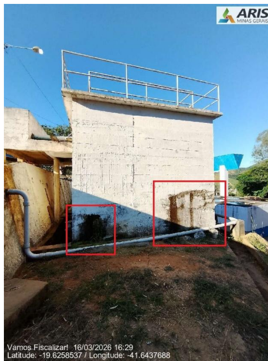
Indícios de infiltração na estrutura dos filtros (Retangular)
