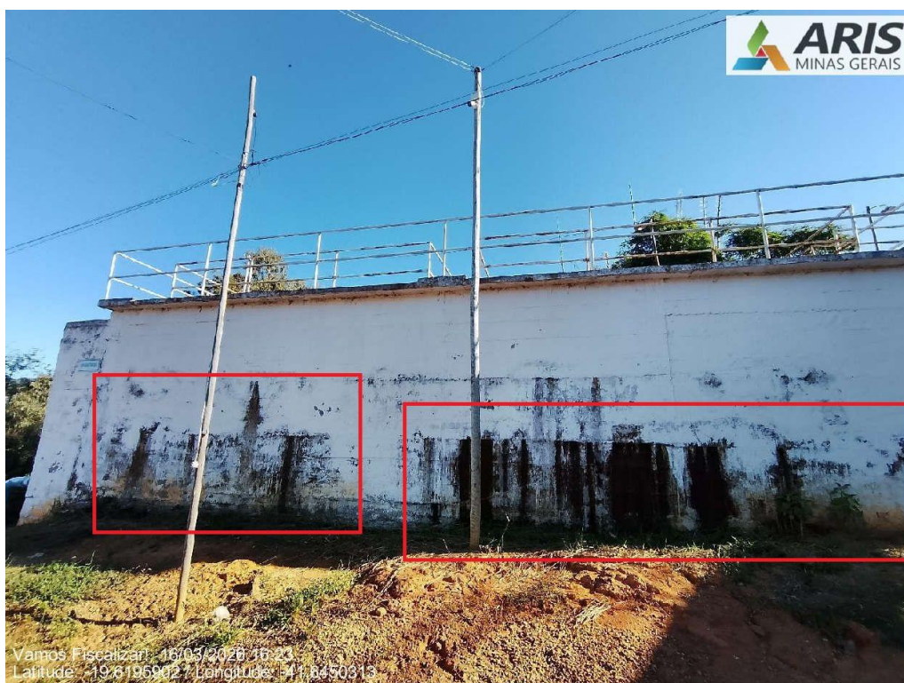
Vista lateral do decantador com indícios de vazamento de água da unidade.
