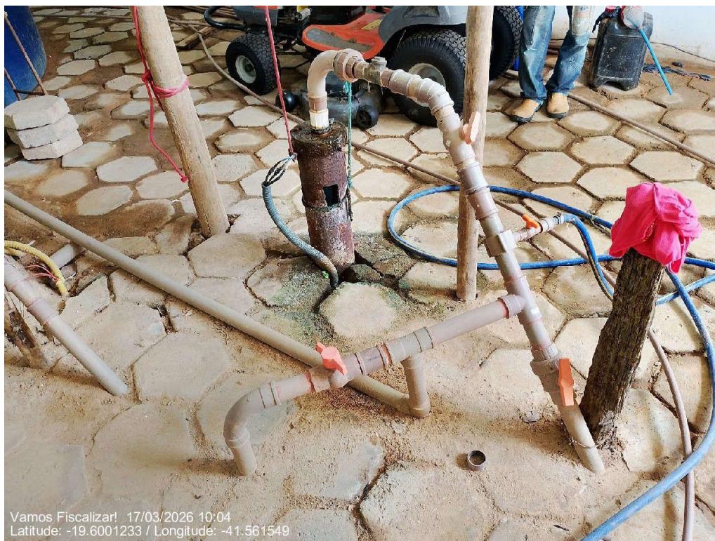
Captação Subterrânea Poço do Campo.
