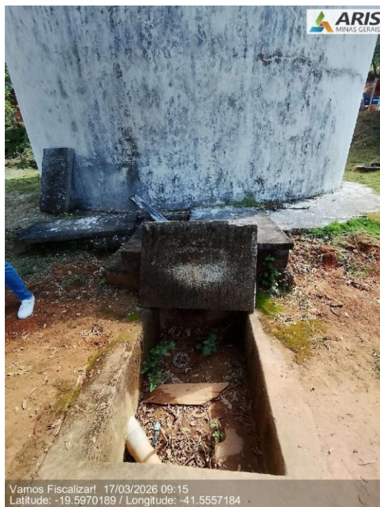
Caixa de registro de saída do reservatório
