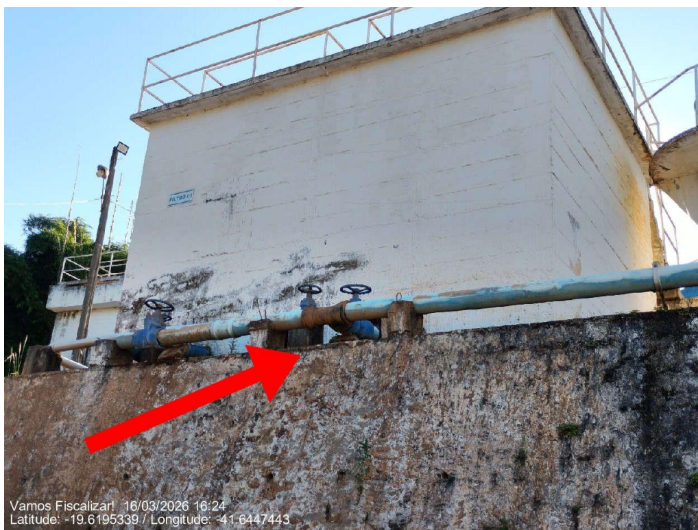
Registro de saída da ETA e entrada na estrutura de reservação I.
