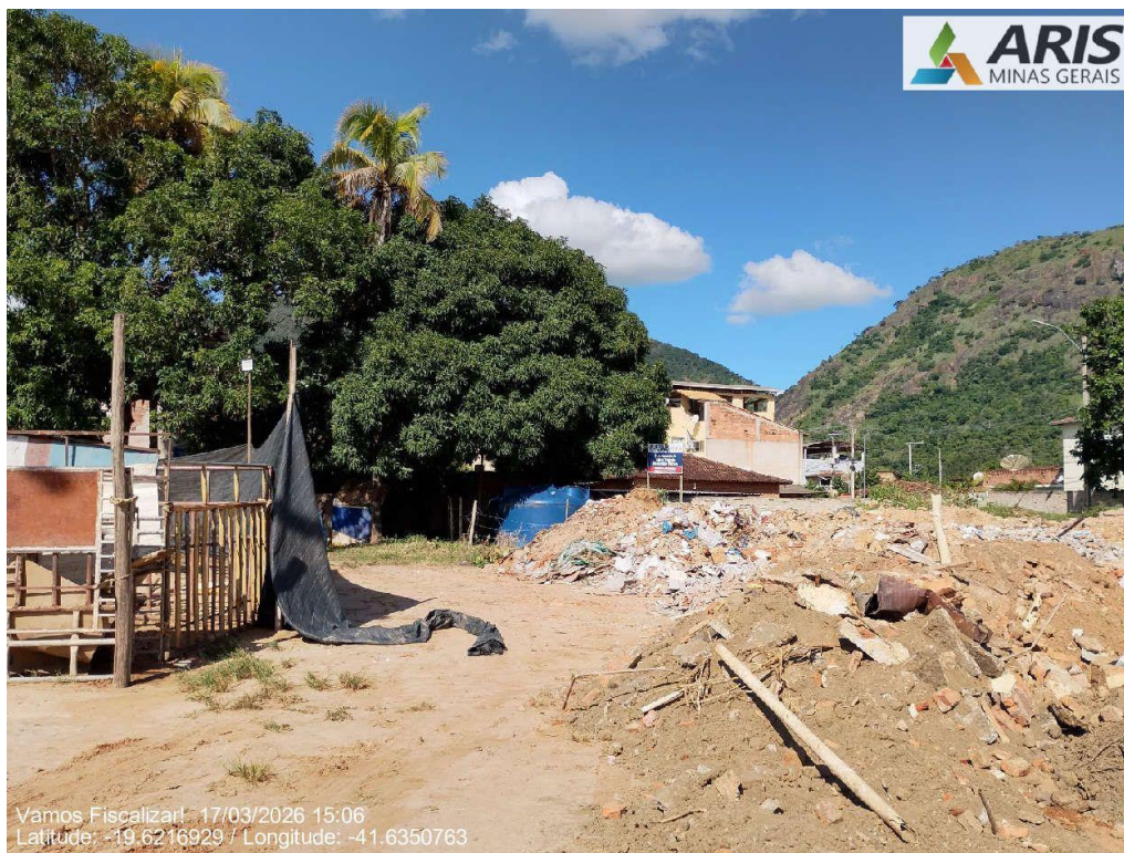
Presença de resíduos sólidos da construção civil
