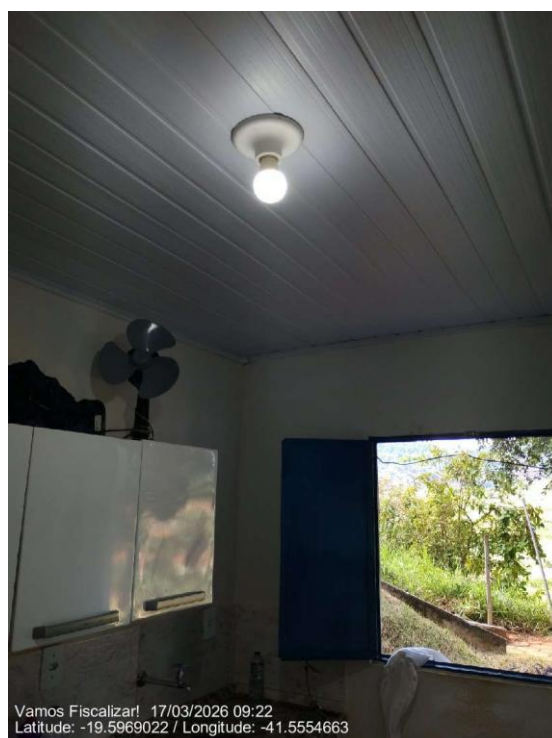
Iluminação na cozinha
