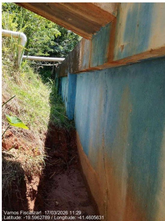
Parede do reservatório desgastada
