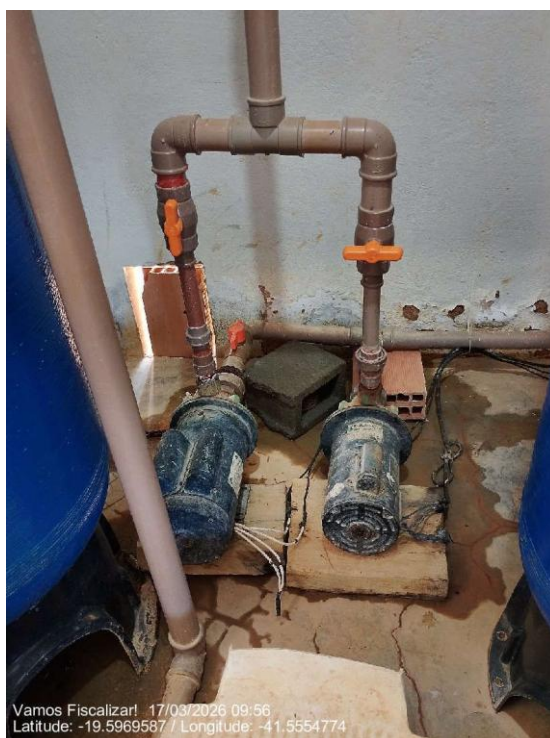
Conjuntos motobombas dos filtros pressurizados (1+1)
