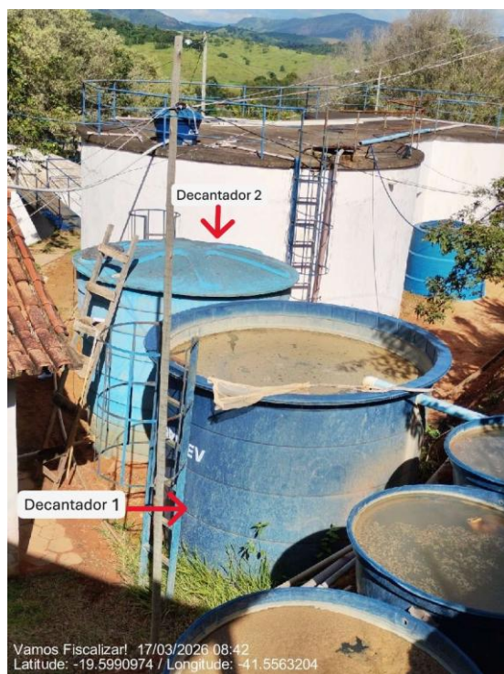
Decantadores em operação
