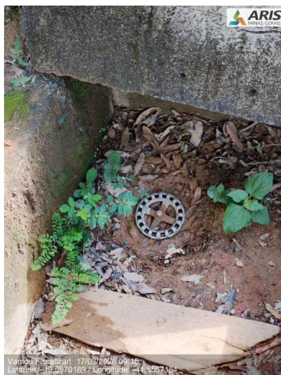
Registro de saída do reservatório
