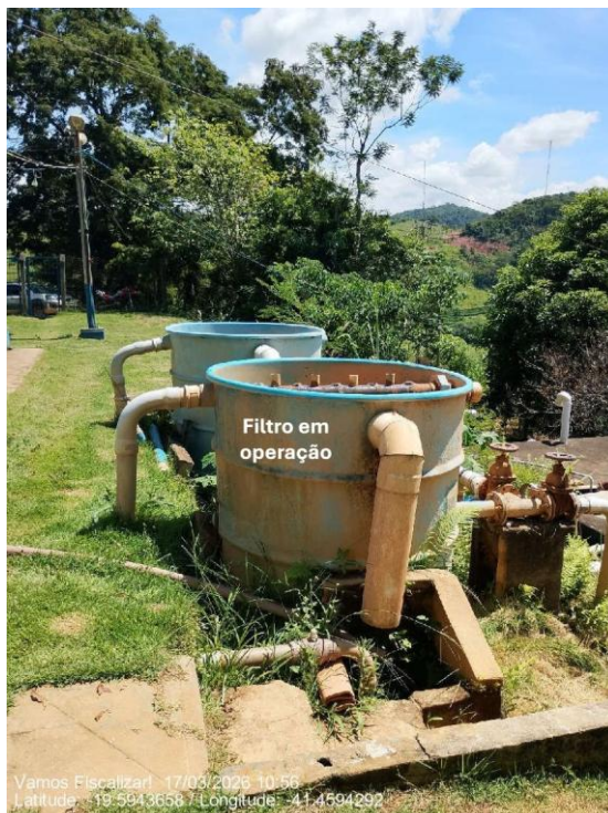
Filtro em operação
