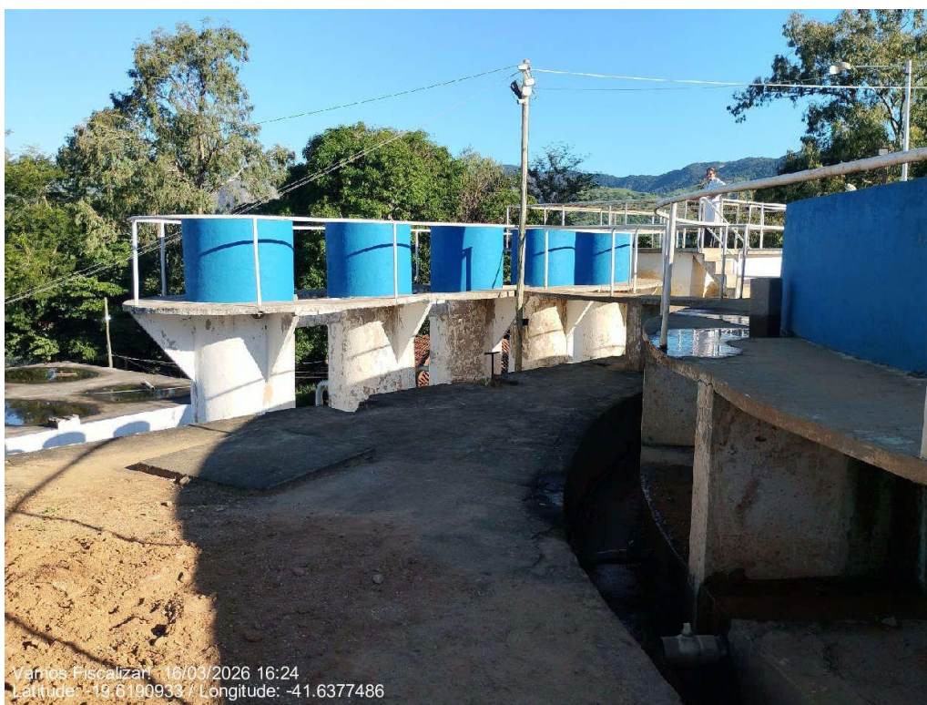
Guarda-corpo nos filtros circular (vãos muito espaçados entre si)
