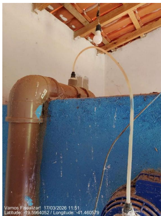
Dosagem do sulfato de alumínio na tubulação de entrada da água bruta
