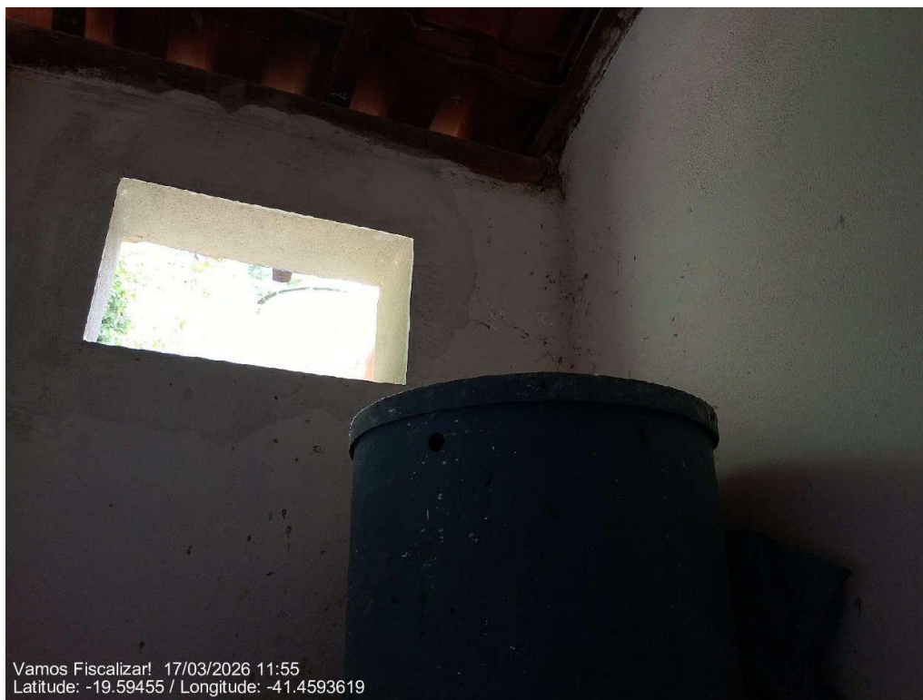
Janela sem proteção para entrada de água
