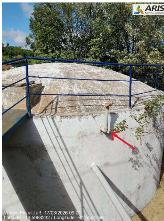
Tubulação para ventilação com uma pedra obstruindo a entrada de ar
