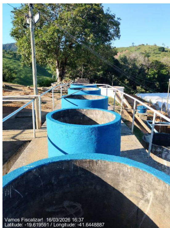
Filtros em operação (Circular)
