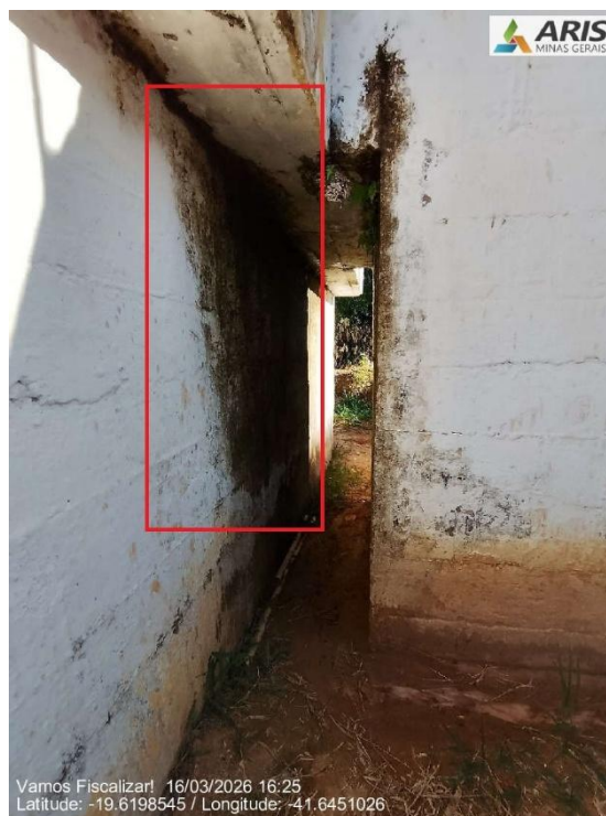
Vista lateral do decantador com indícios de vazamento de água da unidade. Trecho entre o decantador (esquerda) e floculador (direita).
