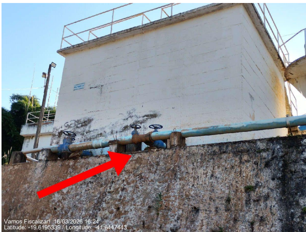
Registro de saída dos filtros retangulares para o tanque de contato
