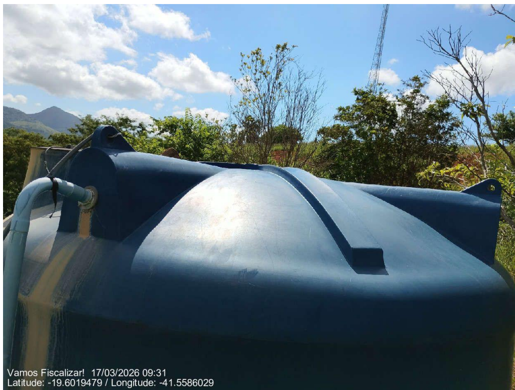
Ausência de tubulação de ventilação.
