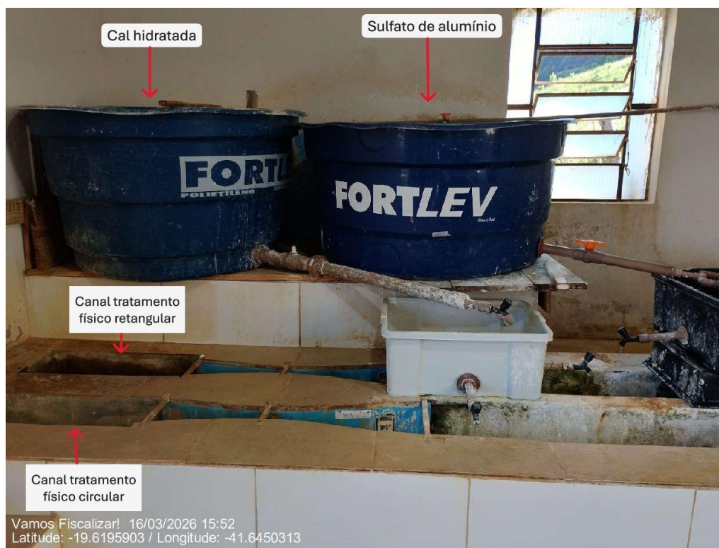
Área de preparo e dosagem dos produtos químicos (cal e sulfato) na entrada da ETA
