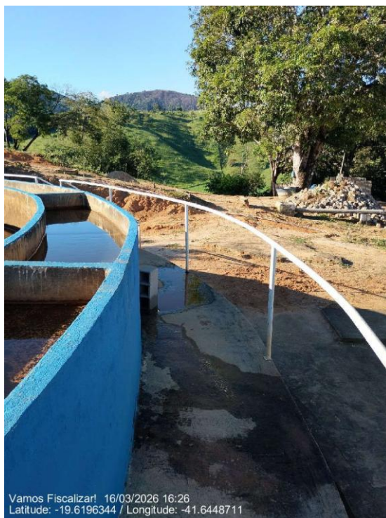
Guarda-corpo baixo e vários vazamentos na área de circulação (circular)
