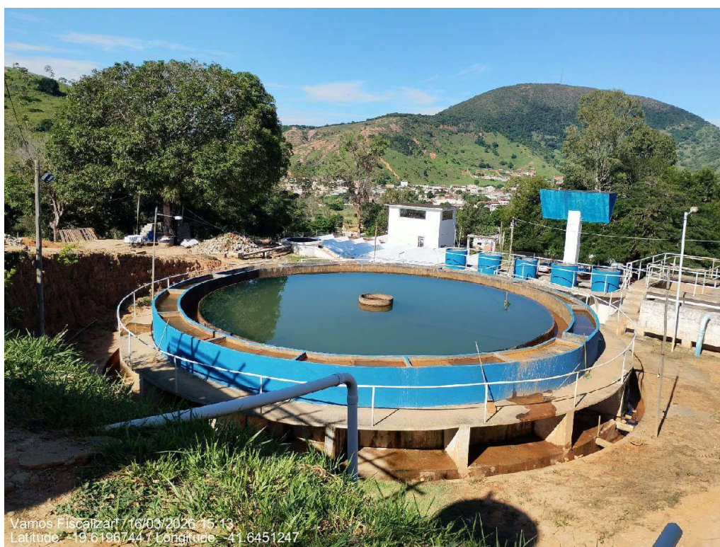
Tratamento físico (floculador e decantador) circular
