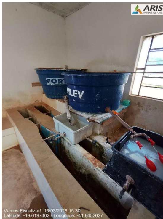
Calha parshall e aplicação de coagulantes químicos e CaO.
