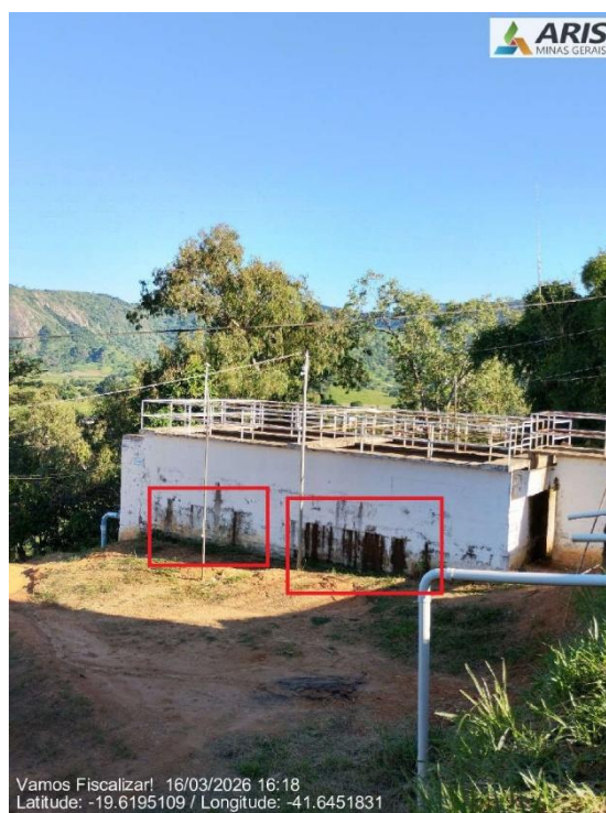
Vista lateral do decantador com indícios de vazamento de água da unidade.
