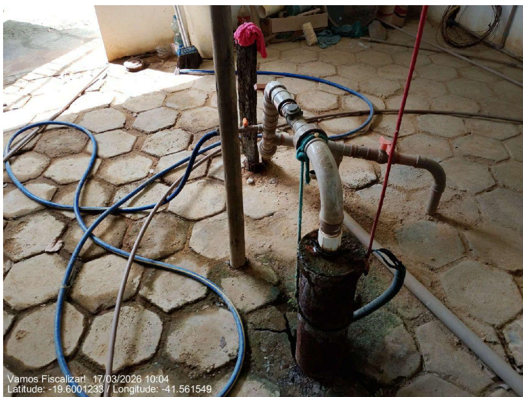
Captação Subterrânea Poço do Campo.
