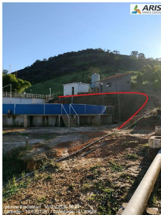
Ausência de guarda-corpo
