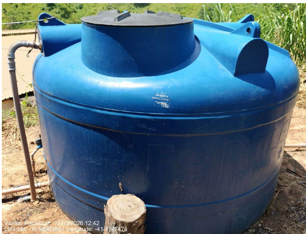
Ausência de tubo extravasor com caixa de descarga.
