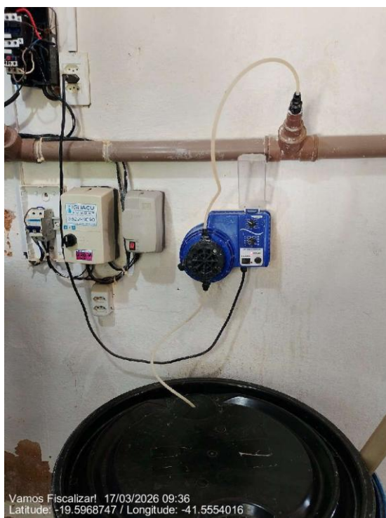
Bomba dosadora de sulfato e aplicação do produto na tubulação de entrada da ETA
