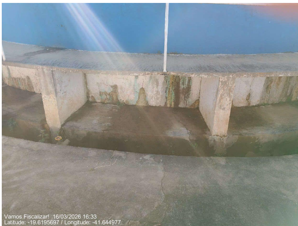
Vazamentos no floculadores/decantador (Circular)
