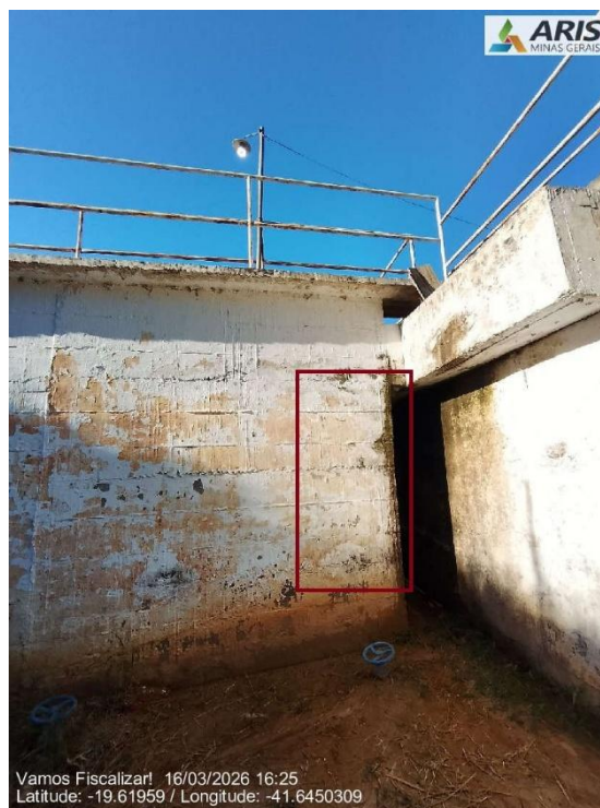
O trecho que conecta os floculadores às unidades de decantação (Retangular)
