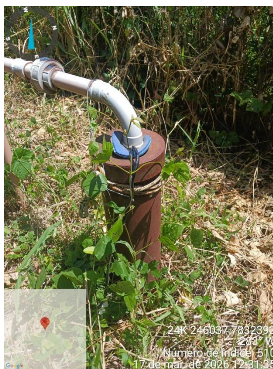
Ausência de torneiras para coleta de água
