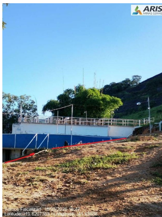
Área próxima ao decantador circular. Ausência de guarda-corpo.
