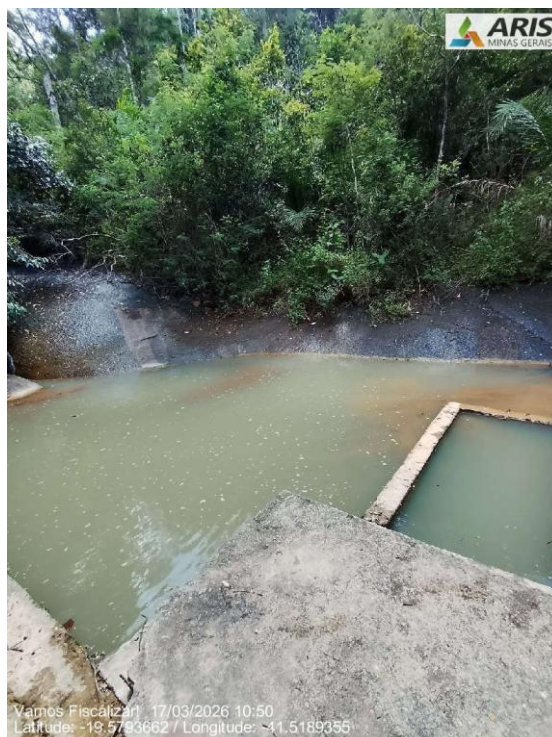
Na estrutura quadrada fica a tubulação de PVC que capta a água
