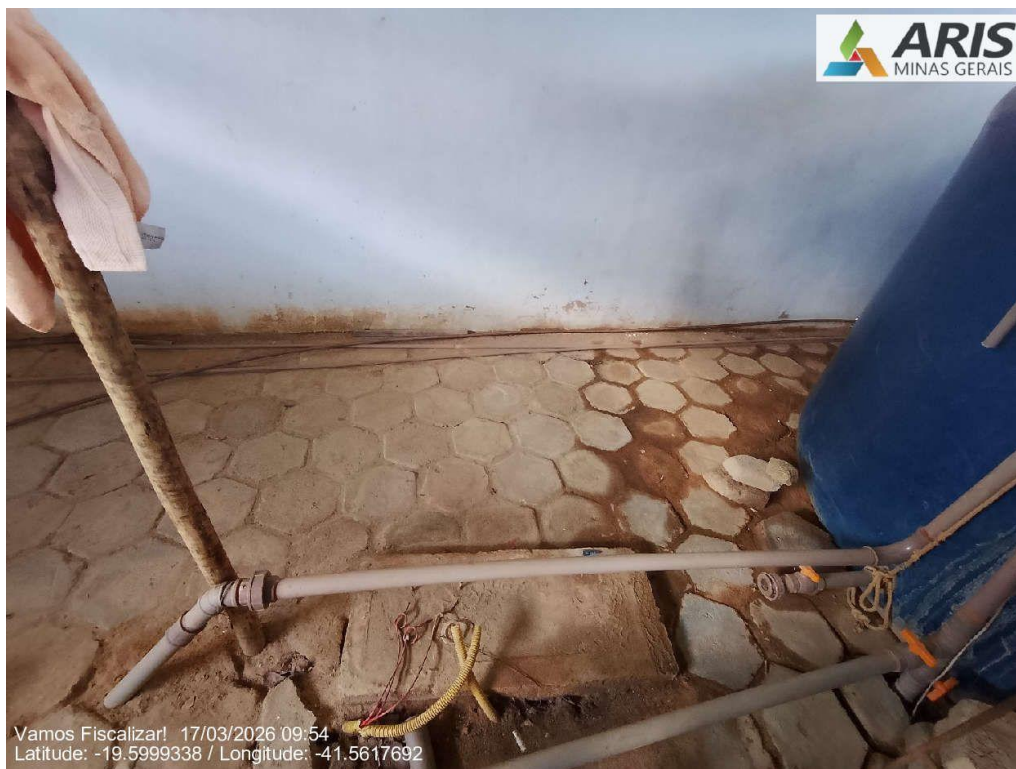
Tubulação por onde chega água tratada da ETA Barra da Figueira.
