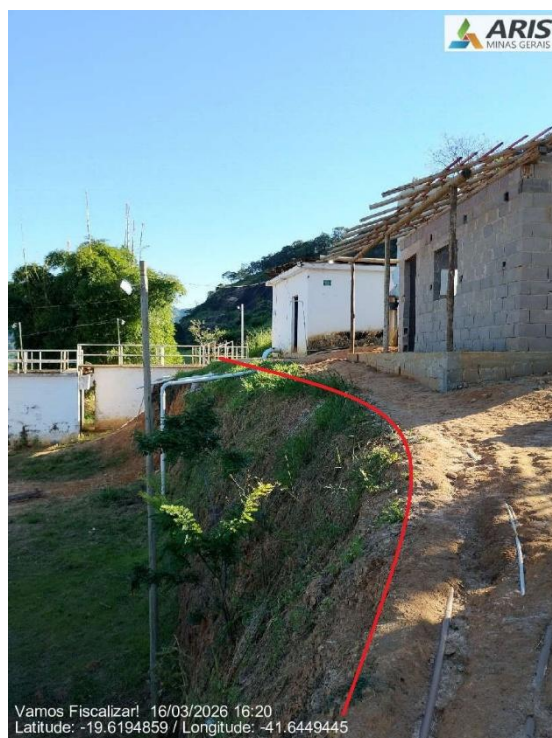
O acesso à parte superior da ETA, área sem guarda corpo (linha vermelha)
