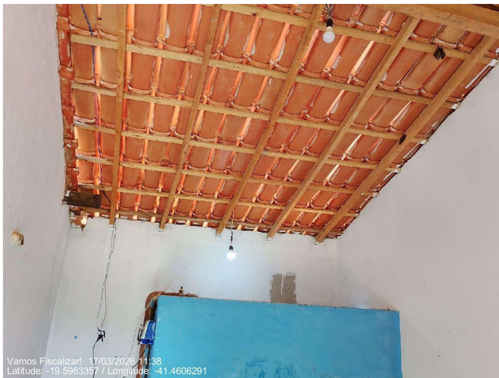
Interior da ETA: há duas lâmpadas, mas estava queimada
