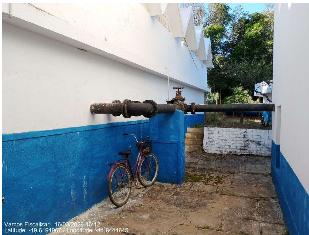
Registro de saída da câmara 2 da estrutura de reservação I e de entrada do Reservatório II (interliga os reservatórios).
