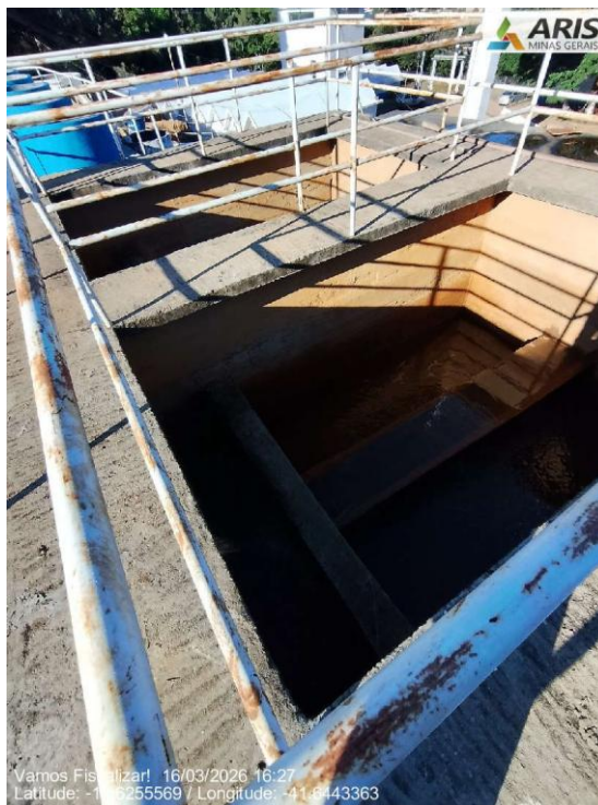
Filtro com ausência de flocos (retangular)
