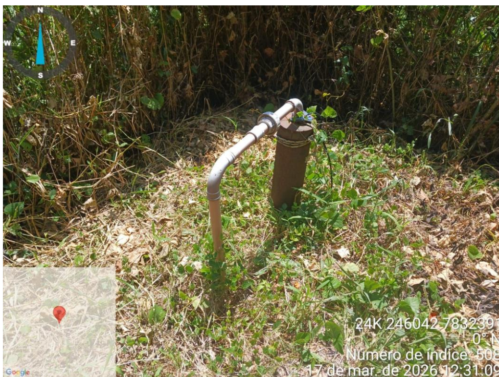
Ausência da laje sanitária
