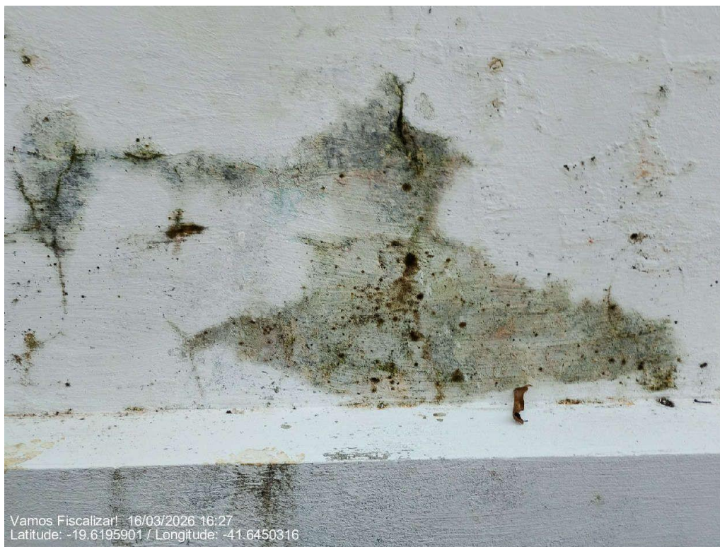
Infiltração com presença de bolor na estrutura de reservação I.
