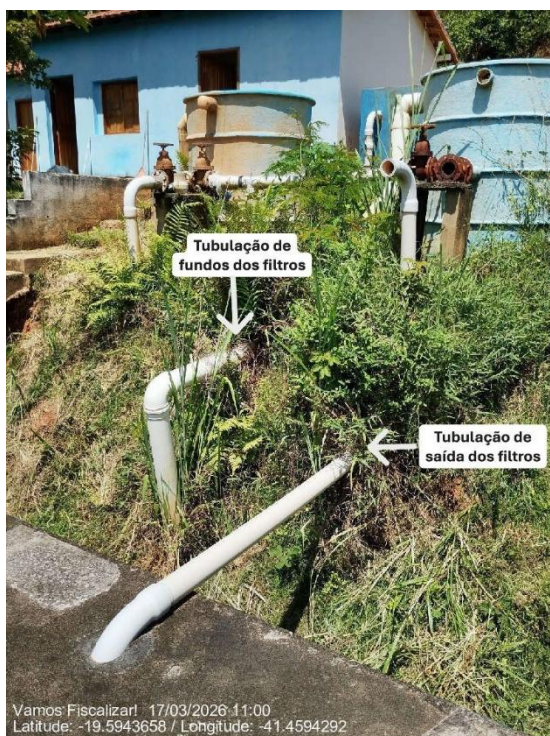
Tubulações de descarga e de saída dos filtros
