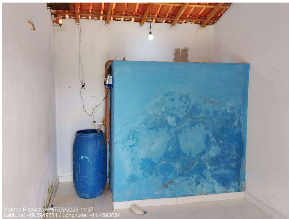
Parede da estrutura de entrada de água na ETA com vazamentos
