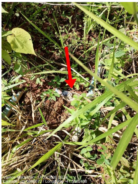
Descarga de fundo.
