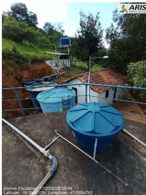
Foto indicando a tubulação que vem direto da ETA, sem medidor de vazão.
