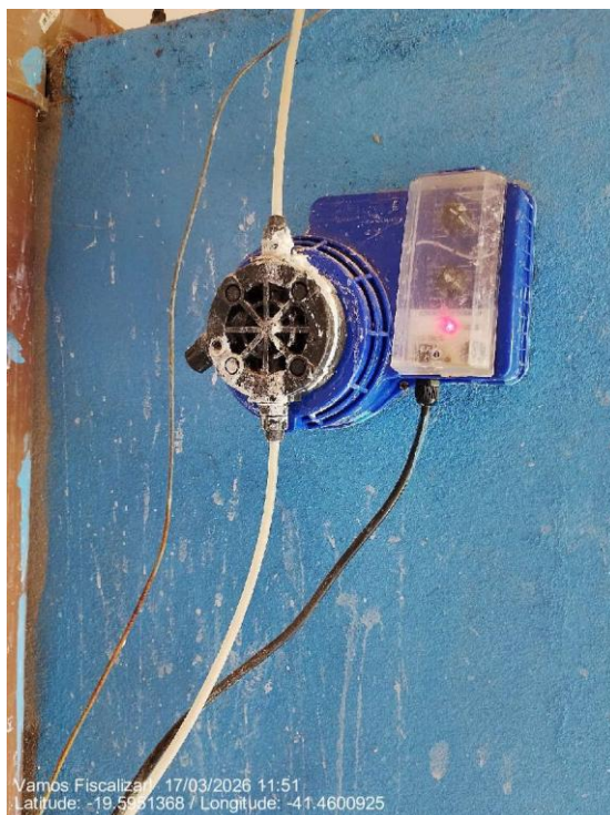
Dosador de sulfato de alumínio
