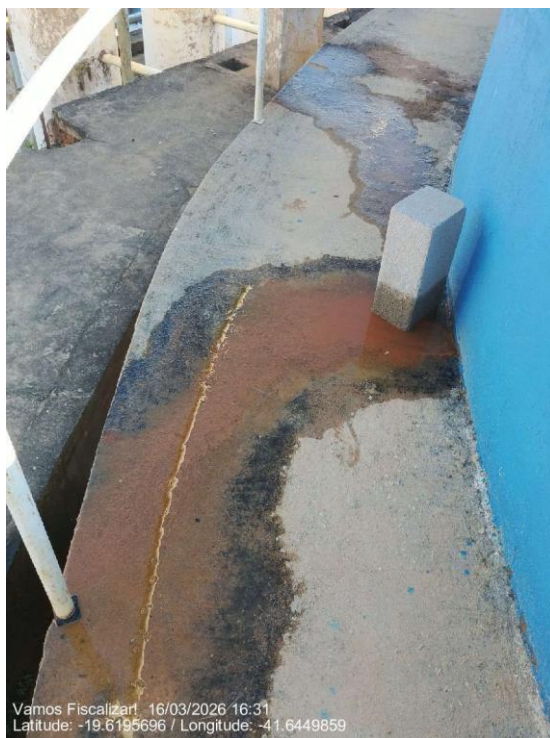
Vazamentos no floculadores/decantador (Circular)
