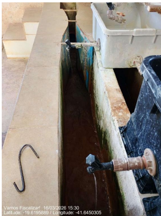
Mofo nas paredes laterais dos canais de entrada da água bruta
