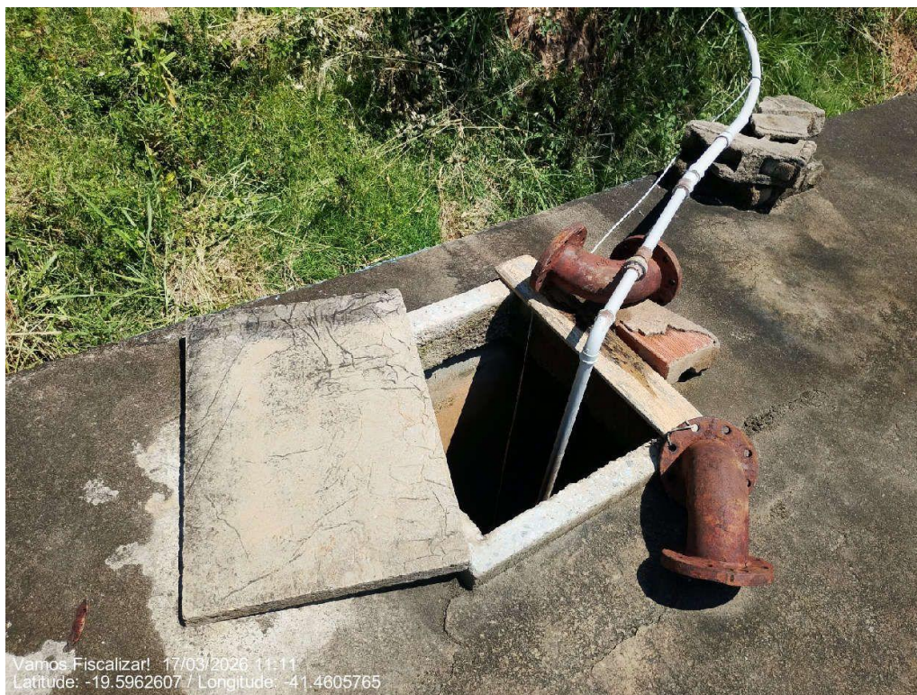
Tampa em concreto sem cadeado e aberta durante a fiscalização
