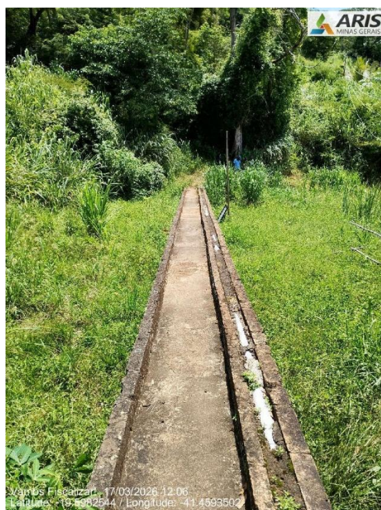
Rampa de acesso sem guarda corpo
