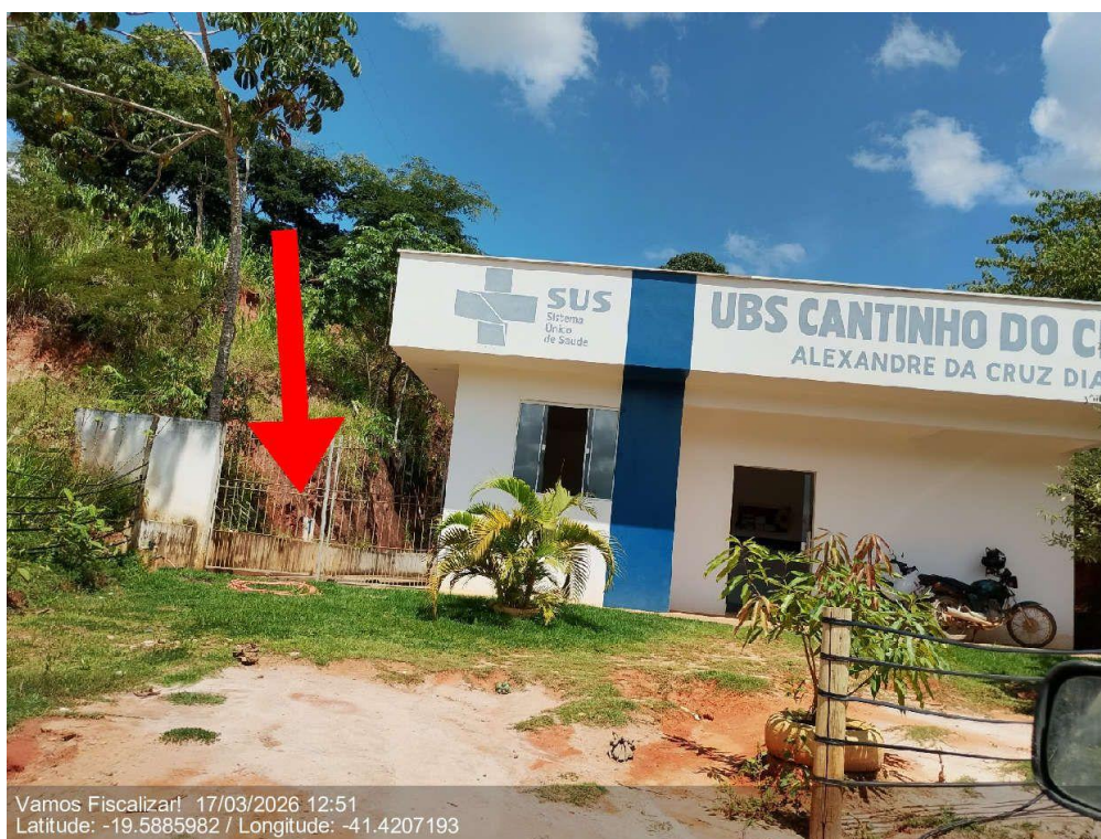
Clorador dentro da área da UBS Cantinho do Céu
