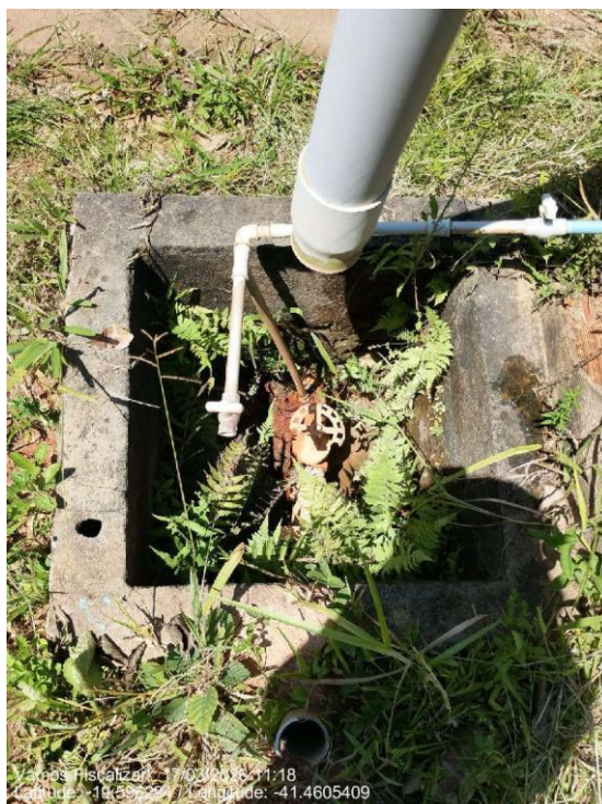
Caixa de registro da tubulação de saída do reservatório
