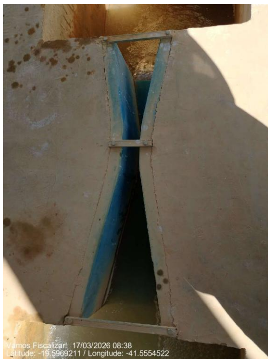
Medidor de vazão na entrada do tratamento
