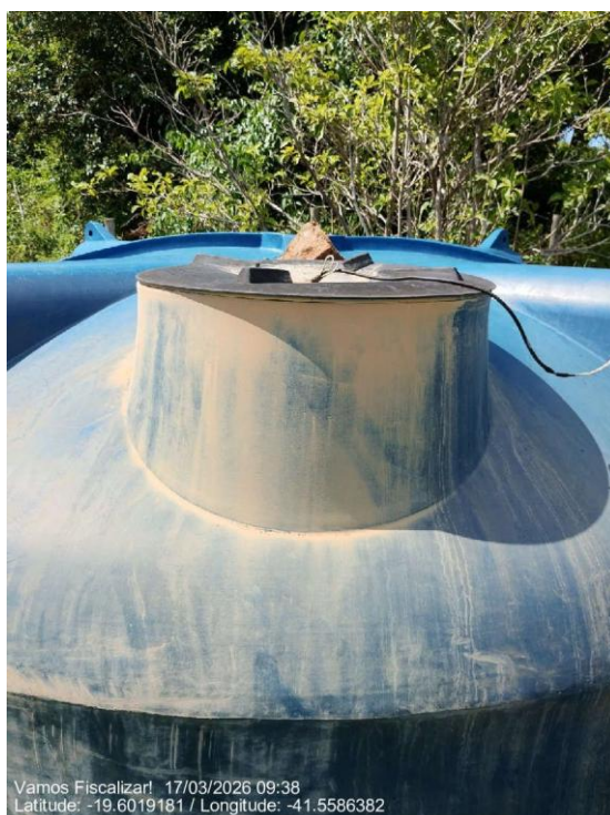
Ausência de cadeado na tampa de inspeção.
