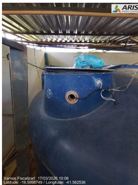
Tampa de inspeção.
