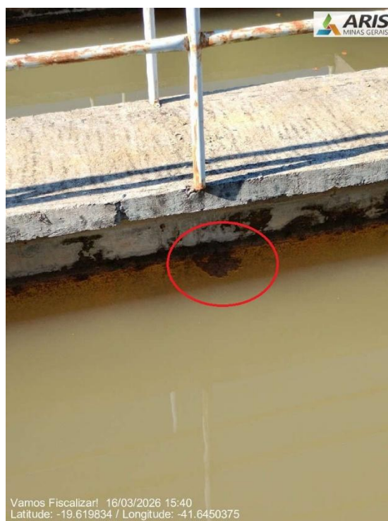
Flocos suspensos na lateral interna do decantador (Retangular)
