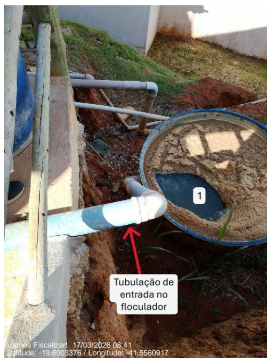
Tubulação de entrada no primeiro floculador
