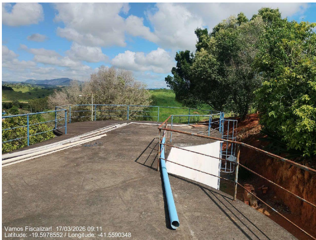
Guarda-corpo no tanque de contato
