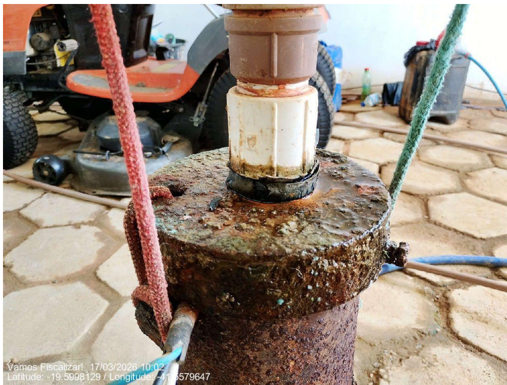
Vazamento na tubulação.
