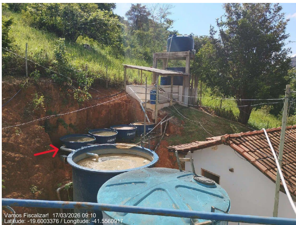
Tubulação de entrada no decantador
