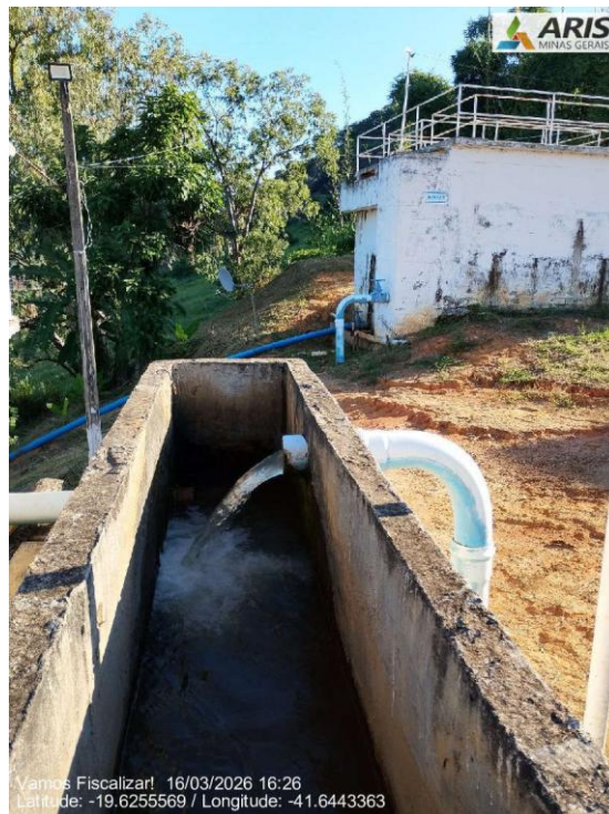
Tubulação de entrada de água na estrutura (retangular)
