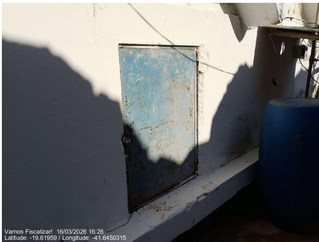
Tampa de inspeção da estrutura de reservação I, câmara 1 (tanque de contato), com início de oxidação.
