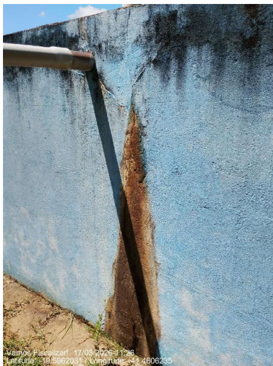
Rachaduras na parede do reservatório e marcas de vazamento
