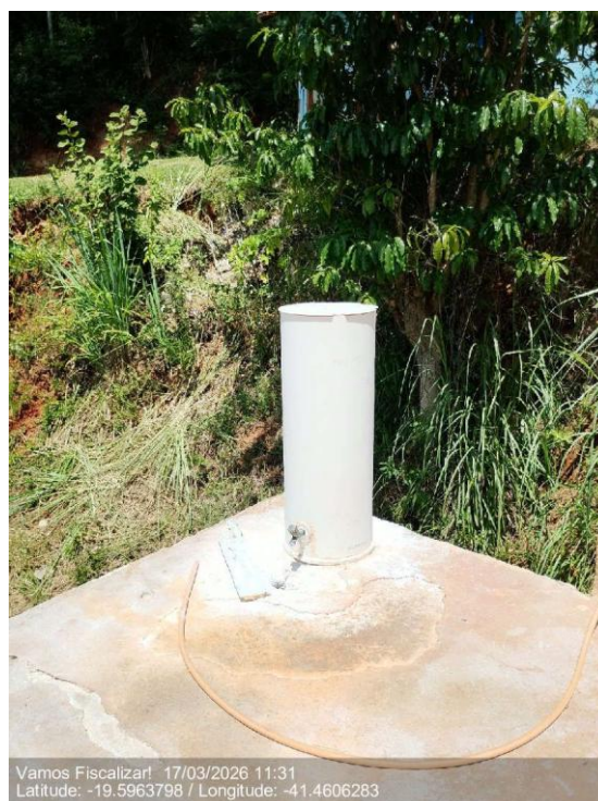
Clorador no reservatório
