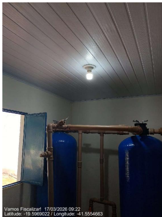
Iluminação na área dos filtros
