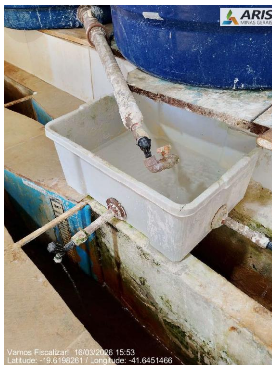
Torneiras em bom estado de conservação (dosagem de cal)
