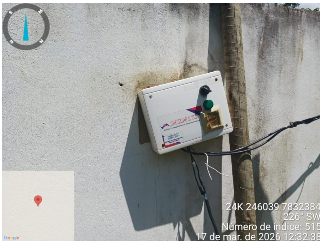
Quadro de acionamento da bomba
