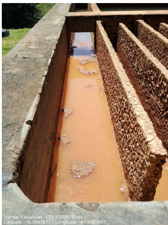
Flocos na saída dos floculadores
