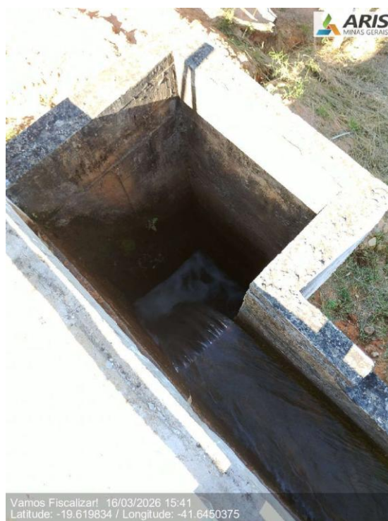
Caixa de saída ao final do decantador (Retangular)
