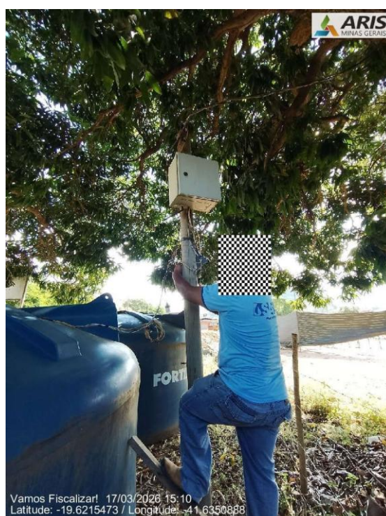
Sem escada para acesso do operador ao quadro de comando.
