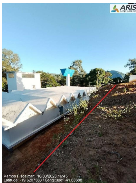
Ausência de guarda corpo indicado na linha vermelha.
