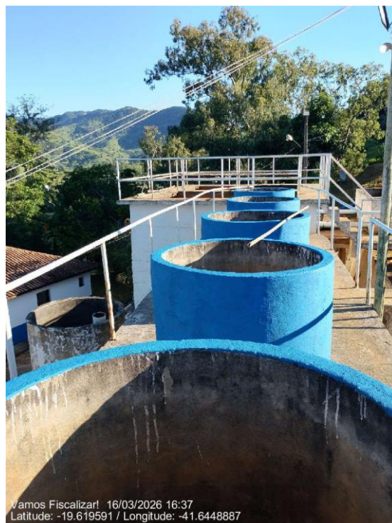
Filtros em operação (Circular)
