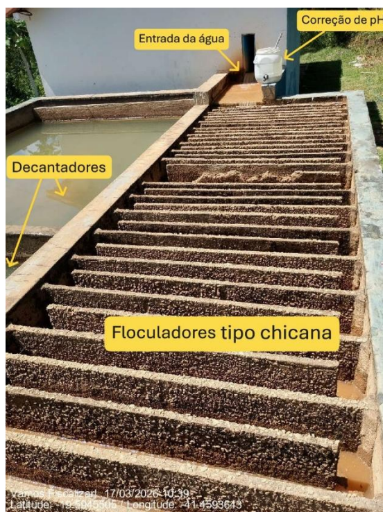
Unidades de tratamento da ETA
