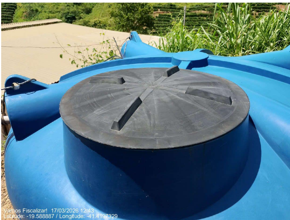
Tampa de inspeção.
