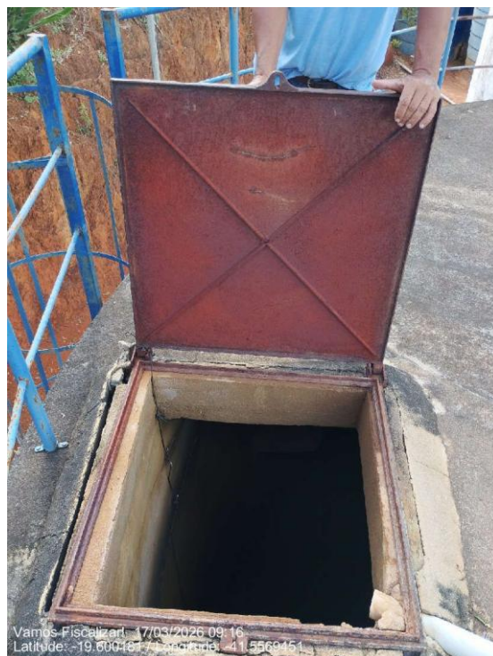
Parte interna da tampa de inspeção da câmara 2 do tanque de contato (oxidada)
