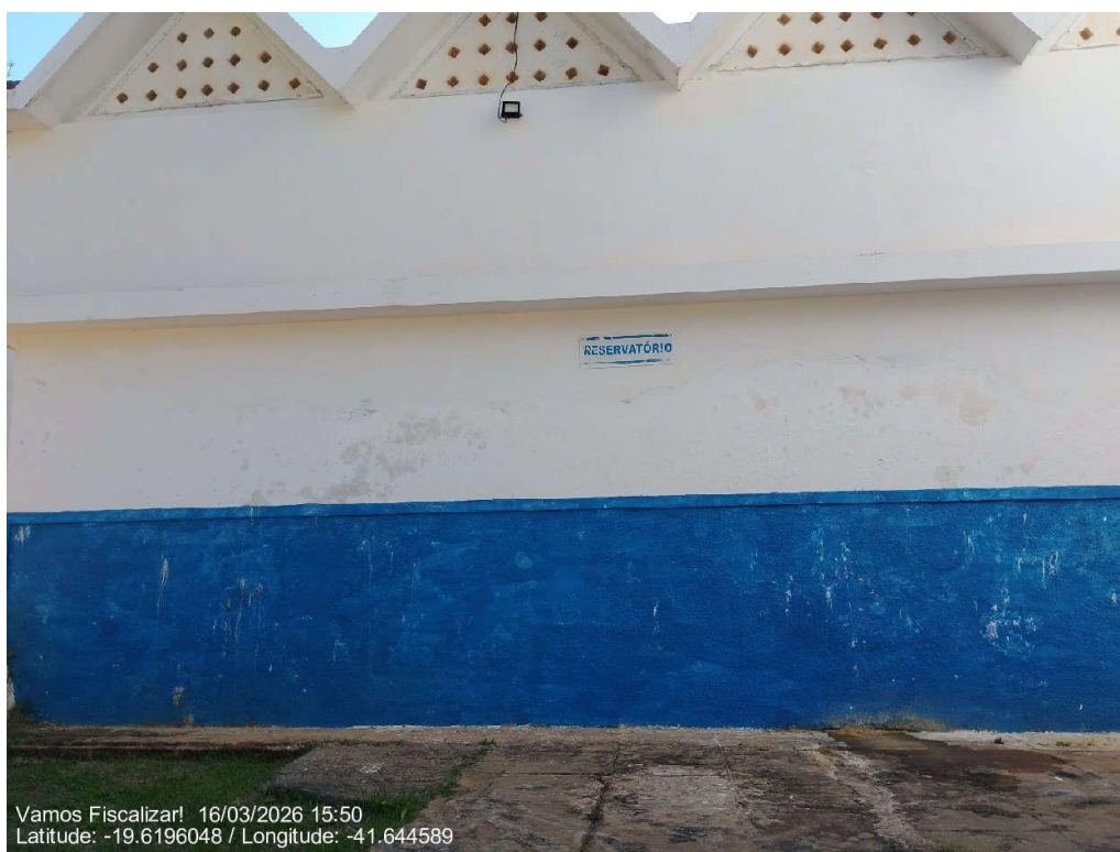
Estrutura de reservação I.
