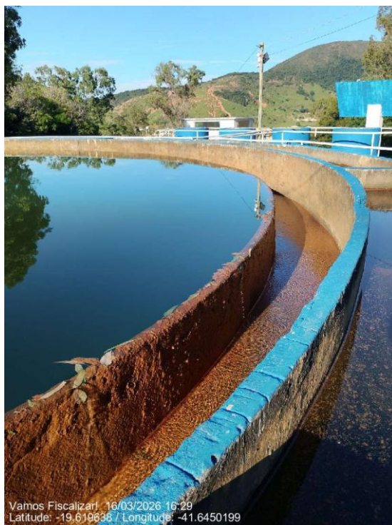
Água clarificada escoando do decantador (Circular)
