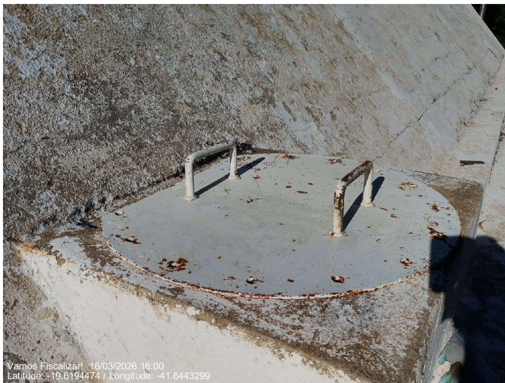
Ausência de cadeado na tampa de inspeção do Reservatório II.
