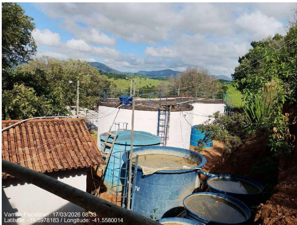
Vista Geral da ETA Barra da Figueira
