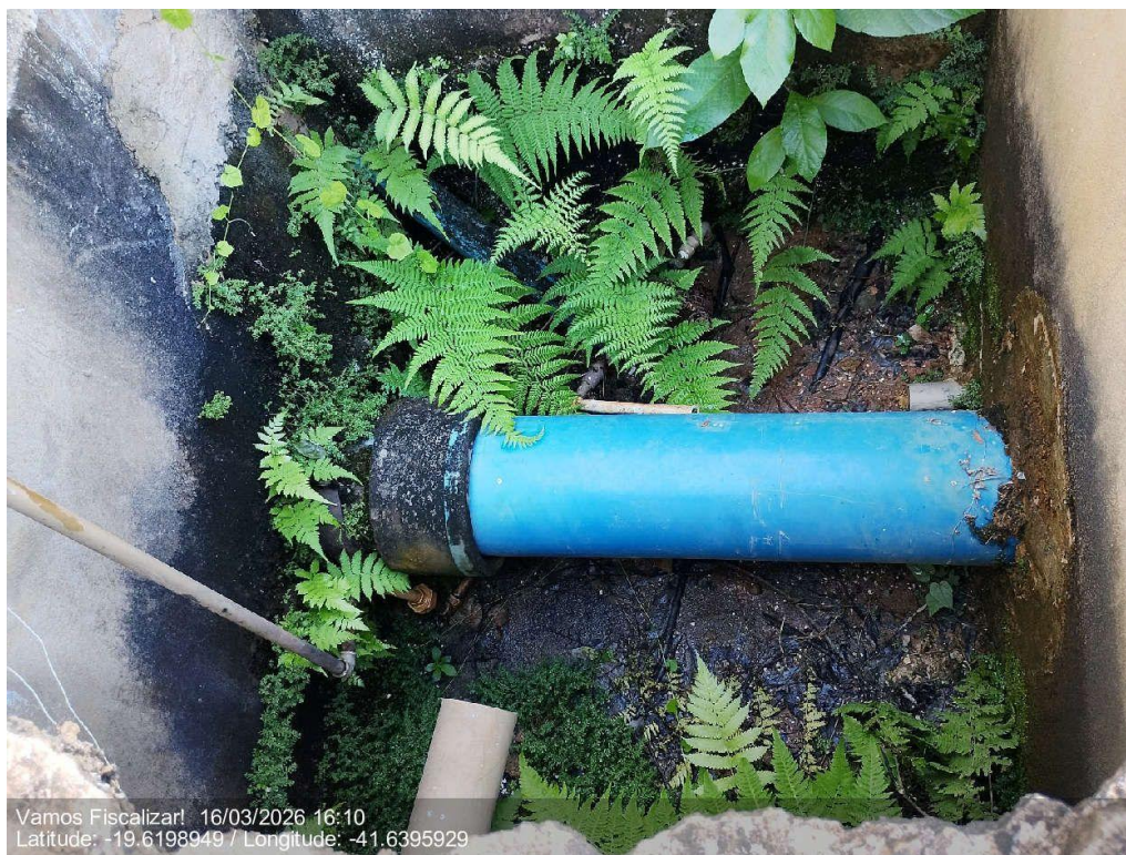
Descarga de fundo.
