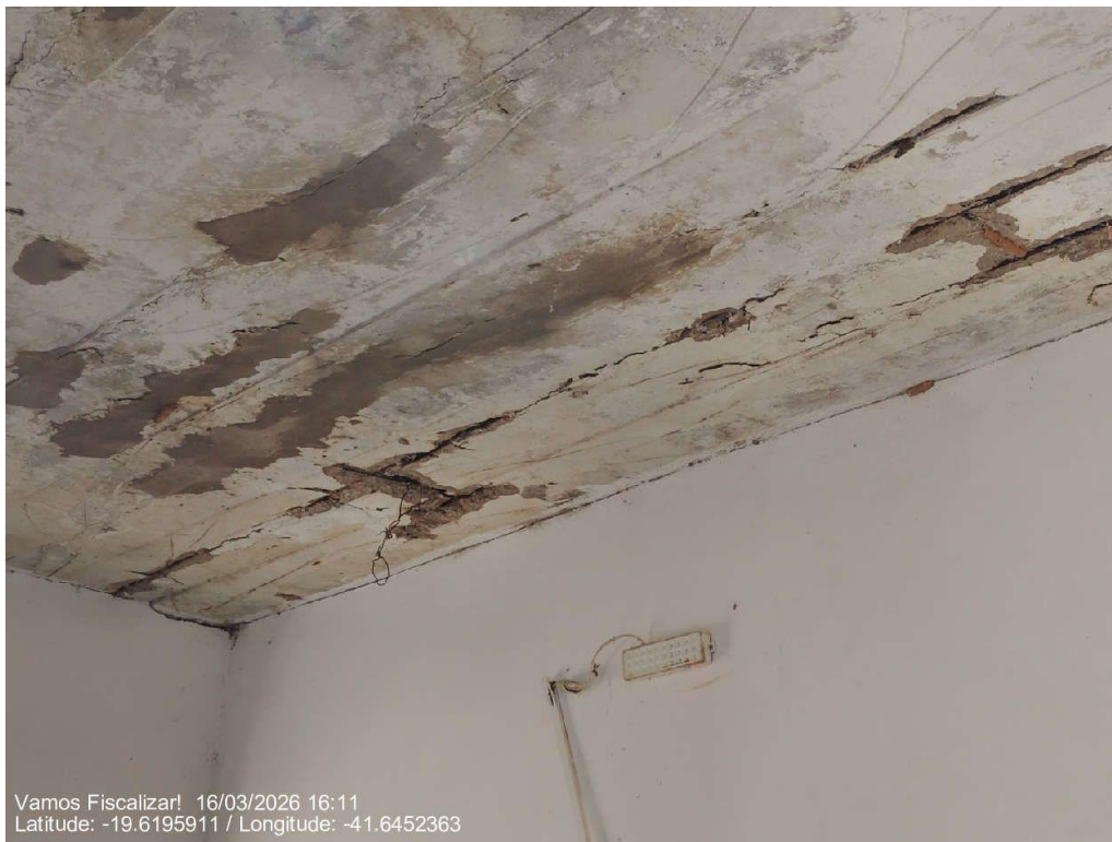
Armação exposta da laje da casa de química
