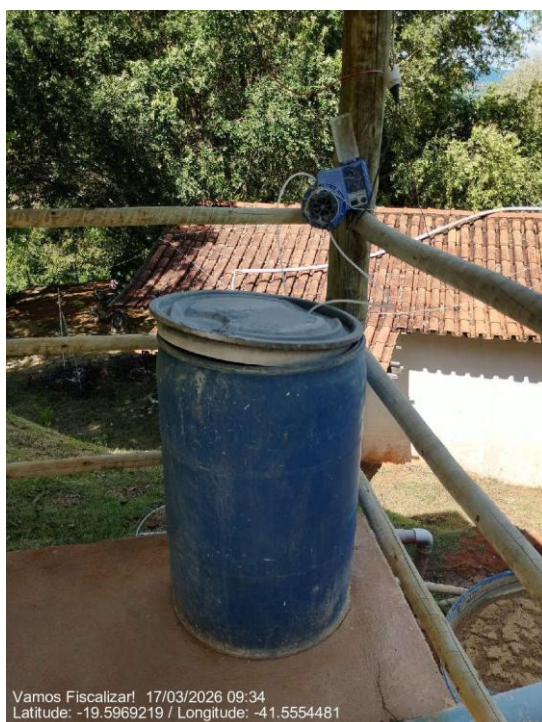
Preparo e dosagem do cloro
