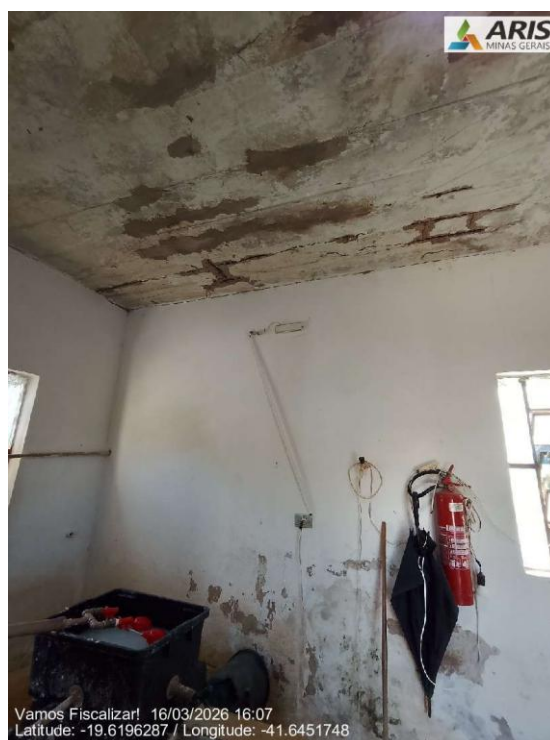
Armação exposta da laje da casa de química
