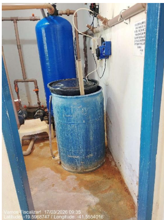
Preparo e dosagem do sulfato de alumínio
