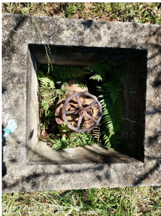
Caixa de registro do fundo
