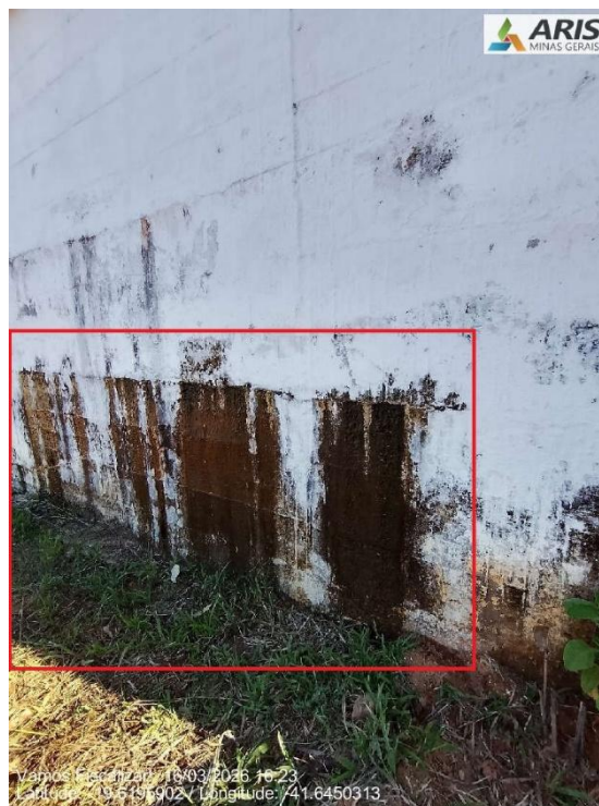
Vista lateral do decantador com indícios de vazamento de água da unidade. Ao tocar a estrutura, o analista de fiscalização observou que a estrutura estava úmida.
