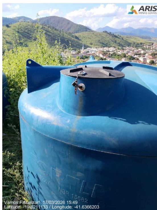
Tampa trancada com reservatório 01 (15 m 3 )
