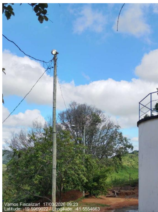
Iluminação na área externa próximo do tanque de contato
