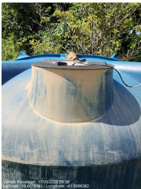
Ausência de cadeado na tampa de inspeção.
