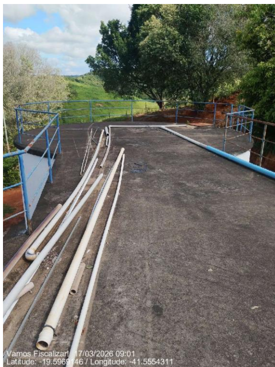
Cobertura da primeira câmara do tanque de contato com presença de várias tubulações
