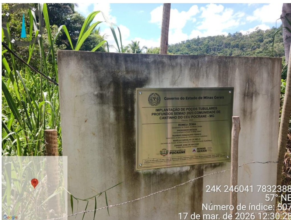
Captação Subterrânea Cantinho do Céu - Identificação da captação
