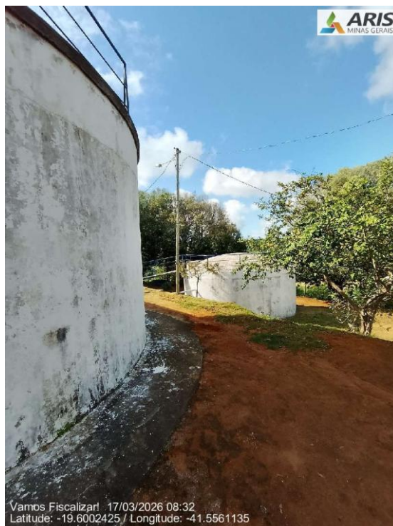
Tanque de contato a frente e reservatório ao fundo.
