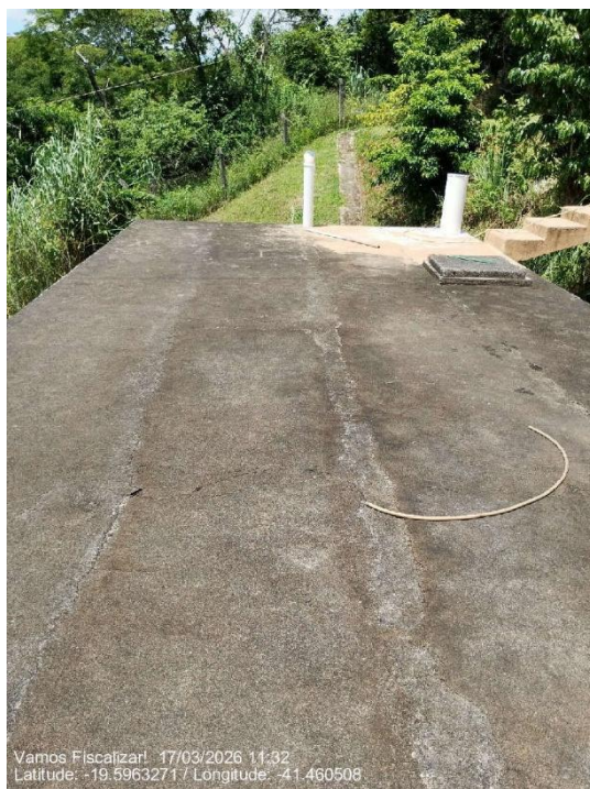
Cobertura do reservatório
