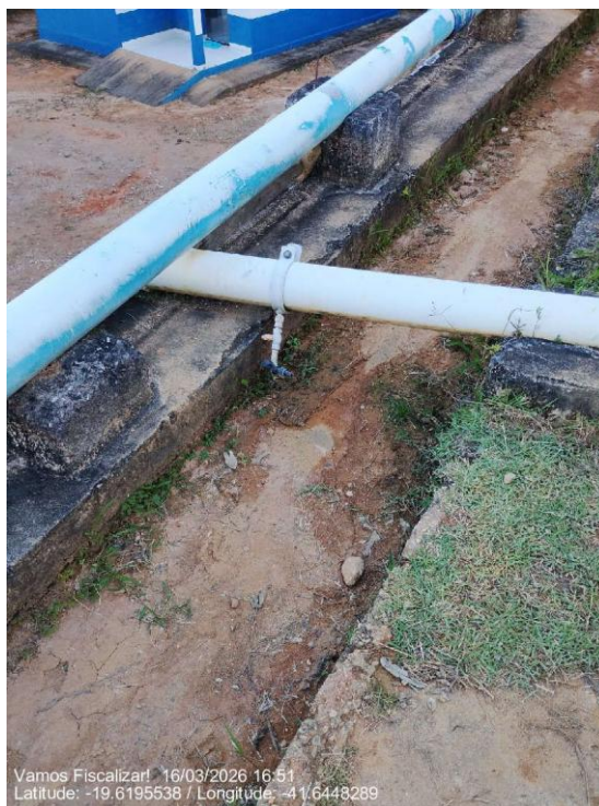
Torneira de coleta de água filtrada (Circular)
