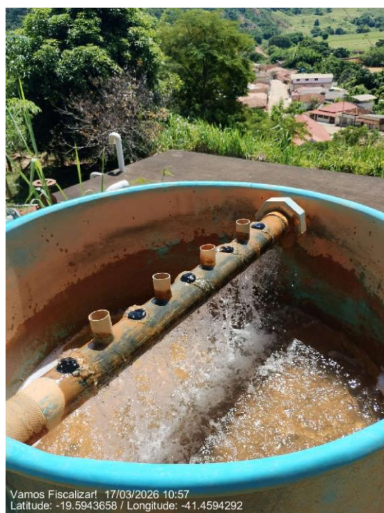
Filtro em operação
