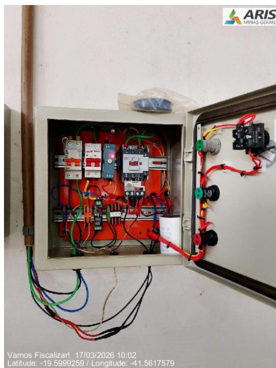
Painel controlador aberto.
