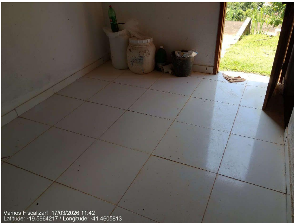
Interior da ETA
