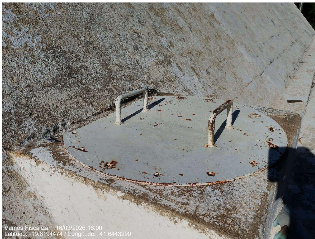
Tampa de inspeção do Reservatório II sem cadeado.
