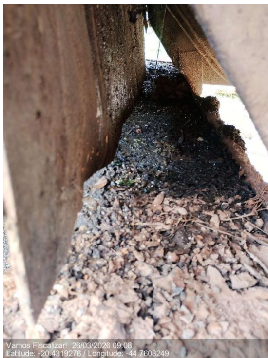
Calha coletora de chorume obstruída.
