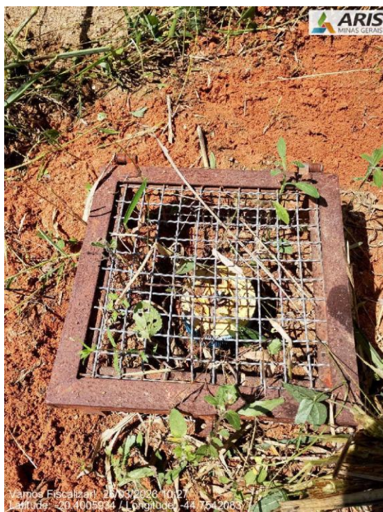
Poço de monitoramento.
