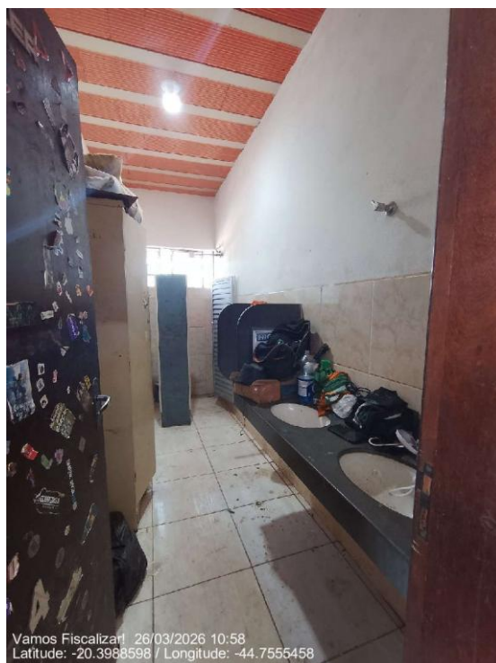
Condições gerais de higiene inadequadas dos sanitários.
