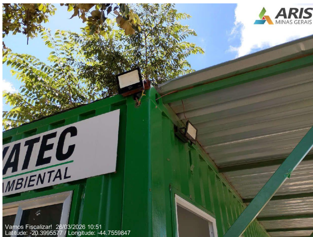
Iluminação na área administrativa.
