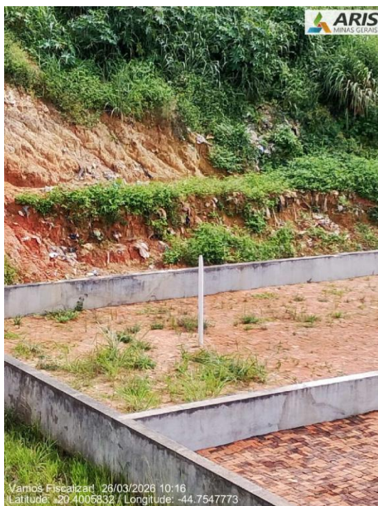
Suspiro da drenagem de chorume.
