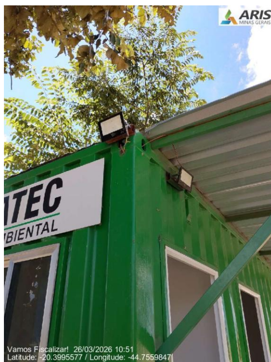
Iluminação na área administrativa.
