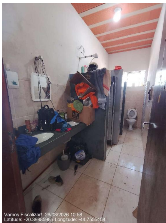
Condições gerais de higiene inadequadas dos sanitários.
