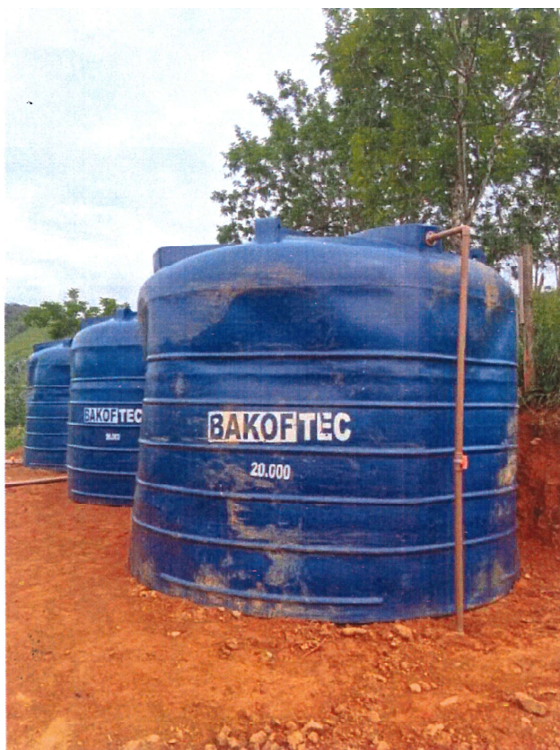
Foto 1: Reservatórios instalados na localidade de Paraíso
