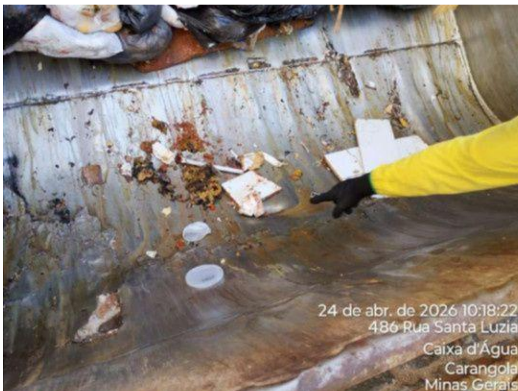
Corte na estrutura metálica onde o resíduo é colocado e posteriormente prensado.
