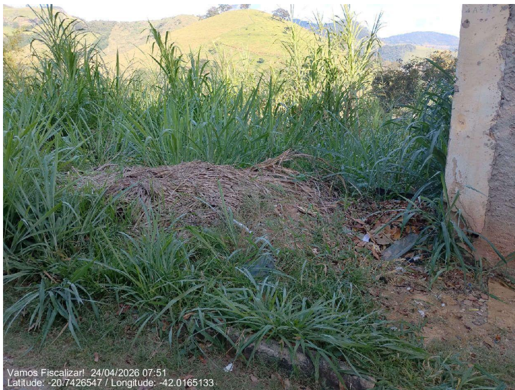
Ponto de disposição inadequada de RS
