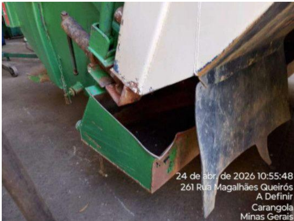
Canaleta de chorume.
