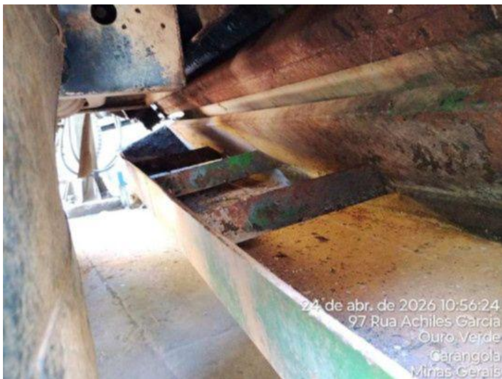
Canaleta de chorume.
