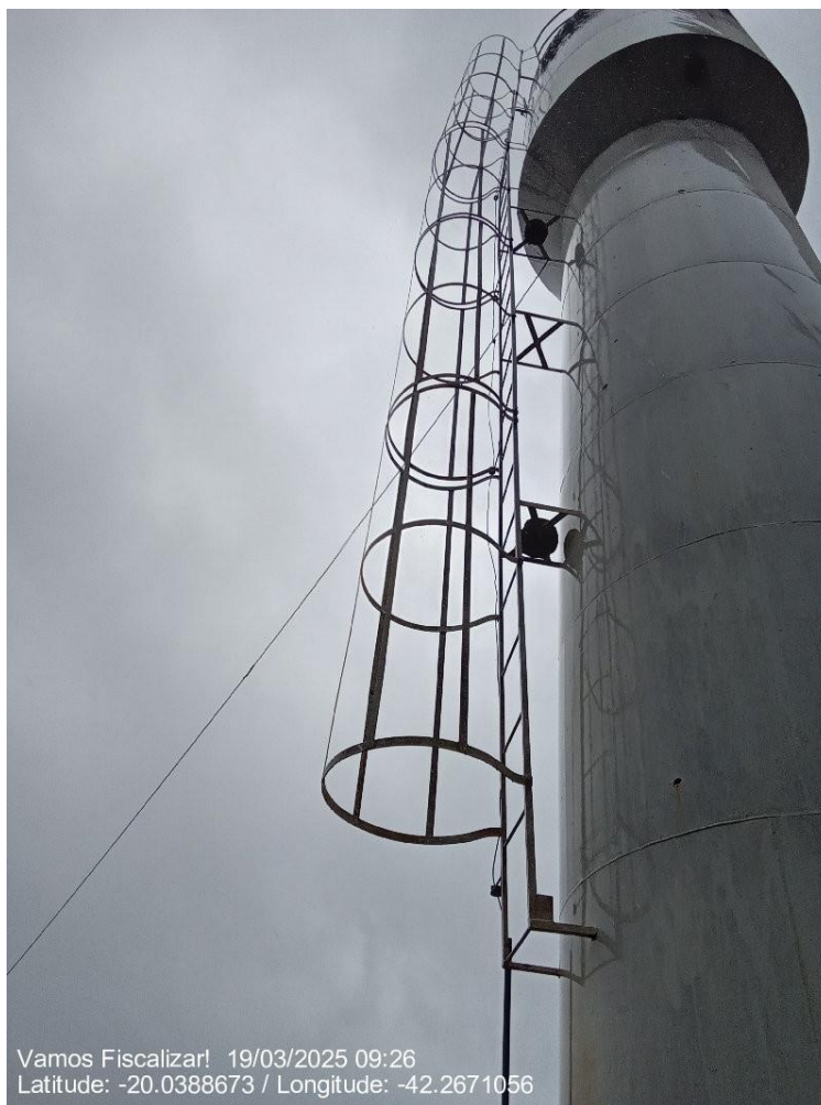
Reservatório Cidade Jardim II.
