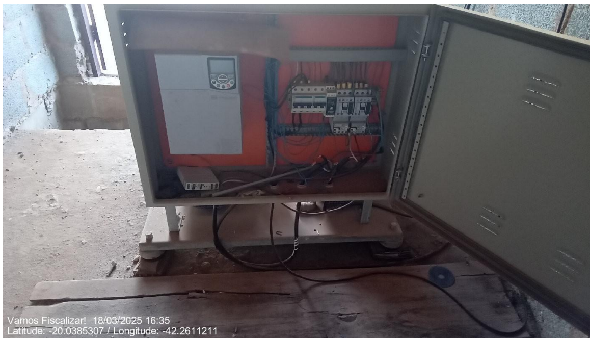
Quadros de comando e painéis.
