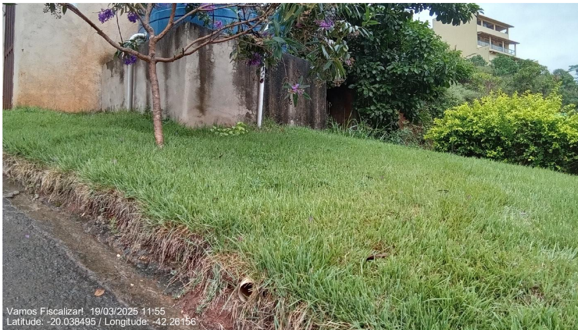
Presença de tubo extravasor.
