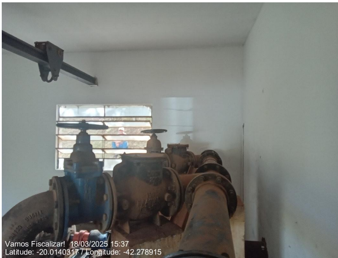
Ausência de dispositivo de monitoramento de vazão.
