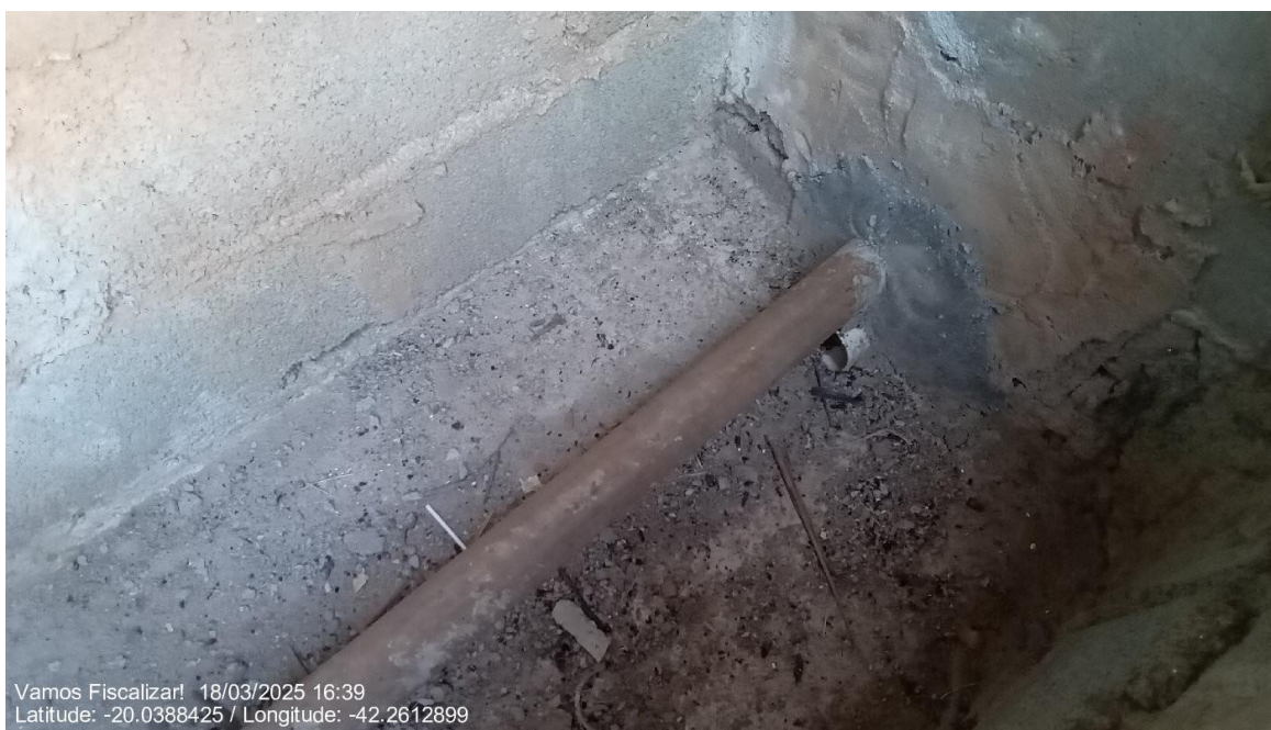
Tubo de drenagem.
