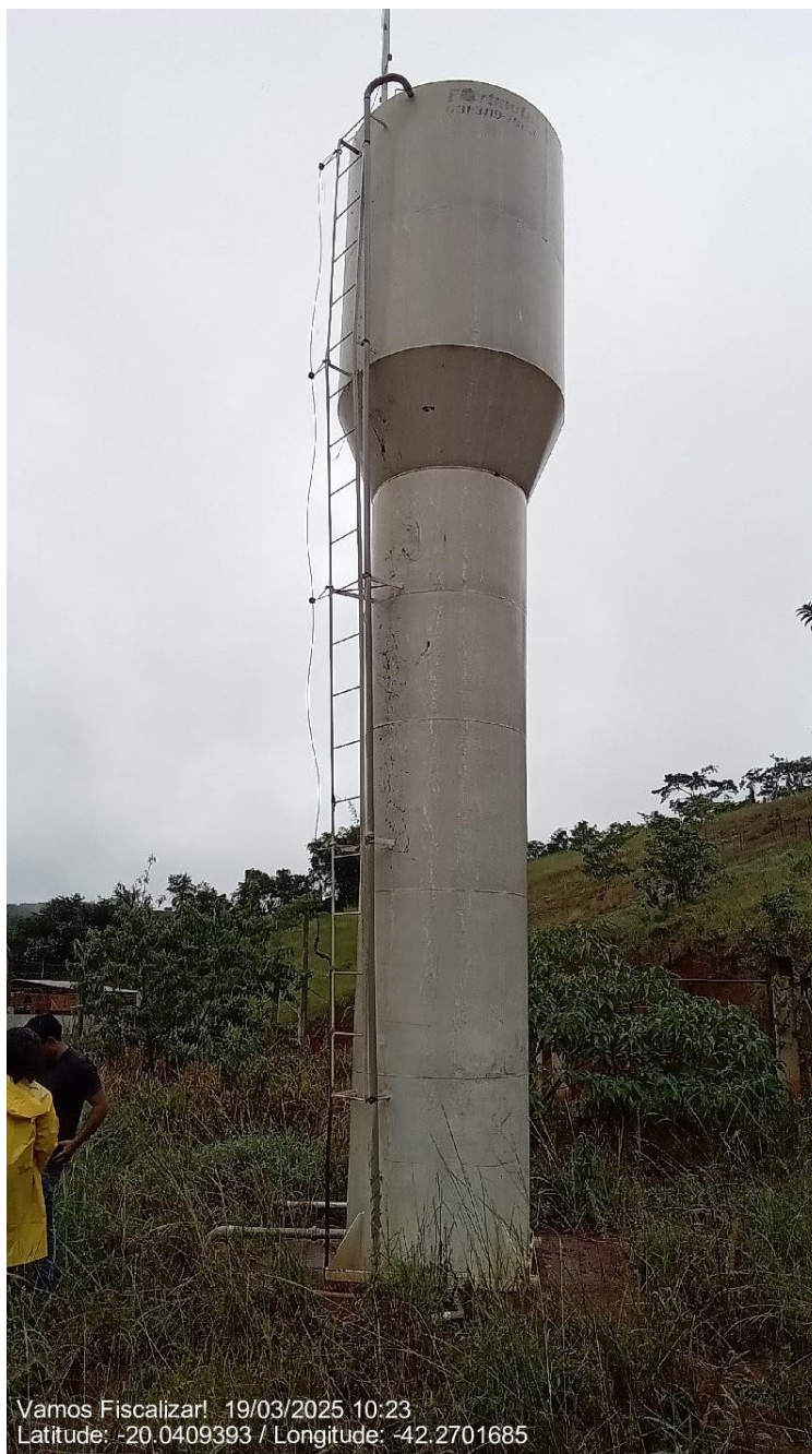
Extravasor com tubulação.
