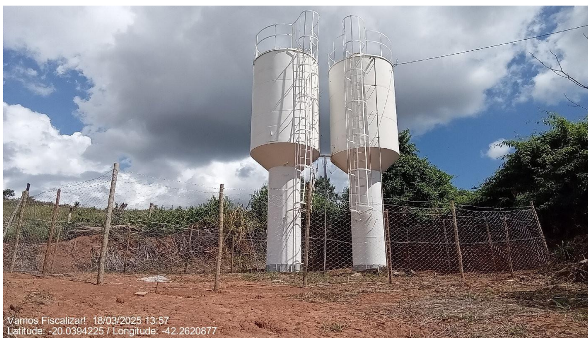
Cercamento do Reservatório Casas Populares.
