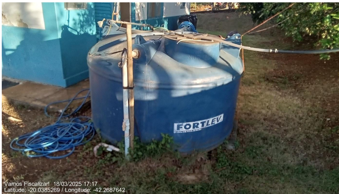
Reservatório Polietileno ETA.
