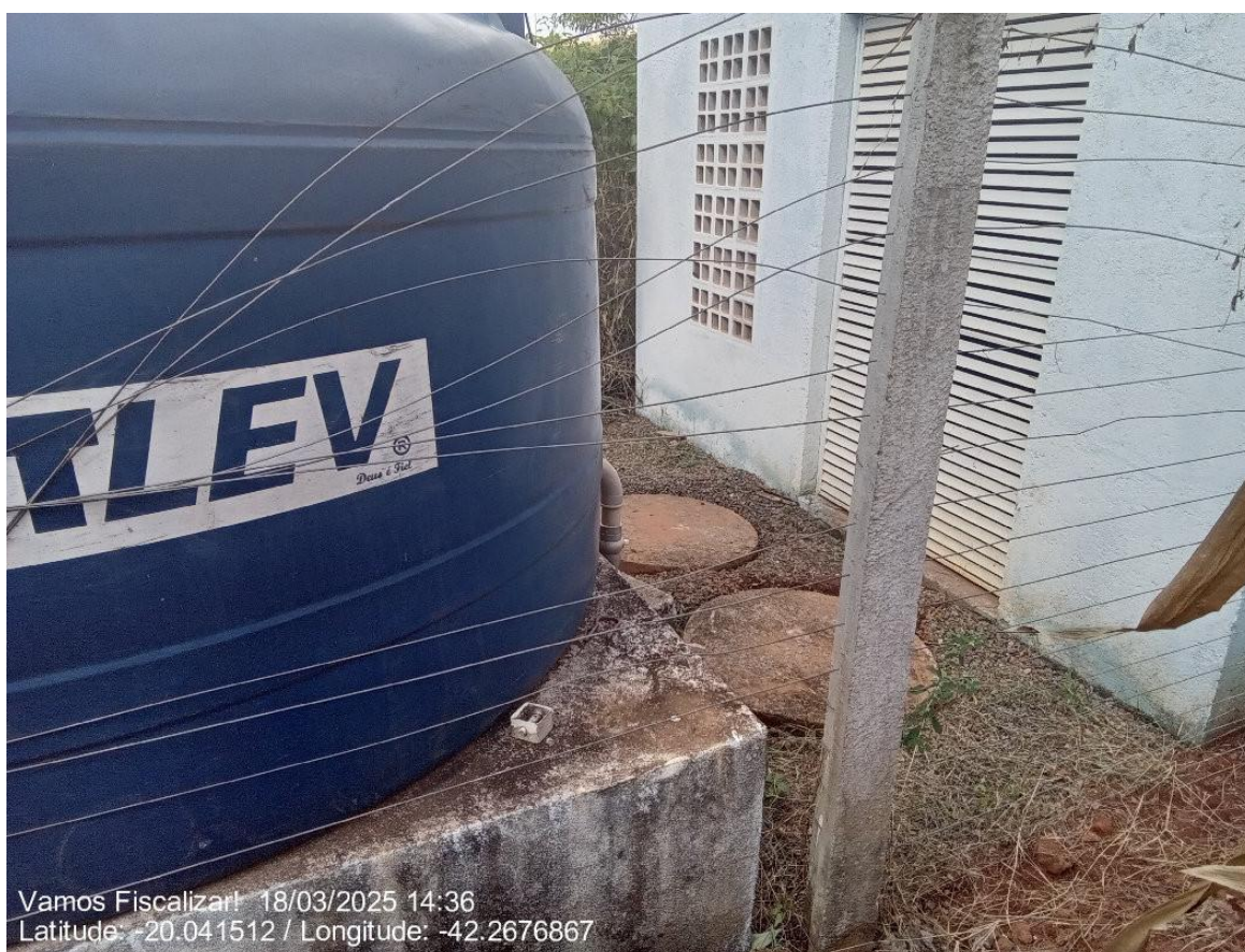
Cercamento com defeito no Reservatório Cidade Jardim II.
