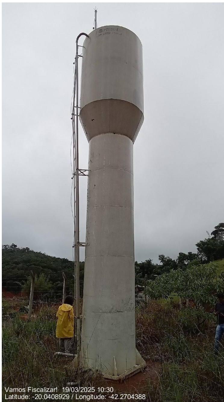
Ausência de tubo de descarga de fundo.
