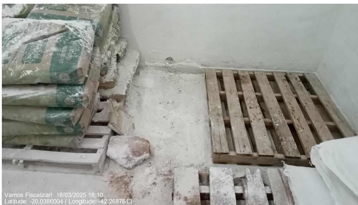
Condições de limpeza da casa de química.
