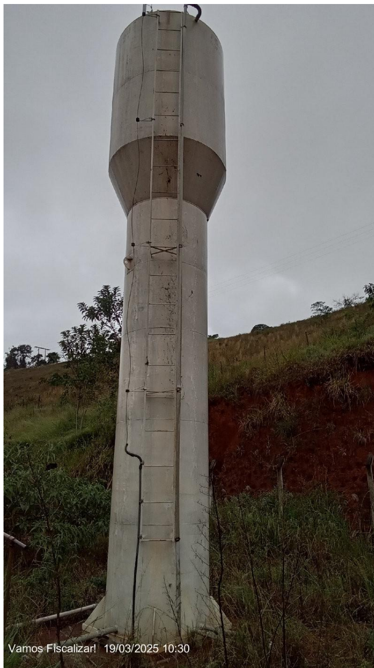
Ausência de tubo de descarga de fundo.
