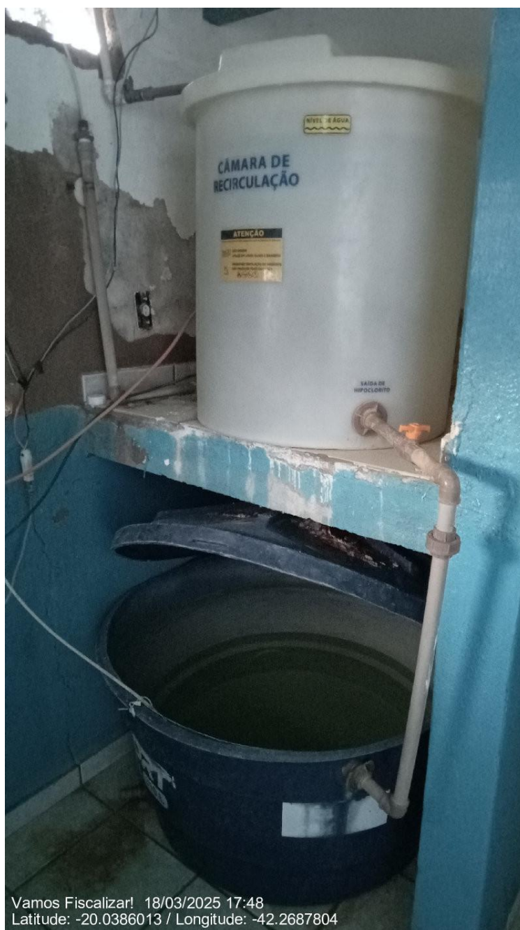
Reservatório e misturador.
