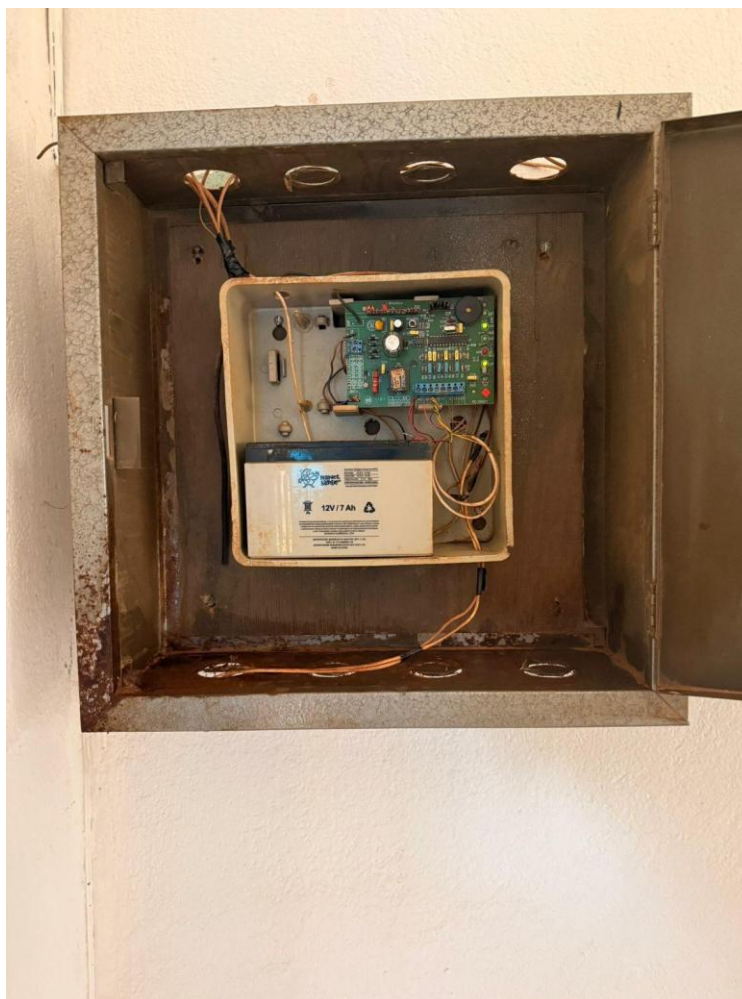
Disjuntores e caixa de proteção.
