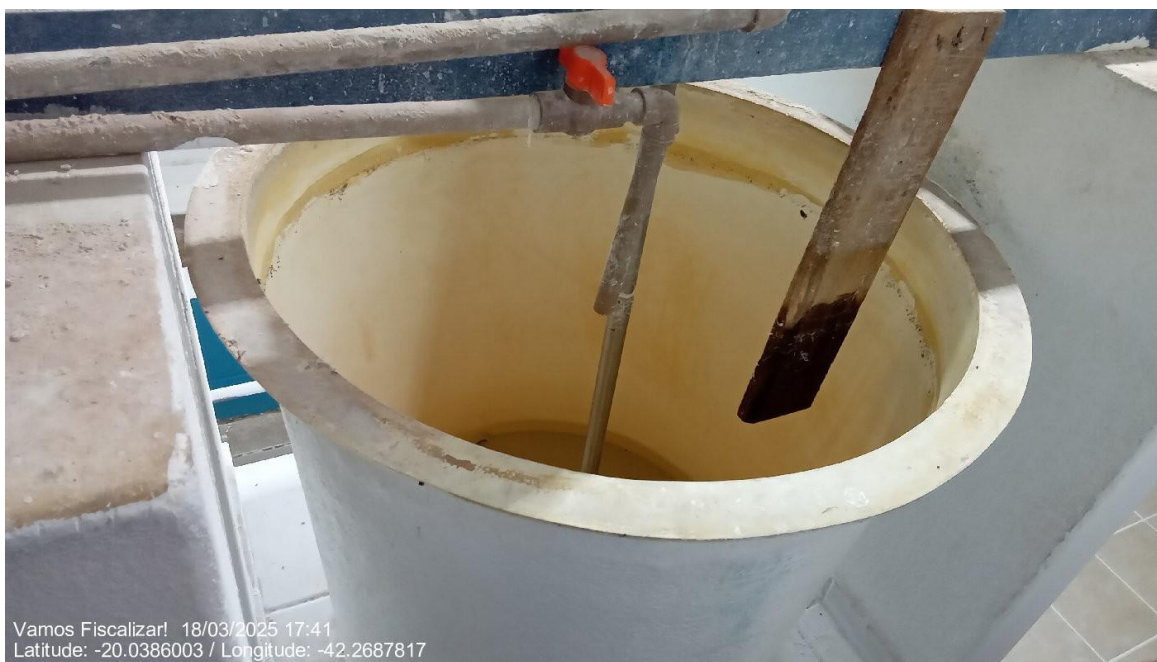
Dois tanques de 250L utilizados de forma reversada.
