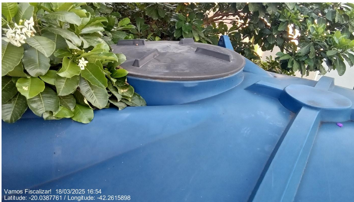
Tampa de inspeção.
