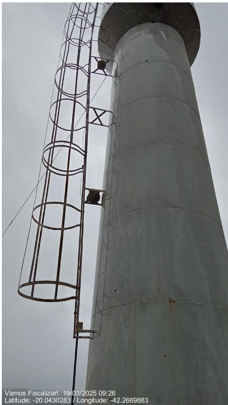
Reservatório Cidade Jardim II.
