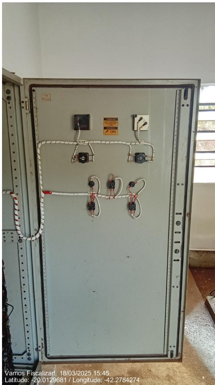
Quadros e cabos elétricos.
