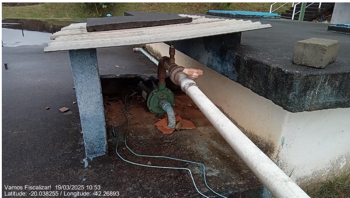
EEAT Principal sem vazamentos aparentes.
