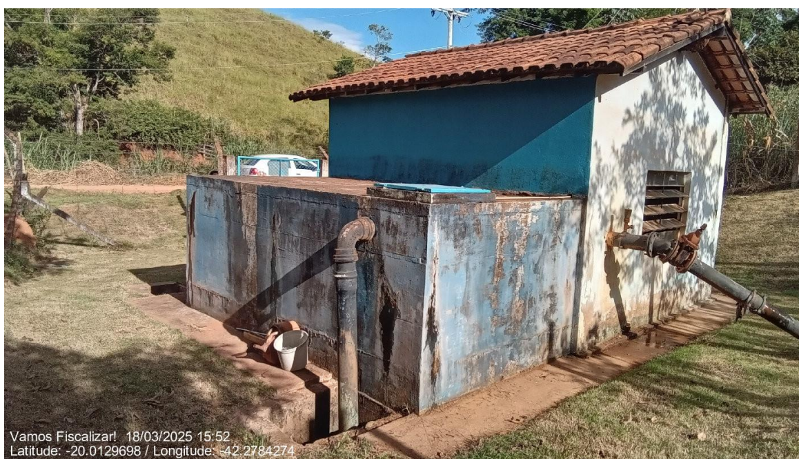
Poço de sucção.
