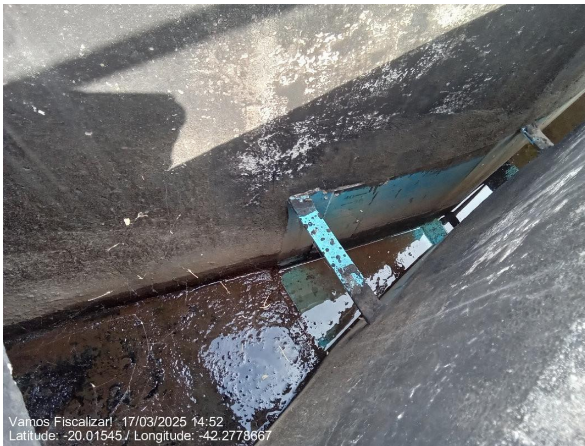
Régua na calha parshall de entrada.
