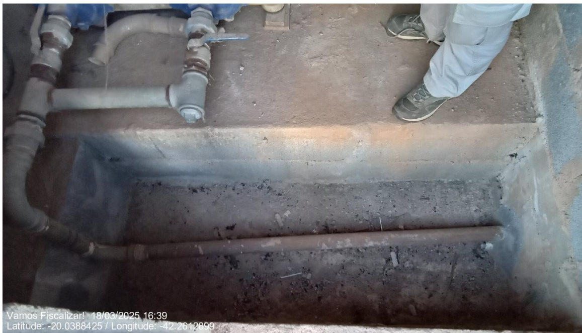
Tubo de drenagem.
