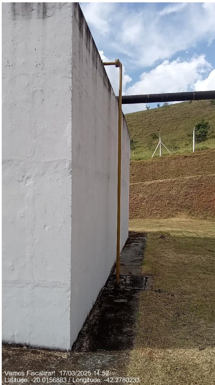
Tubulação de gás.
