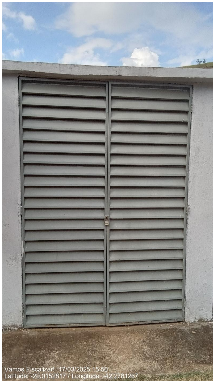
Acesso aos quadros e cabos elétricos.
