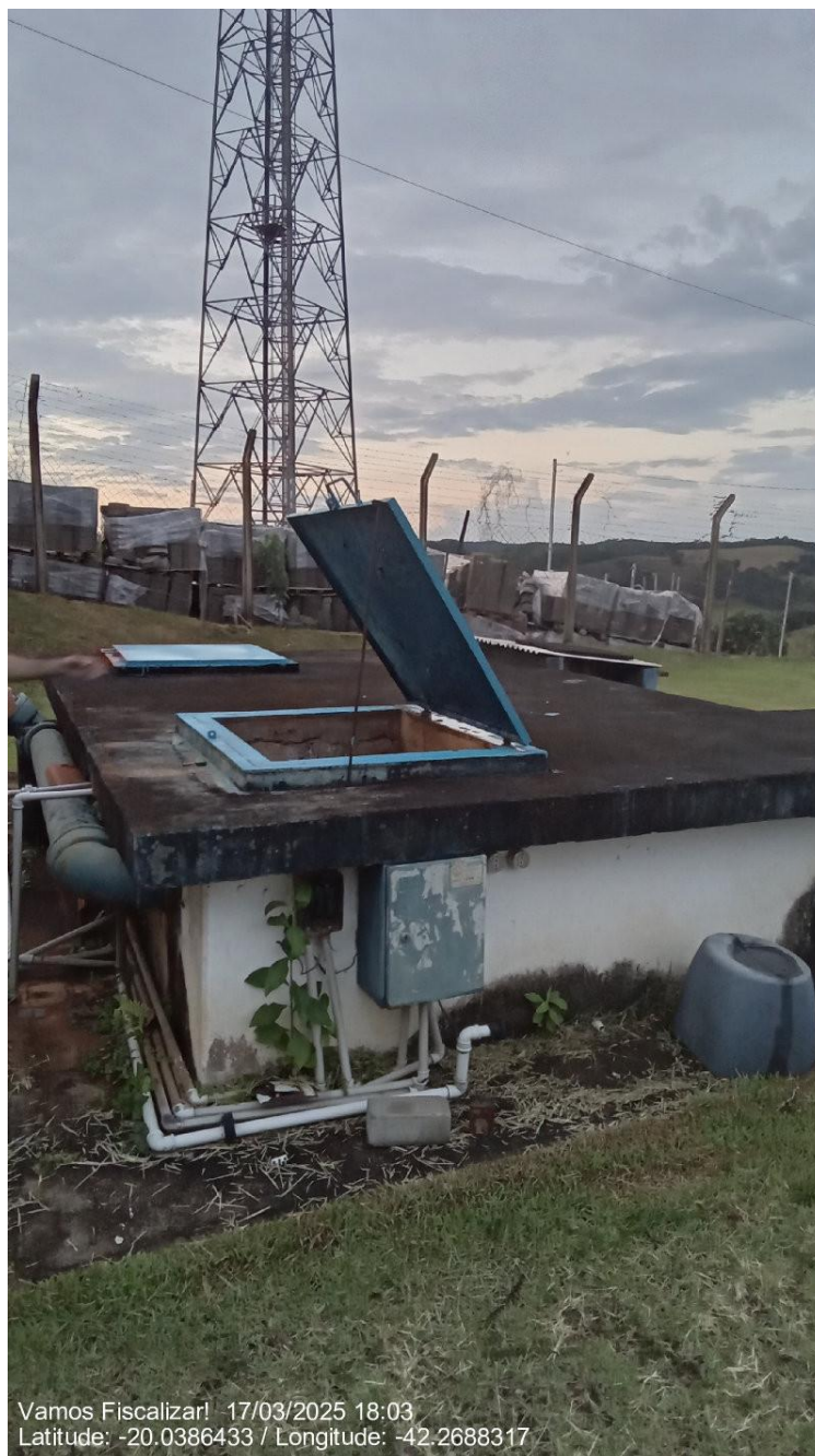
Tanque de contato.
