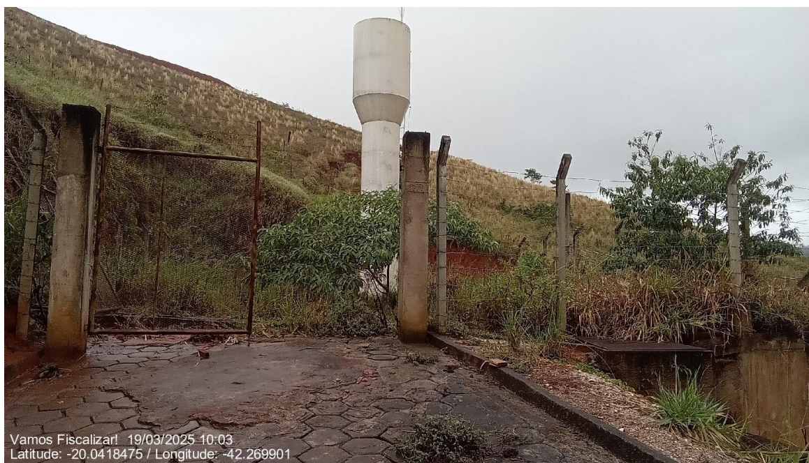
Área do reservatório sem portão.
