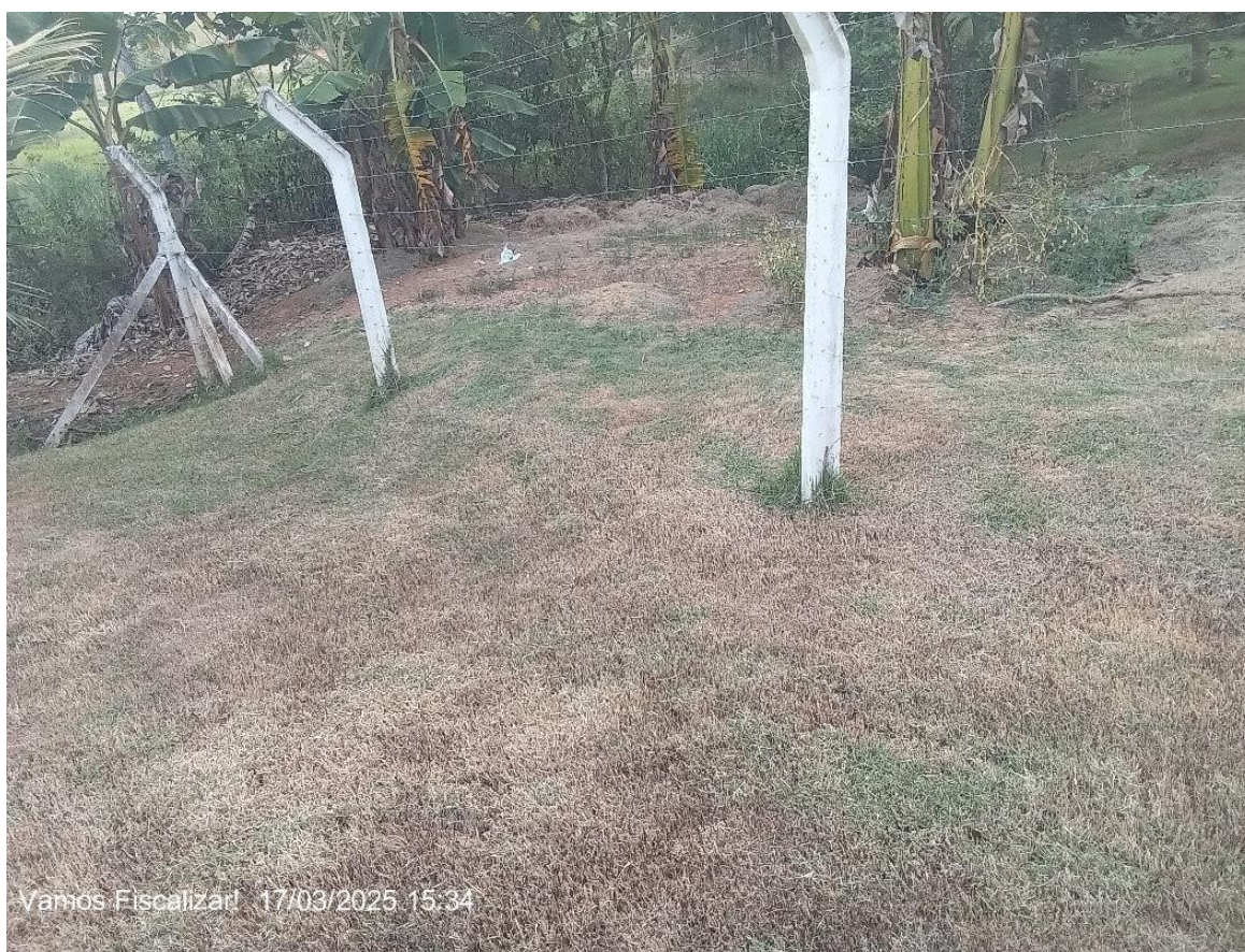
Falha no cercamento da ETE.
