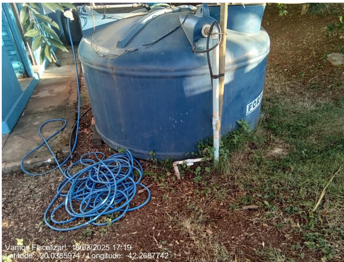
Reservatório Polietileno ETA.
