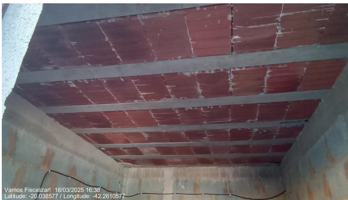
Ausência de iluminação para trabalhos noturnos.
