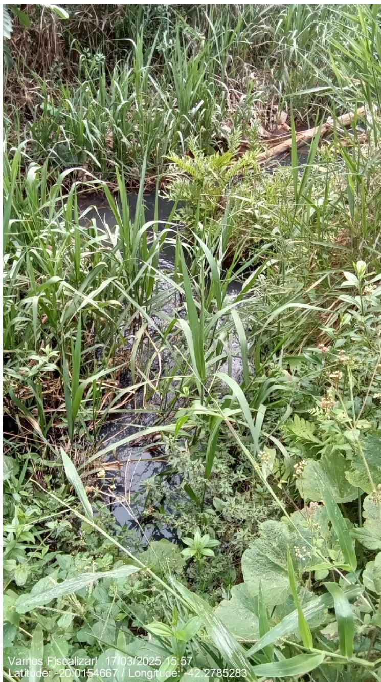
Ladrão do reator UASB.
