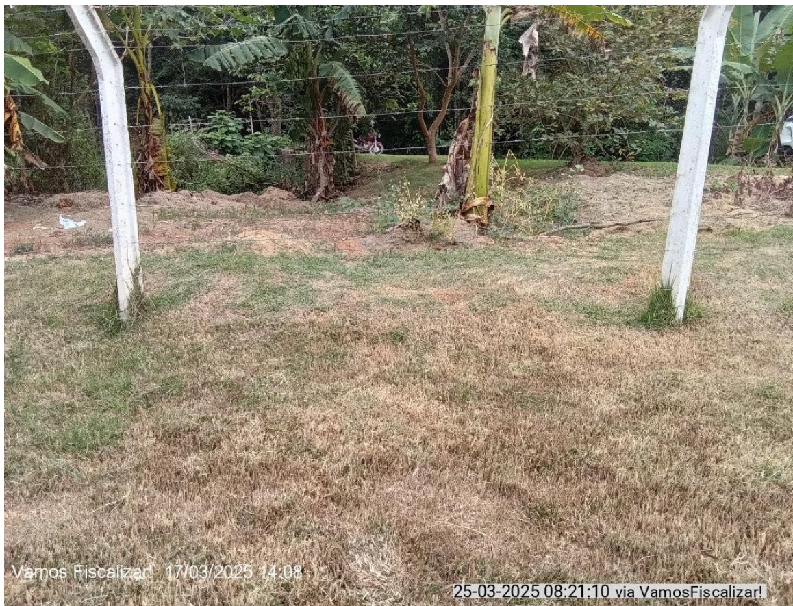
Imagem do cercamento danificado.
