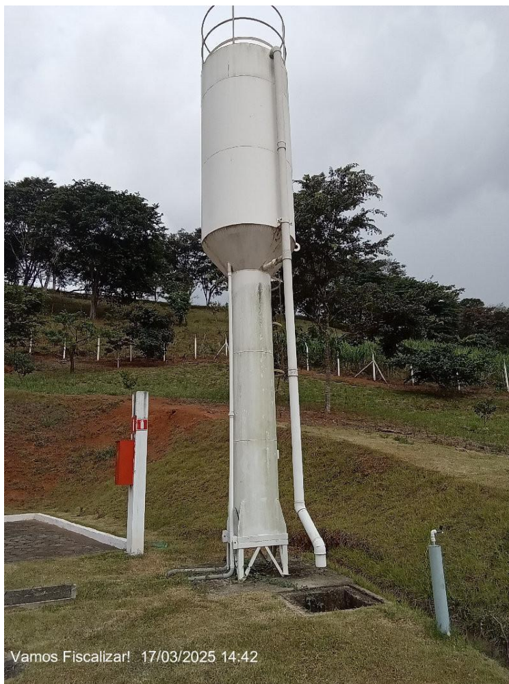
Imagem do tubo extravasor e sua caixa de descarga.
