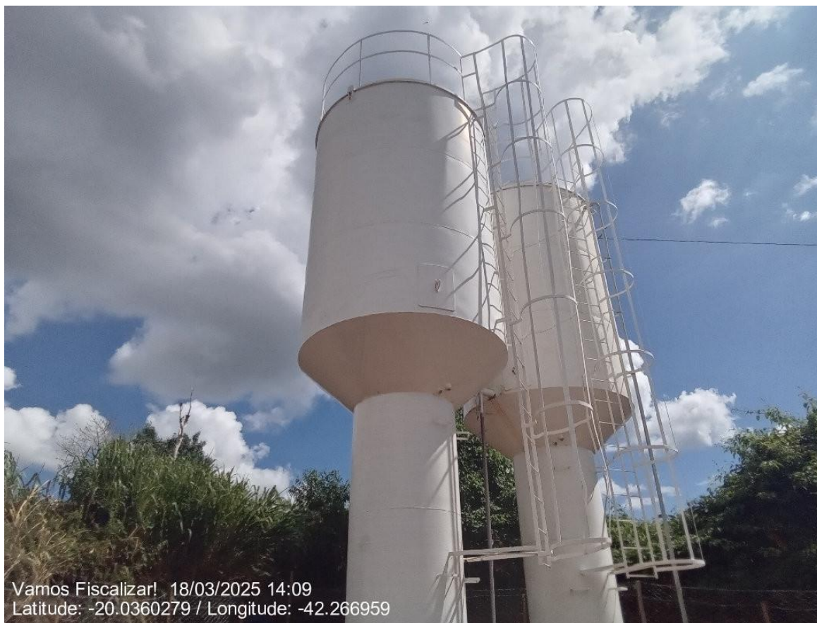
Reservatório Casas Populares.
