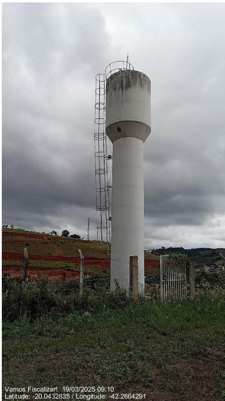
Reservatório Cidade Jardim II.
