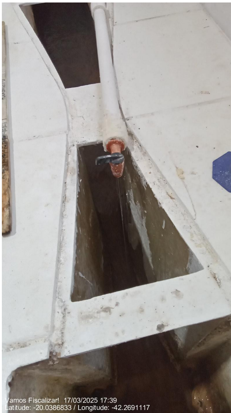
Adição de sulfato de alumínio na calha parshall.
