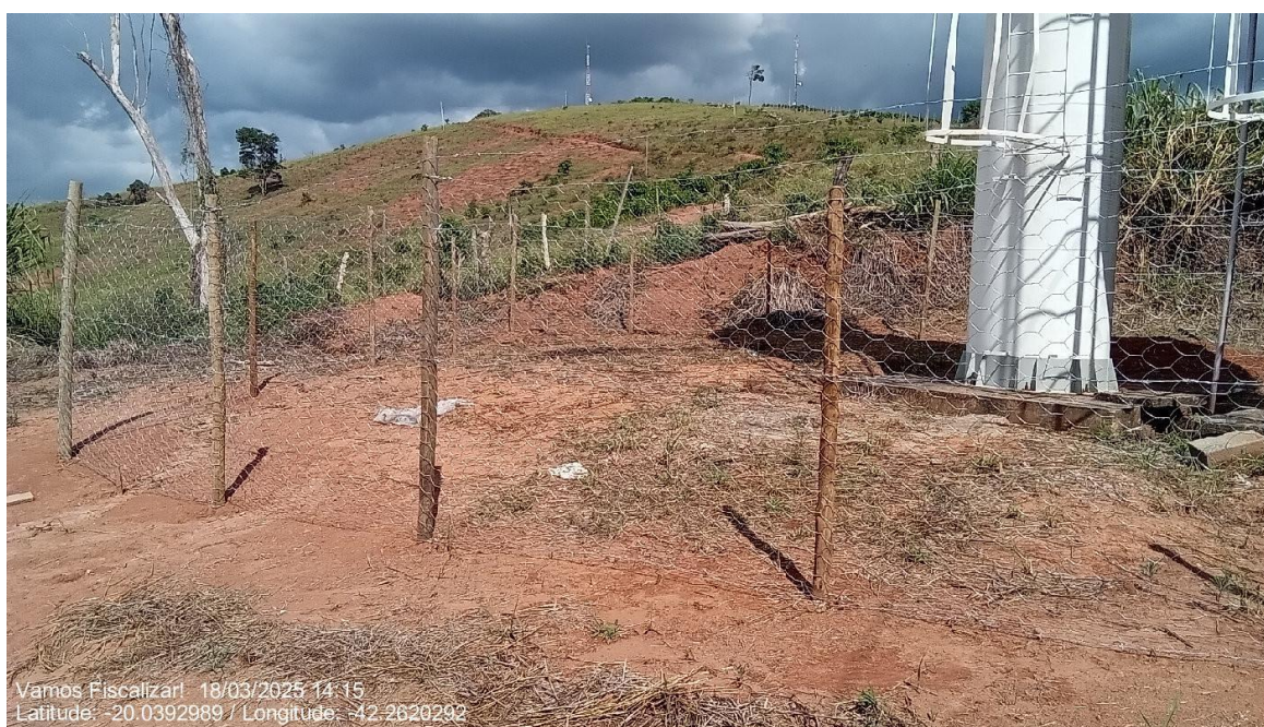
Ausência de placas de identificação e aviso.
