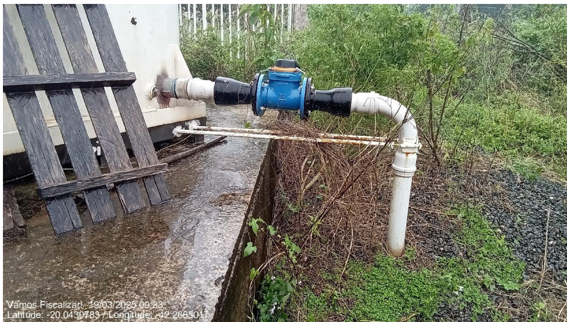
Tubulação de entrada do reservatório.
