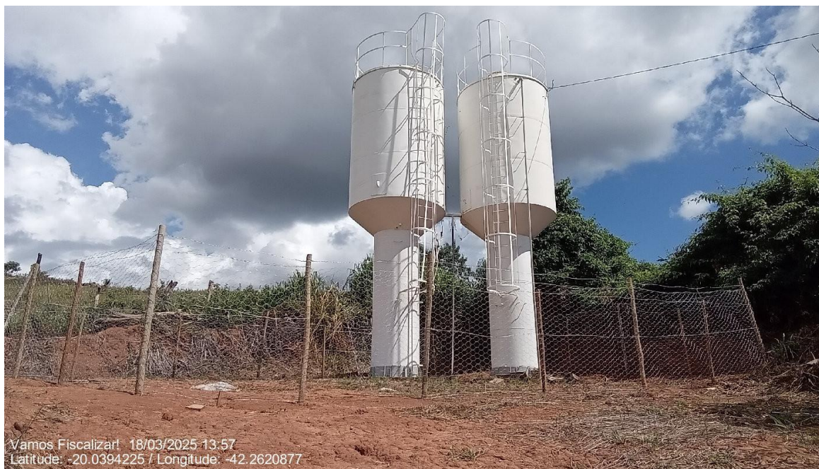
Reservatório Casas Populares.
