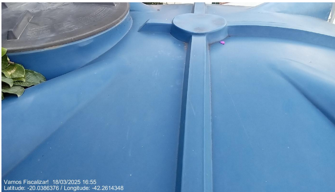
Cobertura do reservatório.
