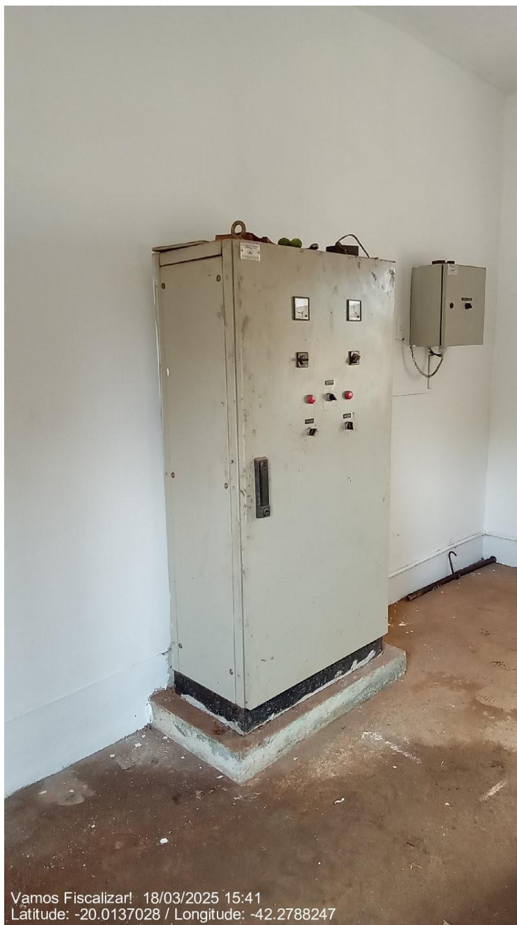
Quadros de comando e painéis.
