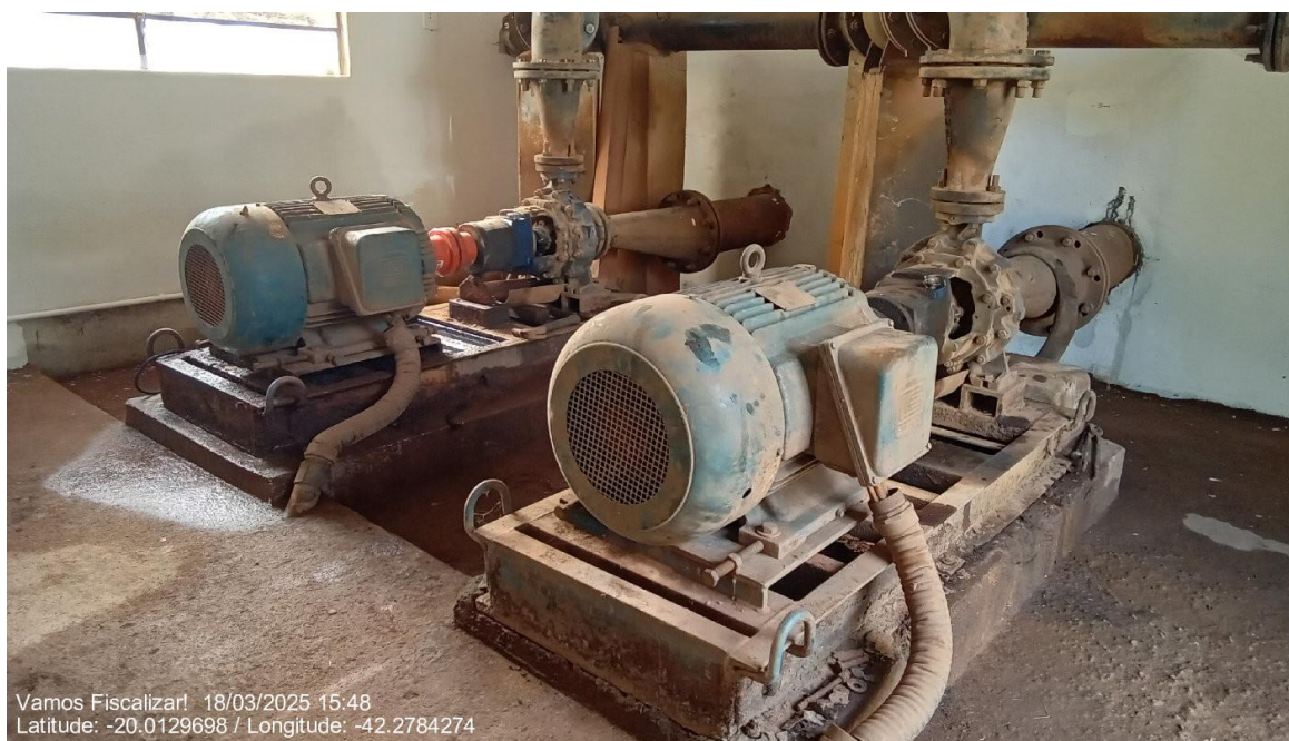
Motobombas da EEAB Principal Vermelho Novo.
