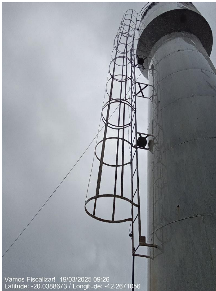
Reservatório Cidade Jardim II.
