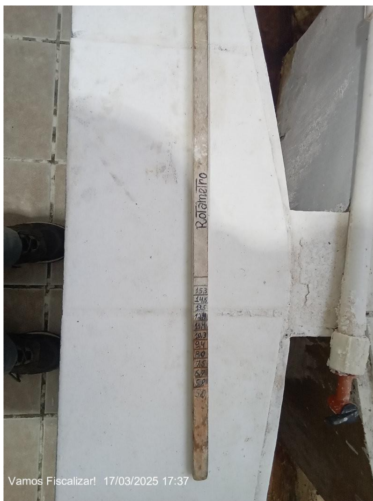
Calha Parshall na entrada da ETA.
