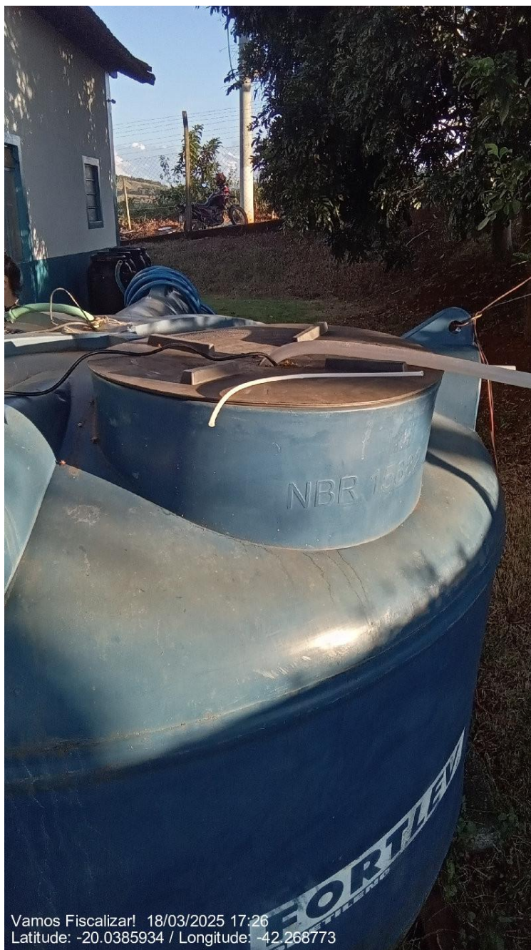
Tampa de inspeção.
