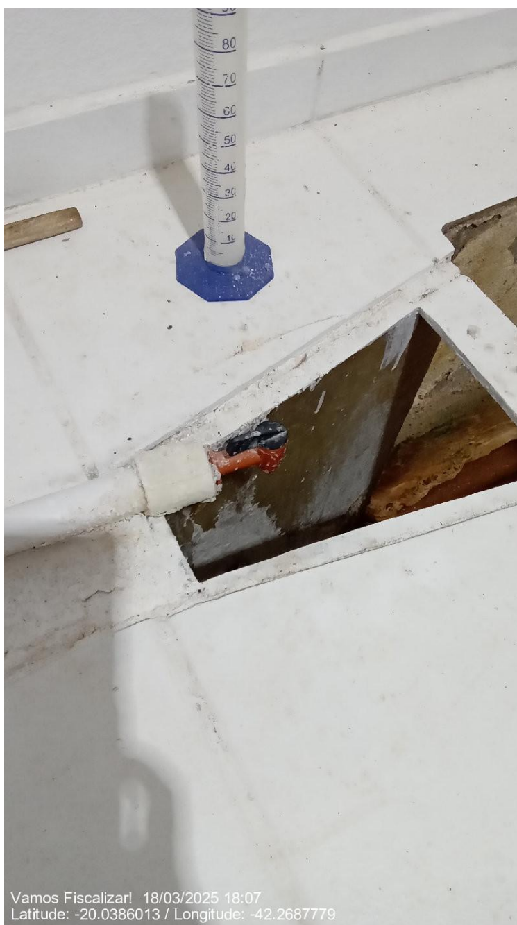
Dosador de sulfato de alumínio.
