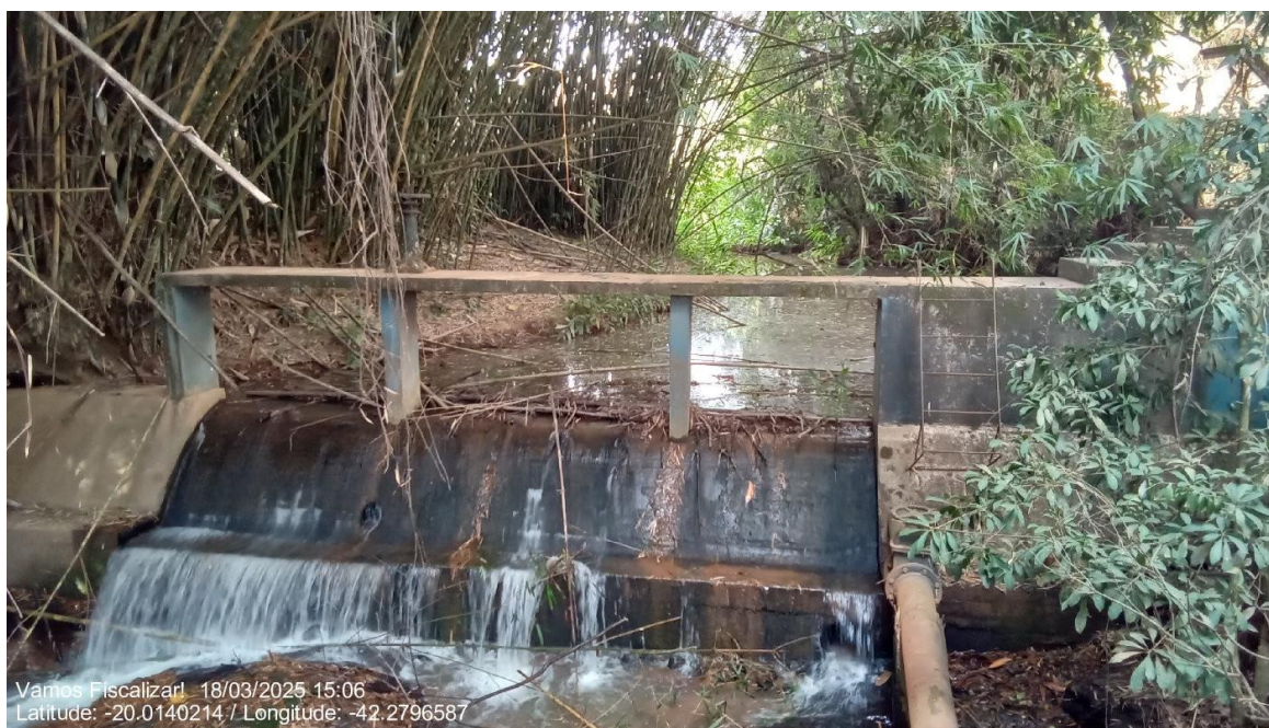
Barramento da Captação Superficial Vermelho Novo.
