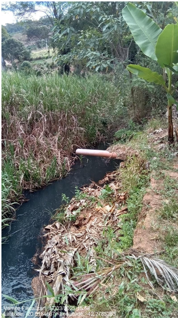
Tubulação de limpeza do cesto da elevatória.
