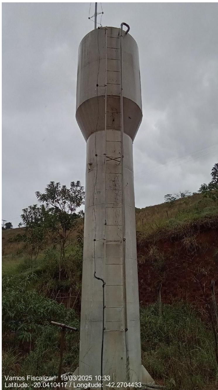
Reservatório Cidade Jardim I.
