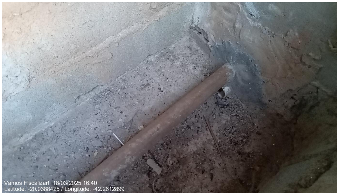
Tubo de drenagem.
