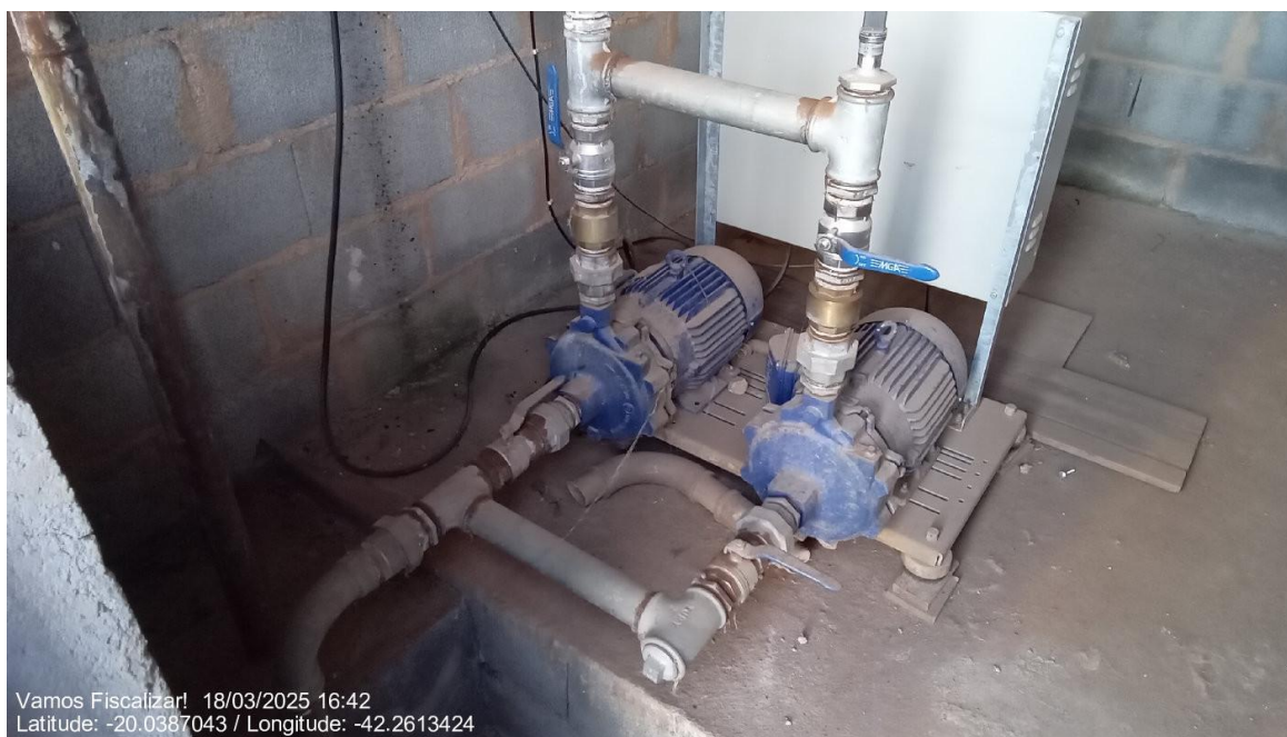
Motobombas da EEAT Casas Populares.
