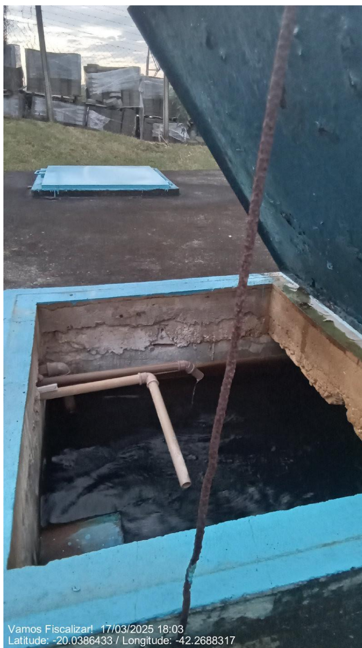
Tanque de contato.
