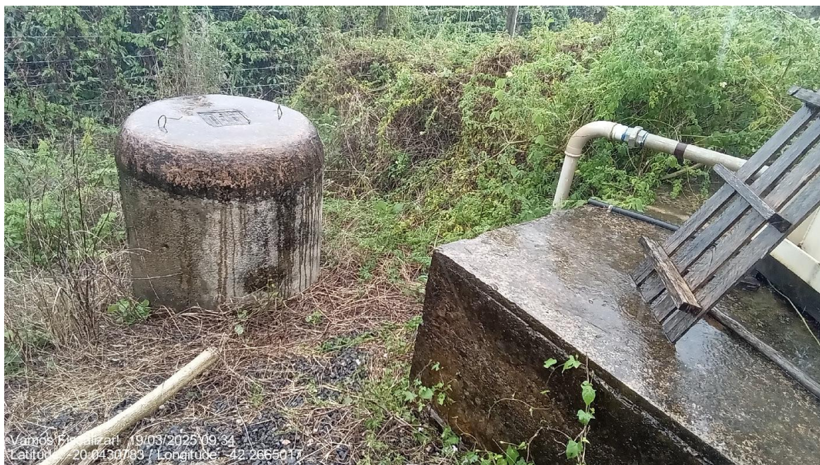
Tubulação de saída do reservatório.
