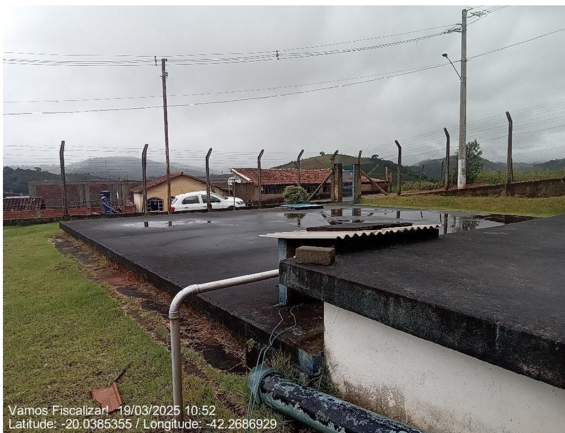
Localização da EEAT Principal.
