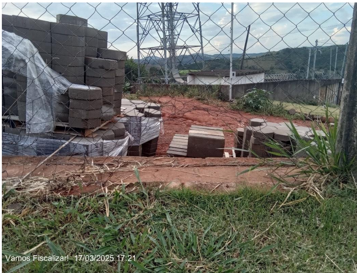
Buraco no cercamento.
