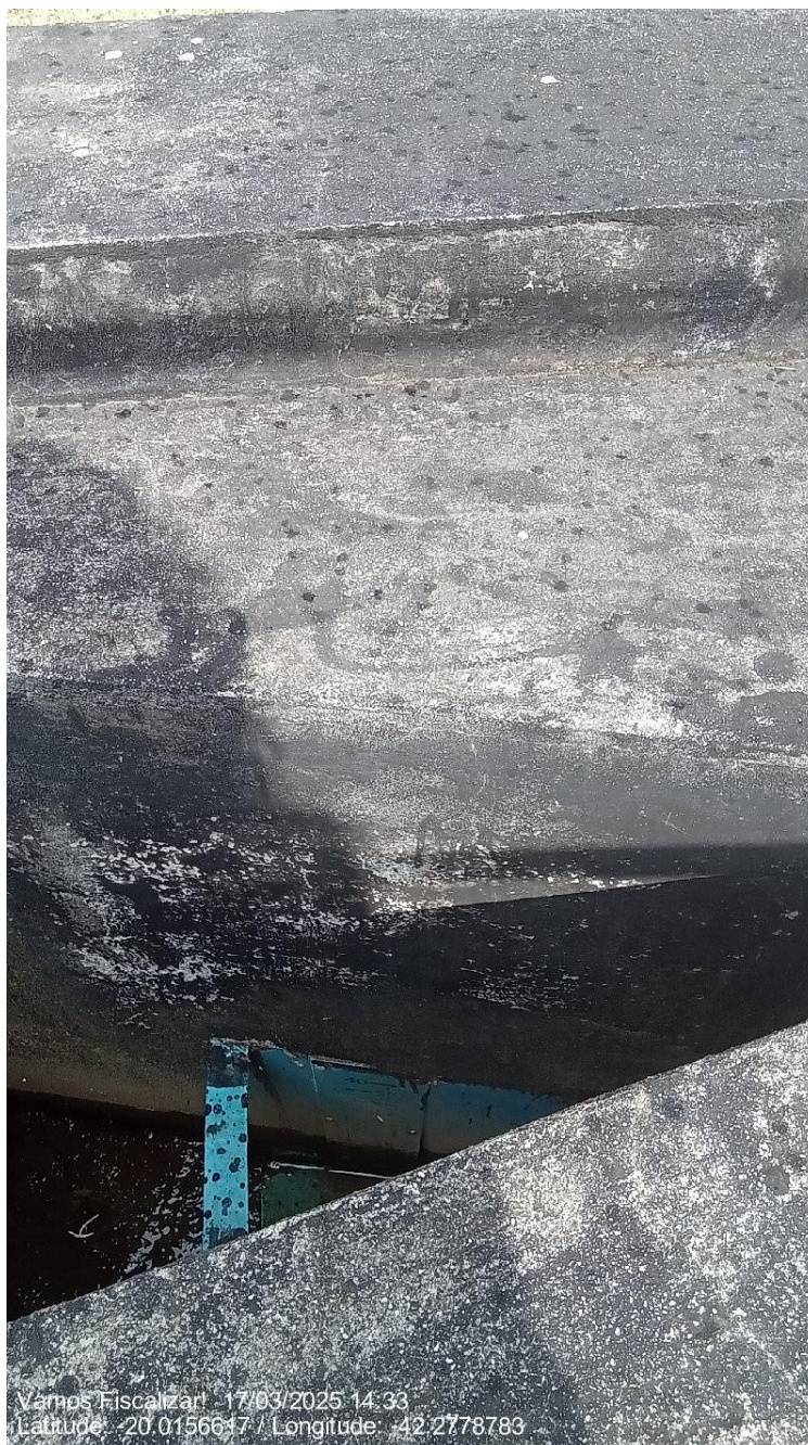
Régua na calha parshall de entrada.
