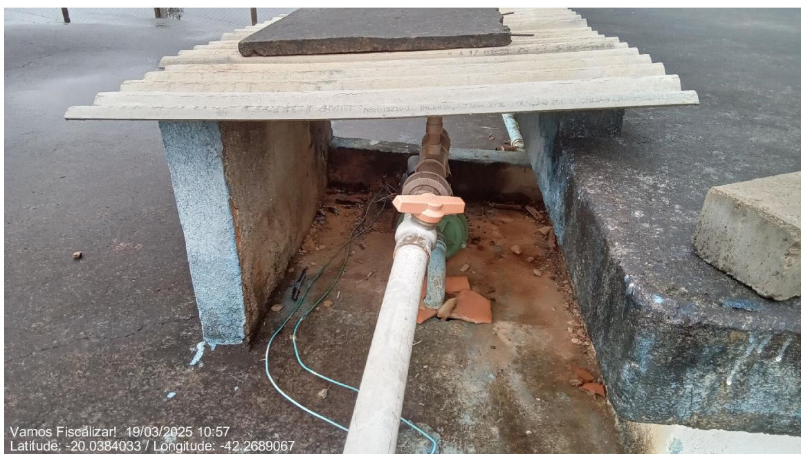
Ausência de sistema de drenagem no piso.
