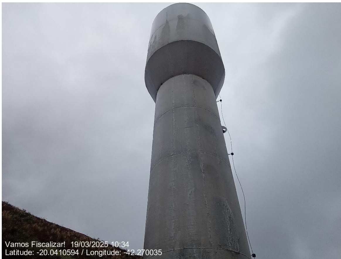
Reservatório Cidade Jardim I.
