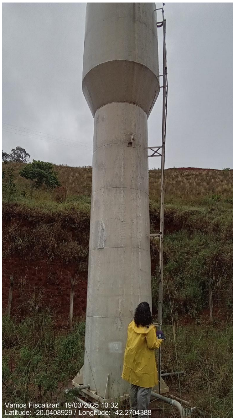
Reservatório Cidade Jardim I.
