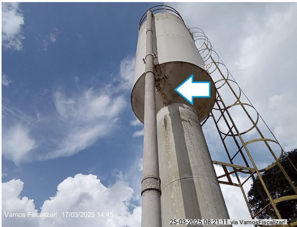
Imagem da conexão do tubo de descarga com tubulação do extravasor.
