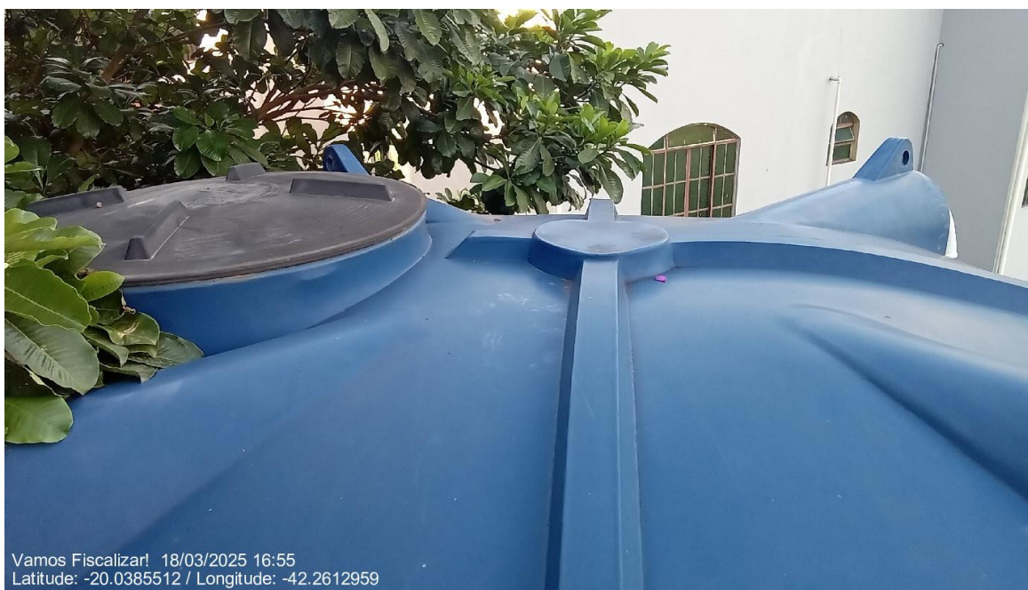
Ausência de tubo de ventilação.
