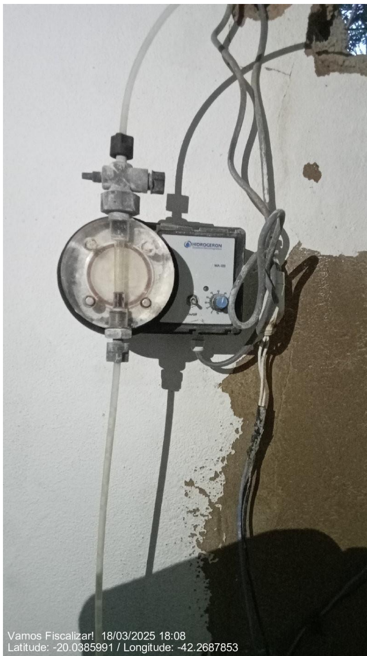
Bomba dosadora de cloro.
