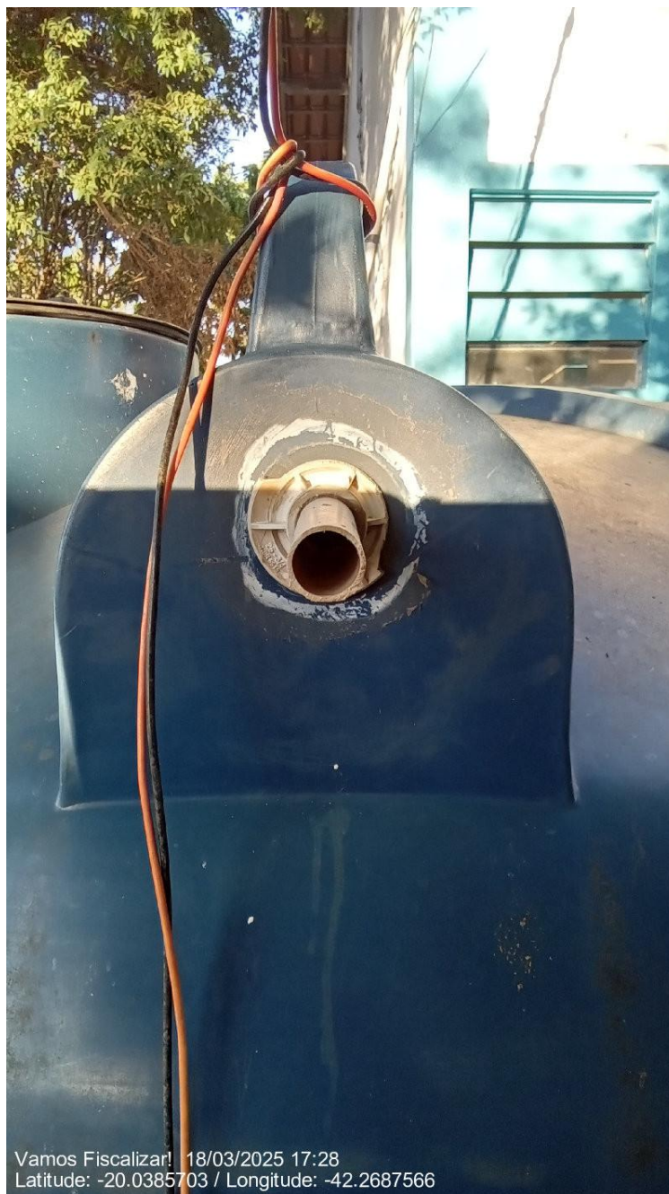
Tubo de ventilação.
