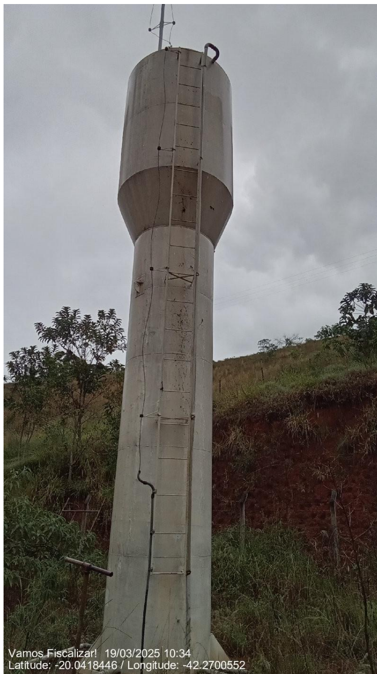
Reservatório Cidade Jardim I.
