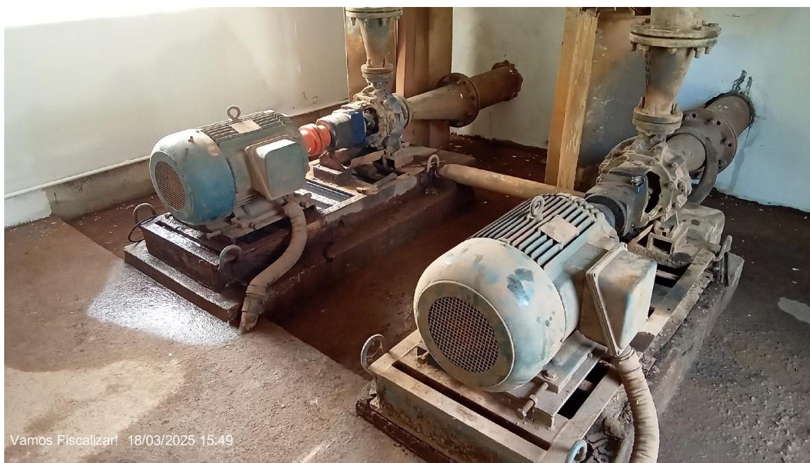
Vazamento na EEAB Principal Vermelho Novo.
