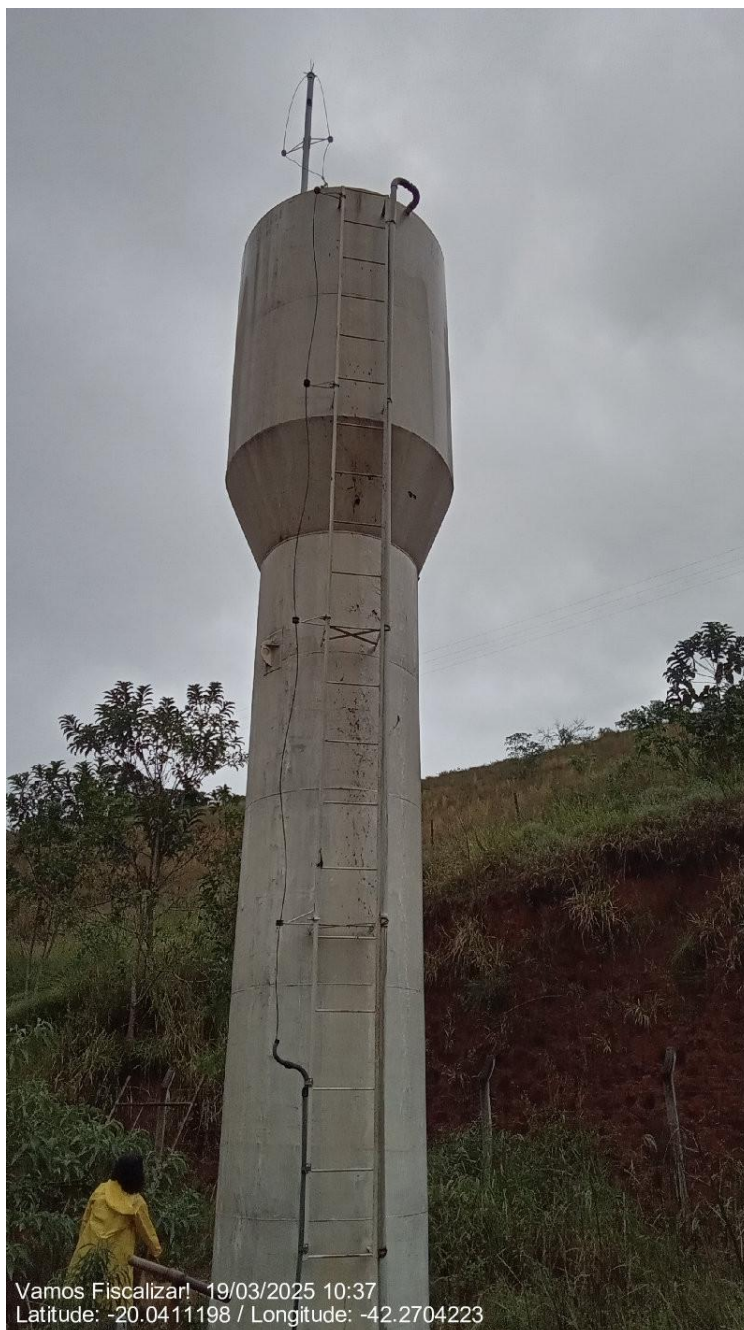
Reservatório Cidade Jardim I.
