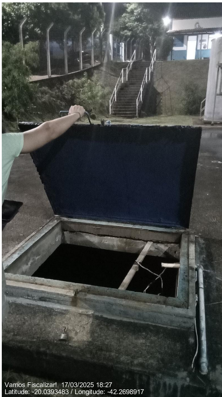
Tampa de inspeção.
