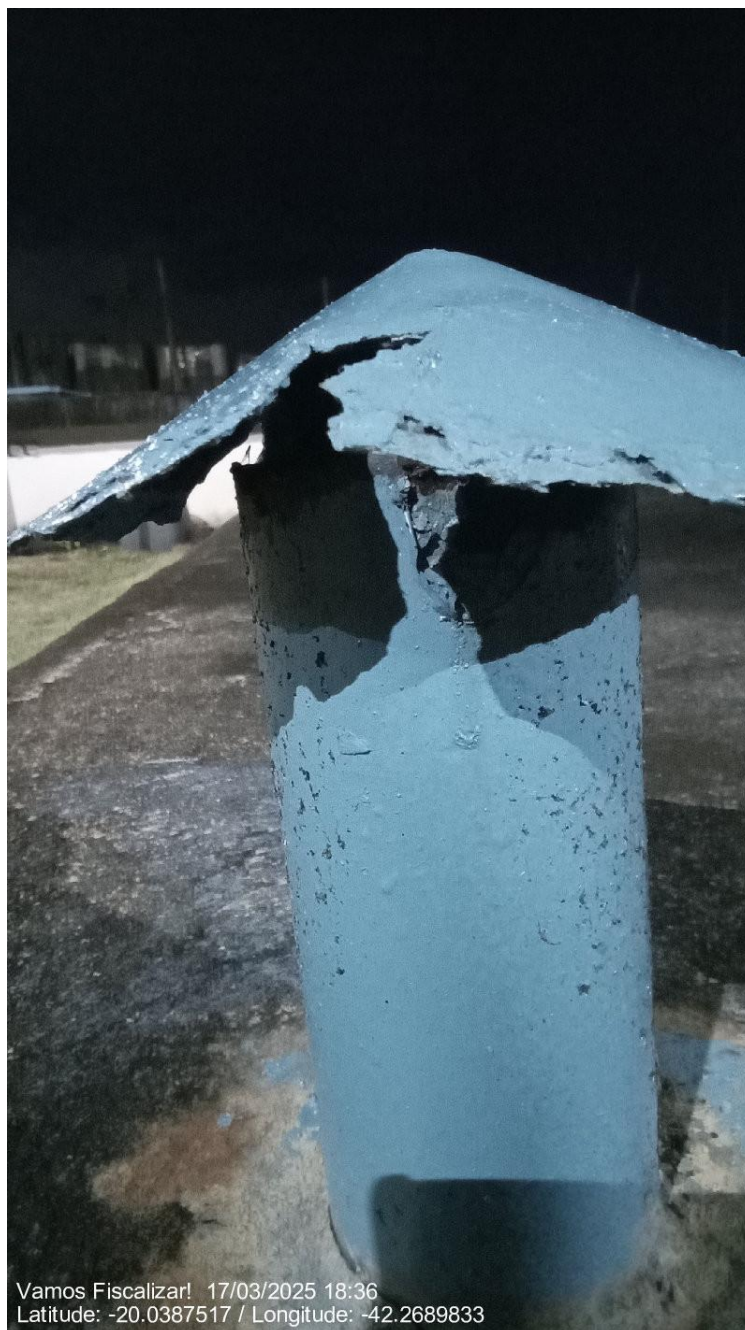
Ausência de tela.
