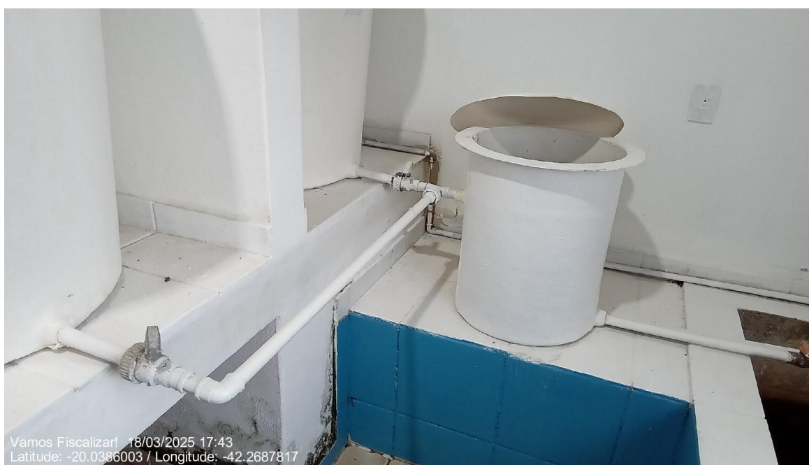
Saída dos tanques.
