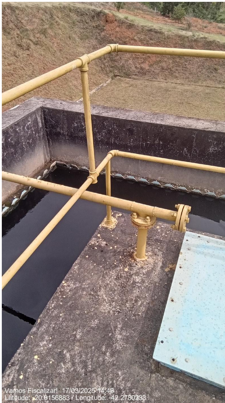
Canalização de gás que segue para o queimador.
