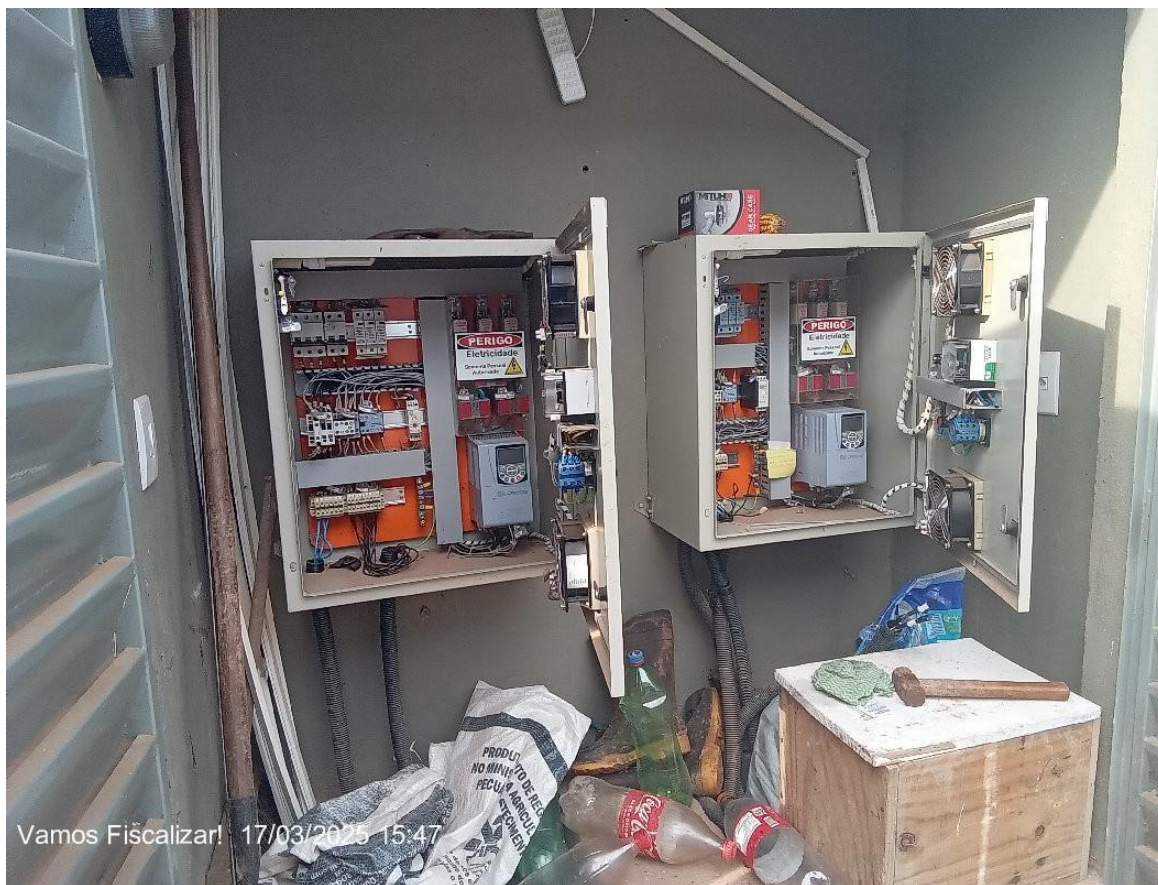
Quadros e cabos elétricos.
