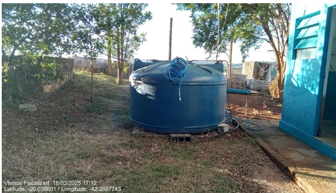
Reservatório Polietileno ETA.
