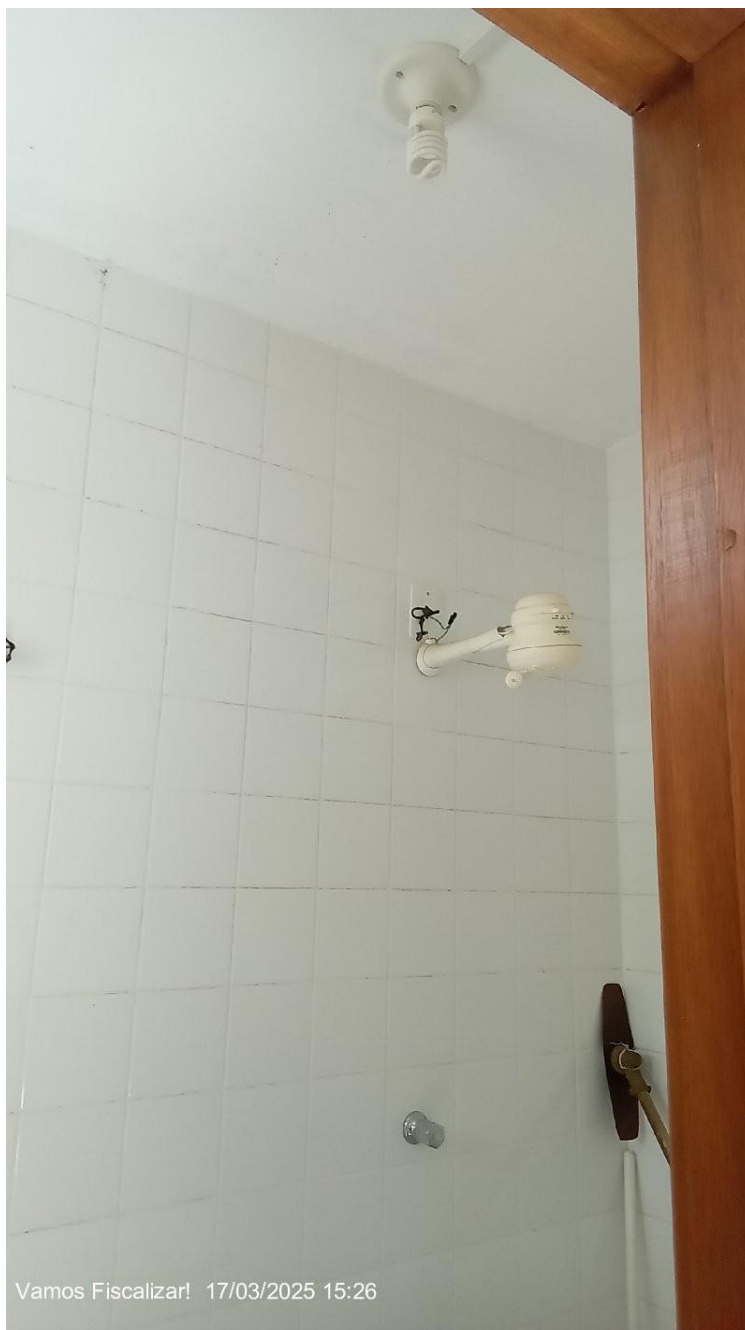
Lâmpada do banheiro queimada
