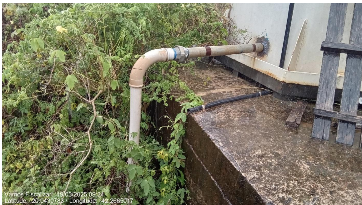
Tubulação de saída do reservatório.
