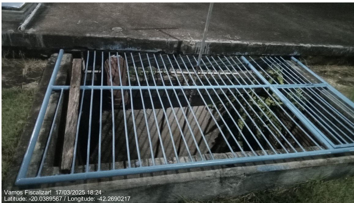
Tubo extravasor com caixa de descarga.
