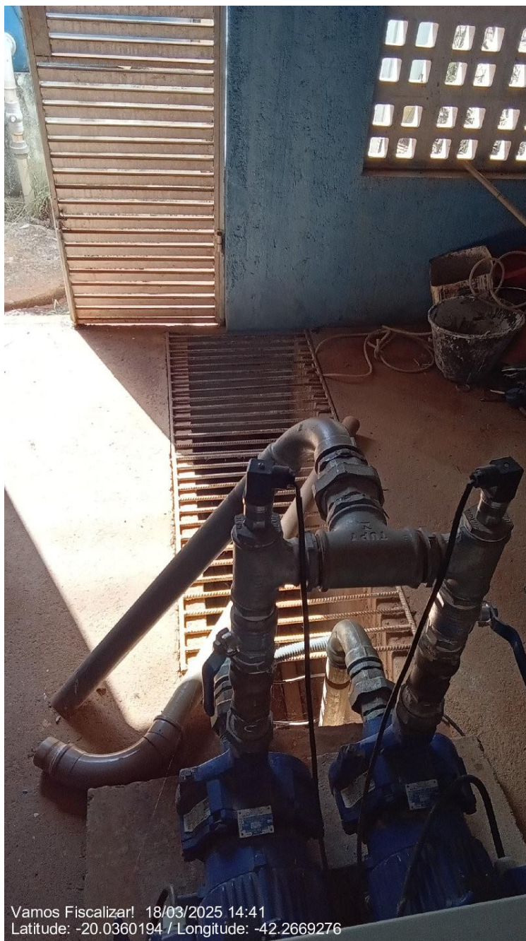
Reservatório Cidade Jardim II.
