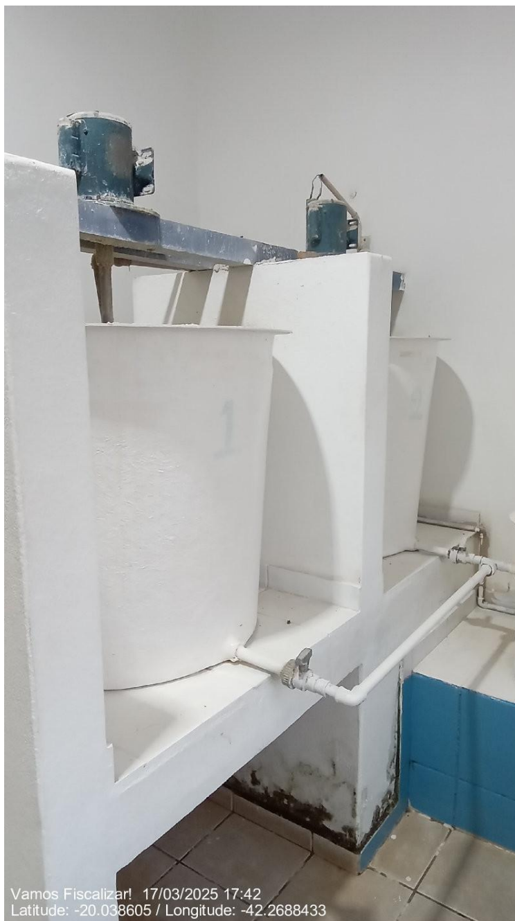
2 caixas de 250L com sulfato de alumínio.
