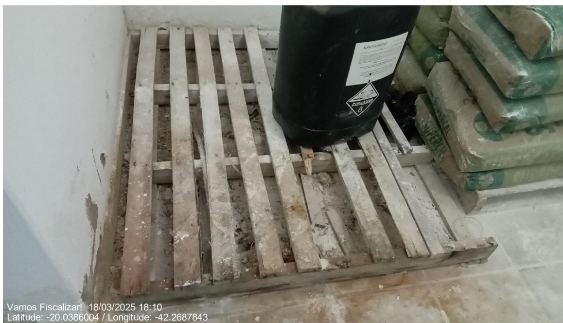
Condições de limpeza da casa de química.
