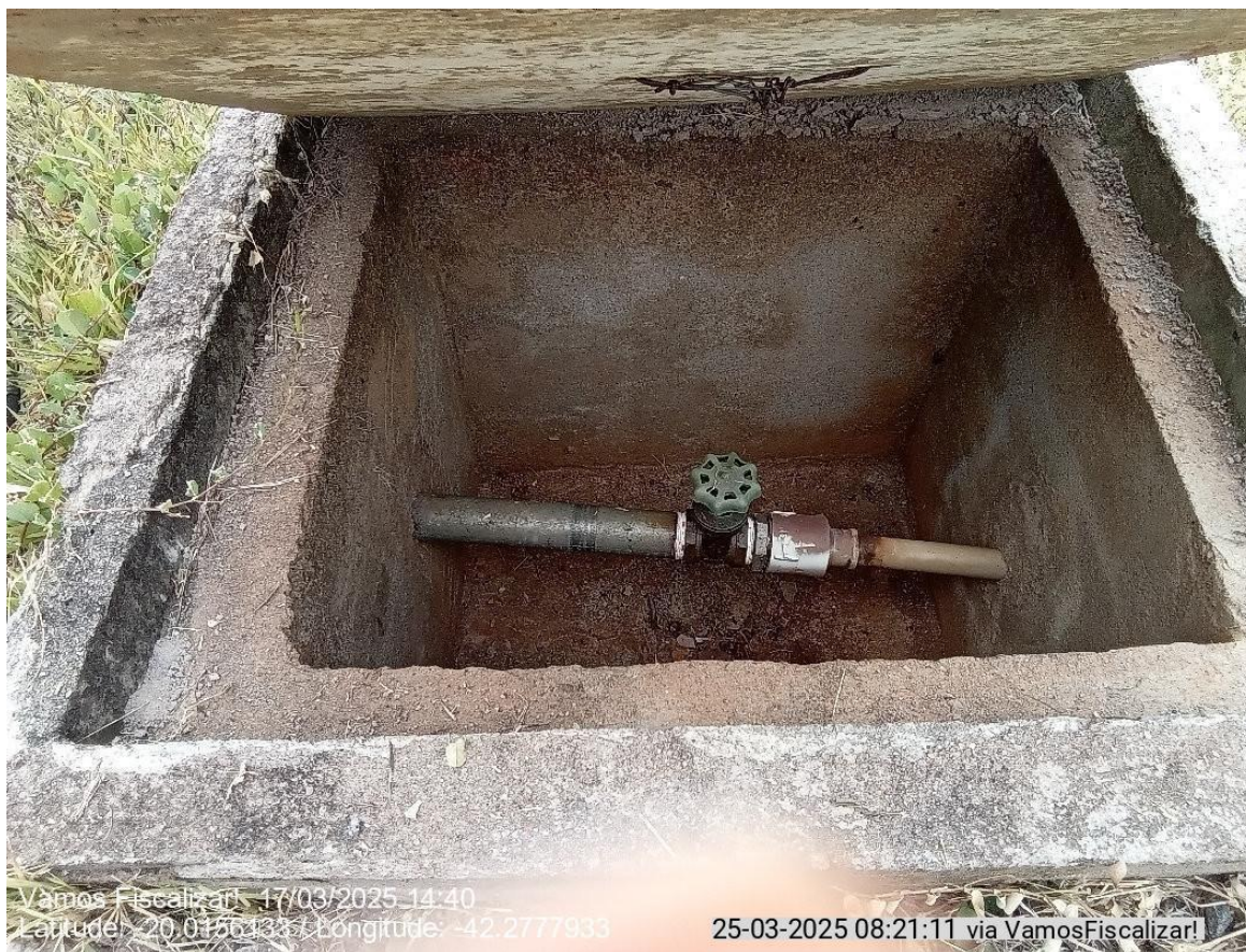
Imagem do registro de fechamento do reservatório.
