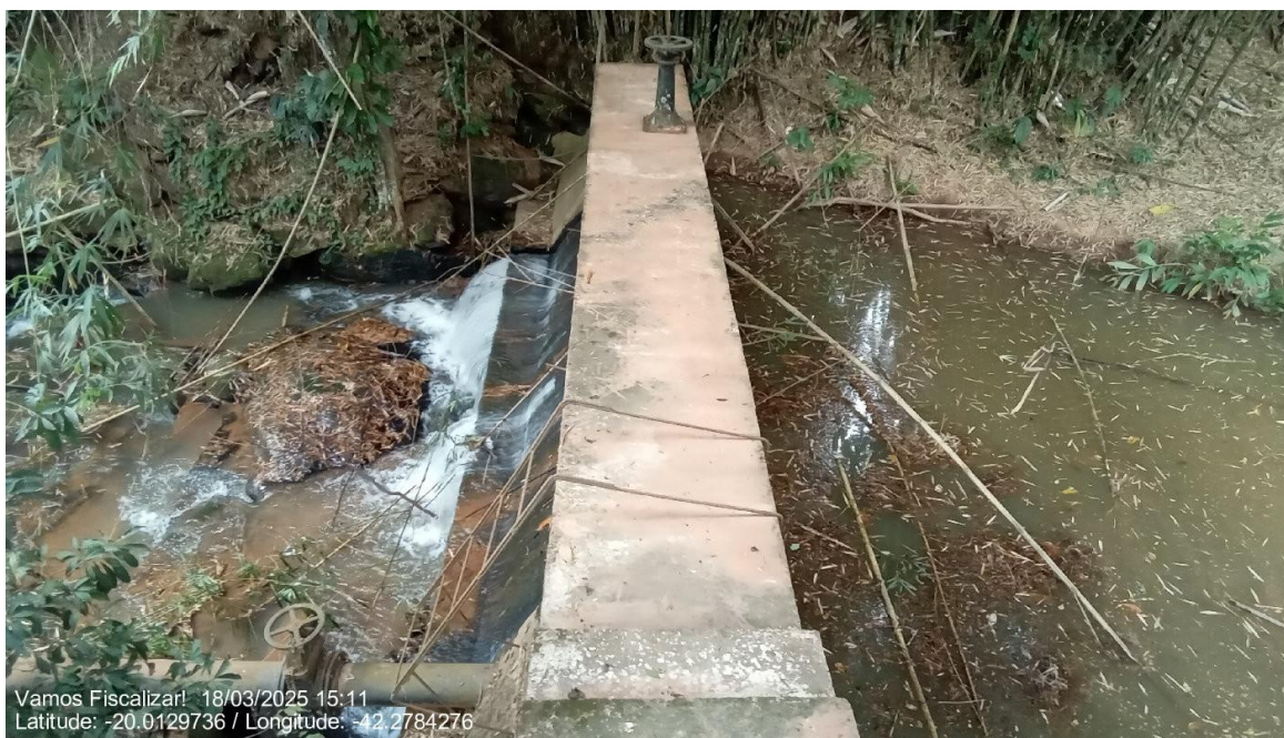
Válvula para regular a vazão na barragem.
