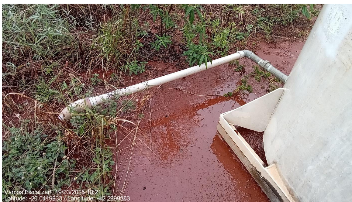
Tubulação de saída.
