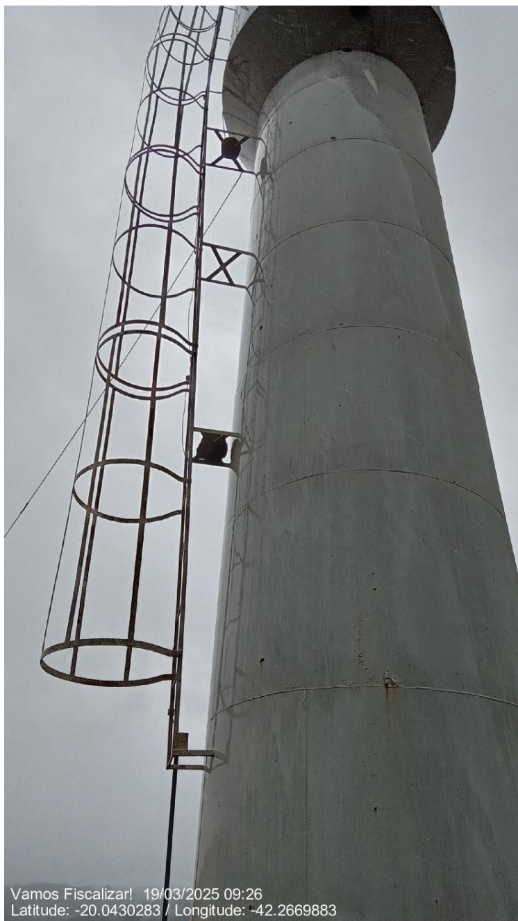
Reservatório Cidade Jardim II.
