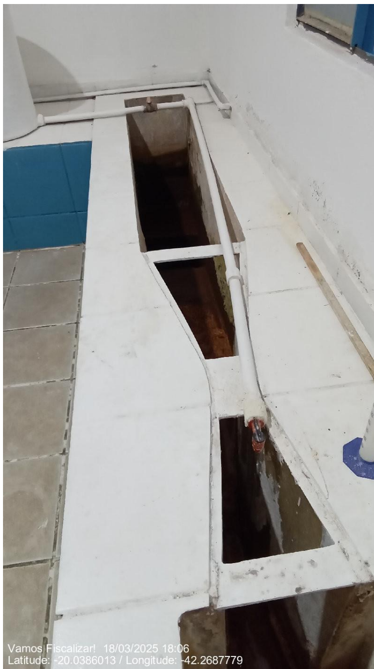
Dosador de sulfato de alumínio.
