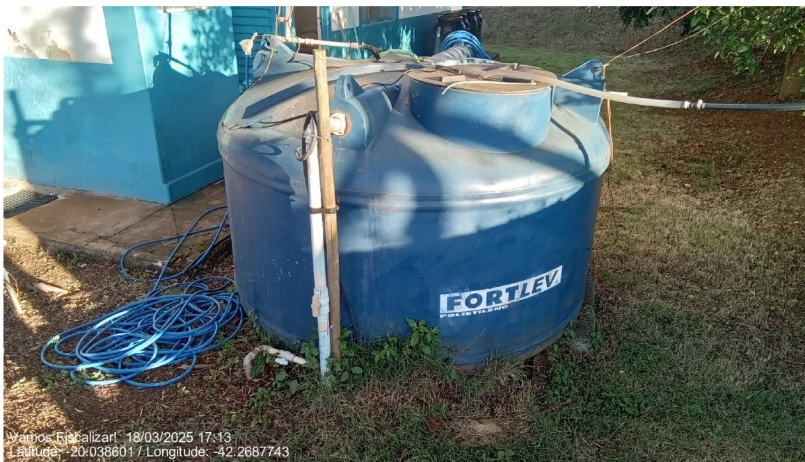
Reservatório Polietileno ETA.
