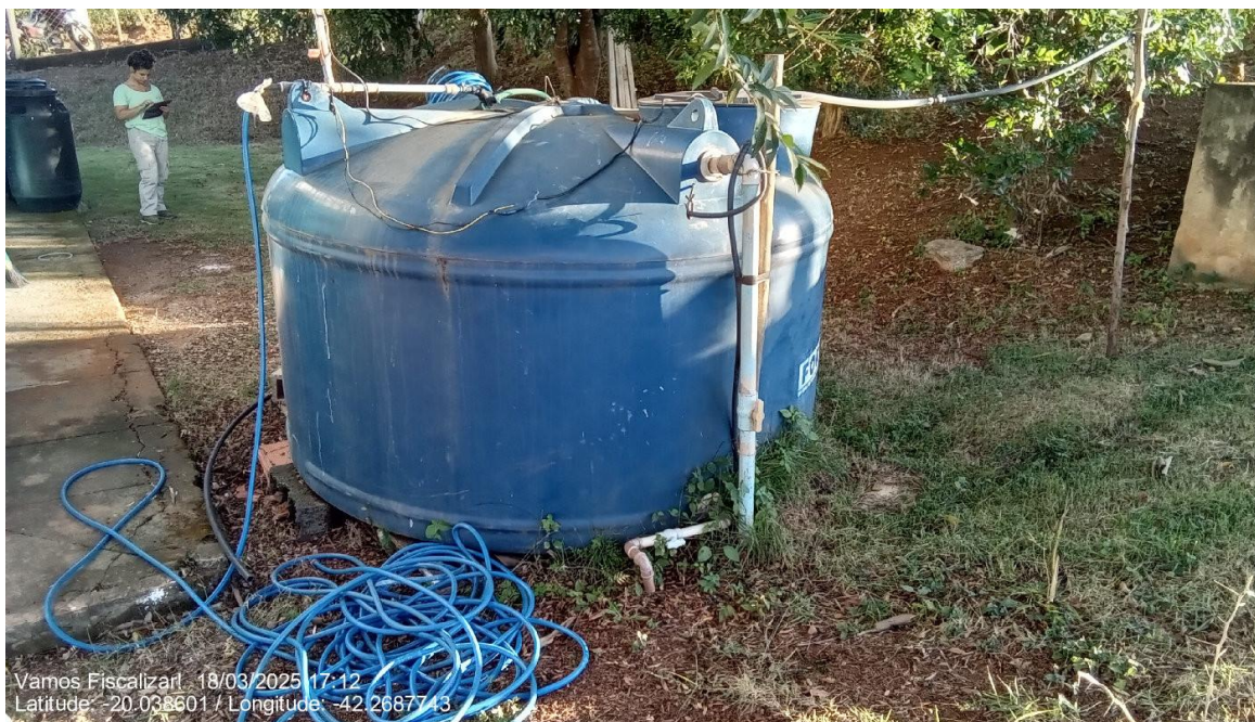
Reservatório Polietileno ETA.
