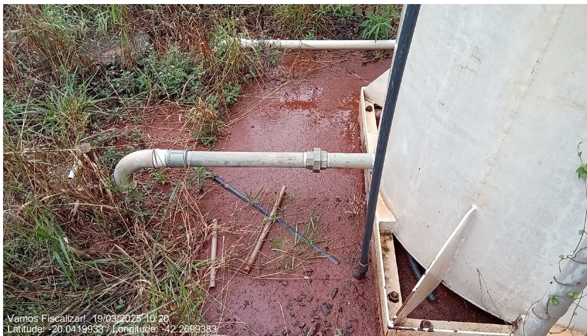
Tubulação de saída.
