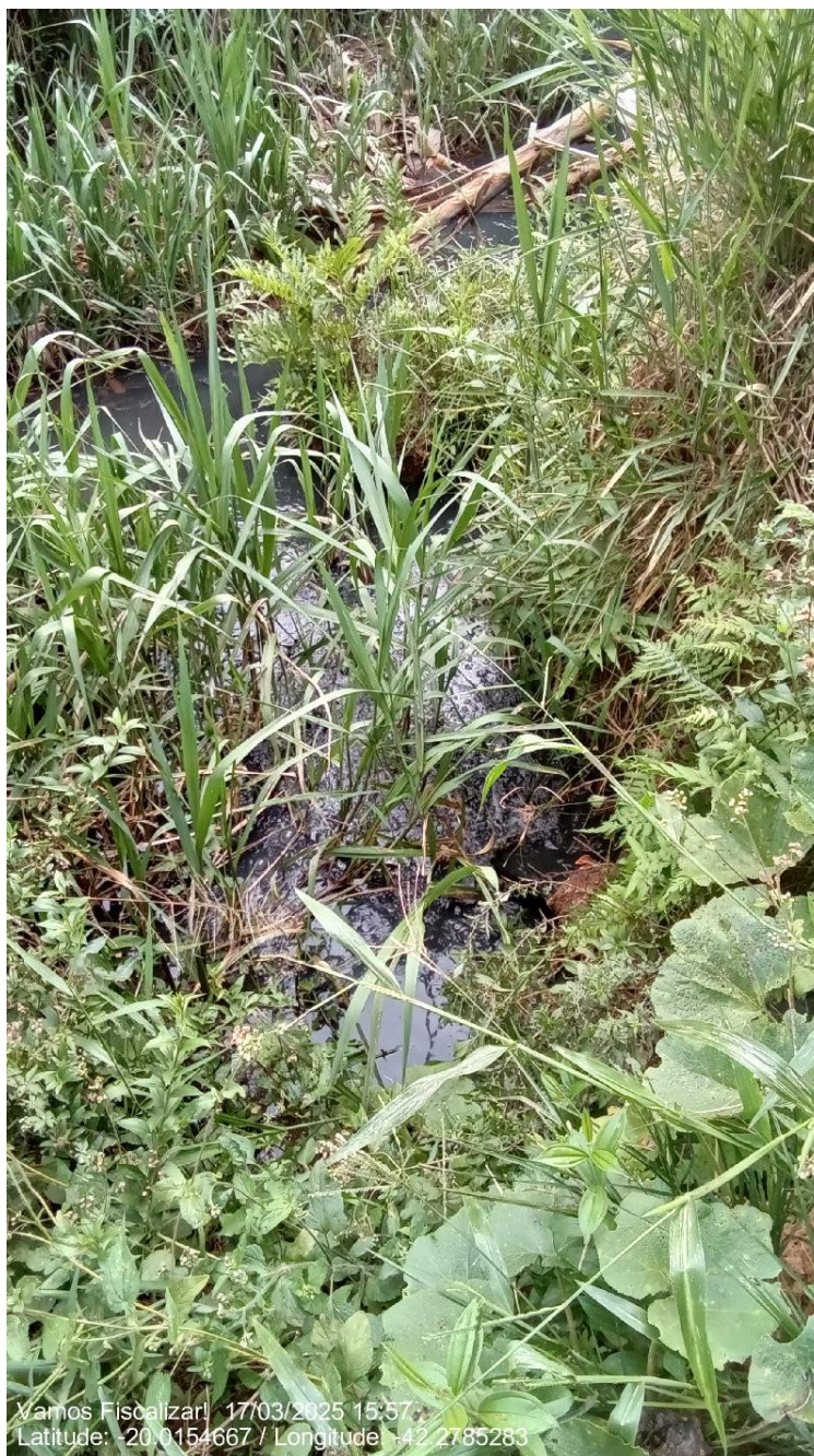
Ladrão do reator UASB.
