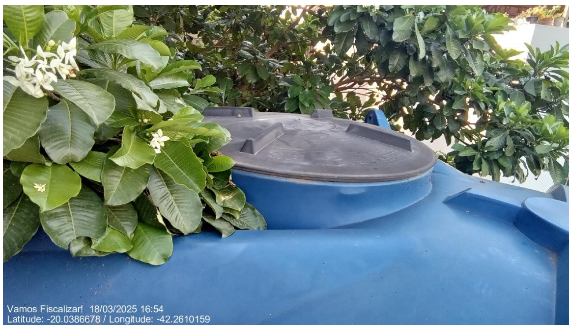
Tampa de inspeção.
