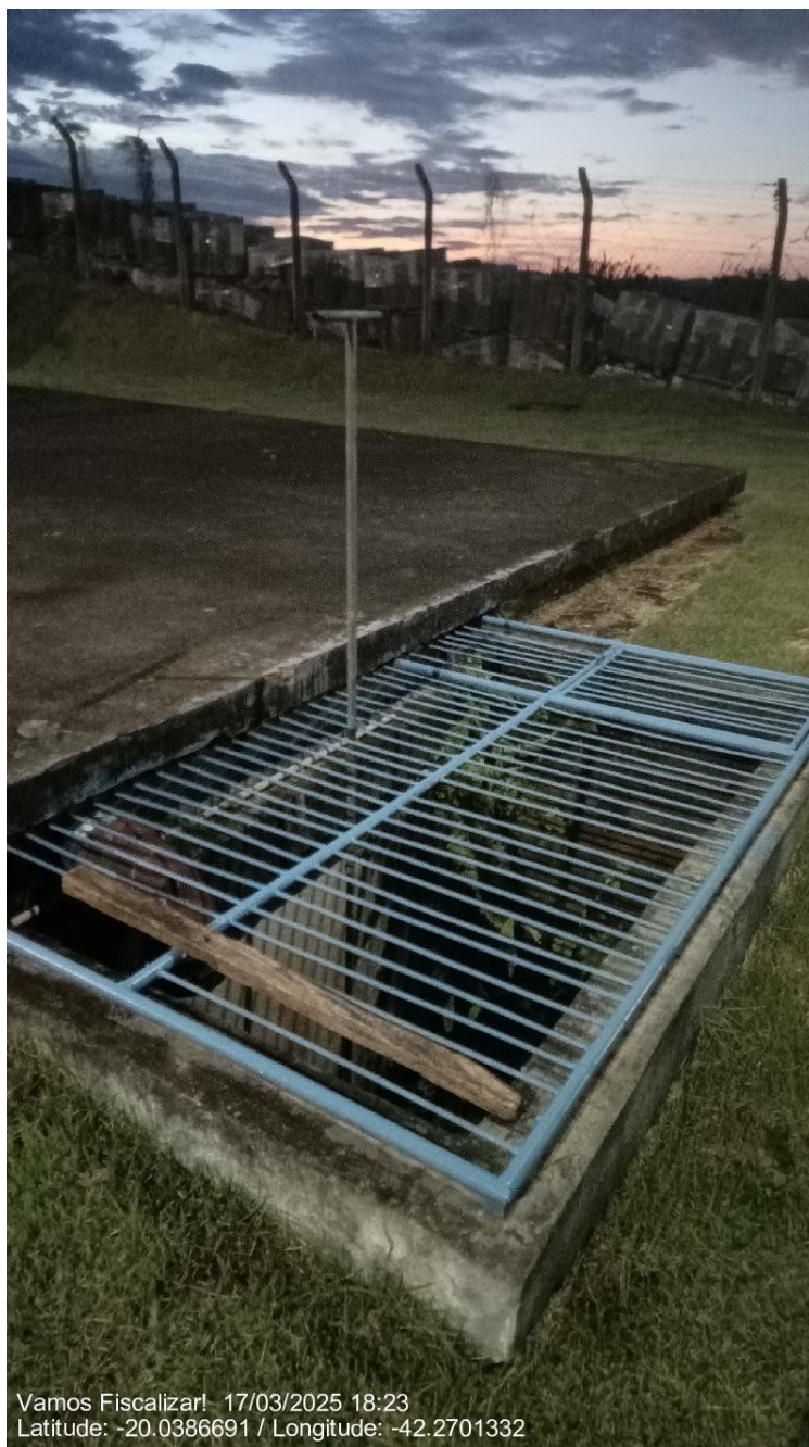
Válvula na saída do reservatório.
