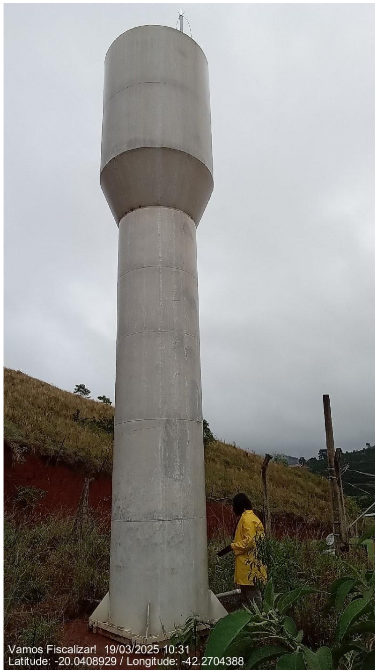
Ausência de tubo de descarga de fundo.
