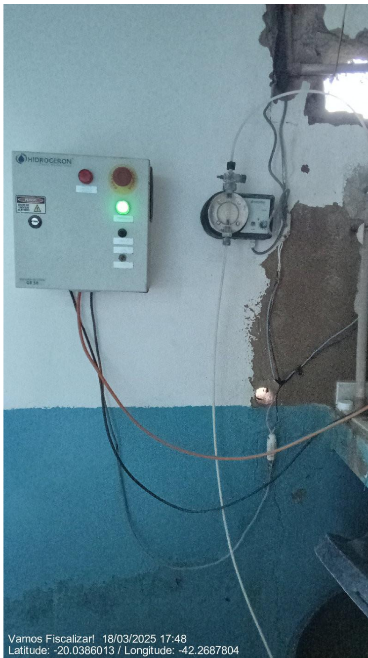
Misturador e bomba dosadora.
