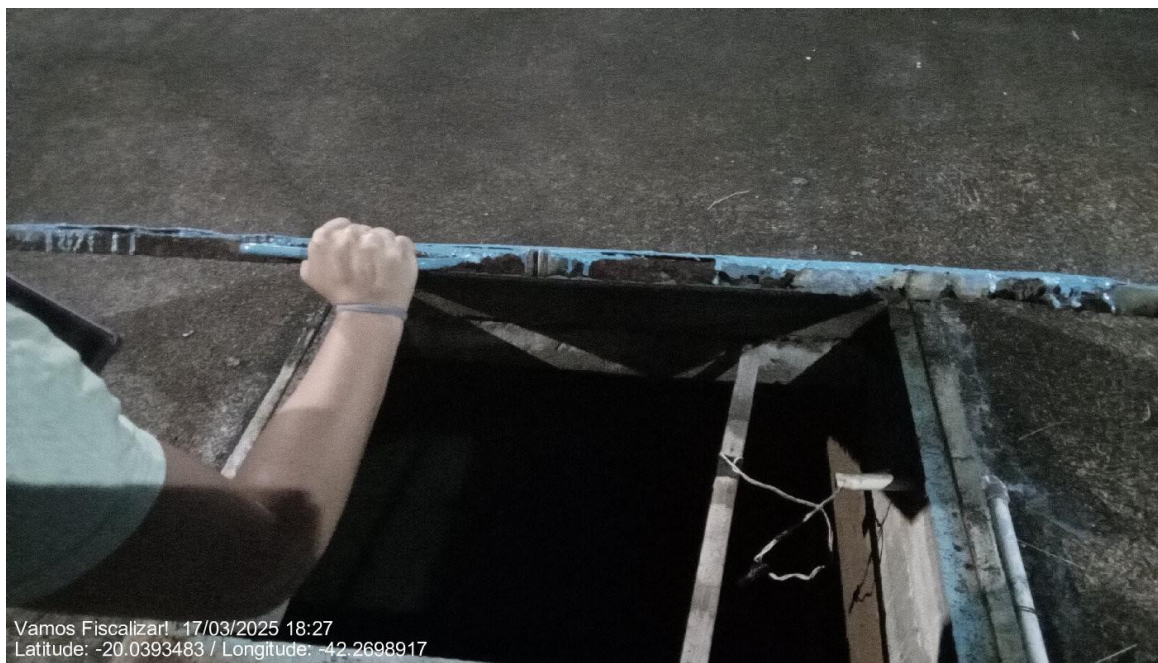
Tampa de inspeção.
