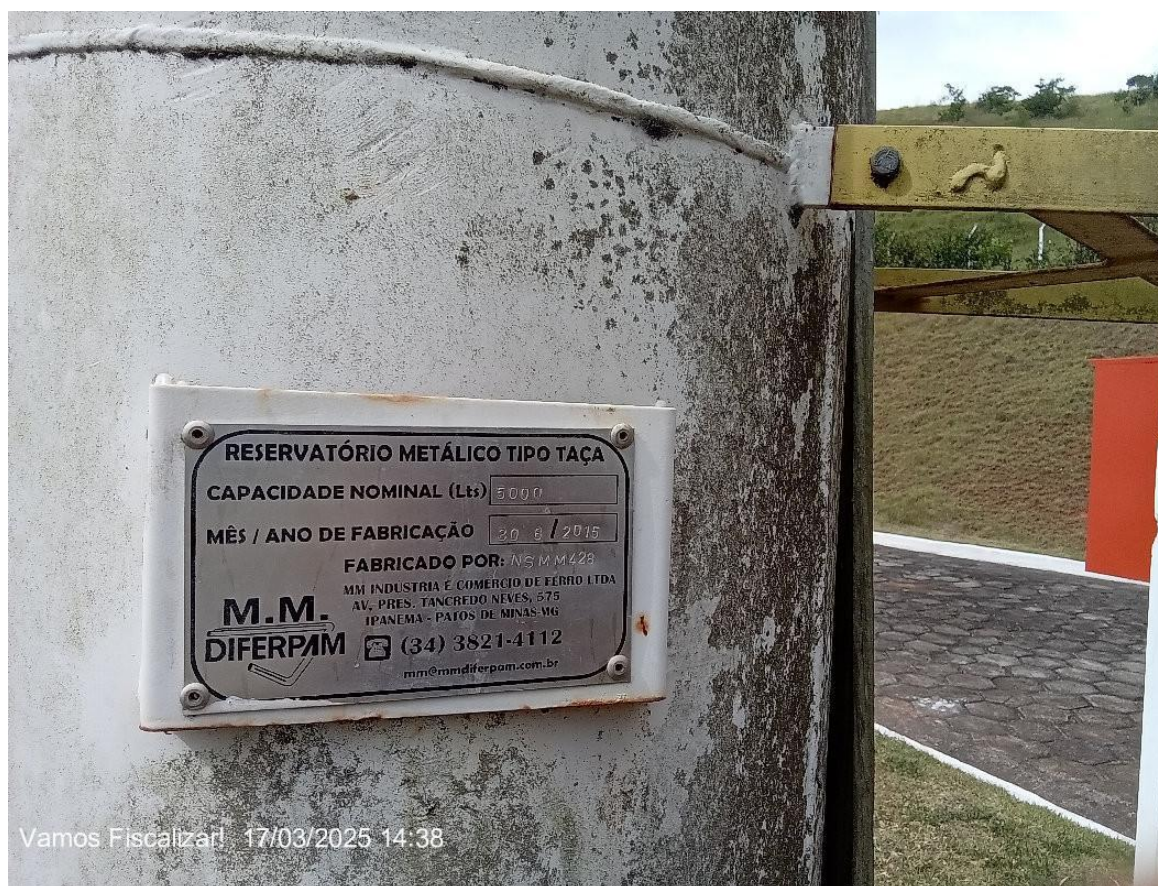
Imagem de placa com informações sobre o reservatório.
