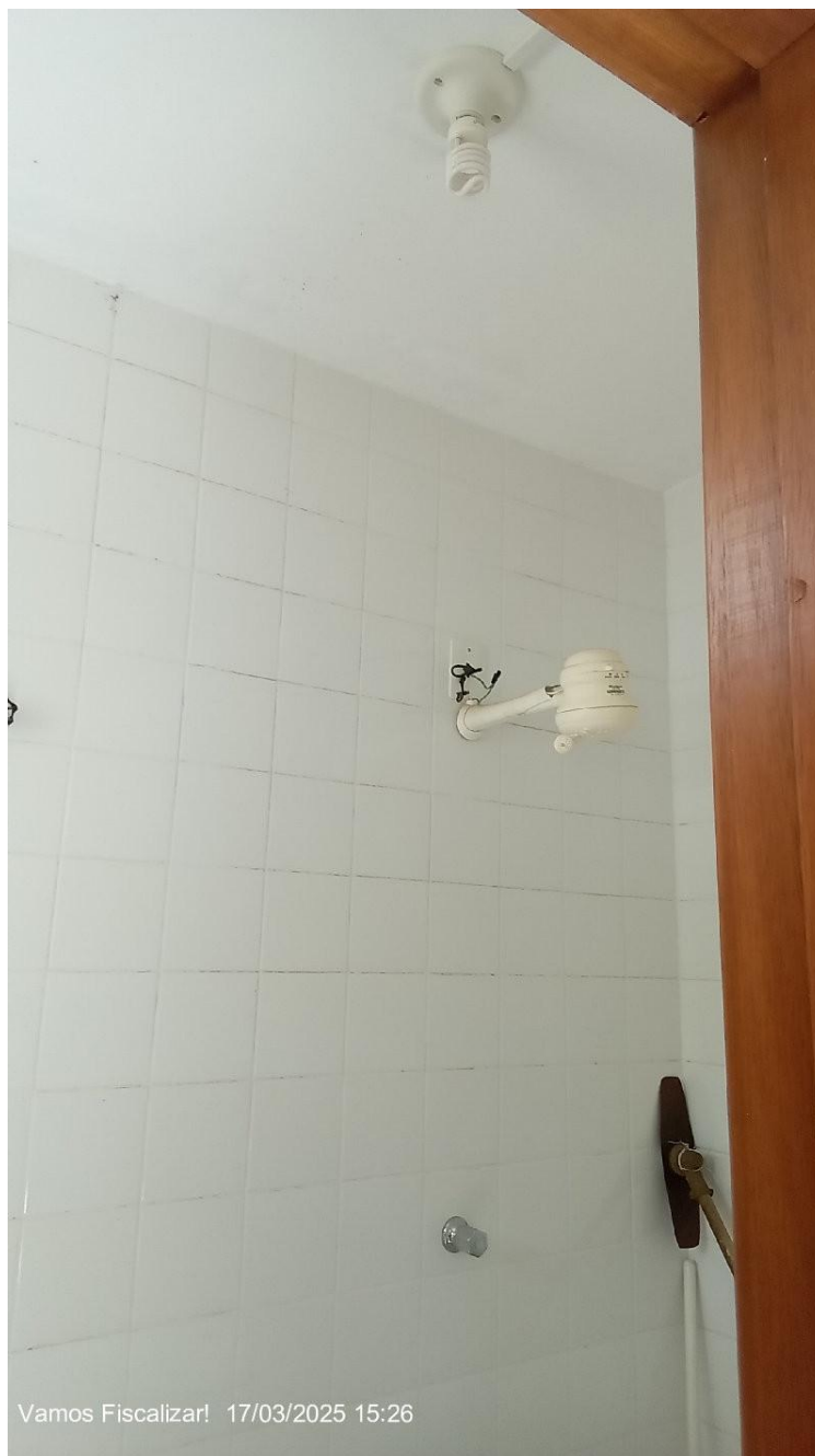
Lâmpada do banheiro queimada.
