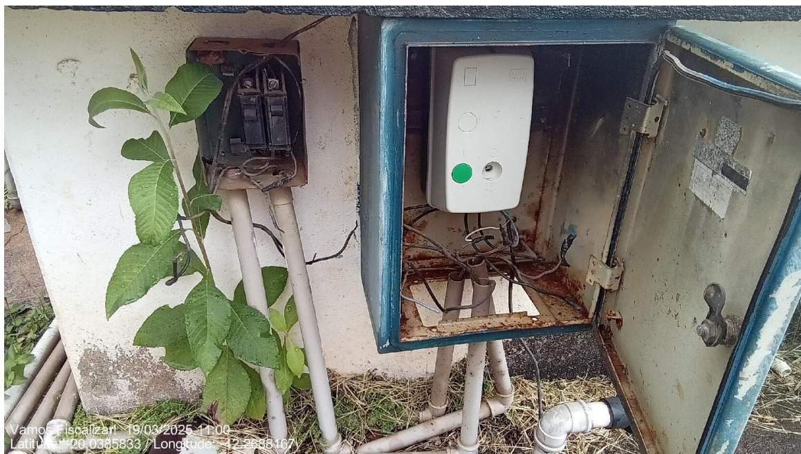
Quadros e cabos elétricos em más condições.
