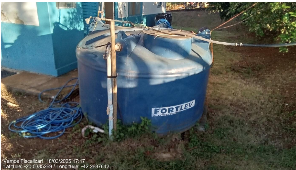
Cobertura do reservatório.
