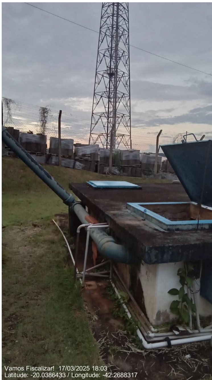
Tanque de contato.
