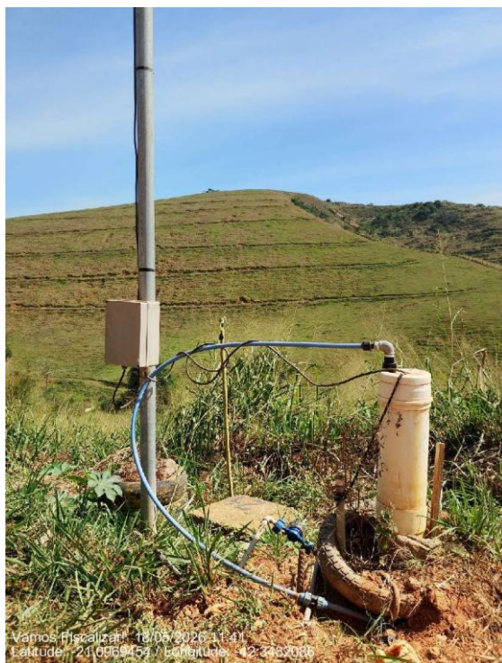
Poço de drenagem forçada de chorume.
