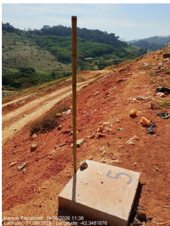
Marco topográfico utilizado para monitoramento da estabilidade do maciço do aterro.
