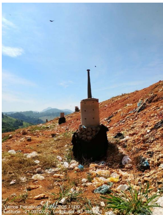
Dreno com queimador.
