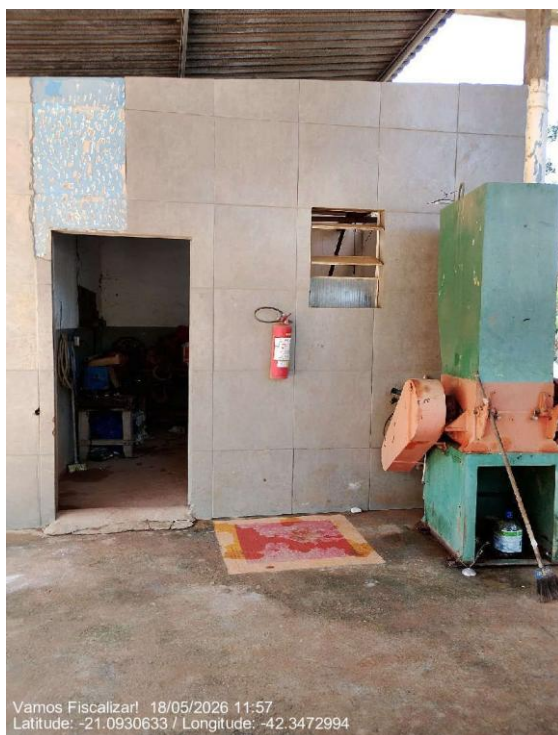
Extintor na área administrativa do aterro.
