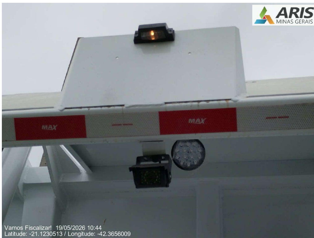
Iluminação superior na área de carregamento e câmera de ré.
