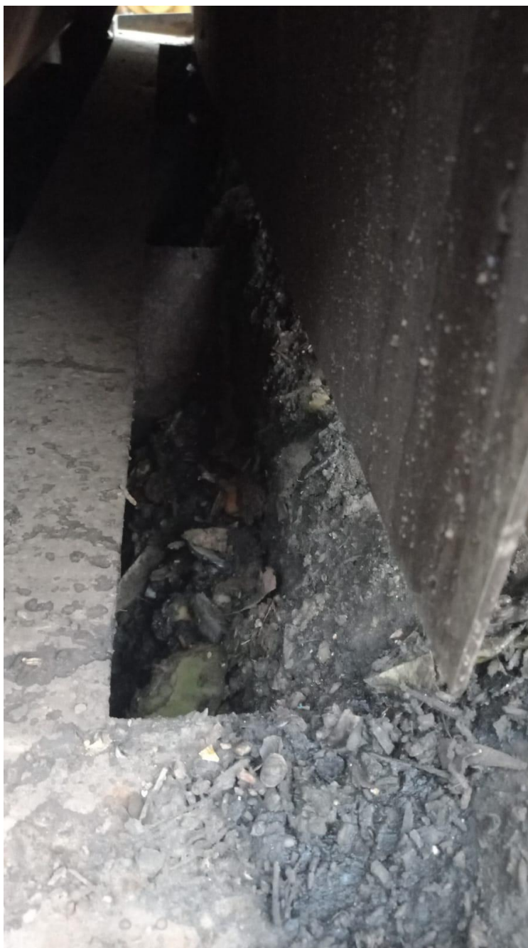
Calha de drenagem de chorume.
