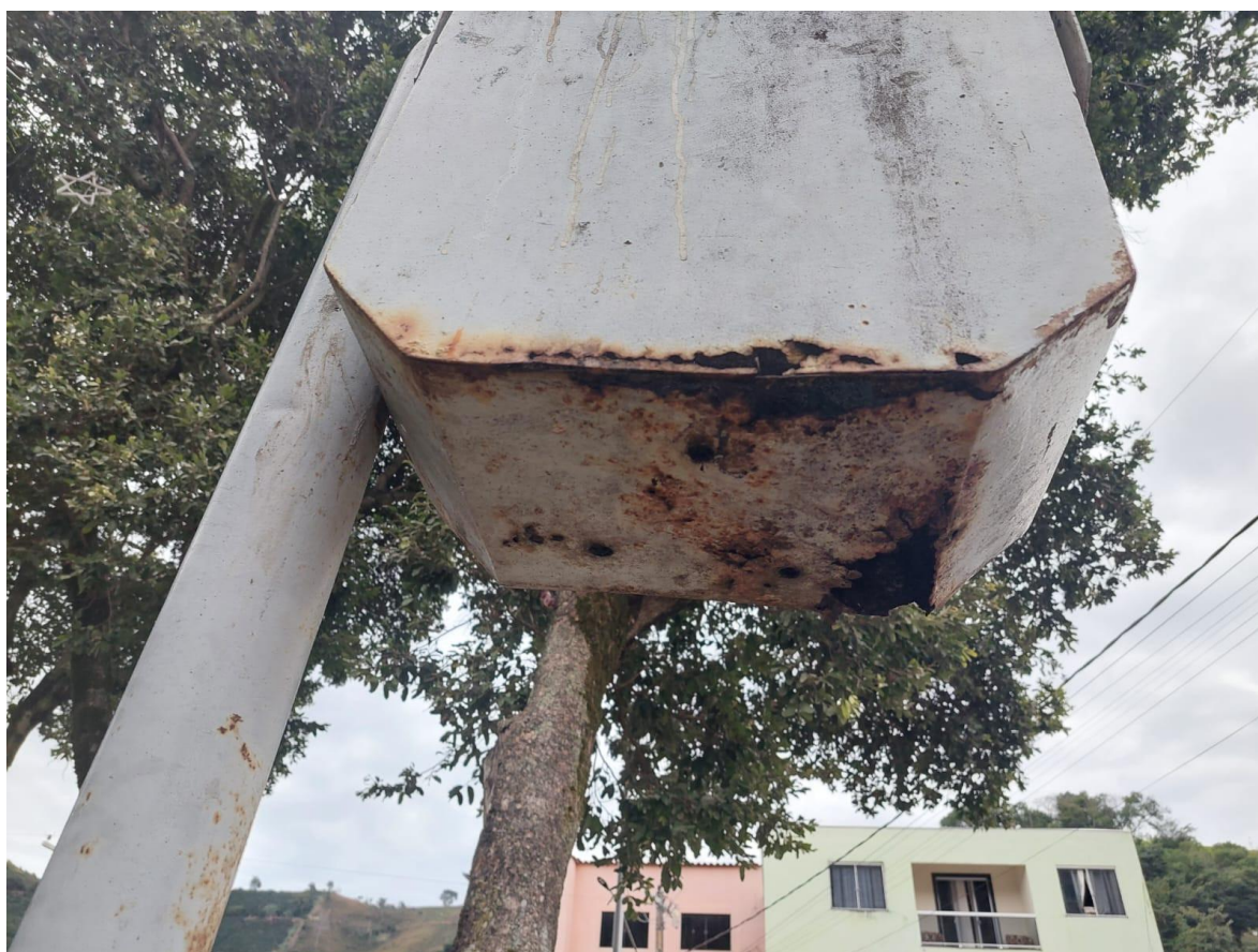
Fundo da lixeira com corrosão.
