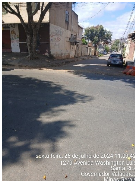
Figura 9 – PV s coberto pelo recapeamento asfalto
