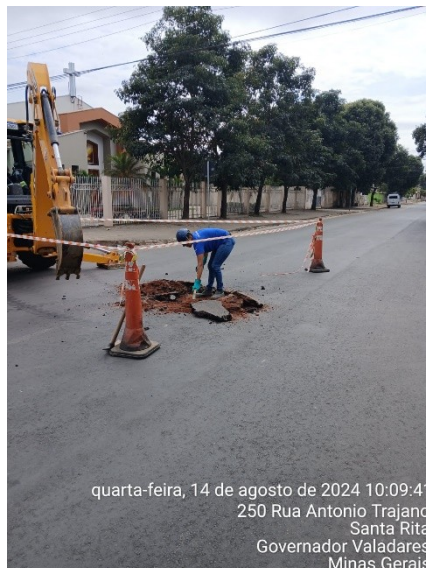
Figura 03.1 – PV tamponado pelo recapeamento asfáltico
