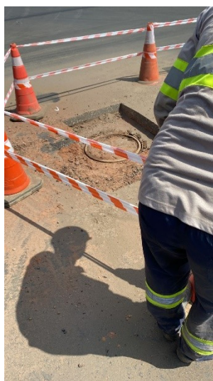
Figura 03.3 – PV tamponado pelo recapeamento asfáltico
