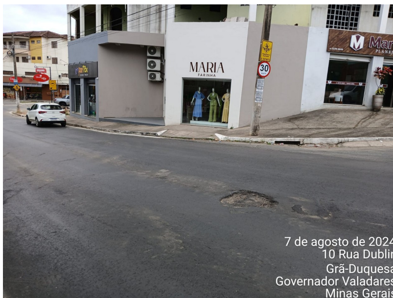
Figura 41 – PV tamponado e que necessita de nivelamento
