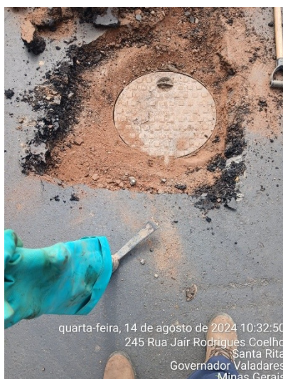
Figura 03.2 – PV tamponado pelo recapeamento asfáltico
