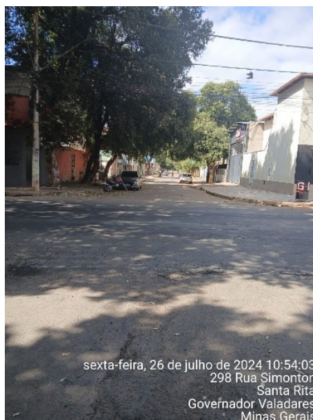
Figura 19 – PV s coberto pelo recapeamento asfalto
