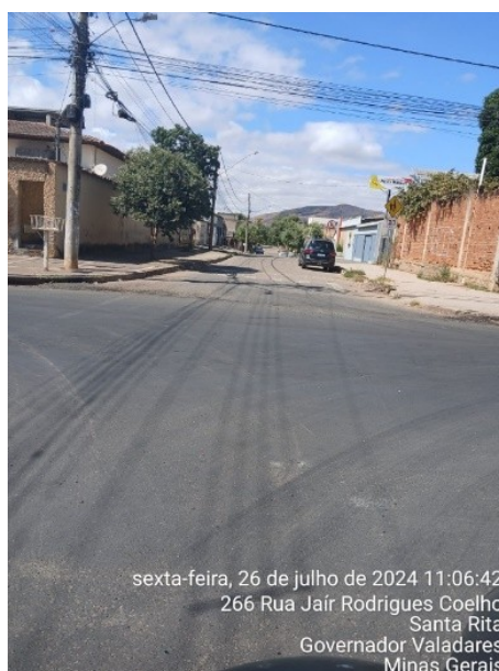
Figura 11 – PV s coberto pelo recapeamento asfalto
