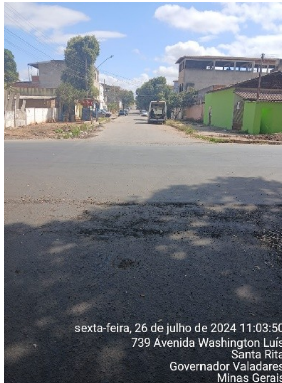
Figura 21 – PV s coberto pelo recapeamento asfalto
