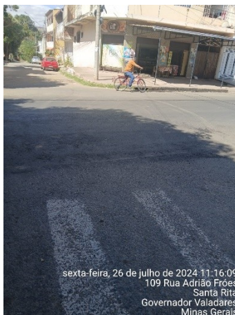
Figura 5 – PV s coberto pelo recapeamento asfalto
