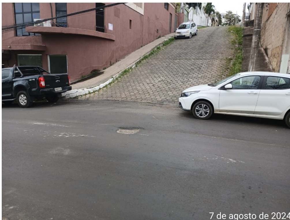
Figura 29 – PV tamponado e que necessita de nivelamento
