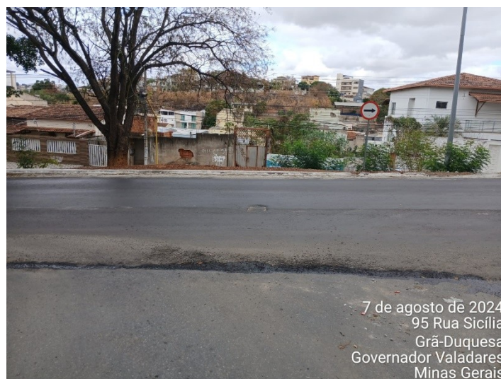
Figura 27 – PV travado pelo recapeamento asfalto
