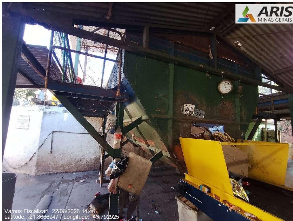
Funil de escoamento que direciona o resíduo para a mesa de triagem.
