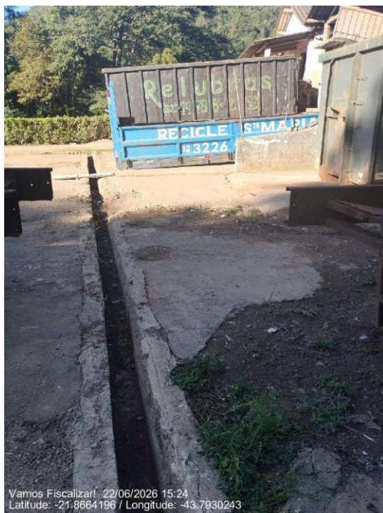
Canaletas para coleta de chorume
