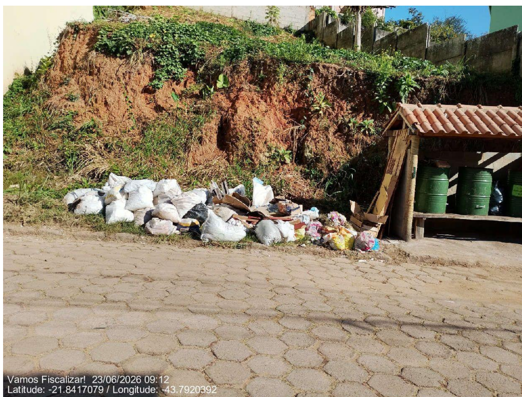
Pontos de descarte irregular de RCC ao lado das casinhas.
