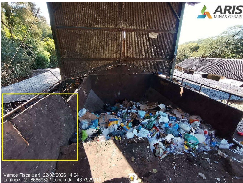
Destaque Amarelo - Estruturas improvisadas na área do funil de escoamento.
