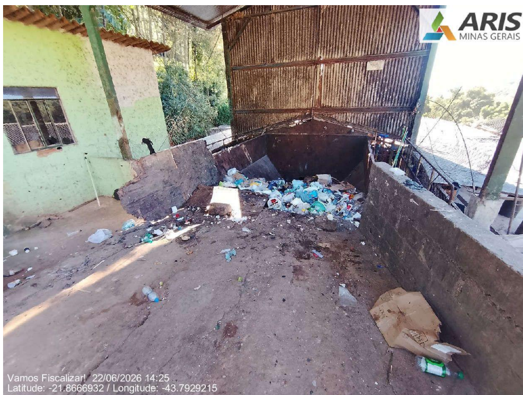
Área do funil de escoamento.
