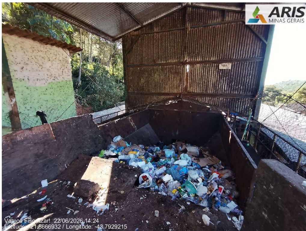
Estruturas improvisadas na área do funil de escoamento.
