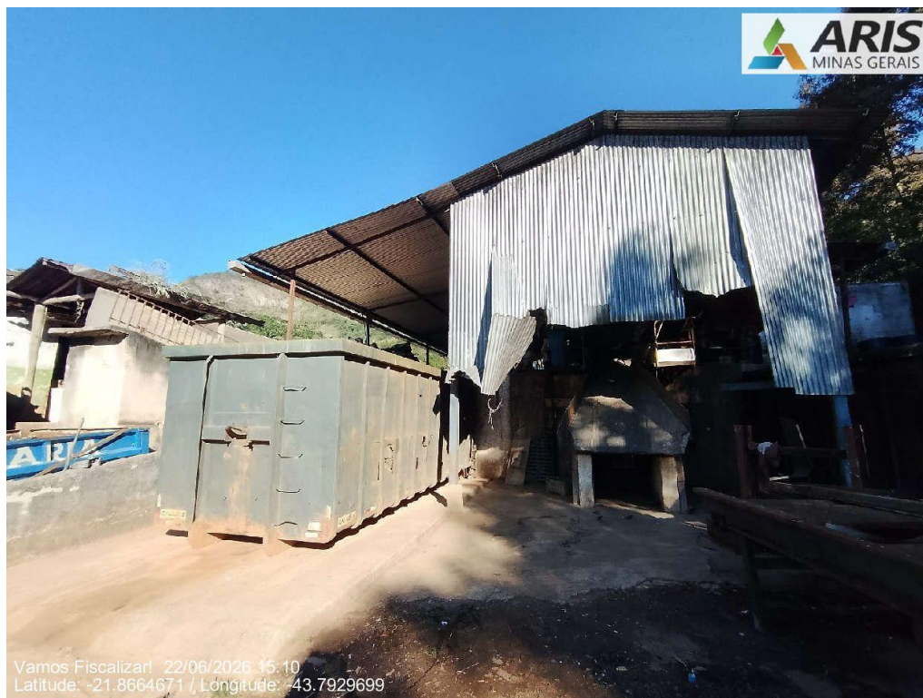
Contêiner localizado em área sem cobertura, ficando exposto à chuva e sol.
