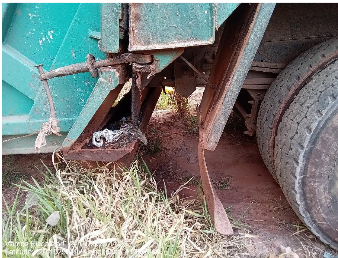
Calha de drenagem de chorume, necessitando de limpeza e esvaziamento.
