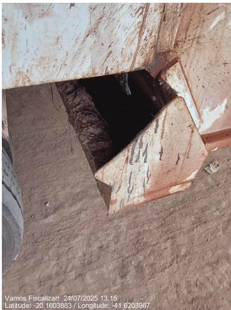
Calha de drenagem de chorume, necessitando de limpeza e esvaziamento.
