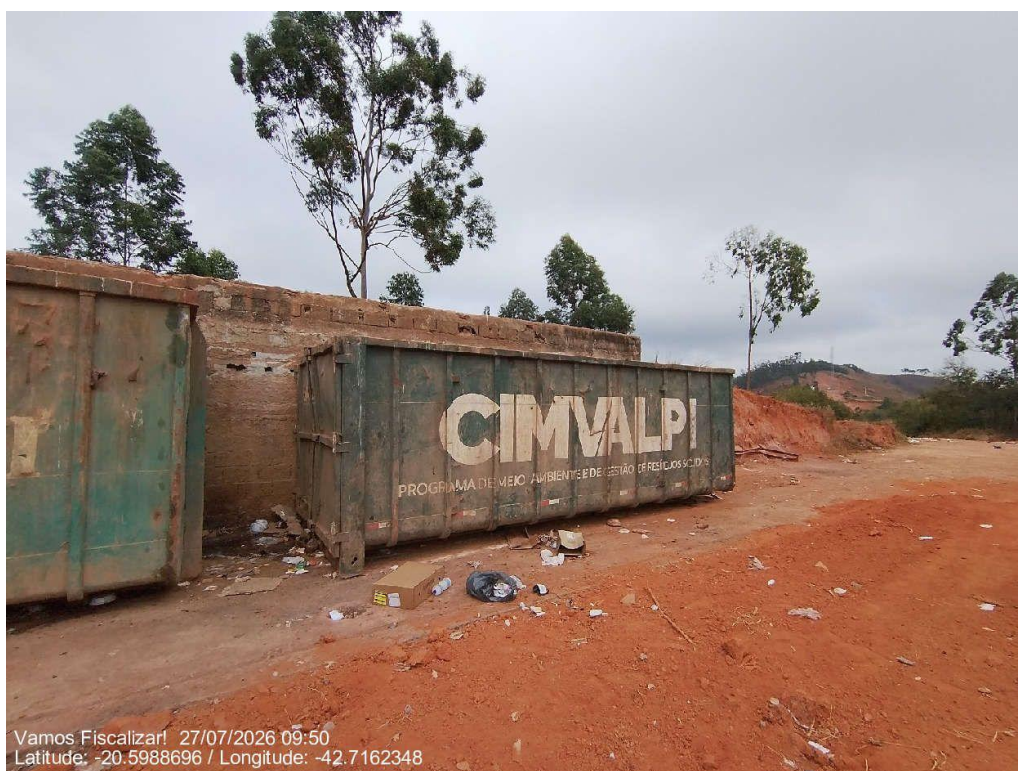
Ausência de cobertura na área de transbordo.
