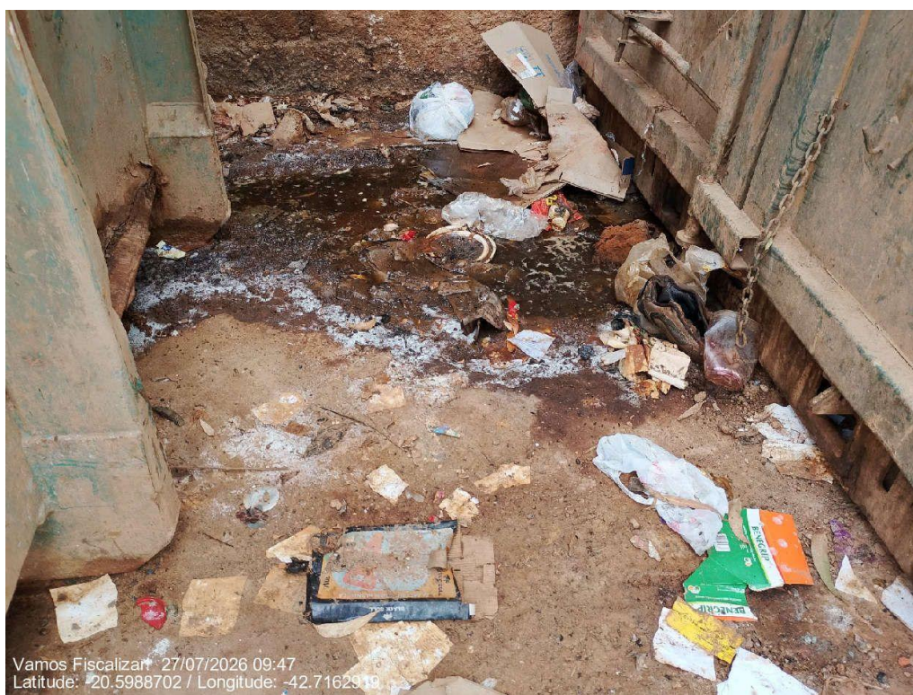
Acúmulo de água e chorume.
