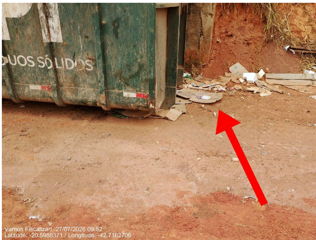
Ausência de laje de concreto na região do contêiner.
