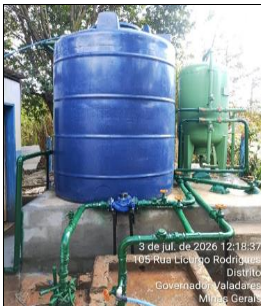
Figura 1. Sistema de tratamento filtro zeólita UTA Itapinoã.
