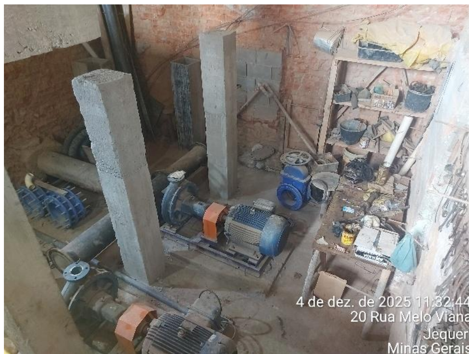
Figura 15 – Dois conjuntos motobombas novos dentro da área da EEAB, ociosos por não estarem conectados ao sistema – Vista 2
