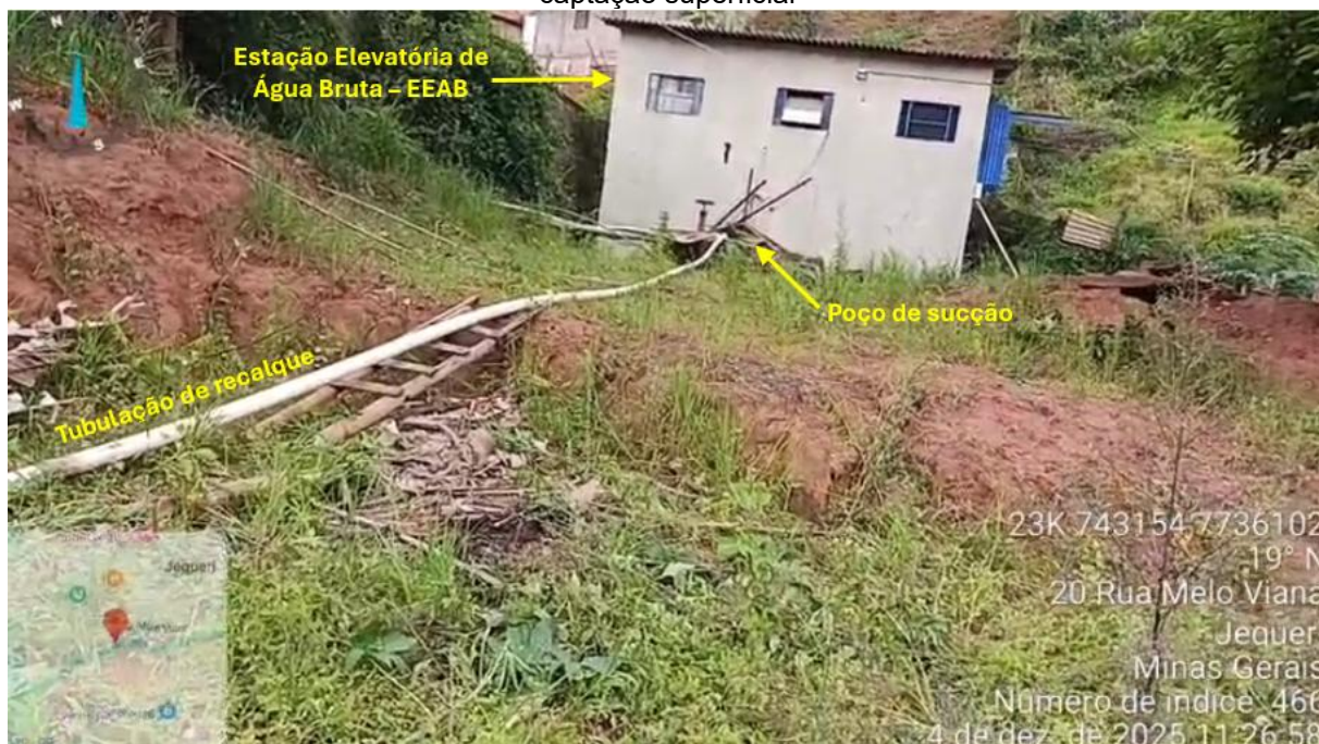
Figura 6 – Tubulação de Recalque do terceiro conjunto motobomba instalado para complementar a captação superficial
