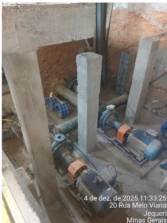
Figura 14 – Dois conjuntos motobombas novos dentro da área da EEAB, ociosos por não estarem conectados ao sistema – Vista 1
