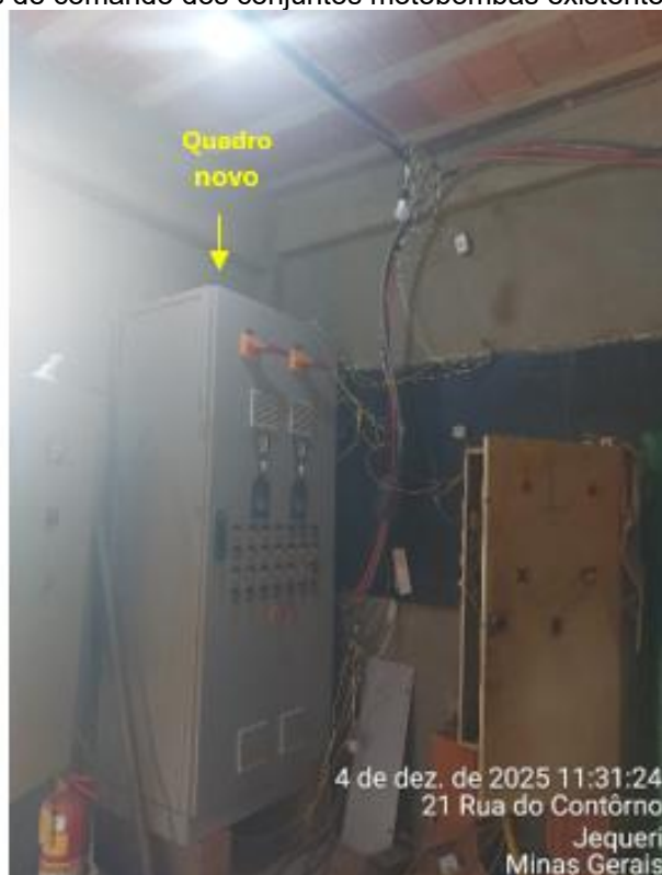
Figura 17 – Quadros de comando dos conjuntos motobombas existentes na EEAB – Vista 2.
