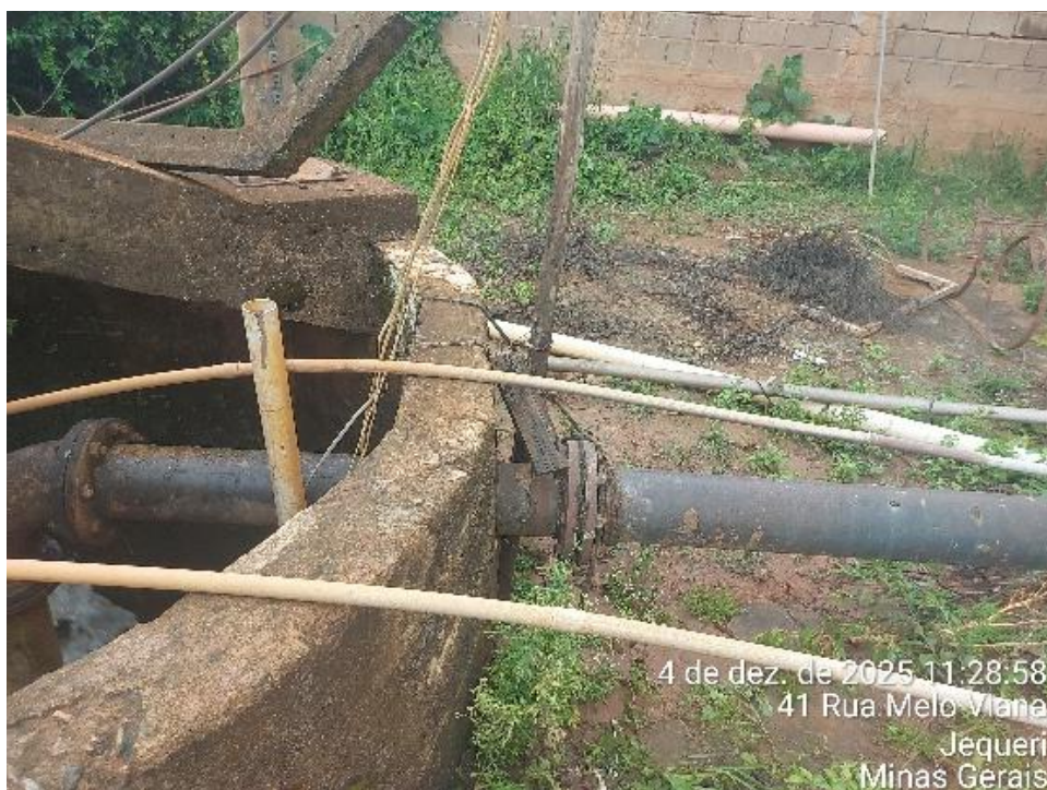
Figura 10 – Tubulação de Sucção da EEAB
