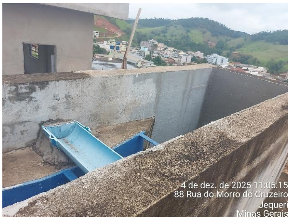
Figura 25 – Calha Parshall do Projeto de Ampliação Não finalizado
