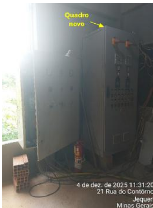
Figura 16 – Quadros de comando dos conjuntos motobombas existentes na EEAB – Vista 1.
