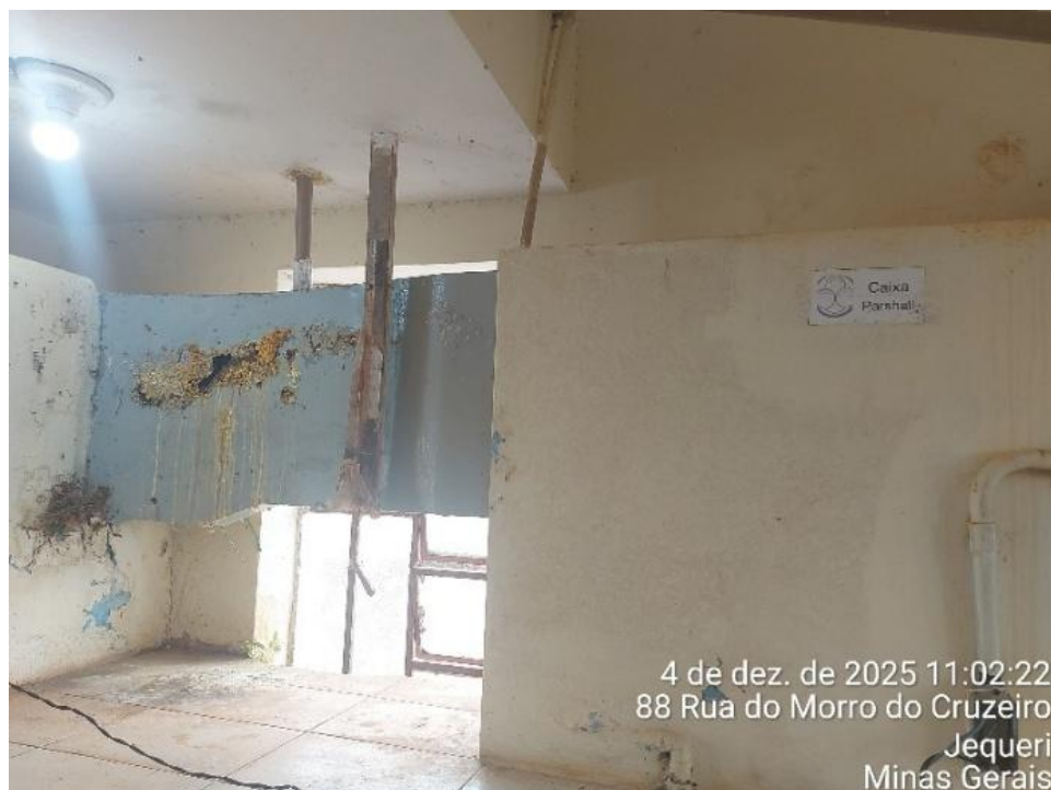
Figura 24 – Calha Parsall e régua de medição
