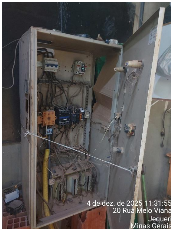
Figura 19 – Interior dos quadros de comando dos conjuntos motobombas em operação na EEAB – Vista 2.
