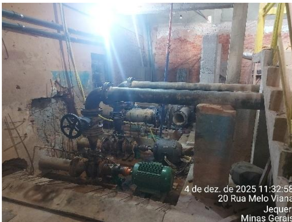
Figura 12 – Dois conjuntos motobombas em operação na EEAB – Vista 1
