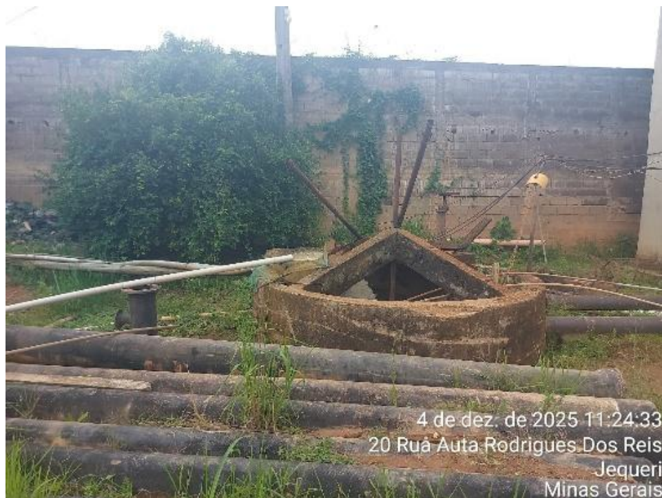
Figura 7 – Poço de sucção com destaque para a tubulação de recalque do terceiro conjunto motobomba
