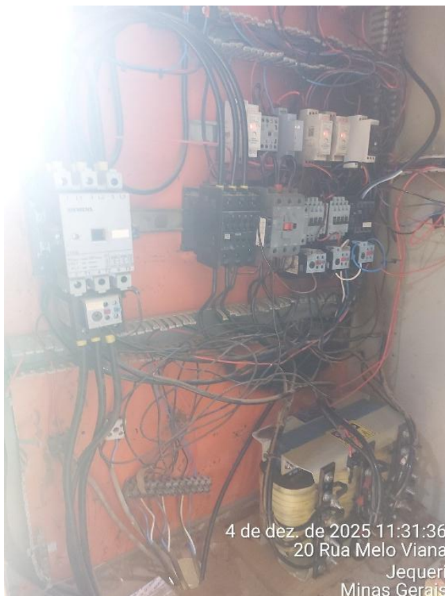
Figura 18 – Interior dos quadros de comando dos conjuntos motobombas em operação na EEAB – Vista 1.
