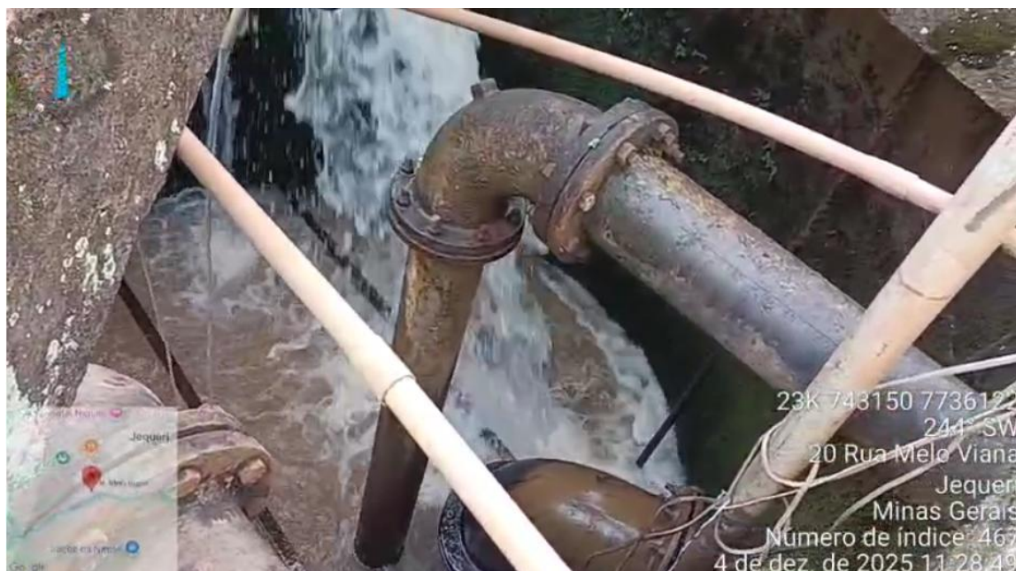
Figura 8 – Interior do poço de sucção e as tubulações de sucção
