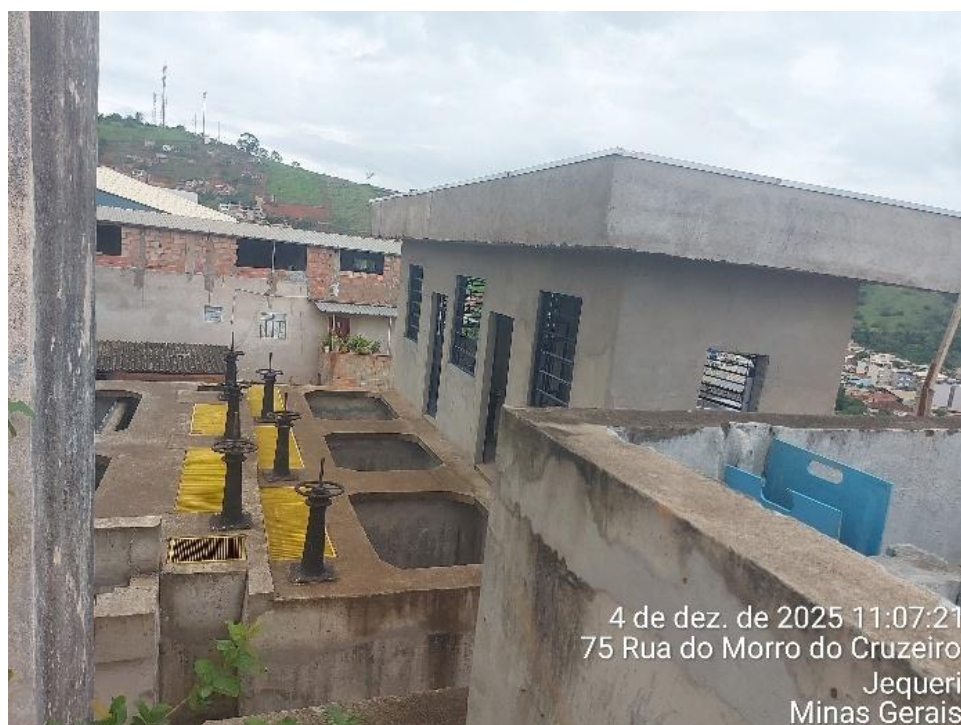
Figura 29 – Estrutura do Projeto de Ampliação Não finalizado
