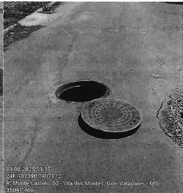
Figura 3 - Poço de Visitas de rede Pluvial
