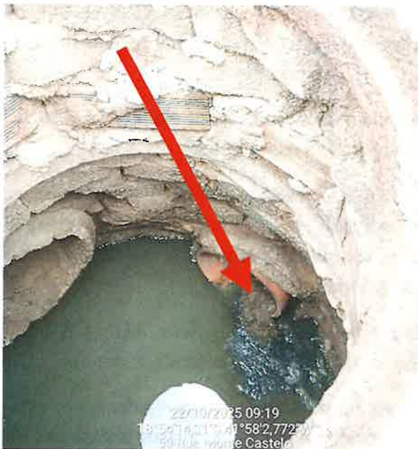
Figura 3 – Extravasor na rede pluvial
