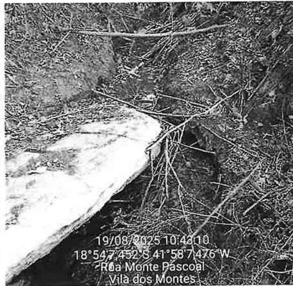
Figura 9 - Poça de esgoto in natura no trecho
