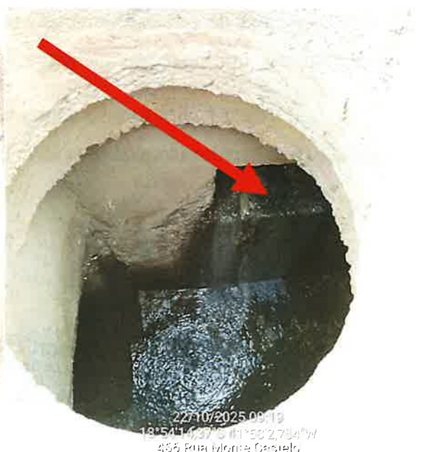
Figura 4 – Fluxo de esgoto descarregando na galeria de agua pluvial
