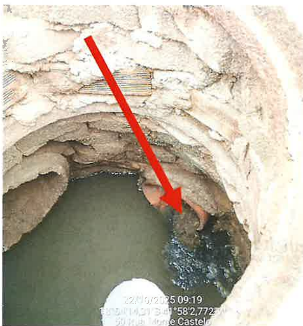
Figura 3 – Extravasor na rede pluvial
