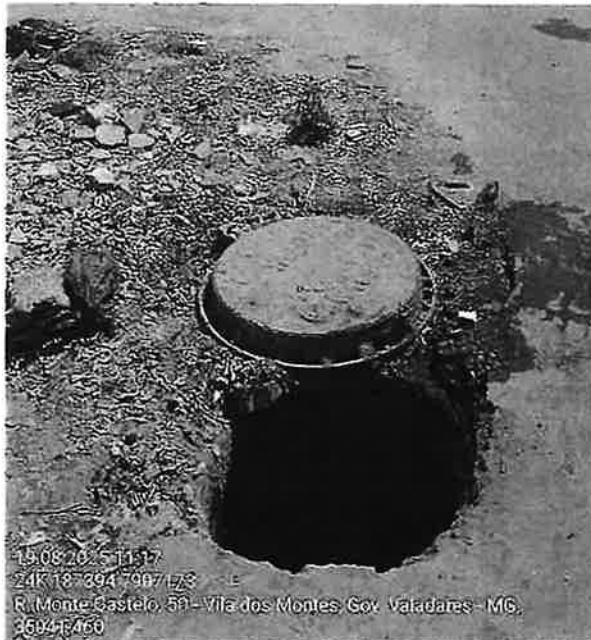
Figura 2 - Poço de Visitas de rede de esgoto
