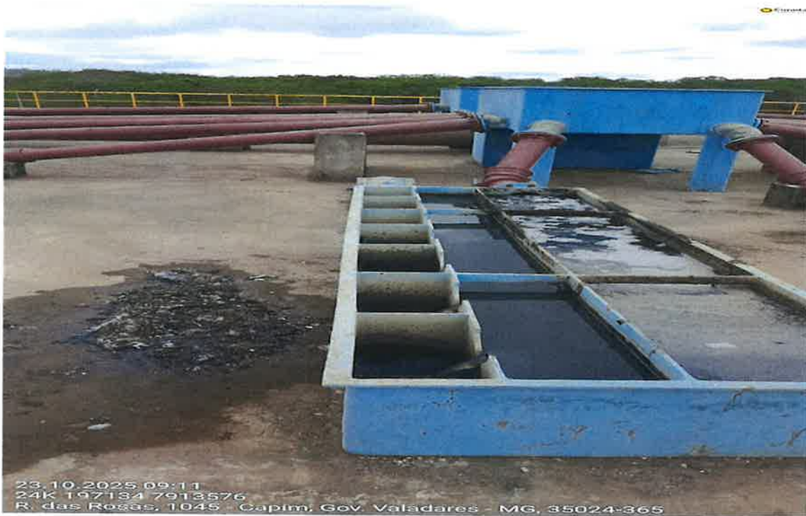
Foto 04: Sólidos grosseiros retirados das caixas divisoras de vazão, localizadas sobre os reatores anaeróbios, pela ausência de operação efetiva do equipamento de TP.
