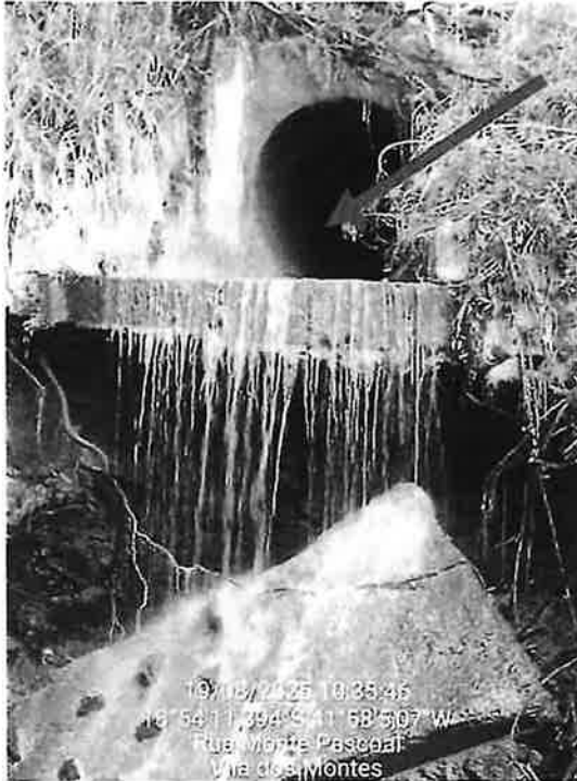
Figura 6 - Rede pluvial com fluxo de esgoto
